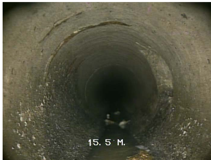
Figure 5 – Armature apparente, rue des Bois, Rosemère
