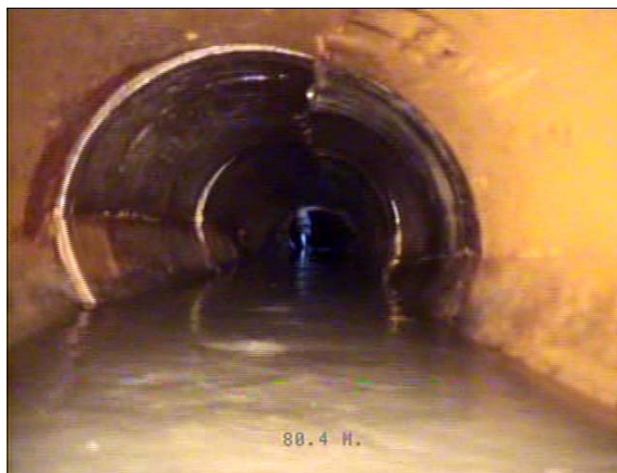
Figure 7 – Déformation de la section de conduite d'environ 20 %, rue Saint-Patrice Est, Magog
