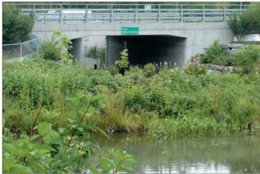
Figure 6-D : Étang de sédimentation.
