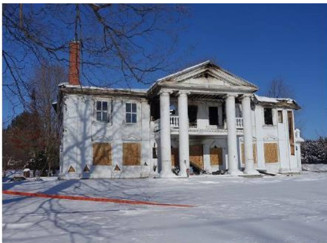
2) Manoir Taschereau après incendie vu de l'ouest. La charpente et la couverture de la toiture se sont effondrées au niveau de l'étage.
