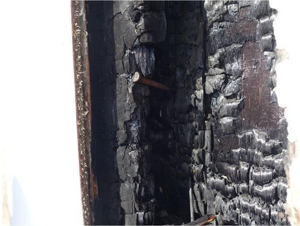
11) Manoir Taschereau après incendie vu du rez-de-chaussée. Idem détail.
