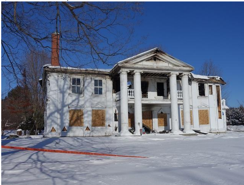
2) Manoir Taschereau après incendie vu de l'ouest. La charpente et la couverture de la toiture se sont effondrées au niveau de l'étage.
