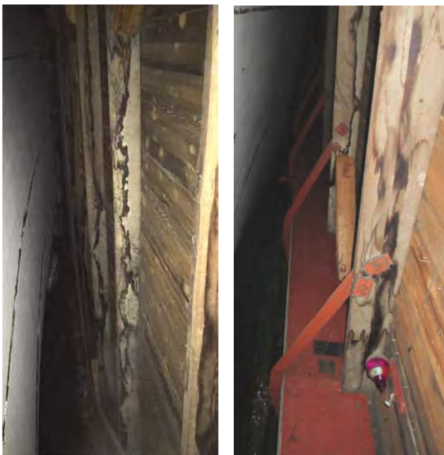
Photos 27 et 27A : Entremises noircies par l'eau
