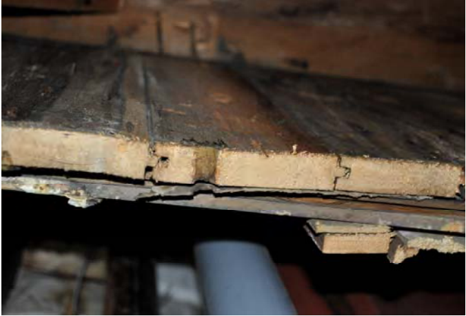
Photo 28 : Pontage extérieur, papier de construction non goudronné et panneaux composites anciens
