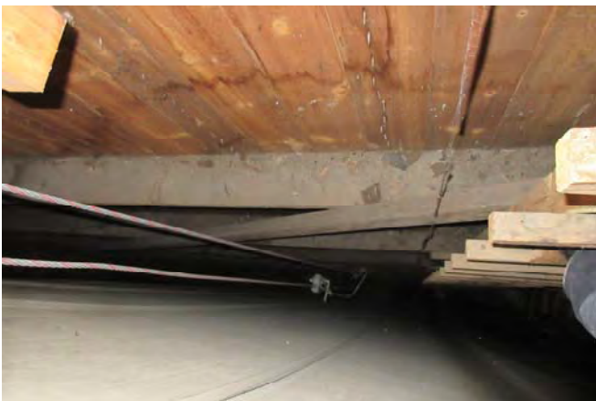
Photo 26 : Pontage mural extérieur vu du haut et traces de dommages par l'eau
