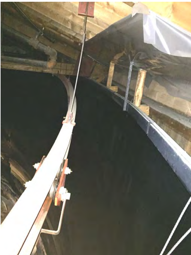
Photo 36 : Rive du toit, polythène, rail suspendu et plaque de renfort à la ferme
