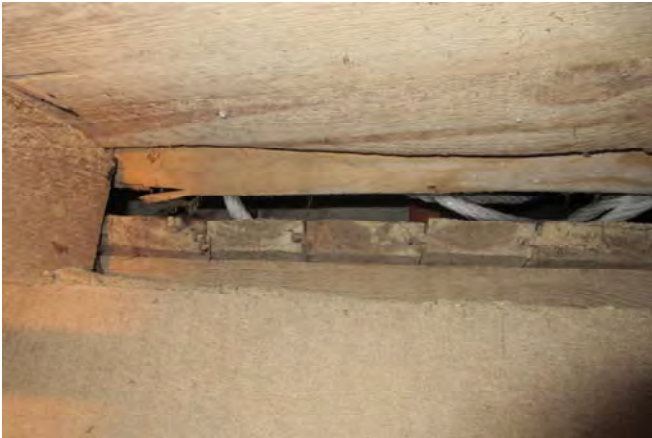
Photo 14 : Discontinuité du pontage
