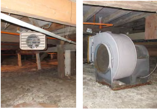
Photo 8-9 : Équipements mécaniques au vide sanitaire
