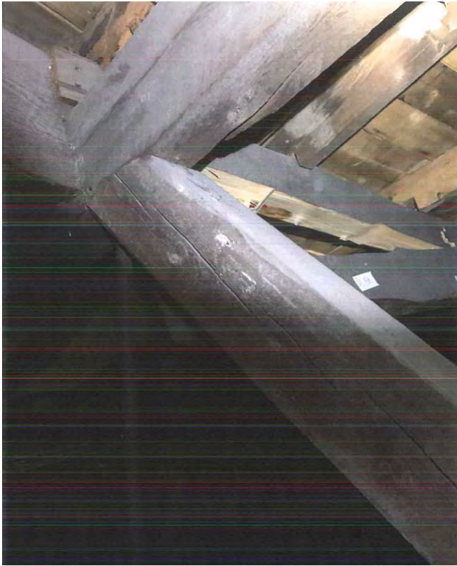
Photo 46 : Poutre affaissée et fendue
