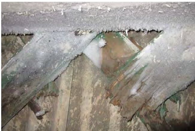
Photo 12 : Anciens treillis de bois et panneaux profilés potentiellement en amiante-ciment
