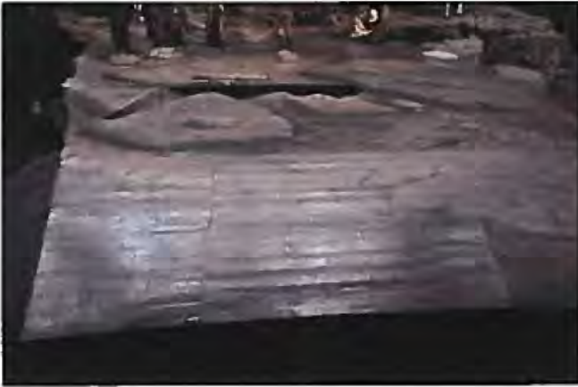
Photo 1 : Toile du faux-terrain qui gondole.
