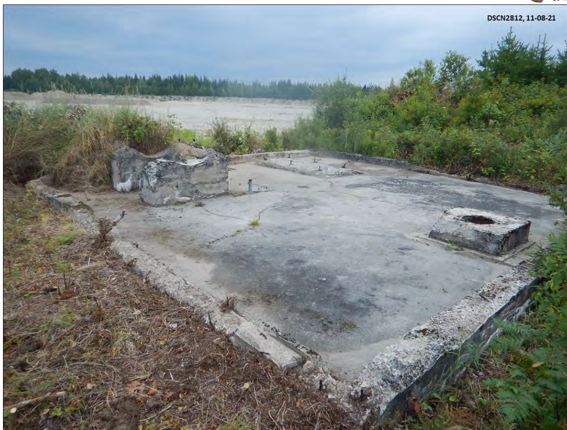
Figure 59 : Fondation de la station de pompage (1E) à la fin des travaux montrant la disposition des ancrages d'équipements, vue vers le nord-ouest. (Source : Subarctique Enr., DSCN2812)
