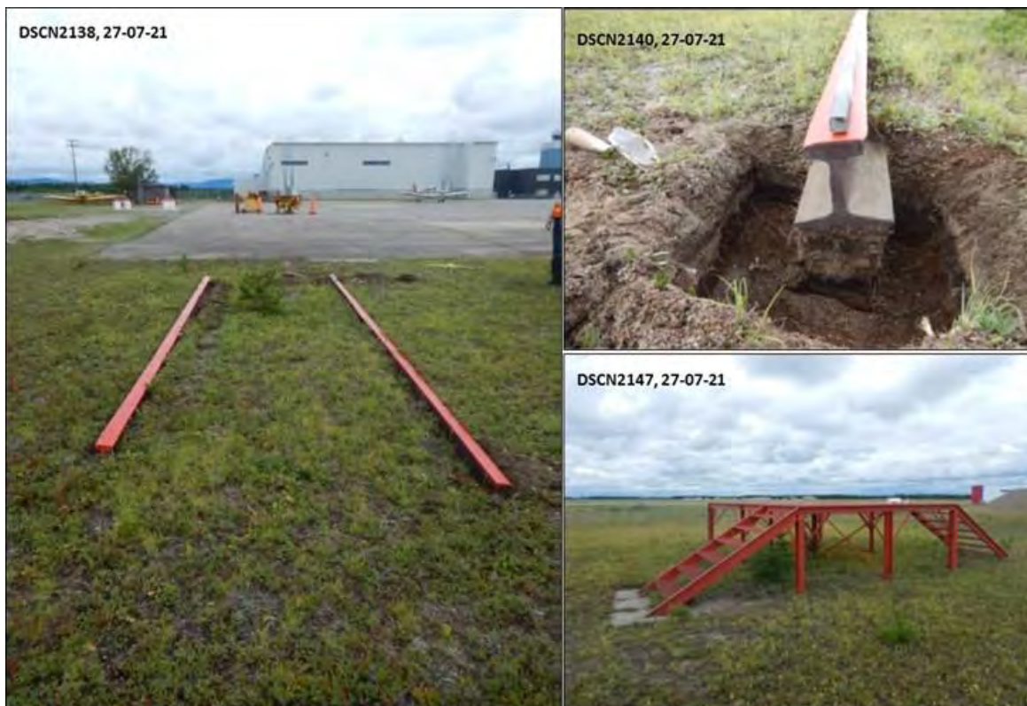
Figure 79 : Rails d'atterrissage d'hélicoptère, vue en surface et de profil, et la plateforme d'hélicoptère à proximité. (Source : Subarctique Enr., DSCN2138, DSCN2149, DSCN2147)
