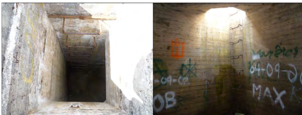
Figure 62 : Vue d'une cheminée d'aération servant d'accès aux réservoirs. (Source : Collection Dany Gauthier, Directeur de l'aéroport, P1020265 et P1020267), transmises le 2021-07-30)
