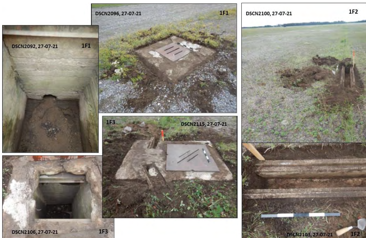
Figure 77 : Puisards et drains types du réseau de drainage de la piste est. (Source : Subarctique Enr., DSCN2092 (1F1), DSCN2096 (1F1), DSCN2100 (1F2), DSCN2115 (1F3), DSCN2106 (1F3))
