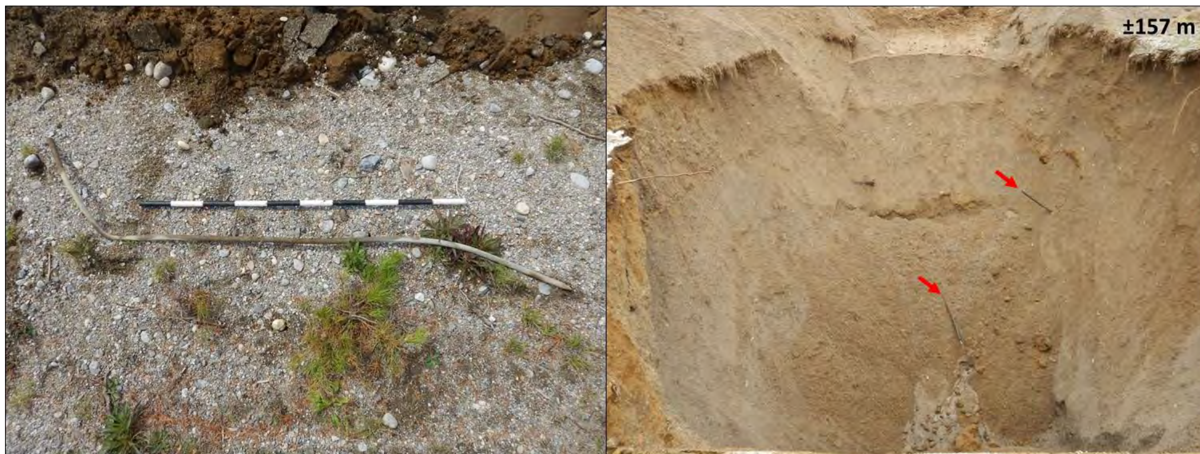
Figure 67 : Tige de mise à terre et tuyau d'eau en cuivre mis au jour dans la tranchée TR-14-20, vue vers l'est. (Sources : Subarctique Enr., DSCN1172 et DSCN1179, 2020-08-05)
