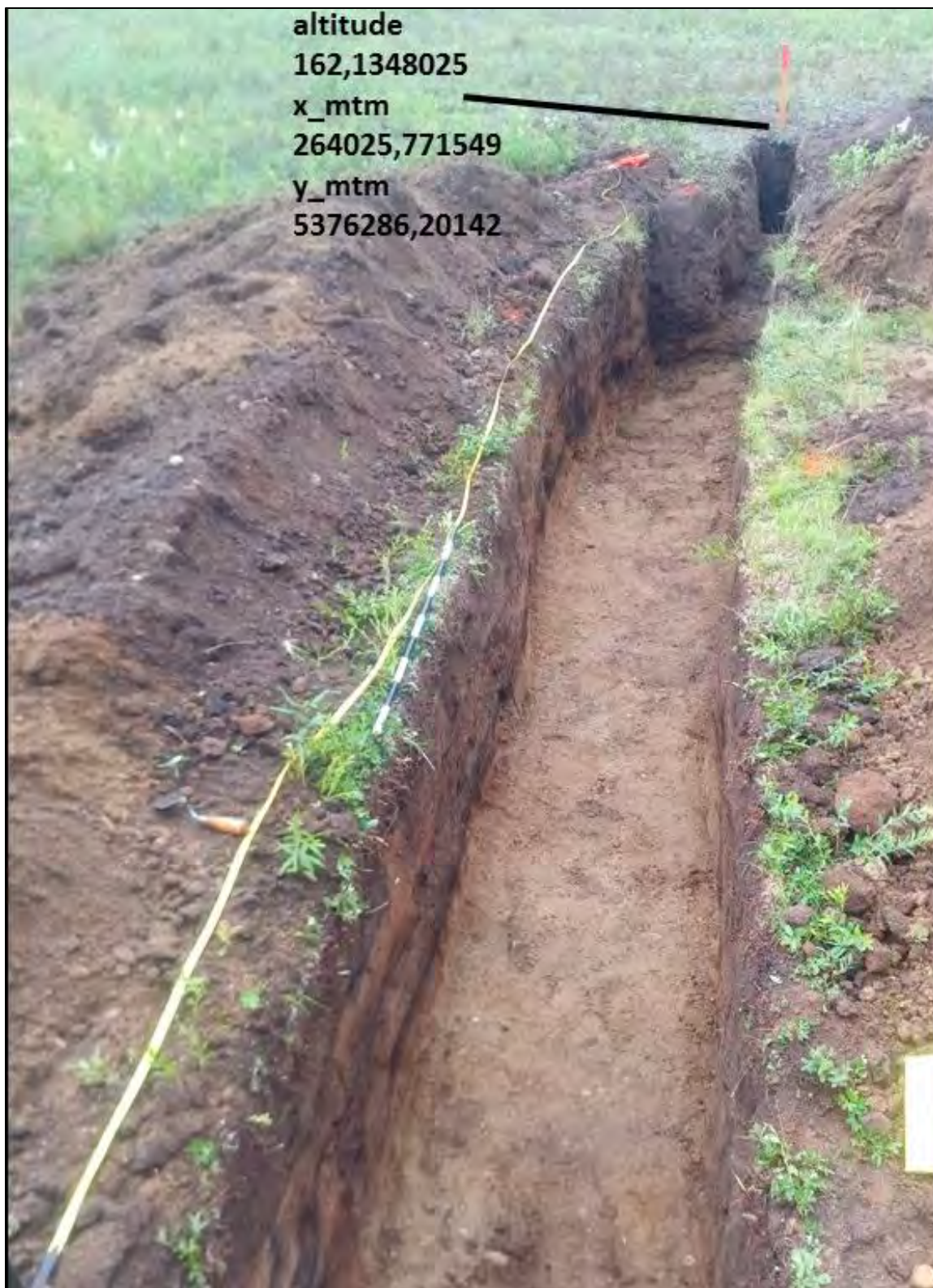
Figure 81 : Tranchée mécanique ouest, vue vers l'est (4B). (Source : Subarctique Enr. , 20200811195459209 et DSCN3223, 2020-08-13)
