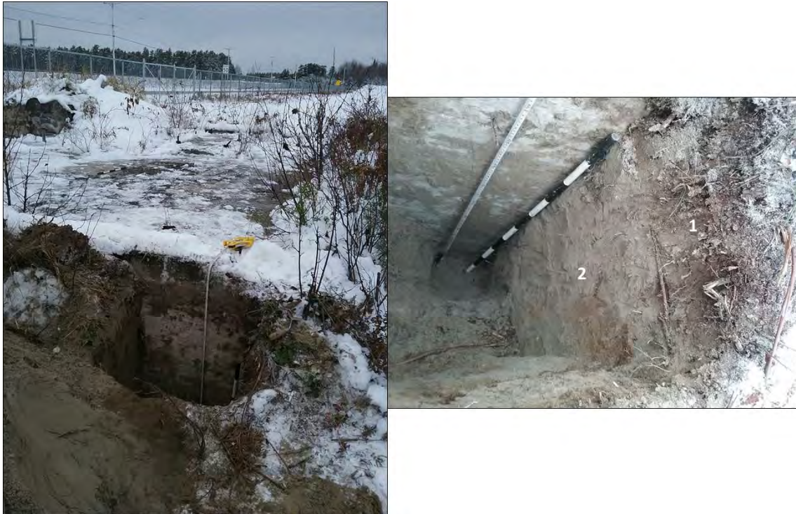
Figure 56 : Sondage 2 en bordure de la fondation de la station de pompage, vers le nord-ouest. (Subarctique Enr., 1603896164914 et 1603895191144, 2020-10-28)
