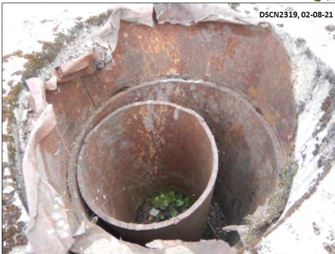
Figure 60 : Détail de l'entrée d'eau en provenance des réservoirs. (Source : Subarctique Enr., DSCN2319)
