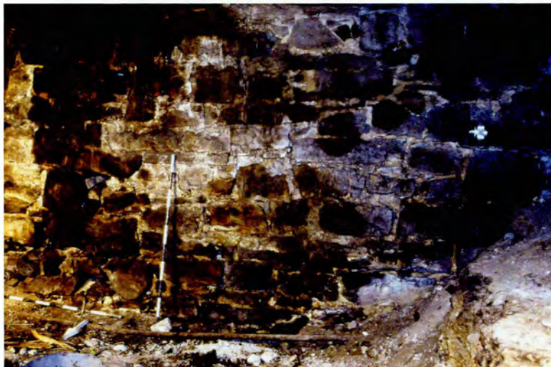
Photo 8 : Bâtiment Robert-Gillespie (I) – Portion ouest du mur sud des fondations. Assises irrégulières assemblées de pierres calcaires (BjFj-101-04-D3-27)
