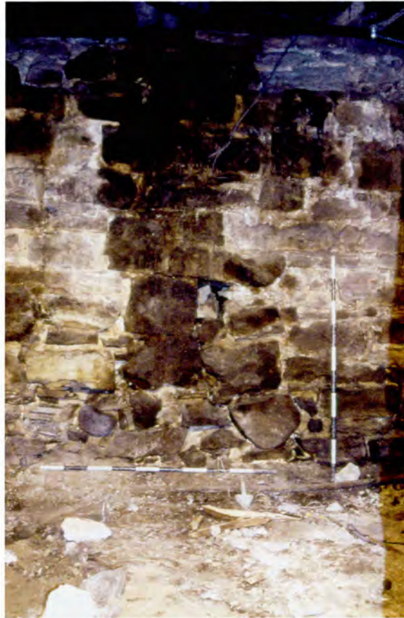
Photo 7 : Bâtiment Robert-Gillespie (I) – Portion ouest du mur sud des fondations. Détail de la césure des appareils des portions centrales et ouest des fondations (BjFj-101-04-D3-30)
