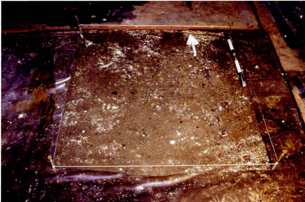
Photo 11 : Bâtiment Robert-Gillespie (I) – Sondage 6D, surface du plancher de béton sous les panneaux d'agglomérés de bois et les feuilles de polyéthylène — Vue vers le nord (BjFj-101-04-D1-08).
