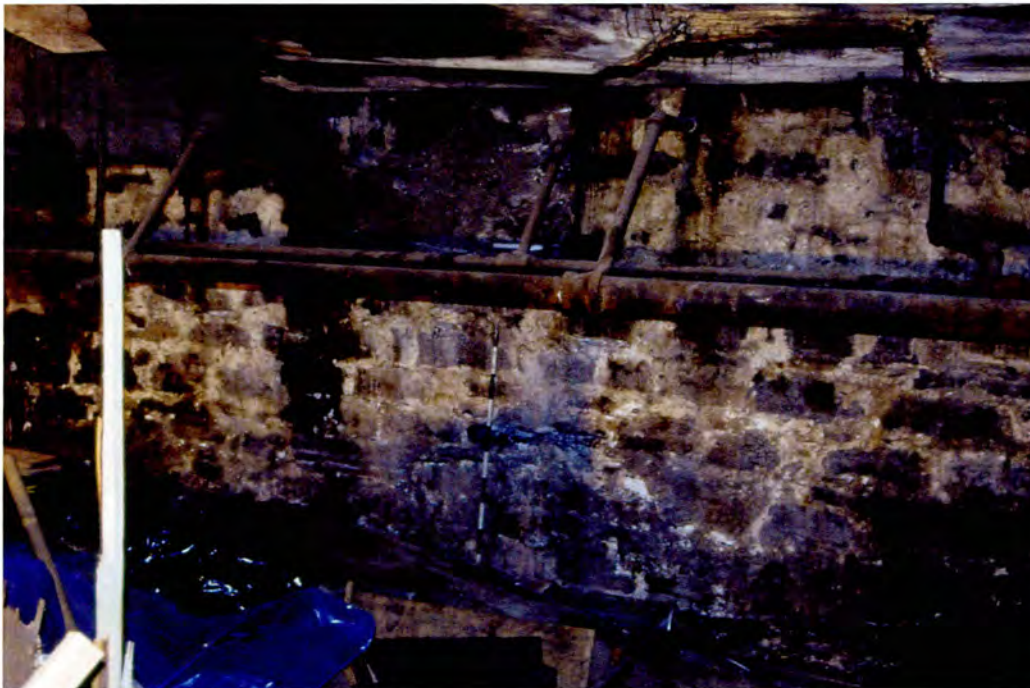
Photo 2 : Bâtiment Robert-Gillespie (I) – Portion nord du mur ouest des fondations. Présence d'un soubirail comblé de débris dans la partie supérieure de la maçonnerie (BjFj-101-04-D3-18)
