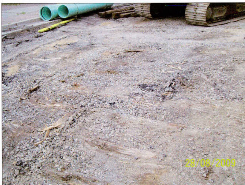
Photo 4.32 Traverses de tramway mis au jour par l'équipe d'Excavation Loiselle directement sous l'asphalte de la rue Principale, en face du centre culturel du vieux Aylmer.
