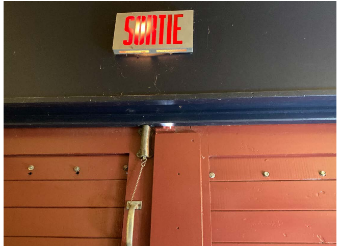
Figure 89 : Les portes d'issues sont surmontées de panneaux de sortie lumineux.
