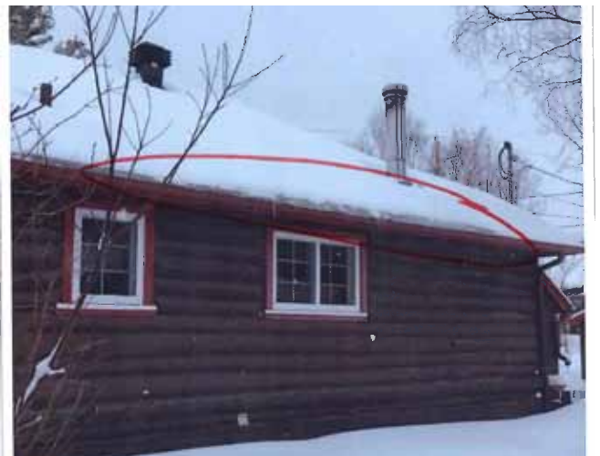
Figure 51 : Formation de petites digues de glace sur le versant latéral nord du 61, rue Marineau en mars 2022. Photographie transmise par la ville de Val-d'Or.
