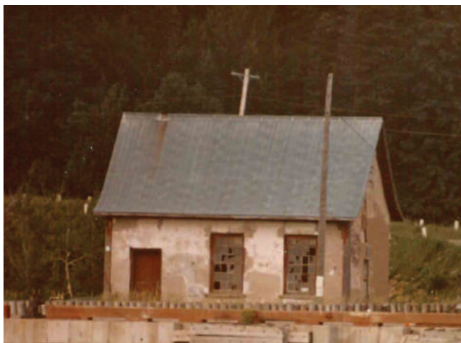
Figure 35 : En 1980, avant les travaux de restauration, certains verres des fenêtres sont cassés ou absent. Collection du SHNP. 1960-1970.
