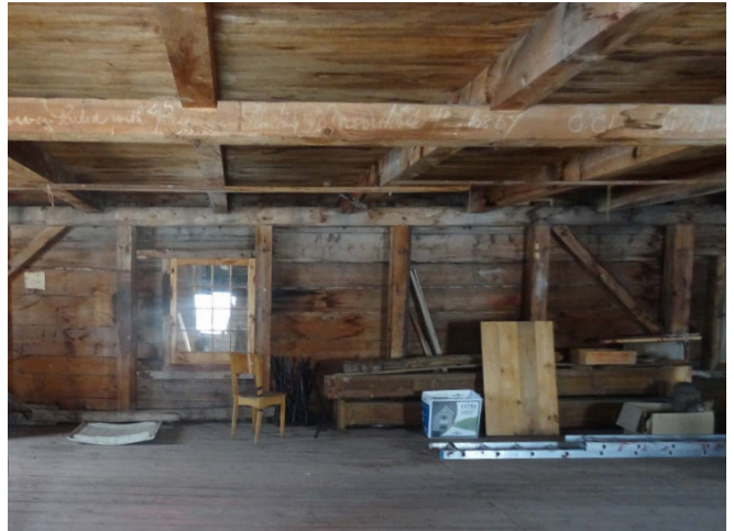
Figure 33 : La structure des murs du volume principal et de l'appentis est composée de poutres et de colonnes de bois contreventées par des pièces de bois posées à la diagonale.
