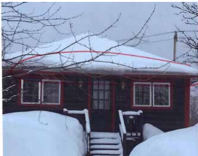
Figure 38 : Maison de type E. 138, avenue Perrault. Accumulation de neige sur le versant nord en mars 2002. Photographie transmise par la ville de Val-d'Or.
