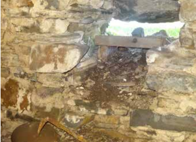
Fig. 9 : Les pierres sont parfois dissociées laissant des ouvertures entre l'extérieur et le vide sanitaire.
