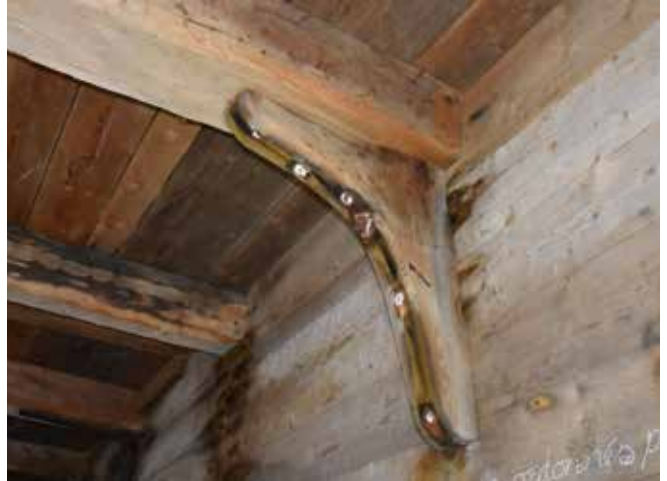
Figure 35 : À quelques endroits, particulièrement dans la pièce située au rez-de-chaussée dans le coin nord-est, les ancrages des consoles sont complètement corrodés.
