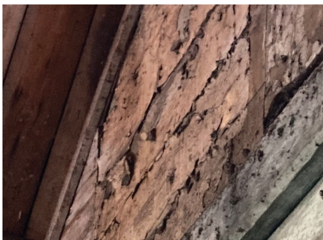
Figure 36 : Des journaux ont été collés dans la partie supérieure du mur pignon de la façade sud.
