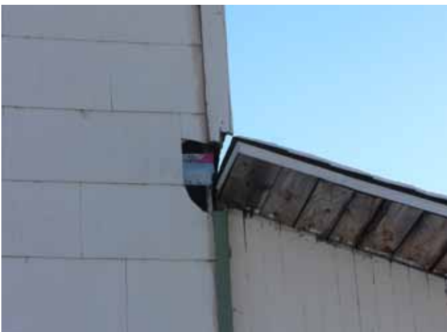
Figure 71 : La jonction entre la toiture de la véranda et la façade avant sud est inadéquate. Un trou important dans le revêtement permet à l'eau des précipitations et à la neige qui peut s'accumuler sur la toiture de la véranda, qui n'est pas chauffée, de s'infiltrer à l'intérieur de la structure des murs.
