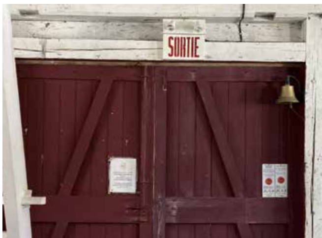
Figure 44 : La porte d'issue est surmontée d'un panneau de sortie lumineux.
