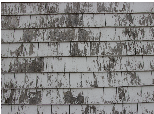
Figure 20 : Les murs extérieurs sont revêtus de bardeaux de cèdre. En 2005, les bardeaux ont été peints. La peinture est très écaillée et le bois est, à divers endroits, laissé à nu.
