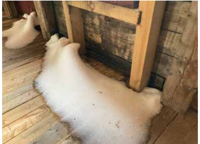
Figure 84 : Du côté intérieur, de la neige s'infiltré par certaines fenêtres.
