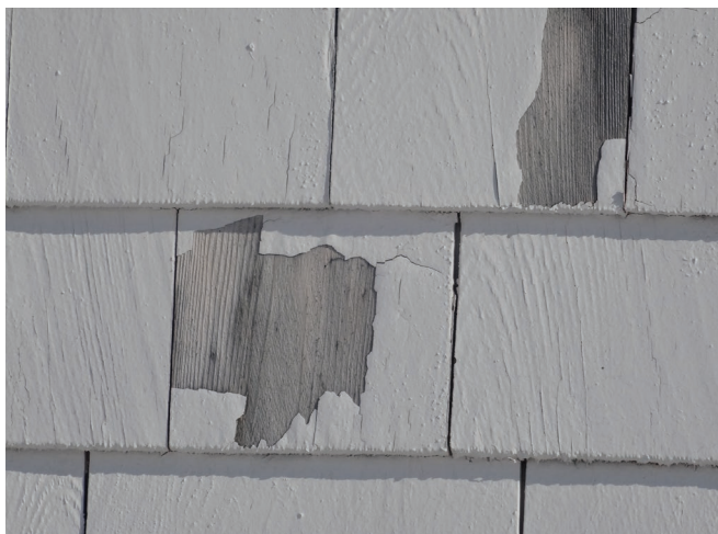
Figure 29 : La peinture est en mauvais état.
