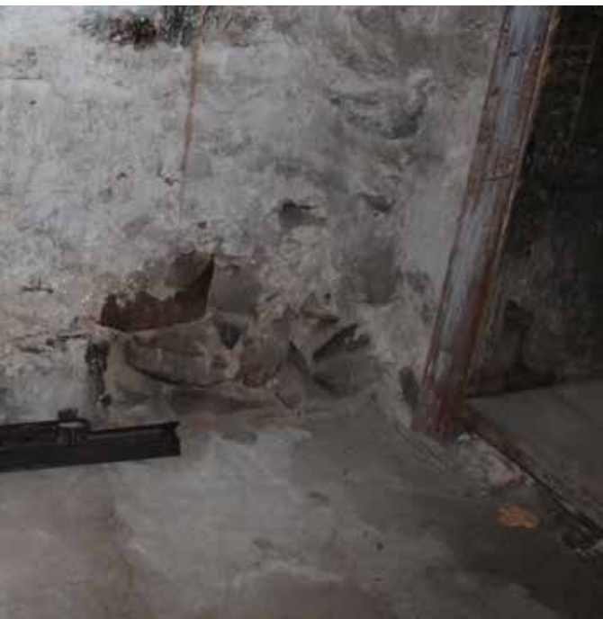
Fig. 17 : Dans la partie centrale du sous-sol, des cernes sur la dalle de béton de même que des traces d'efflorescence sont signes de la présence d'humidité dans le sous-sol.
