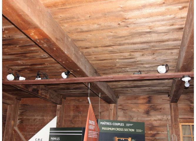
Figure 89 : Des projecteurs sont installés sur la structure de bois.
