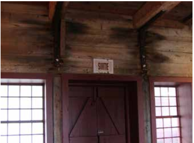
Figure 36 : Certaines consoles de bois ont été remplacées par des consoles en acier qui sont corrodées.
