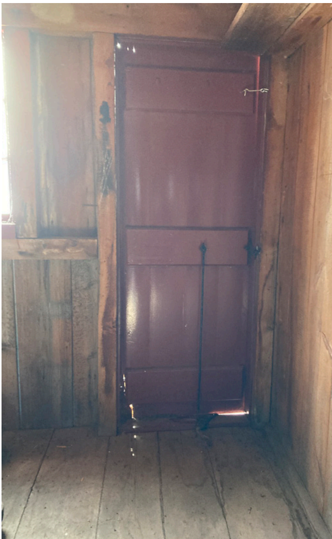
Figure 44 : Les portes ne sont pas étanches et laissent passer la neige.
