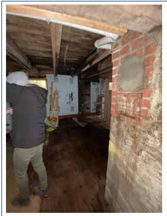
PHOTO 15 : Sous-sol. Le plancher semble mouillé.
