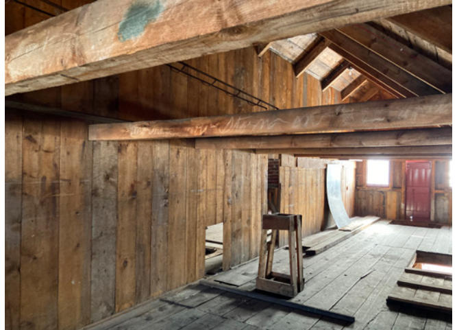
Figure 25 : Des graffitis sont visibles sur les faux entrails.
