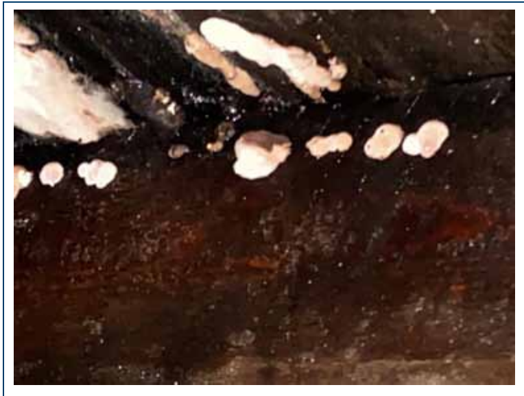
PHOTO 16 : Sous-sol. Présence de champignons au plafond.
