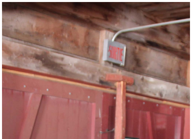
Figure 83 : Les portes d'issues sont surmontées de panneaux de sortie lumineux.
