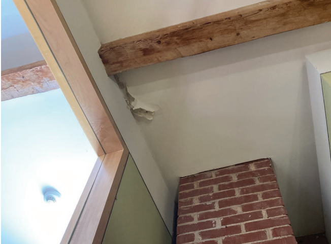
Figure 62 : La cheminée est apparente depuis l'étage. Du côté intérieur, des fissures sont visibles dans le plafond de gypse autour de la cheminée.
