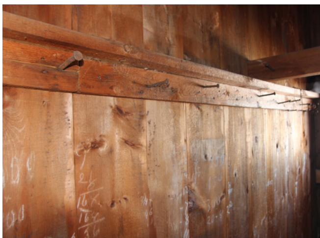
Figure 70 : Des clous sont installés dans la cloison pour accrocher des vêtements.
