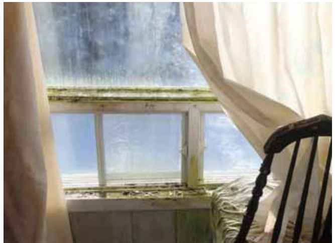
Figure 77 : Une ouverture du côté gauche à l'étage de la façade arrière est aussi plus large que la fenêtre type avec ses deux guichets. Dans l'ensemble, les cadres de fenêtres sont dégradés.
