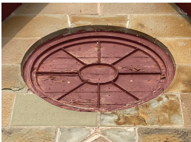
Figure 25 : Le bois de l'oculus est fissuré et la peinture s'écaille, notamment au bas de l'ouverture.
