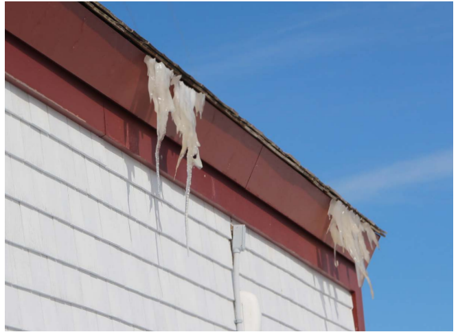
Figure 79 : En hiver, la toiture de la cookroom condense et de grands glaçons se forment du côté sud-est du bâtiment.
