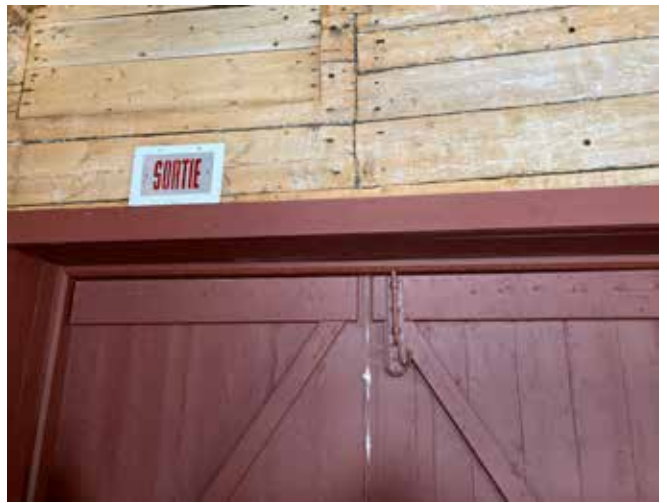
Figure 112 : Les portes d'issues sont surmontées de panneaux de sortie lumineux.
