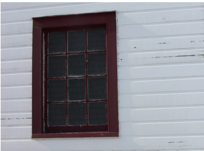
Figure 33 : Les fenêtres sont généralement en bon état, bien que la peinture s'écaille par endroits.
