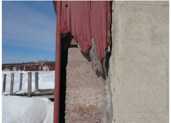
Figure 31 : Certaines planches cornières sont pourries et doivent être remplacées.
