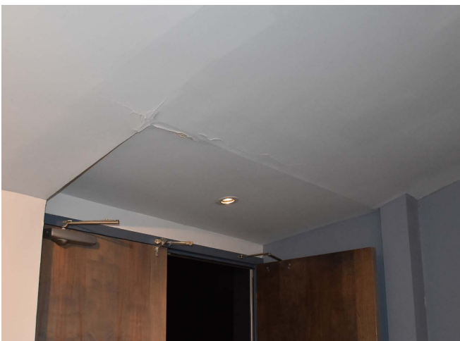
Figure 108 : Dans la salle de rencontre, les finis de gypse au plafond sont fissurés.
