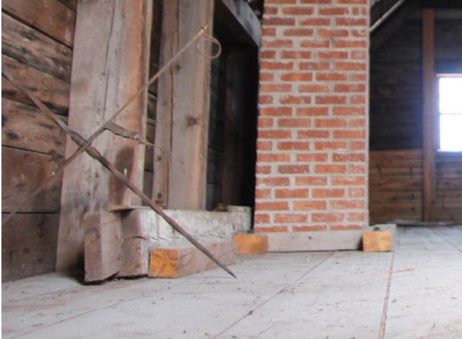
Figure 48 : Le plancher de l'étage est en planches de bois nu. Les planchers sont probablement d'origine. Ils sont en bon état.
