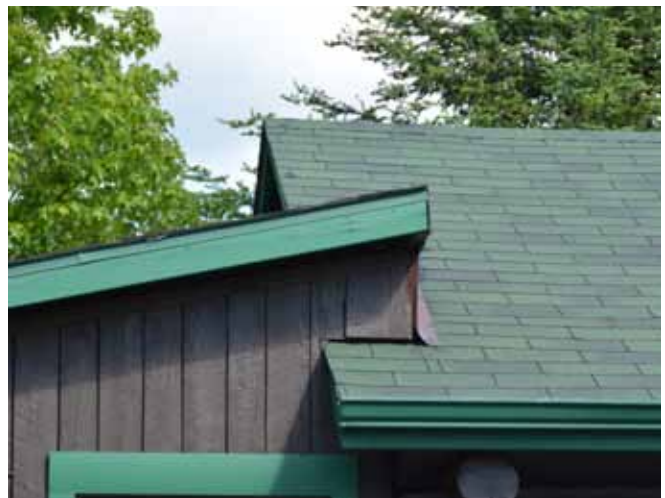
Figure 84 : La résidence a été modifiée de façon importante notamment par le surhaussement de la toiture de l'annexe.
