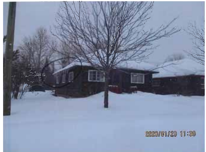
Figure 29 : Importante accumulation de neige et formation de digues de glace sur le versant ouest de la toiture du 116, avenue Perrault en janvier 2020. Photographie transmise par la ville de Val-d'Or.
