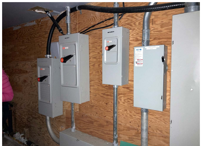
Figure 123 : Les panneaux électriques sont situés dans le volume principal sous l'espace technique. Ces panneaux contrôlent l'électricité des bâtiments environnants.
