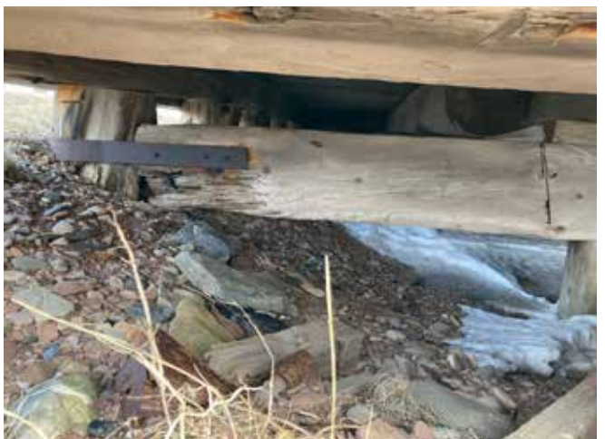
Figure 29 : Certaines poutres semblent s'affaisser particulièrement au coin nord-ouest du bâtiment entraînant un affaissement sur l'ensemble des étages du bâtiment.
