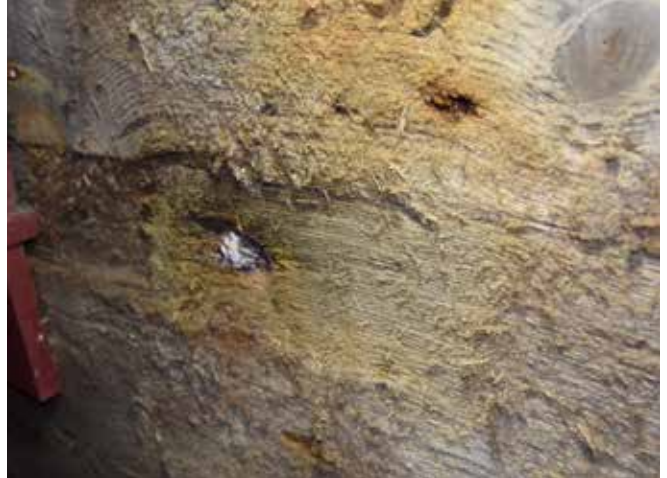
Figure 71 : À l'intérieur, dans la pièce située au nord-est du bâtiment, plusieurs planches présentent de premières formes de pourriture, soit un bois défibré en surface et humide.
