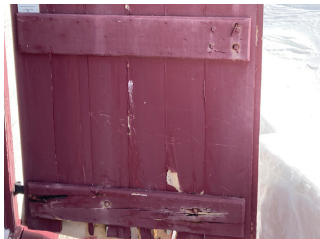
Figure 39 : La peinture s'écaille sur les portes et la porte principale et les portes de chargement sont pourries par endroit.
