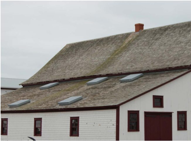
Figure 76 : Le revêtement de bardeaux, généralement en bon état, est aussi recouvert partiellement de mousse.
