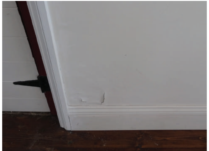
Figure 60 : À quelques endroits, les plâtres sont fissurés.
