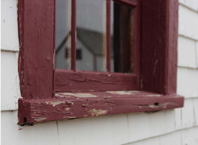
Figure 58 : Les fenêtres sont en bon état, mais les fenêtres, tablettes et cadres doivent être peints et restaurés.
