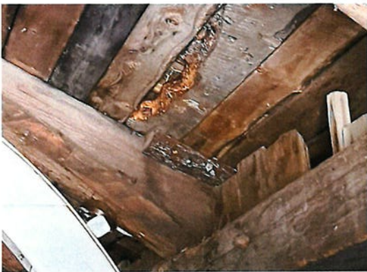
Photo #22 INTERVENTION #4 La structure sur la façade de gauche a travaillé au fil des années, ce qui a fait rondir la toiture. Prévoir stabiliser le tout et corriger si possible.
