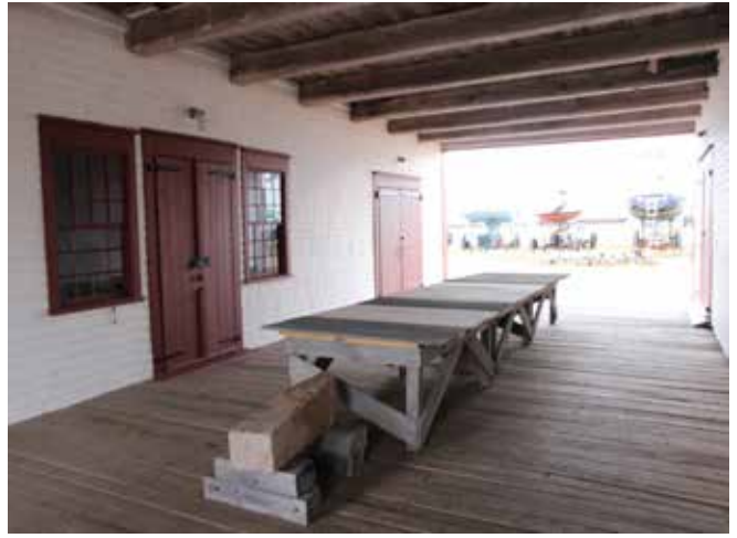
Figure 51 : Le plancher du corridor est construit de bois laissé à nu qui est généralement en très bon état. Le plancher est protégé par le toit du corridor qui le protège des intempéries.
