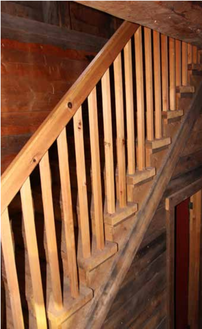
Figure 123 : Une cage d'escalier d'issue a été ajoutée sur le coin sud-est du bâtiment.
