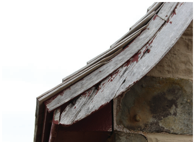
Figure 32 : Le toit est muni de débords latéraux et d'un avant-toit incurvé. La peinture de la couleur Rouge Navajo 4076-85 de la compagnie SICO est en mauvais état.
