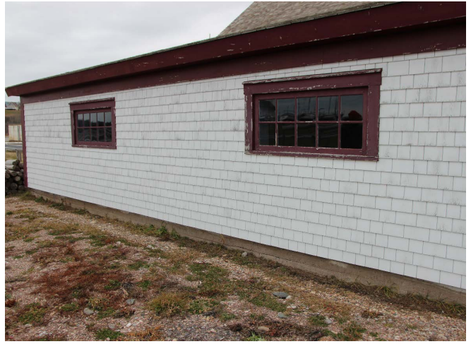
Figure 15 : Les fondations sont peu visibles de l'extérieur, mais semblent en bon état.
