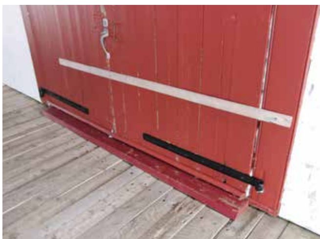
Figure 97 : L'une des portes est condamnée puisque sa quincaillerie est en mauvais état.
