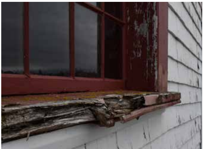
Figure 78 : Des tablettes de fenêtres sont pourries.
