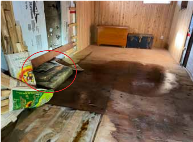
Figure 13 : Les planchers du sous-sol étaient mouillés au moment de la visite d'expertise vis-à-vis l'appentis contigu à la façade arrière, dont l'emplacement est indiqué par la présence d'un petit embranchement.
