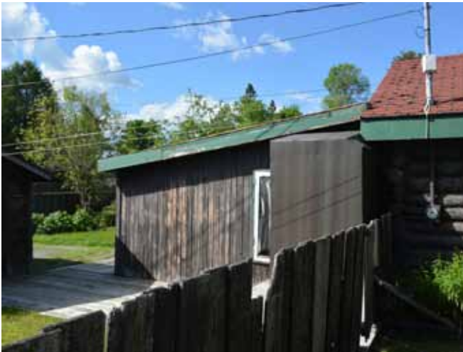
Figure 88 : Le revêtement extérieur de la maison est très dégradé. La peinture est largement écaillée sur le revêtement en planches de l'annexe.
