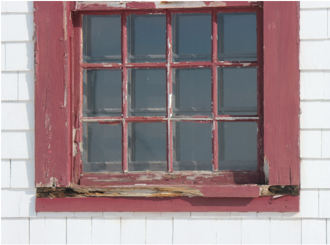
Figure 37 : Certaines tablettes sont complètement pourries notamment sur la façade ouest.
