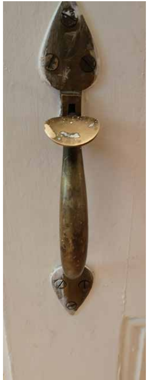
Fig. 82 : Plusieurs quincailleries des portes semblent d'origine.
