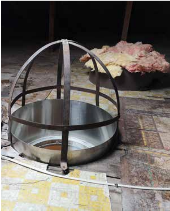
Fig. 73 : L'hiver, de la laine minérale en matelas est utilisée pour couvrir les puits de lumière du plancher de l'entretoit.
