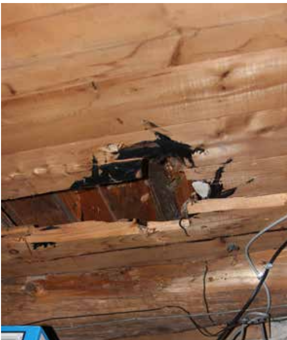
Fig. 21 : À certains endroits au sous-sol, la structure d'origine du plancher est dissimulée derrière un plafond en lattes de bois.
