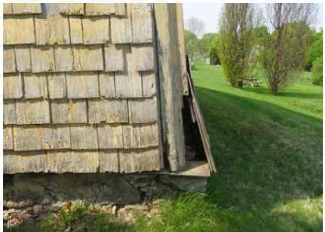
Fig. 41 : La peinture s'écaille à plusieurs endroits. Certaines planches cornières sont très abîmées à la base.
