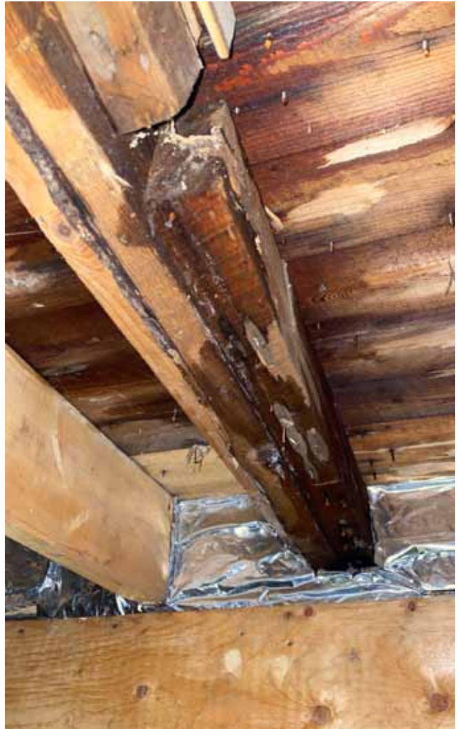
Figure 28 : Des cernes sont apparents sur les poutres à plusieurs endroits au sous-sol, ce qui témoigne d'infiltrations d'eau à travers le plancher.
