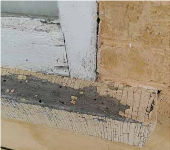
Fig. 52 : La peinture des contre-fenêtres et des tablettes des fenêtres extérieures du rez-de-chaussée est écaillée.
