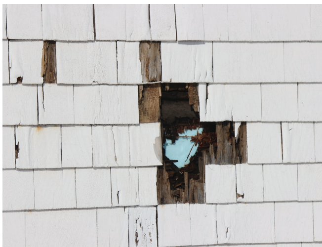
Figure 32 : L'isolant installé derrière les bardeaux est parfois visible là où les bardeaux sont détériorés.
