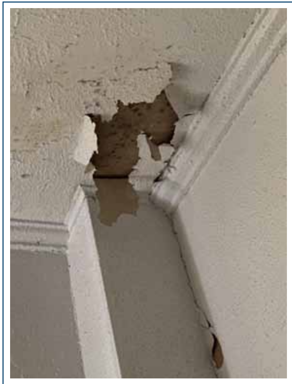
PHOTO 11 : Rez-de-chaussée. Vue sur le plafond affecté par l'eau.
