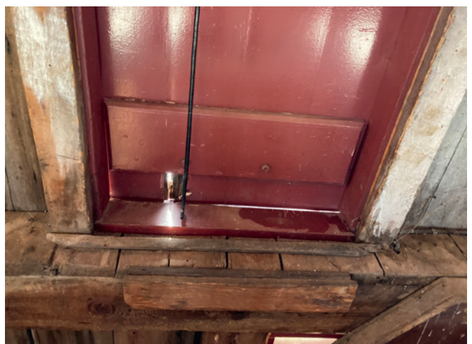
Figure 46 : Les portes ne sont pas étanches et laissent passer la neige.
