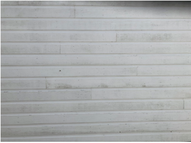
Figure 28 : La peinture sur les planches s'efface, mais les planches sont généralement en bon état.
