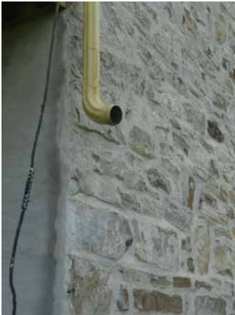
Fig. 75 : Plusieurs descentes de gouttières ne sont pas reliées à un drain de sol ce qui ne favorise pas l'évacuation de l'eau loin des fondations.
