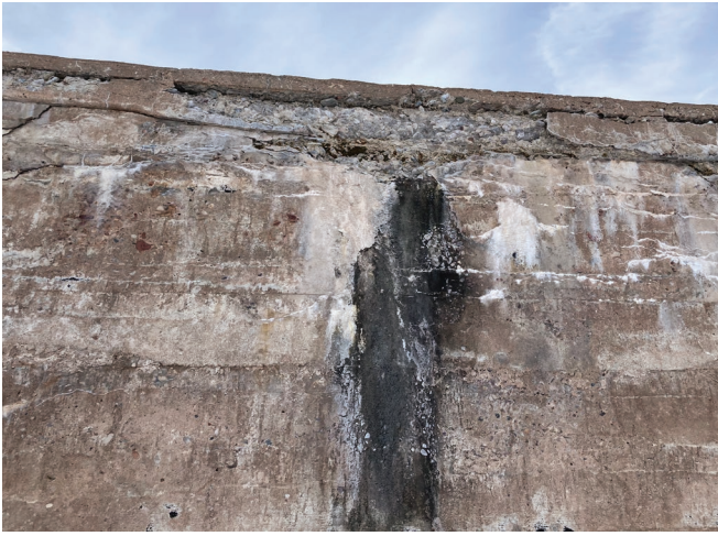
Figure 22 : Des traces d'efflorescence ont été observées au sommet des murs extérieurs.
