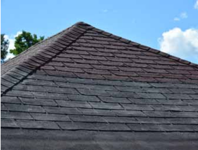
Figure 73 : Les bardeaux sont fendus, brisés, leurs extrémités sont retroussées et des granulats sont manquants.
