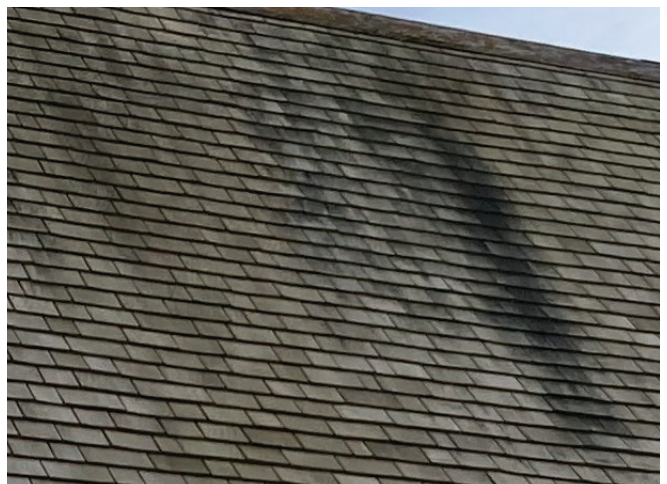
Figure 28 : Les bardeaux sont généralement en bon état. Une marque foncée est visible sur certains bardeaux du versant ouest. Du lichen est présent par endroits sur le revêtement.
