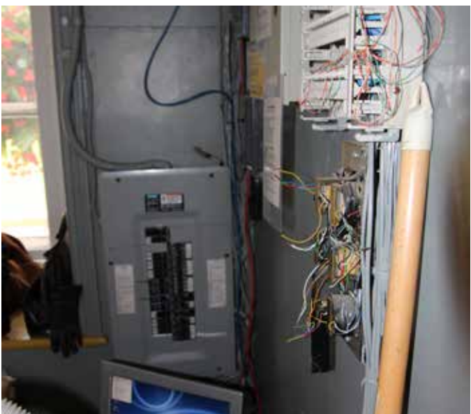
Fig. 118 : Les panneaux électriques sont situés au rez-de-chaussée du côté de la cuisine d'été.
