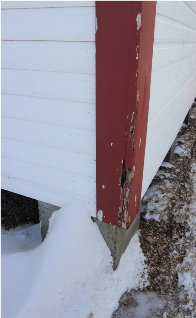
Figure 30 : La peinture est écaillée sur les planches cornières et certaines sections sont pourries.
