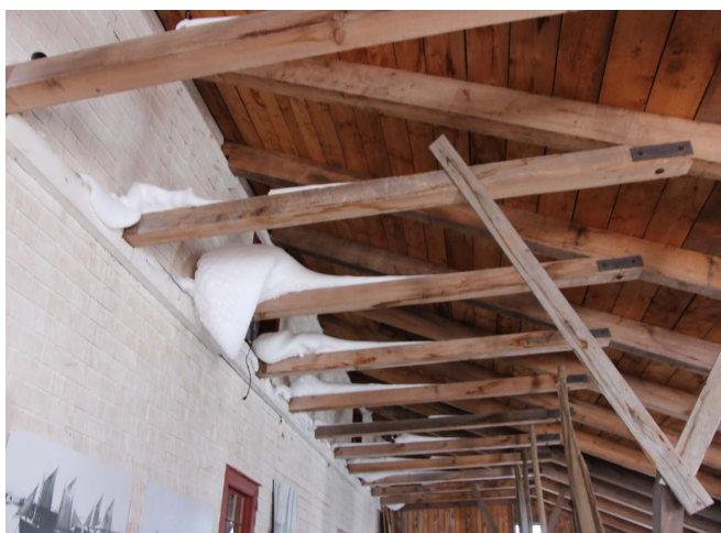
Figure 28 : La charpente de l'appentis est visible depuis l'intérieur et composée d'un platelage de bois déposé sur des chevrons reliés par des entrails.
