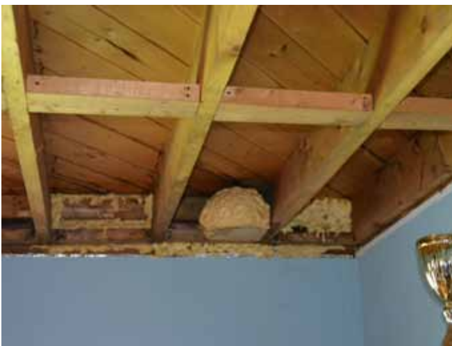
Figure 162 : Les propriétaires ont subi de gros dégâts d'eau à l'intérieur cet hiver qui ont fait tomber le plafond de leur cuisine située dans l'appentis à l'arrière.
