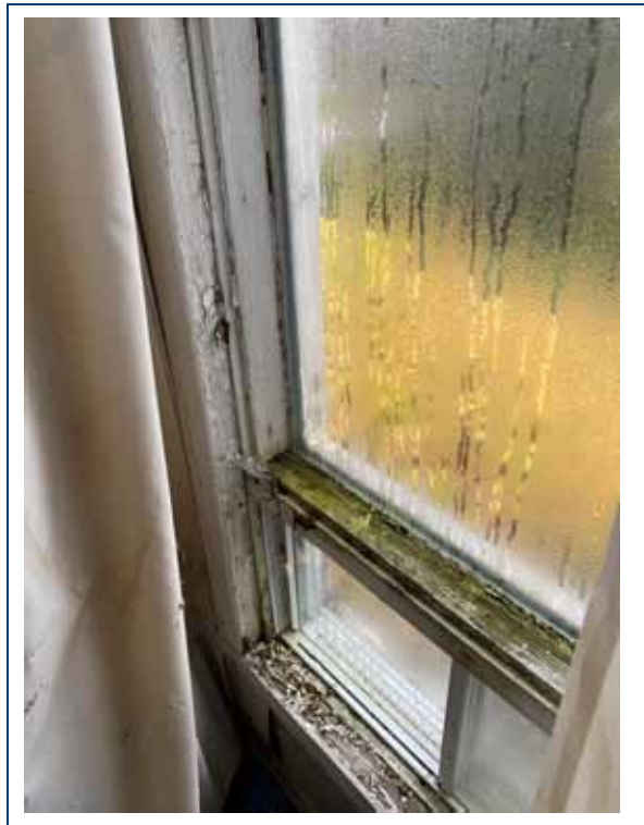
PHOTO 9 : 1 er étage. Présence de condensation dans la vitre de la fenêtre. Le cadre de fenêtre est très détérioré.
