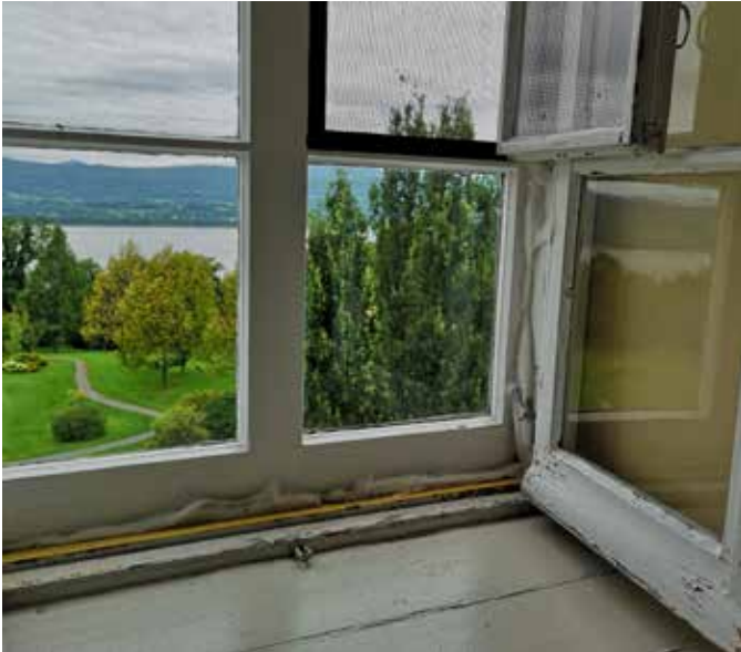
Fig. 58 : À l'étage, de la laine isolante a été insérée autour de plusieurs contre-fenêtres ce qui démontre que les systèmes de fenêtres et de contre-fenêtres ne sont pas optimisés.
