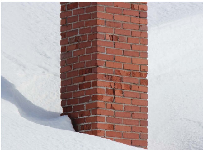
Figure 82 : Plusieurs briques de la cheminée actuelle sont éclatées.
