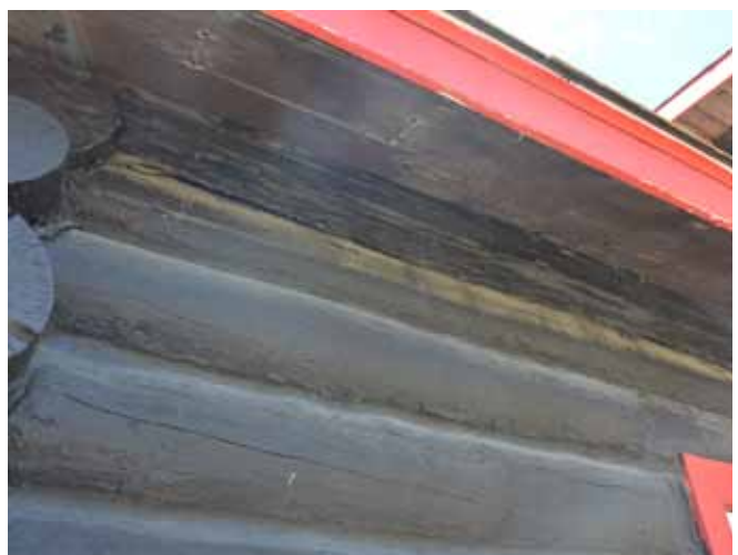
Figure 134 : Un scellant a été grossièrement appliqué sur le sommet des murs en billes de bois, à la jonction avec les larmiers.
