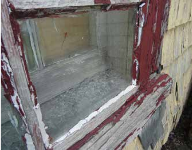
Fig. 28 : Le mastic des fenêtres et contre-fenêtres est en très mauvais état de même que certaines pièces de bois.
