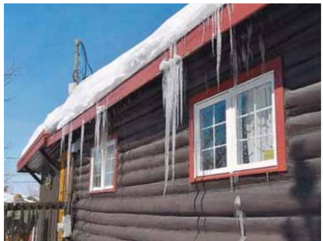
Figure 78 : Dignes de glace formées sur la toiture durant l'hiver 2021-2022. Photographie transmise par le propriétaire à la Ville de Val-d'Or.
