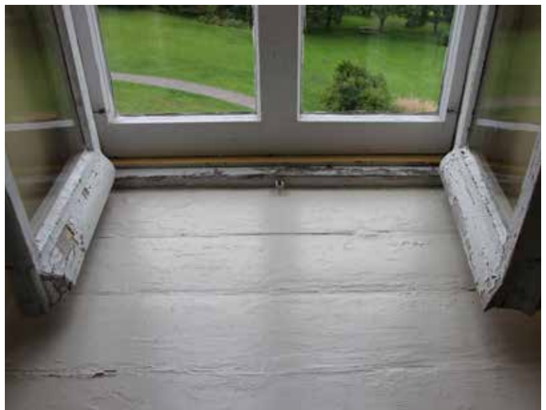
Fig. 57 : La peinture de certaines fenêtres est grandement écaillée.
