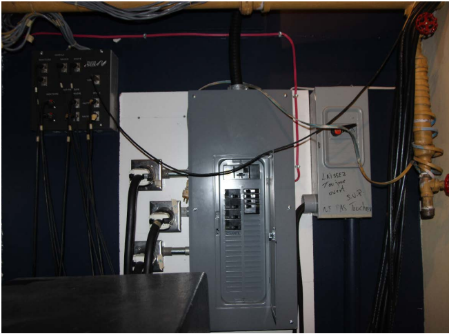
Figure 124 : Des panneaux électriques supplémentaires sont installés dans la loge.
