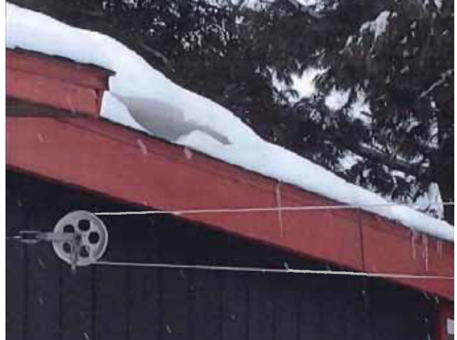
Figure 31 : Accumulation de neige sur la toiture de l'annexe du 131, avenue Perrault à l'hiver 2022. Photographie transmise par la ville de Val-d'Or.
