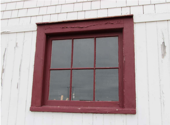
Figure 52 : Sur la façade sud, 5 fenêtres fixes à 6 carreaux et une fenêtre à guillotine à 12 carreaux éclairent le rez-de-chaussée.
