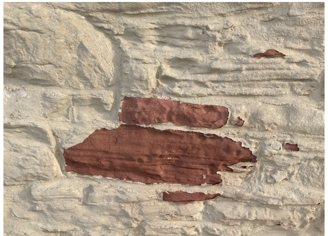
Figure 18 : L'enduit est fissuré à plusieurs endroits laissant ainsi la pierre à nu.
