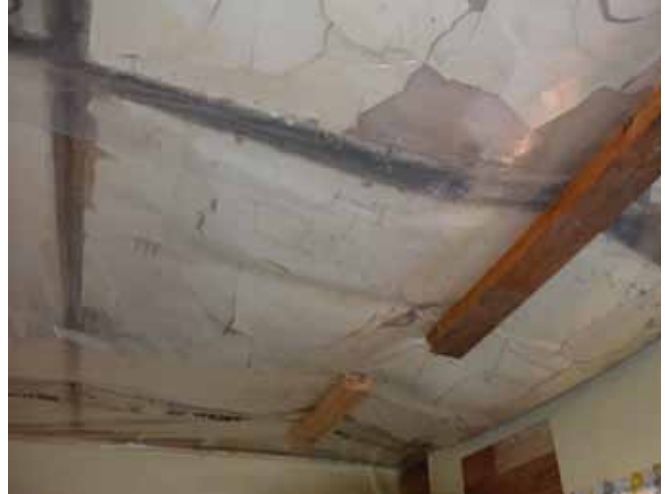
Figure 159 : Les propriétaires ont subi de gros dégâts d'eau à l'intérieur cet hiver qui ont fait tomber le plafond de leur cuisine située dans l'appentis à l'arrière.
