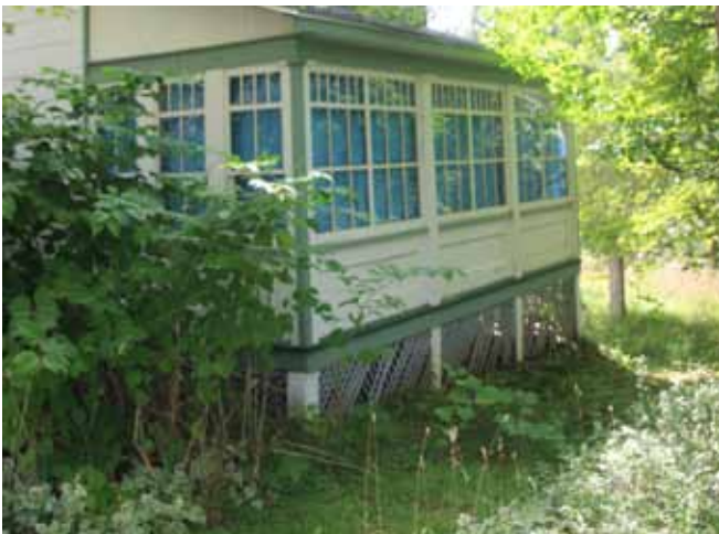
Figure 15 : De l'extérieur, le périmètre de la résidence est entouré de végétation. Cette situation permet à l'eau pluie de stagner à la base des murs.
