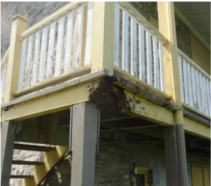
Fig. 30 : Certains éléments structuraux sont pourris, comme le coin nord-est, affectant l'intégrité architecturale des galeries.
