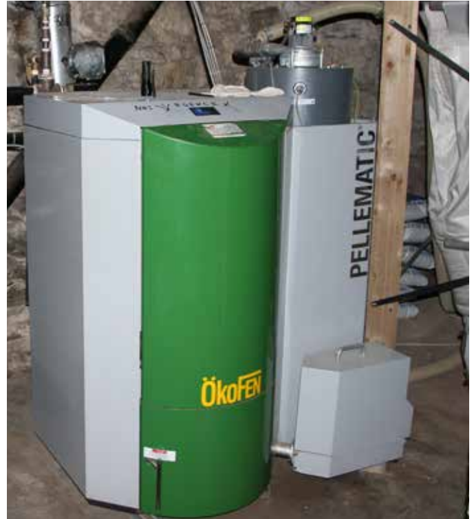
Fig. 111 : L'édifice est entièrement chauffé par une chaudière à granules de bois.
