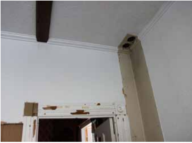
Figure 112 : Au rez-de-chaussée, une ancienne finition de murs en papier texturé est encore visible.
