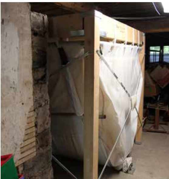
Fig. 111 : Les granules de bois sont entreposées à proximité de la chaudière.
