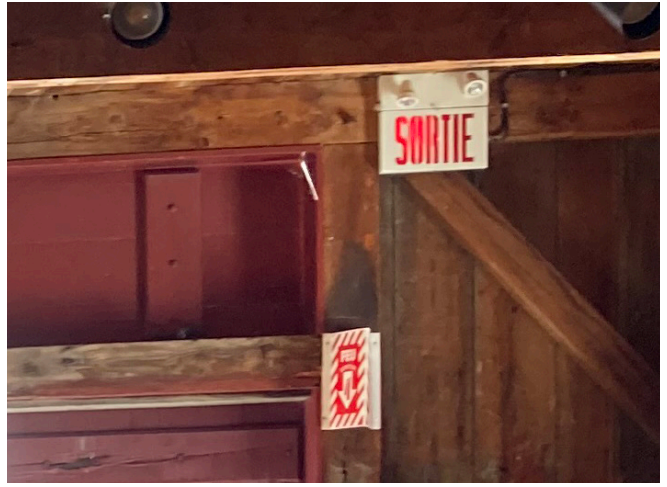
Figure 59 : Les portes d'issues sont surmontées de panneaux de sortie lumineux.
