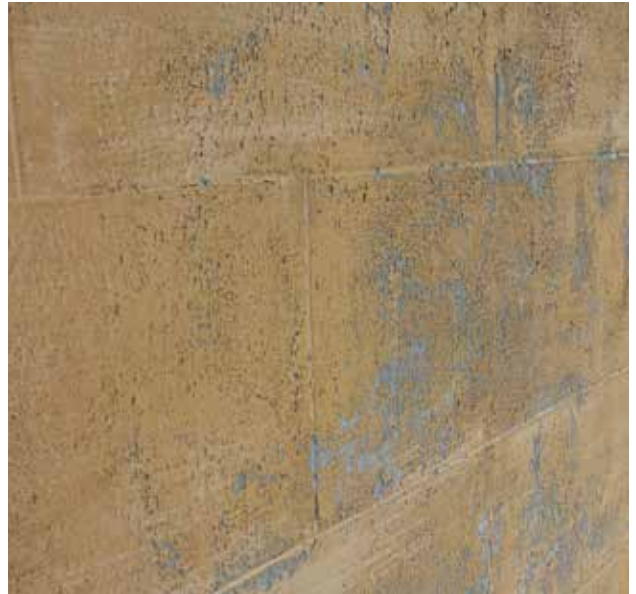
Fig. 47 : L'enduit du rez-de-chaussée imite la pierre de taille. Il est peint jaune mais il était originellement gris pour imiter la pierre.
