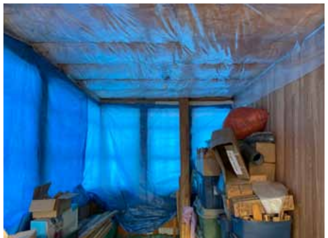
Figure 59 : De grandes bâches sont tendues sous le plafond et devant les fenêtres de la véranda en raison de défauts d'étanchéité.
