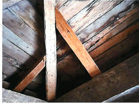
Photo #13 Platelage du toit, nous avons constaté quelques planches pourries à remplacer au bas de la jonction de la noue.
