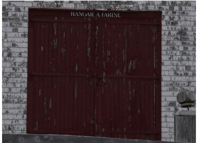
Figure 25 : La porte de grange située sur la façade nord est à double battant en planches de bois peint en rouge. La peinture est écaillée à l'extérieur.
