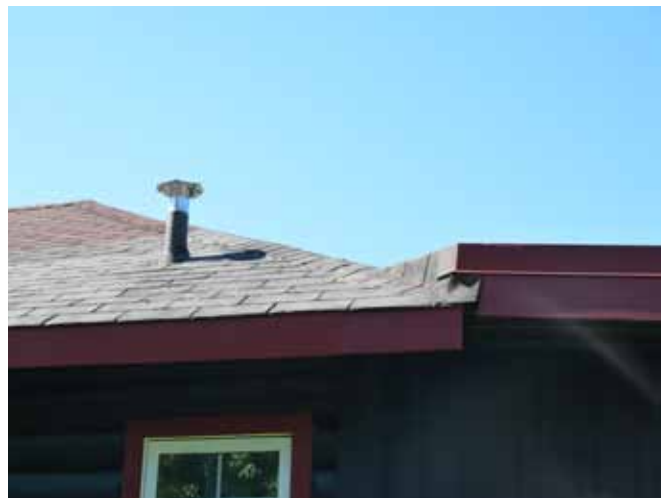
Figure 76 : La toiture a été modifiée pour augmenter la hauteur de l'espace habitable à l'intérieur, faisant en sorte que la toiture de l'annexe dépasse la hauteur de l'égout de la toiture de la maison.
