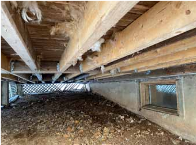
Figure 41 : La structure de plancher de la véranda est constituée d'un platalage reposant sur des solives. Le plancher a été renforcé relativement récemment par l'ajout de solives modernes.
