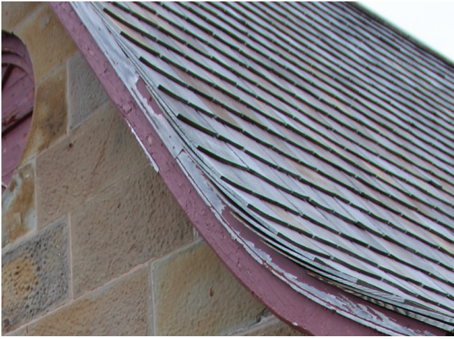
Figure 33 : Le toit est muni de débords latéraux et d'un avant-toit incurvé. La peinture est en mauvais état.
