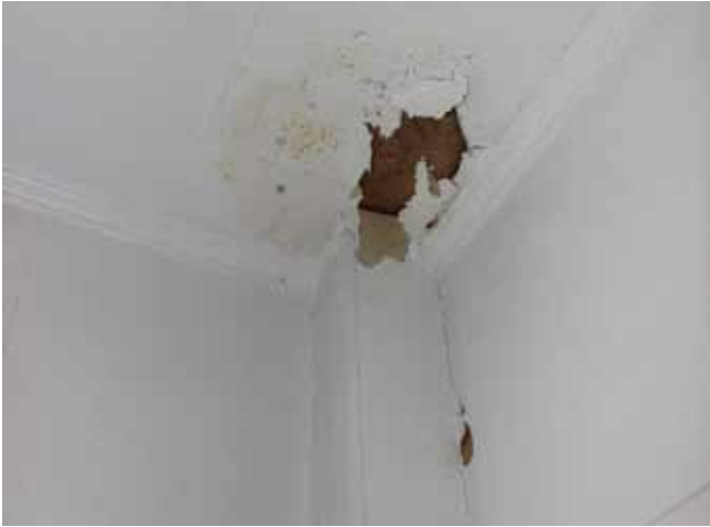
Figure 33 : Là où il y a des infiltrations d'eau depuis longtemps, la structure est attaquée par la moisissure et la pourriture, et ce, depuis plusieurs années.
