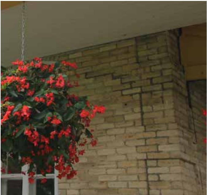
Fig. 42: Certains joints de maçonnerie ont été rejointoyés. La couleur du mortier de rejointoiment n'est pas la même que le mortier d'origine.
