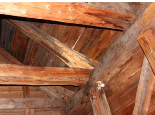
Figure 56 : Des traces d'infiltration d'eau sont visibles sur la face intérieure du platelage de la toiture. Ces infiltrations ne semblent toutefois plus actives.
