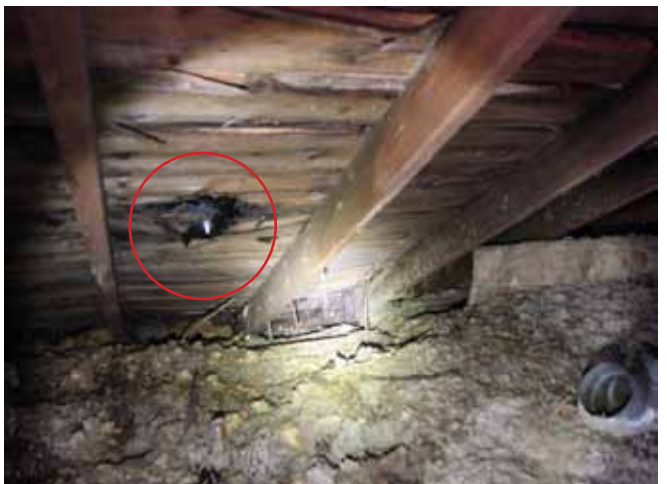
Figure 53 : Un trou dans le platalage a été observé dans l'entretoit. Il s'agit probablement du passage d'un ancien conduit.
