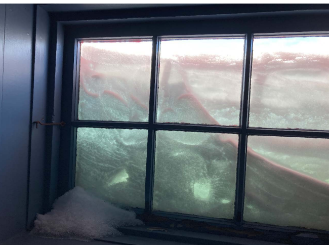
Figure 52 : L'hiver, la neige s'accumule devant les fenêtres accélérant la dégradation de celles-ci.
