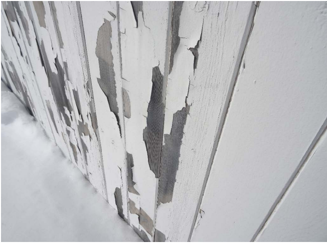
Figure 38 : La façade ouest de l'appentis, et la partie basse de la façade sud du volume principal sont recouverts de planches verticales. La peinture sur les planches s'écaille.
