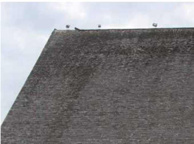
Figure 106 : La planche faîtière est en mauvais état. Le revêtement de bardeaux de cèdre est généralement en bon état. Quelques bardeaux sont retroussés.
