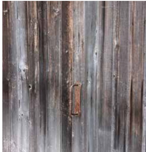
Fig. 31 : La quincaillerie de ces portes est en très mauvais état.
