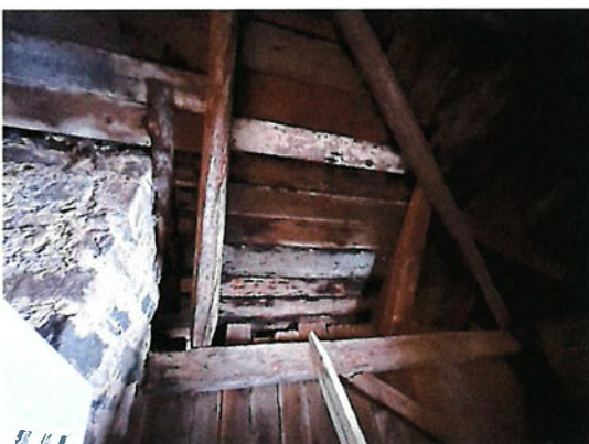
Photo #16 INTERVENTION #2 Platelage du toit, nous avons constaté quelques planches pourries à remplacer dû à une infiltration d'eau près de la cheminée. Prévoir ragréer le pourtour de la cheminée.
