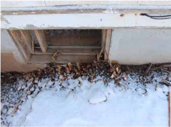
Figure 11 : On retrouve également à cet endroit un sopirail fermé par une fenêtre dont la base est vis-à-vis le niveau du sol
