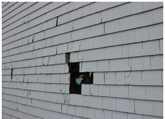
Figure 28 : La peinture est en mauvais état. Plusieurs bardeaux sont pourris et doivent être remplacés
