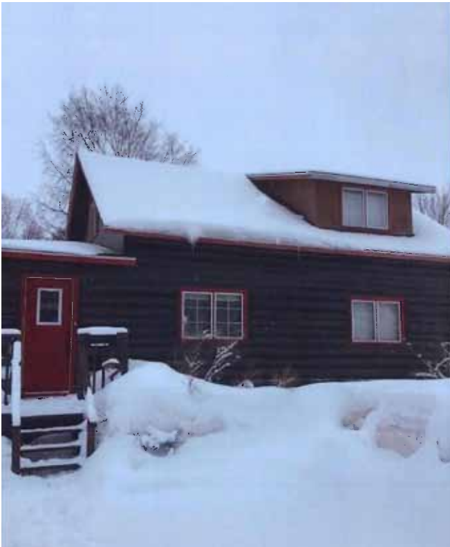
Figure 172 : Formation de digues de glace importantes sur le versant ouest de la toiture en mars 2022, surtout sur la moitié arrière, là où se sont produites les infiltrations d'eau. Photographie transmise par la ville de Val-d'Or.
