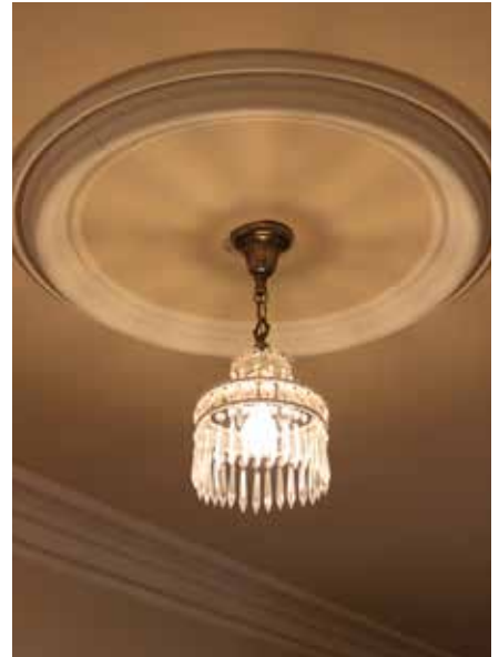
Fig. 122 : L'éclairage intérieur du bâtiment est assuré par des luminaires.
