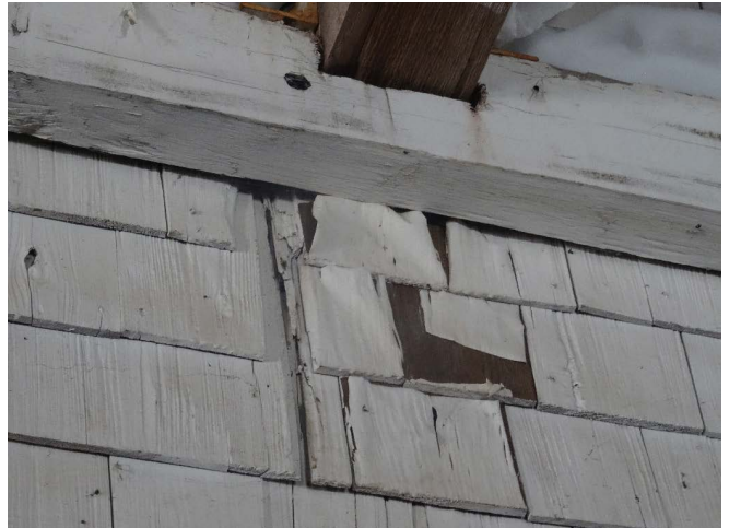
Figure 41 : Quelques bardeaux sont tout de même à remplacer.
