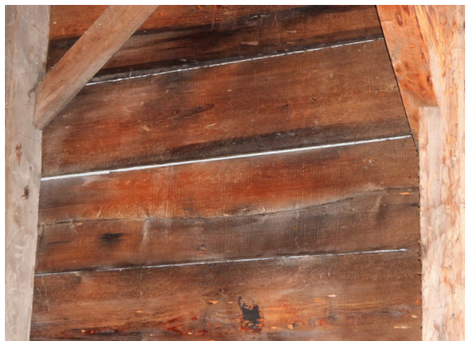
Figure 45 : Lors du remplacement, une membrane pare-air, visible entre les planches intérieures, a été installée sous les bardeaux.
