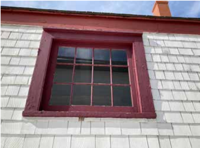
Figure 30 : Quatre fenêtres à douze carreaux sont situées sur la façade ouest. Elles sont en bon état, bien que la peinture commence à s'écailler par endroits.
