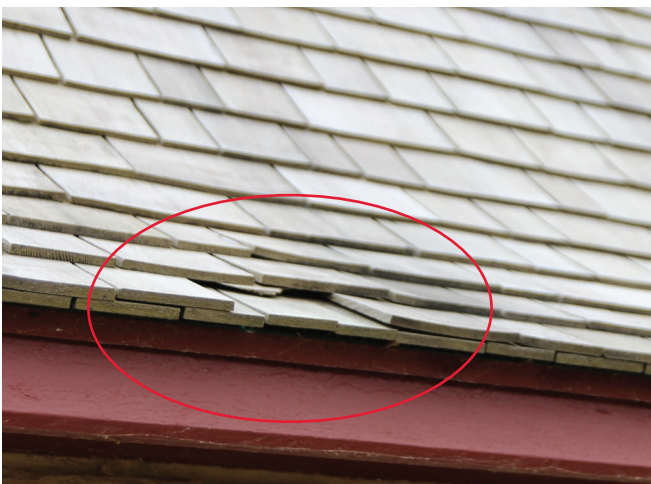
Figure 31 : Un bardeau est tombé dans le bas du versant ouest. Autrement, le revêtement est en très bon état.
