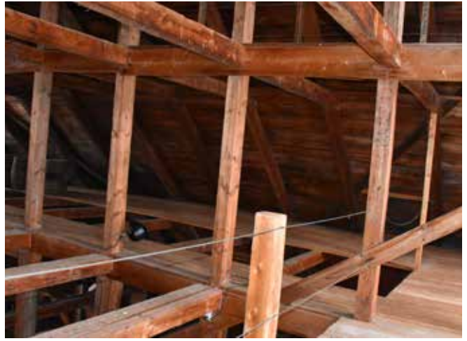
Figure 111 : À l'étage du bâtiment, des câbles métalliques sont fixés sur la structure de bois pour protéger les utilisateurs des passerelles.
