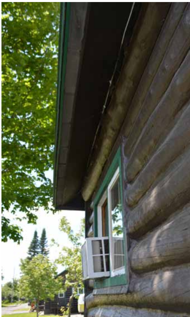
Figure 177 : Les soffites sont ventilés par une ventilation linéaire refermée par un moustiquaire.
