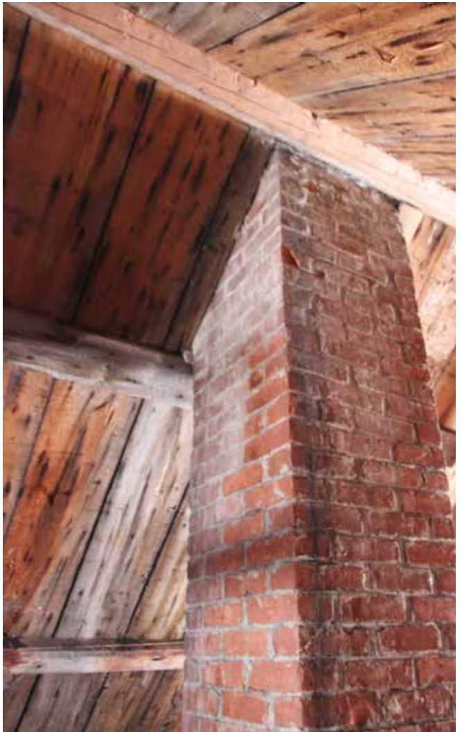
Figure 41 : Certains joints de la cheminée sont creux ou évidés et des traces d'efflorescences sont visibles sur une portion de la cheminée dans l'entretoit.
