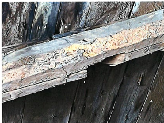
Photo #11 INTERVENTION #3 Prévoir renfort structural sur 2 poutres qui ont été encochées.
