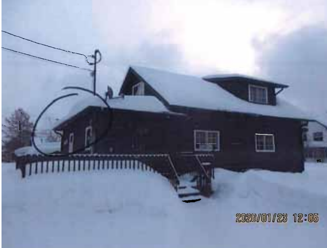
Figure 24 : Formation de digues de glace sur la toiture de l'annexe du 107, avenue Perrault à l'hiver 2020. Photographie transmise par la ville de Val-d'Or. Les annexes étaient peu isolées à l'origine.
