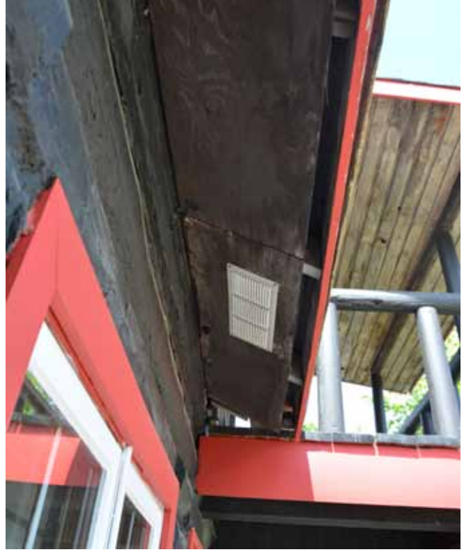
Figure 126 : La partie des chevrons qui se poursuit au-delà des murs extérieurs a été recouverte de planches de contreplaqué.
