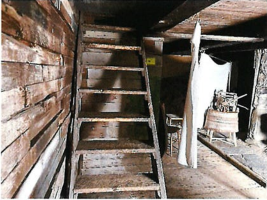
Photo #1 Escalier intérieur menant au niveau 2 du bâtiment. Accès au niveau par une trappe.
