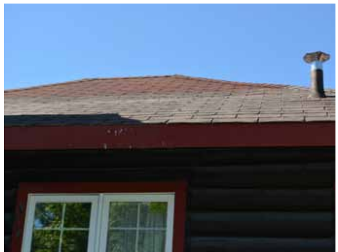
Figure 71 : La toiture de la maison est recouverte de bardeaux d'asphalte 3 pattes. Le revêtement en bardeaux d'asphalte est très dégradé.
