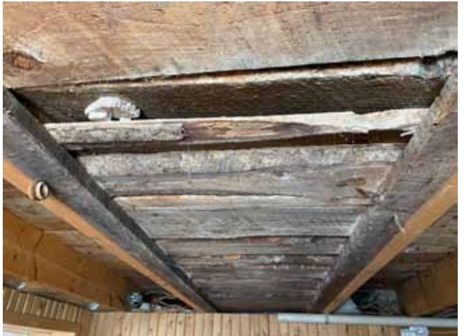
Figure 22 : La structure des planchers est constituée d'un platelage posé sur des solives en bois de sciage, ce qui est cohérent avec le type et l'année de construction d'origine de la maison.
