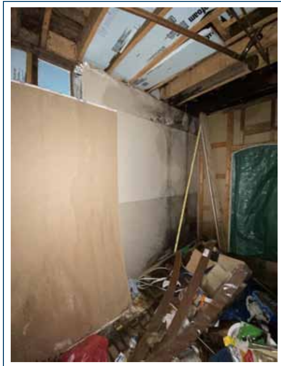
PHOTO 14 : Rez-de-chaussée. Beaucoup d'objets sur le sol et présence de taches de moisissures sur les murs.
