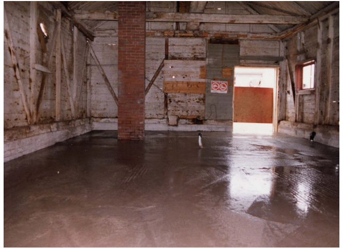
Figure 31 : La structure des murs de la cookroom est chaulée et de même composition que celle du volume principal. Travaux de restauration de 1988. Source : Collection du SHNP.
