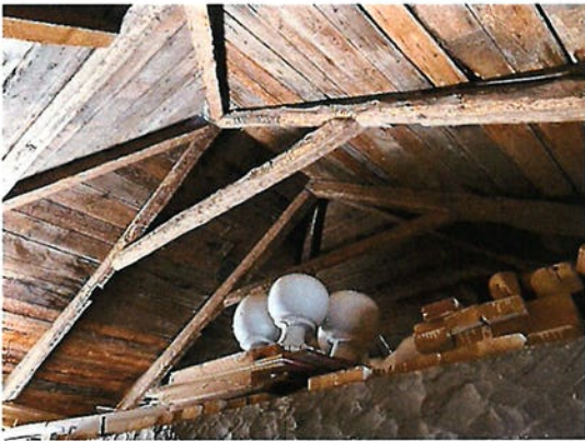
Photo #20 INTERVENTION #2 Structure du toit en bon état, prévoir remplacer les planches pourries.
