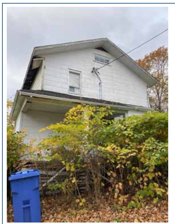
PHOTO 4 : Extérieur. Vue sur les panneaux de bois détériorés à l'emplacement des soffites ainsi que sur la vitre de la fenêtre cassée.
