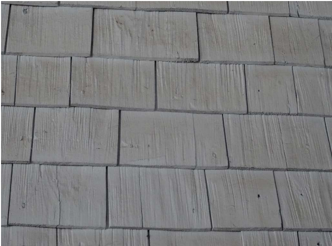
Figure 40 : Dans l'appentis, la façade nord du volume principal est recouverte de bardeaux de cèdre peint blanc en bon état
