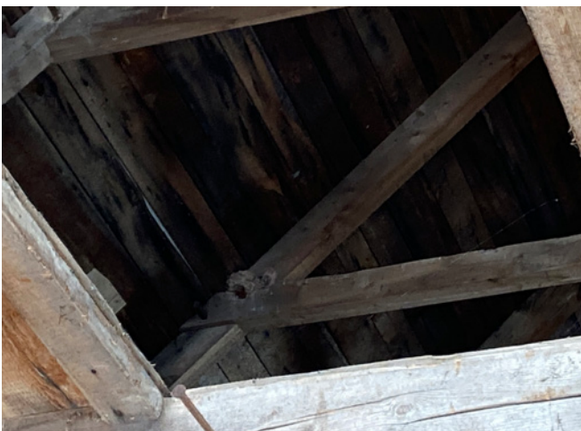
Figure 38 : Lors des travaux de restauration, le revêtement de toiture a été installé sur une membrane visible entre les planches du platelage depuis l'entretoit.
