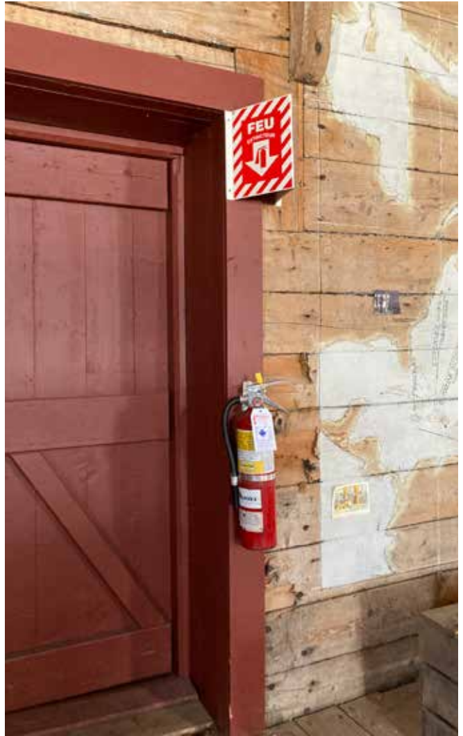
Figure 124 : Des extincteurs portatifs sont installés dans le bâtiment. Ils sont identifiés par panneaux indicateurs.
