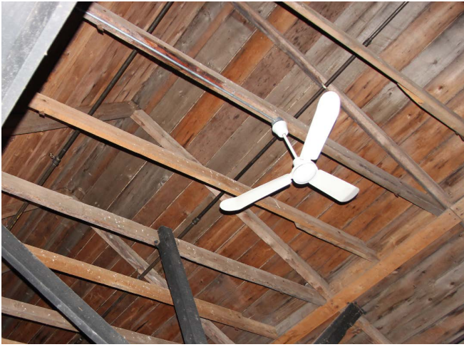
Figure 117 : Des ventilateurs sont installés au plafond de la salle de spectacle.
