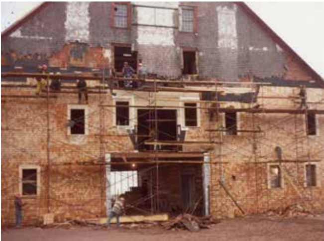
Figure 62 : Des bardeaux ont été remplacés en 1981. Ils sont alors laissés nus. Source: Collection du SHNP. 1981.
