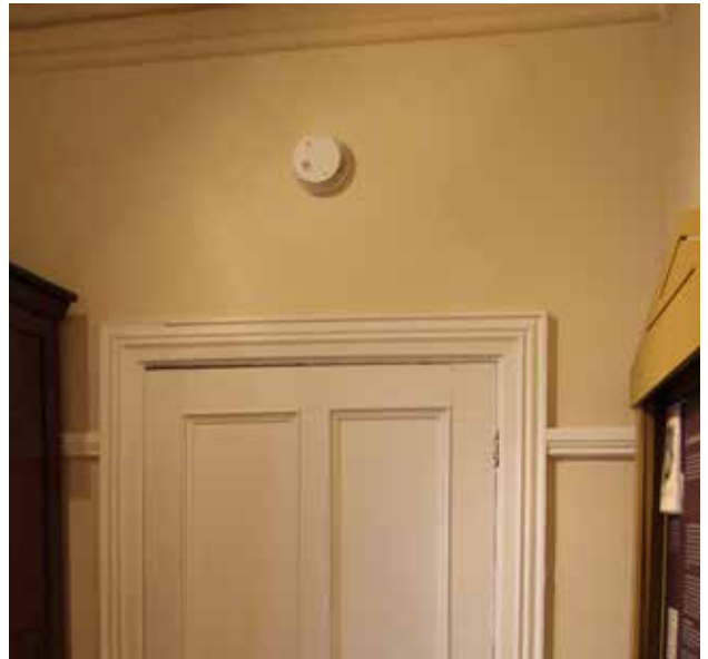
Fig. 115 : L'édifice est muni d'avertisseurs de fumée.
