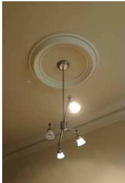
Fig. 121 : L'éclairage intérieur du bâtiment est assuré par des lustres.
