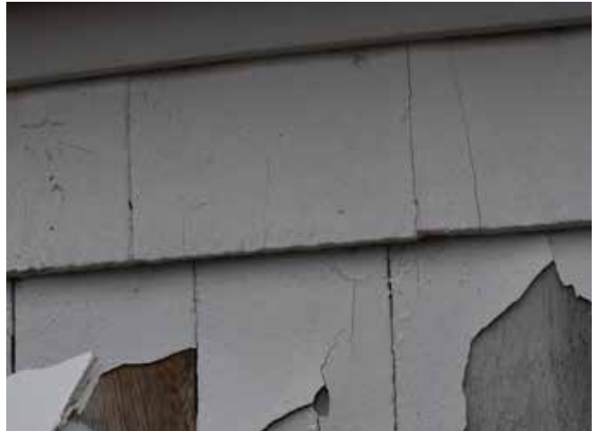
Figure 69 : Plusieurs bardeaux sont pourris et doivent être remplacés alors que d'autres sont tombés.
