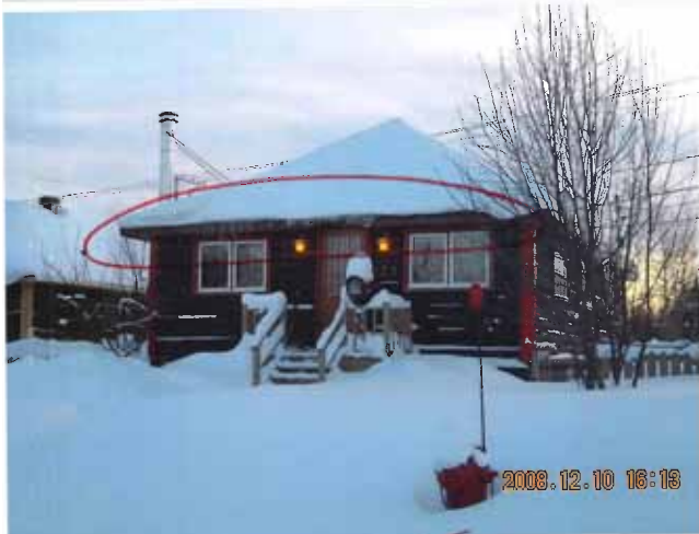
Figure 36 : Maison de type E. 138, avenue Perrault. Formation de digues de glace sur le versant nord en décembre 2008. Photographie transmise par la ville de Val-d'Or.
