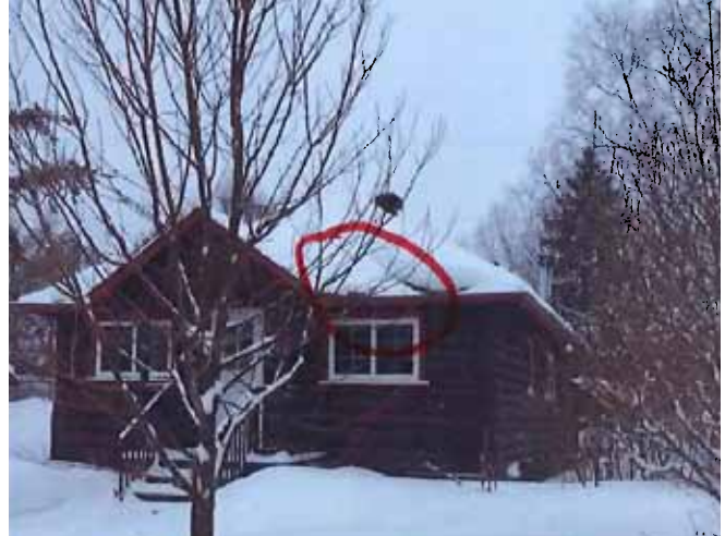
Figure 49 : Maison de type E. Accumulation de neige vis-à-vis la noue en façade avant est du 61, rue Marineau en mars 2022. Photographie transmise par la ville de Val-d'Or.
