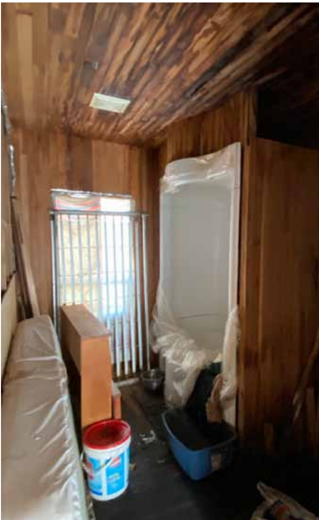
Figure 120 : Dans la pièce avec la douche et dans une des chambres à l'étage, les murs sont recouverts de lattes de bois verni. Des cernes sur les lattes de bois au plafond sont visibles.
