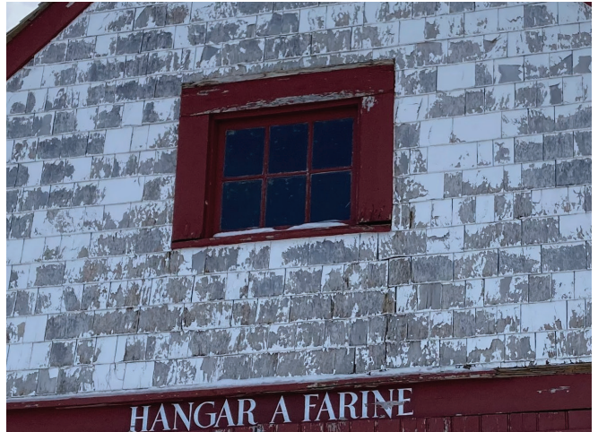
Figure 23 : Fenêtre en bois peint en rouge à six carreaux située sur le mur pignon nord. La peinture de la fenêtre et du chambranle s'écaille.
