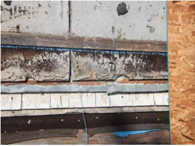
Figure 73 : Le revêtement est également très dégradé à la base de la façade arrière. Un solin en tôle est présent à la base du fond de clouage des tuiles d'amiante-ciment, au-dessus du dernier rang.
