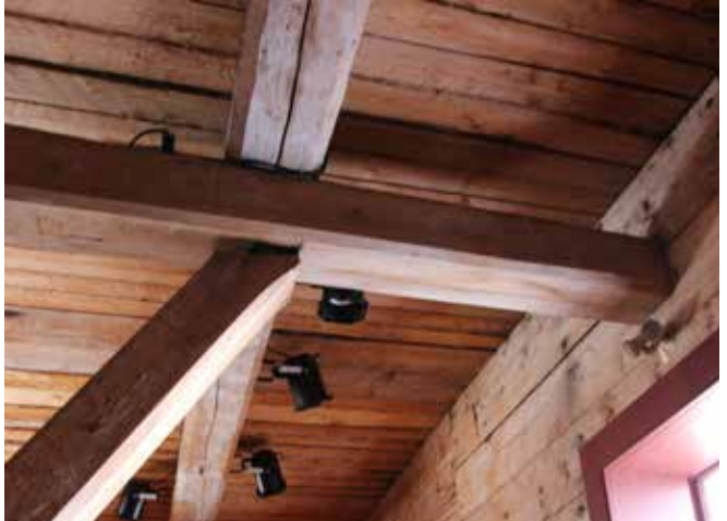
Figure 126 : Des projecteurs sont installés sur la structure de bois.
