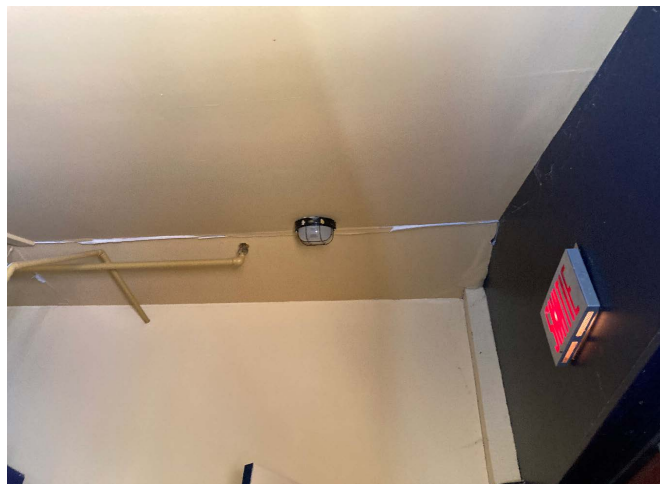
Figure 107 : Les plafonds de l'appentis ouest sont recouverts de gypse. Le gypse est fissuré par endroits et des traces d'infiltration d'eau sont visibles.
