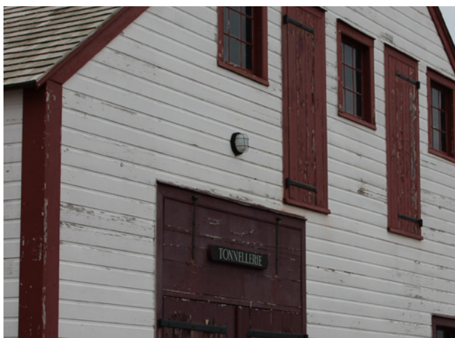
Figure 67 : Un luminaire en applique de style marin est installé au-dessus de la porte principale.
