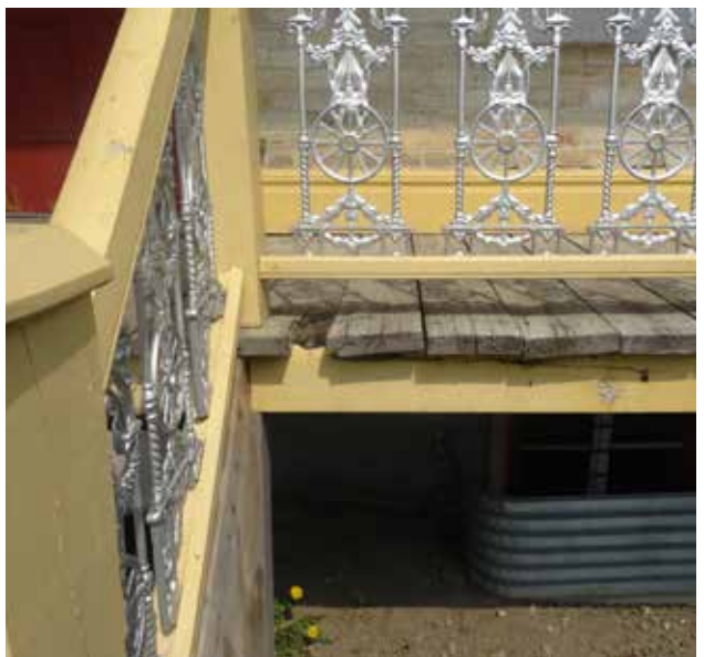
Fig. 31 : Plusieurs éléments des galeries, comme les planches du plancher de la galerie principale, sont grandement dégradés.
