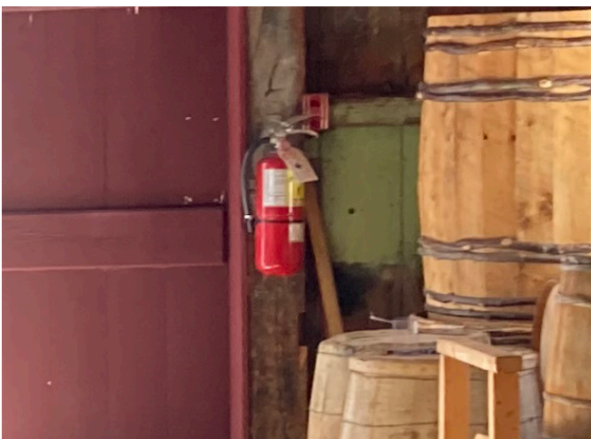
Figure 63 : Des extincteurs portatifs sont installés dans le bâtiment.
