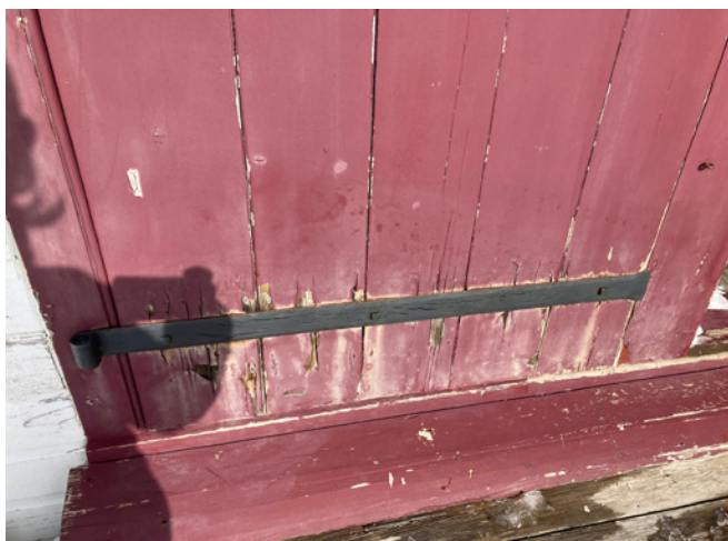
Figure 36 : La peinture s'écaille sur les portes et la porte principale et les portes de chargement sont pourries par endroit.
