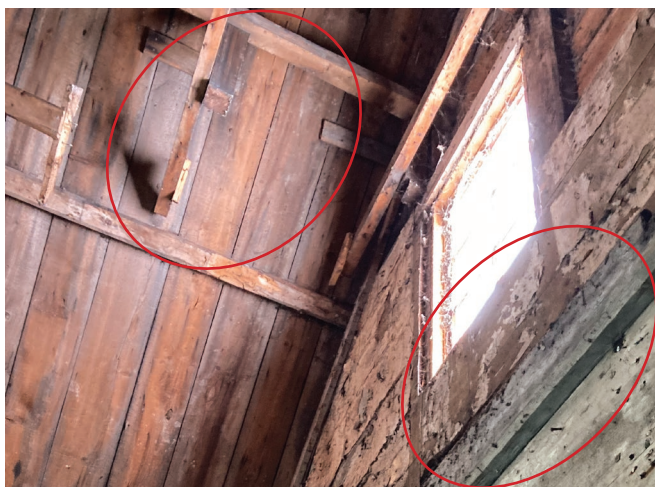
Figure 31 : Traces de la structure du clocheton autrefois présente à l'extrémité sud de la toiture. La poutre de soutien de l'ancien plancher de l'étage demeure aussi présente.
