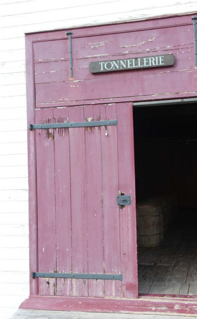
Figure 42 : La peinture s'écaille sur les portes et la porte principale et les portes de chargement sont pourries par endroit.
