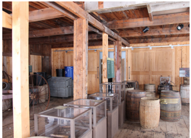
Figure 17 : Contrairement à plusieurs bâtiments sur le site, les planchers ne sont pas soutenus par des consoles de bois. Certains poteaux ont été consolidés lors des travaux de 2003.
