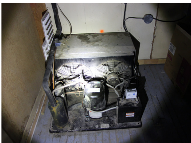
Figure 68 : Des chambres froides sont installées dans la partie arrière du bâtiment.
