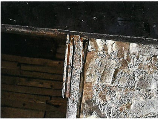
Photo #4 Sur la cheminée, une planche de bois est abîmée et serait à remplacer. La maçonnerie de la cheminée est bon état.
