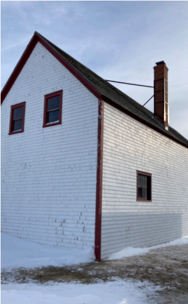
Figure 42 : La cheminée est retenue à la charpente par une structure de tirants d'acier peint noir.
