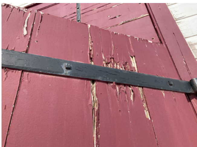
Figure 35 : La peinture s'écaille sur les portes et la porte principale et les portes de chargement sont pourries par endroit.
