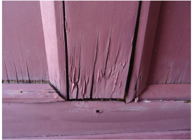
Figure 43 : Une traverse verticale de la porte principale est pourrie.
