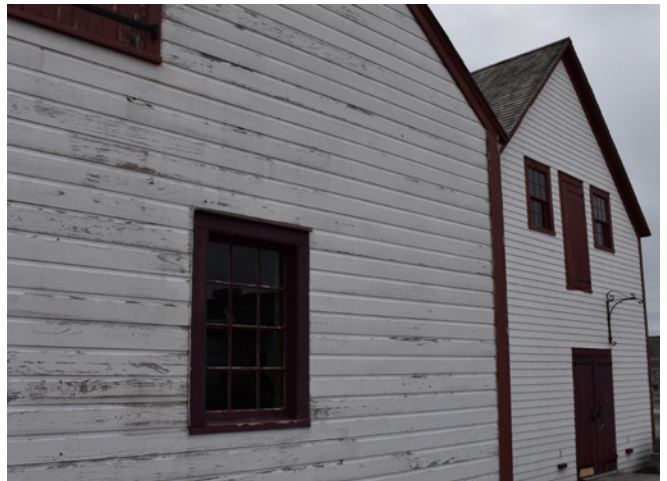
Figure 27 : Les murs extérieurs sont revêtus de planches à gorge, ou à feuillure, peint blanc.
