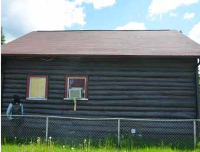
Figure 111 : Une crête faîtière a ensuite été ajoutée pour créer un appel d'air depuis les larmiers.
