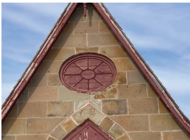
Figure 24 : En façade avant, le bâtiment est muni d'un oculus fermé en bois peint de la couleur Rouge Navajo 4076-85 de la compagnie SICO.
