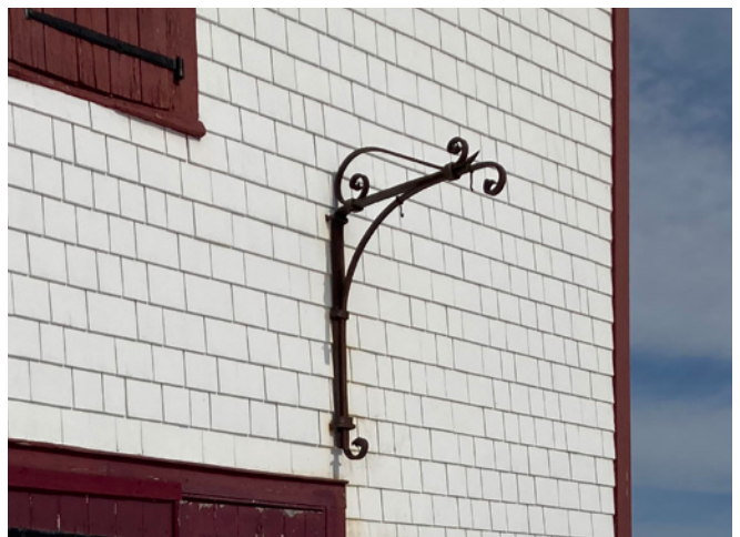
Figure 45 : Sur la façade sud de la forge, une potence métallique permet d'accrocher une affiche en au-dessus de la porte. Elle a été installée lors des travaux de 2003.
