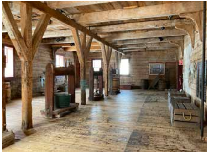
Figure 31 : Au rez-de-chaussée et à l'étage, des pièces de bois installées en diagonale entre les colonnes et les poutres permettent de contreventer l'ensemble.
