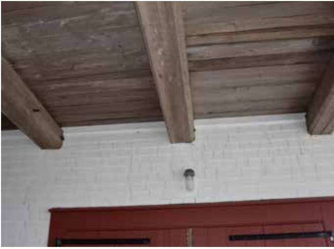
Figure 129 : Des luminaires en applique sont installés au-dessus des portes à l'intérieur du grand corridor du rez-de-chaussée.
