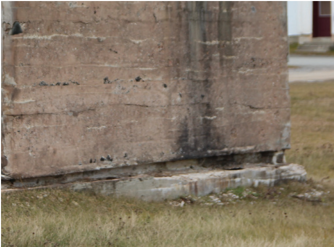
Figure 16 : La semelle de béton des fondations est visible de l'extérieur. Le périmètre du bâtiment est entouré de gazon.
