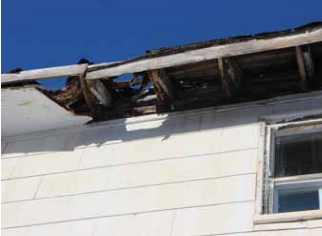
Figure 70 : Une section importante du soffite est pourrie et s'est effondrée du côté sud.
