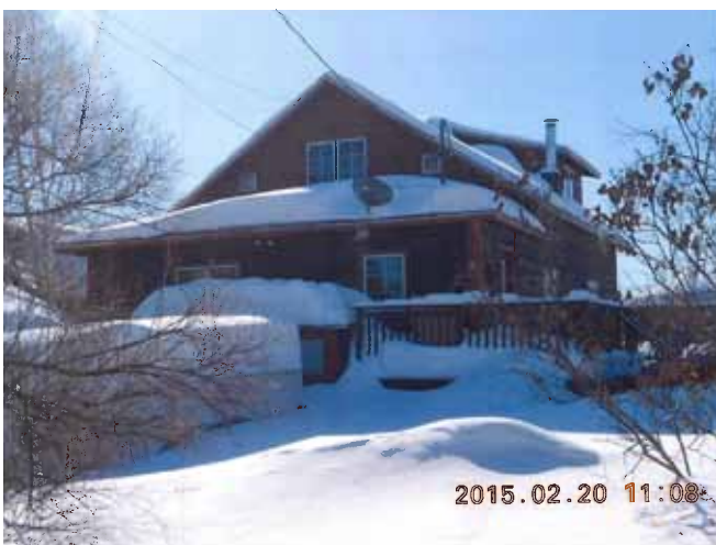
Figure 168 : Formation de digues de glace sur la toiture de l'annexe en février 2015. Photographie transmise par la ville de Val-d'Or.
