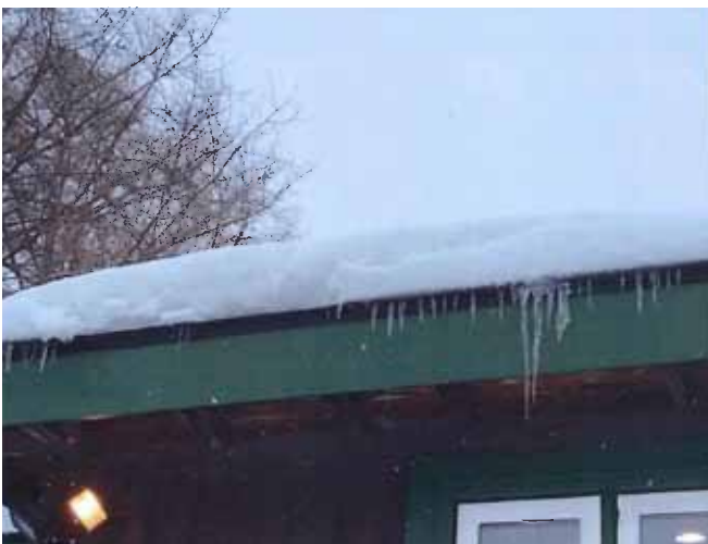
Figure 22 : Formation de digues de glace sur la toiture de l'annexe du 61, rue Lemieux. Photographie transmise par la ville de Val-d'Or.
