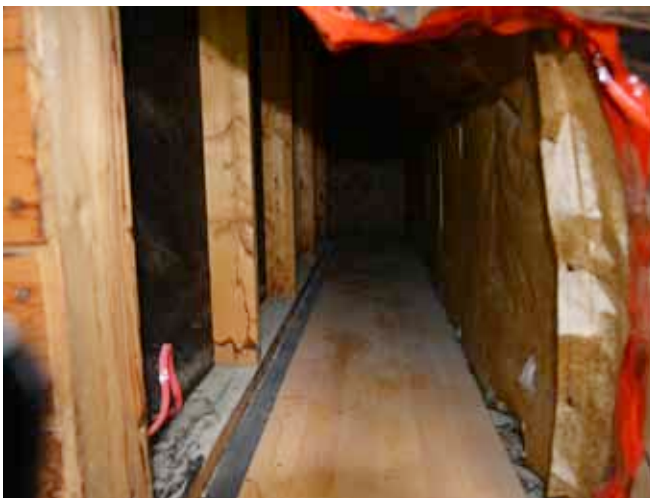
Figure 154 : La face inférieure de la toiture est isolée par des matelas de mousse isolante blanche en polymère avec un pare-vapeur réfléchissant du côté chaud.
