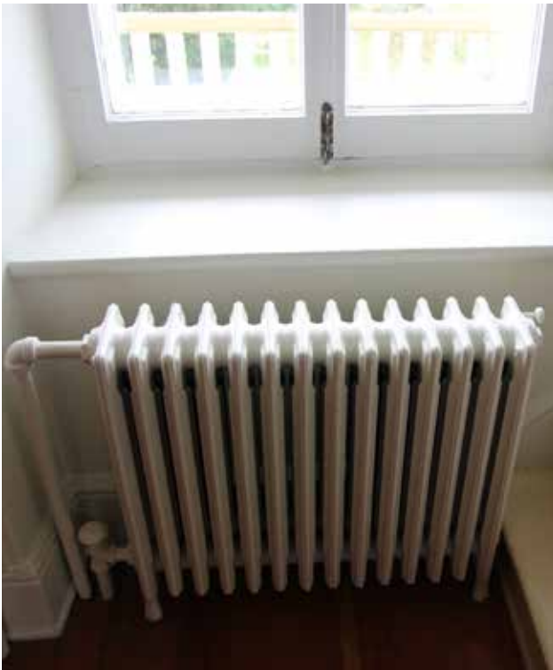
Fig. 110 : La chaleur est distribuée grâce à des radiateurs en fonte à eau chaude.
