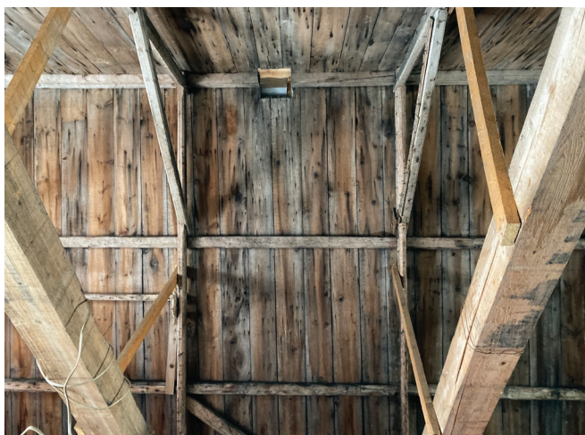
Figure 16 : Des cernes, visibles sur le platelage de la toiture, témoignent d'infiltration d'eau. Ces infiltrations ne semblent plus actives.
