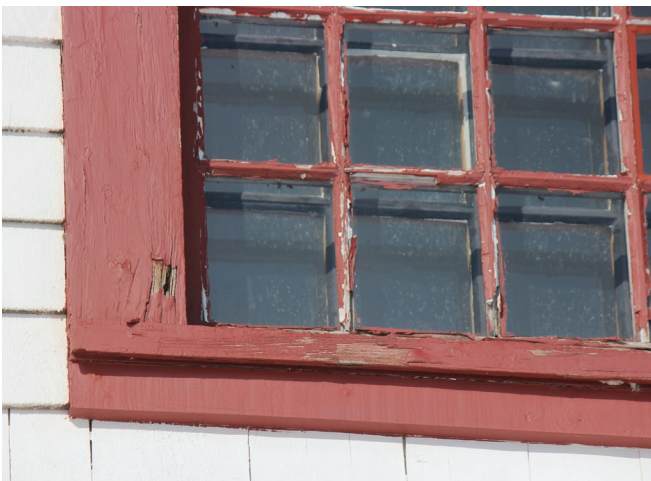
Figure 41 : Le mastic des contre-fenêtres doit également être refait.
