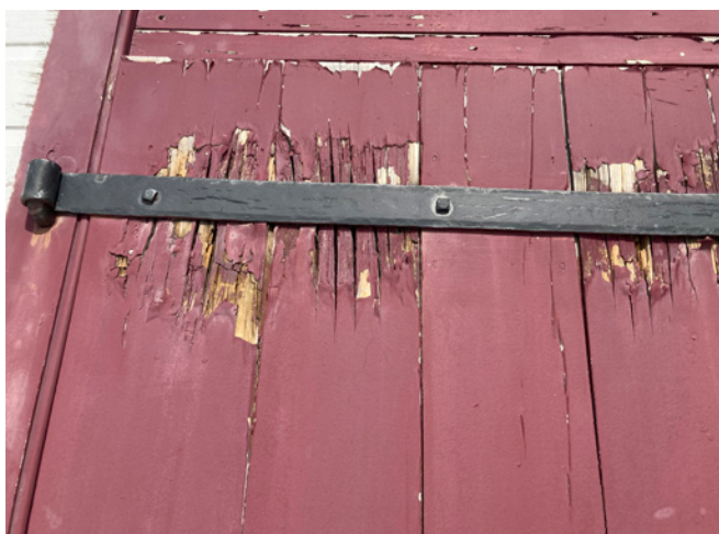
Figure 38 : La peinture s'écaille sur les portes et la porte principale et les portes de chargement sont pourries par endroit.
