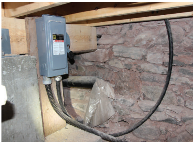
Figure 67 : Le panneau de distribution est situé dans le vide sanitaire.
