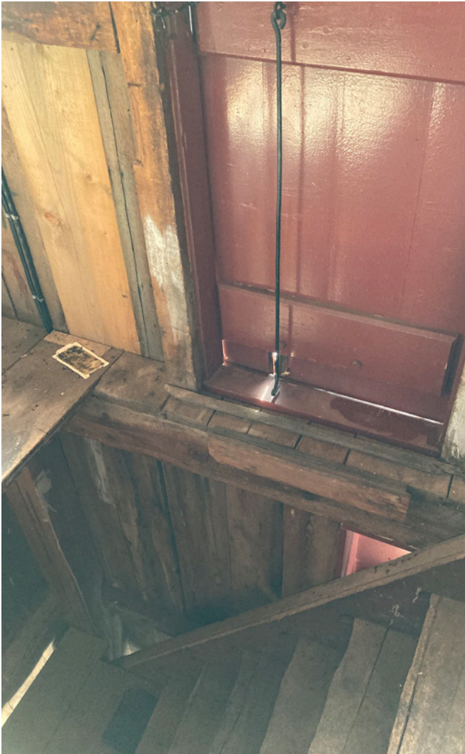
Figure 49 : De grands crochets permettent de retenir les portes en position ouverte.
