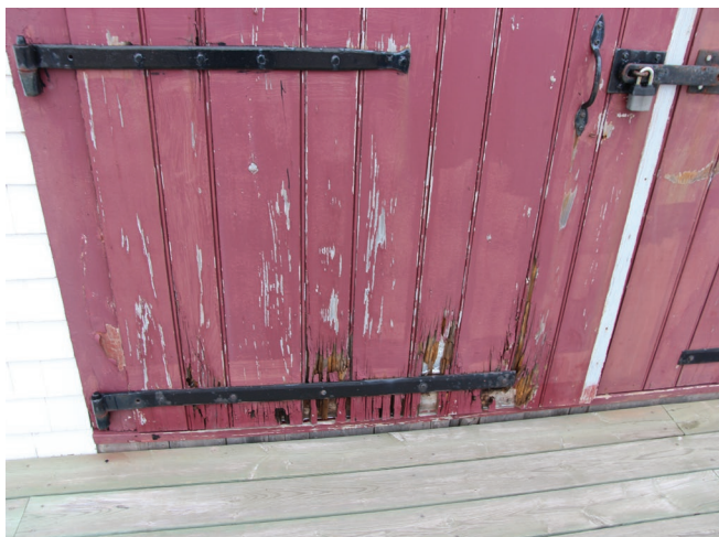
Figure 52 : Les contre-portes sont en très mauvais état.
