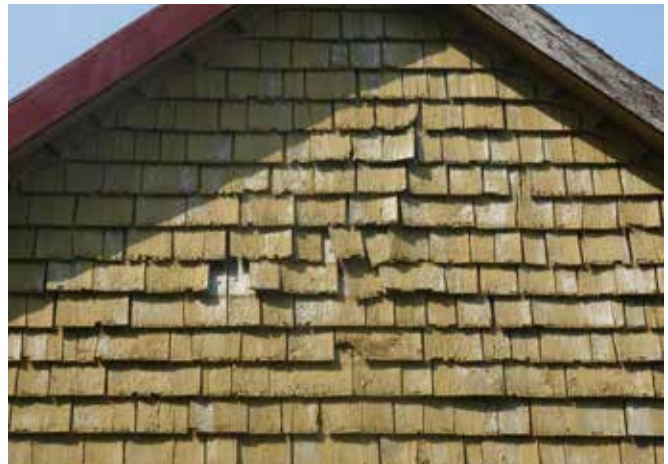
Fig. 18 : Le parement de bardeaux de cèdre est en très mauvais état.
