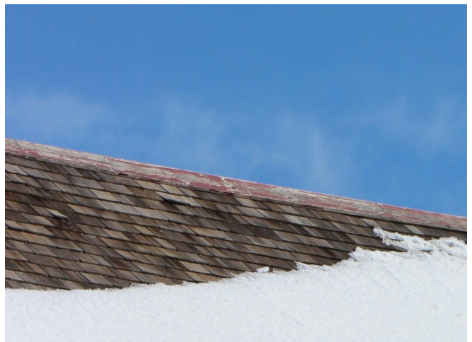
Figure 75 : Une nouvelle planche faitière en bois peint rouge a été installée. Elle est en bon état, mais doit être peinte.
