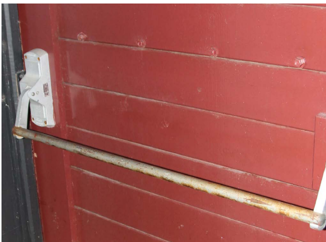
Figure 60 : La porte simple de la façade est, avec barre panique, a été ajoutée en 1988 pour ajouter une issue à la salle de spectacle. La barre panique est corrodée.
