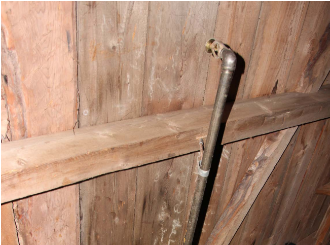
Figure 118 : Le bâtiment est muni d'un système de gicleurs.
