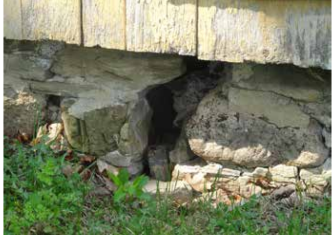
Fig. 10 : Les pierres sont parfois dissociées laissant des ouvertures entre l'extérieur et le vide sanitaire.
