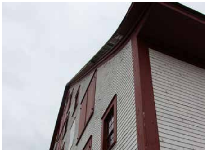
Figure 73 : De façon générale, les larmiers sont en bon état mais sur la façade principale, certaines sections de bois sont manquantes près de la jonction des deux versants.
