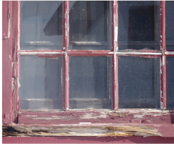
Figure 38 : Certaines tablettes sont complètement pourries notamment sur la façade ouest.
