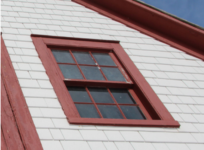
Figure 30 : Le mastic des fenêtres est parfois détérioré.
