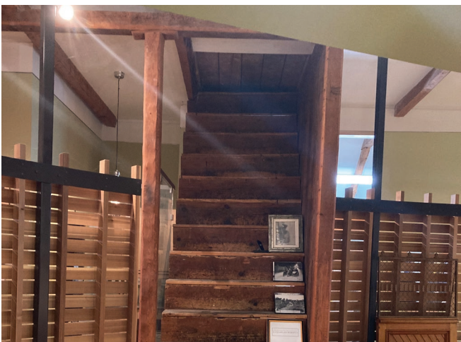
Figure 64 : Une trappe en planches de bois donne accès à l'entretoit depuis l'étage. Elle est accessible par une échelle de meunier.
