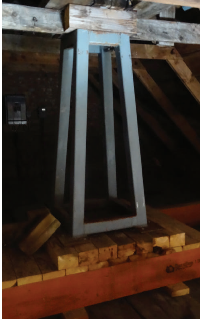
Figure 55 : La cheminée est soutenue de l'intérieur par une structure en acier située dans l'entretoit.
