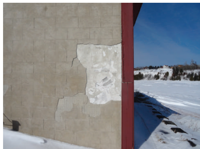
Figure 27 : À certains endroits, particulièrement sur la façade sud-est, l'enduit se détache du mur.
