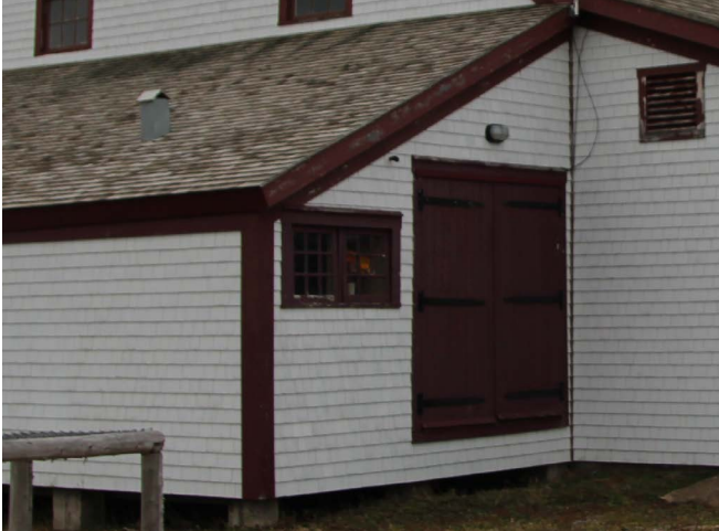
Figure 66 : Une porte double donne également accès à la loge depuis la façade sud de l'appentis ouest.
