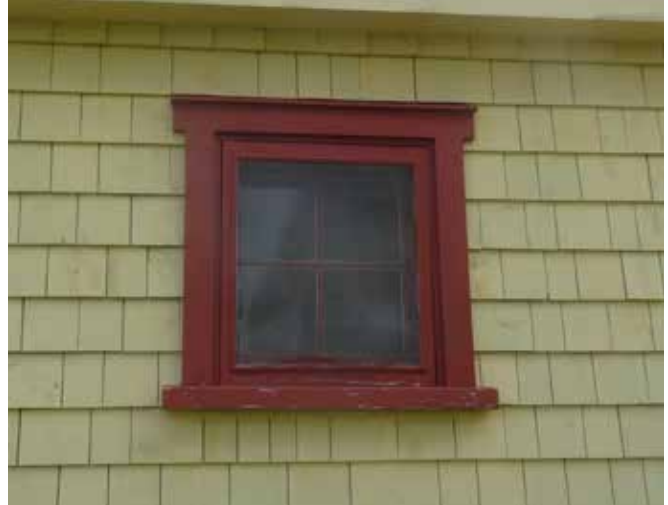
Fig. 29 : Une petite fenêtre de bois à quatre carreaux apporte de la lumière naturelle à l'appentis ouest.
