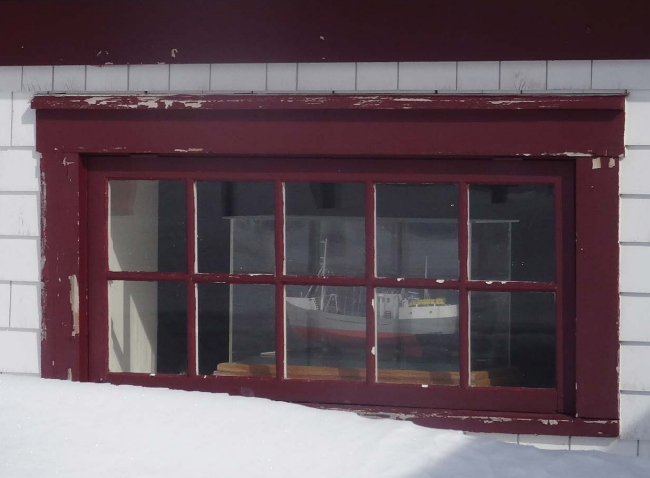
Figure 50 : Du côté extérieur, les fenêtres et leurs chambranles doivent être restaurés et peints.
