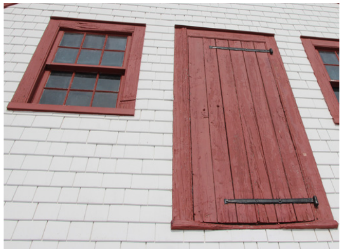
Figure 37 : Le bois de la porte de chargement ainsi que du chambranle est très fissuré.
