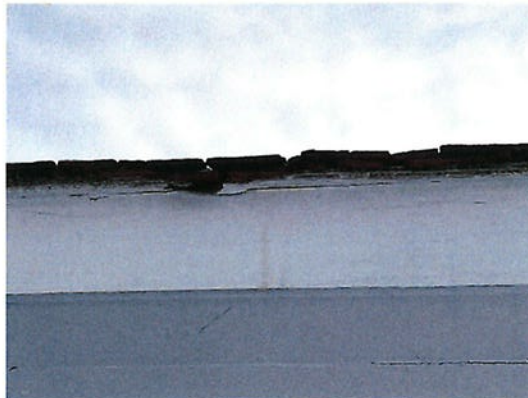
Photo #27 INTERVENTION #7 Les bardeaux sont en très mauvaises état. Prévoir remplacer tous les bardeaux.
