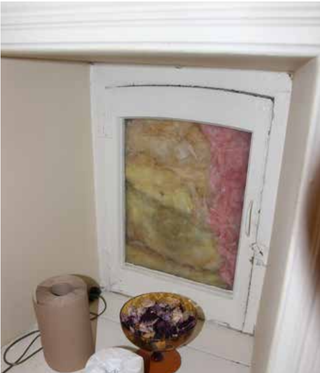
Fig. 54 : Dans la salle de bain située au rez-de-chaussée, la fenêtre a été condamnée avec de l'isolant.
