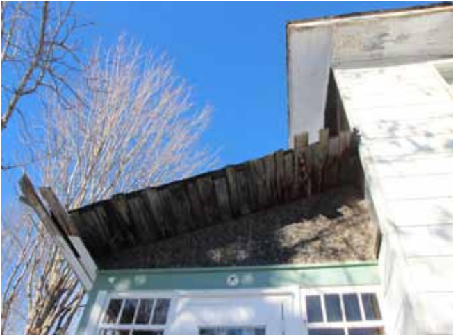
Figure 55 : La finition de la toiture de la véranda au-dessus de la porte du côté sud est inadéquate.
