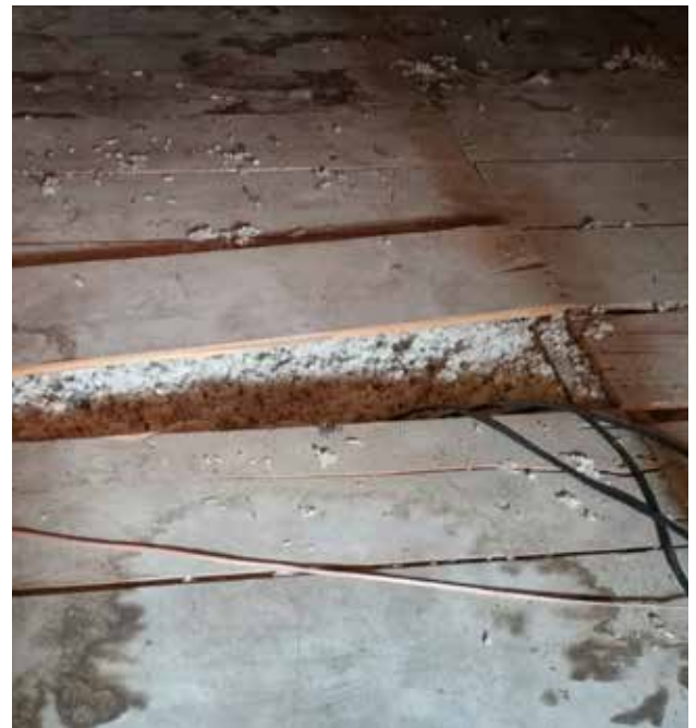
Fig. 72 : Le plancher de l'entretoit a été isolé avec de la laine minérale soufflée.
