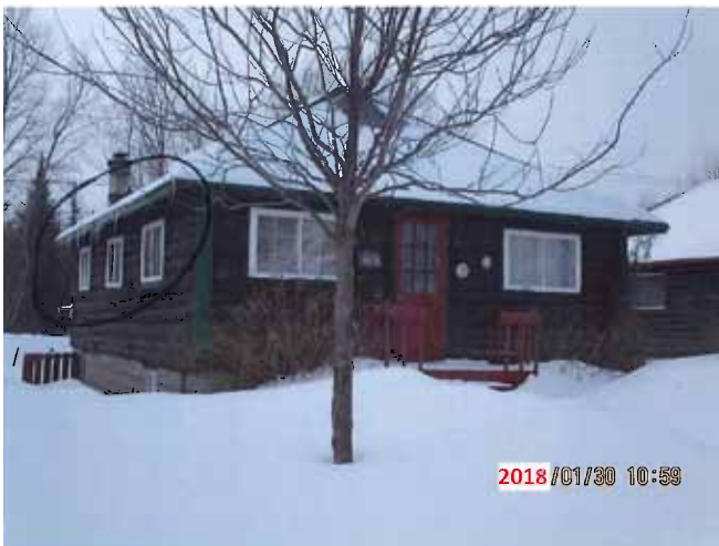
Figure 28 : Formation de glaçons sur le versant est de la toiture du 116, avenue Perrault en janvier 2018. Photographie transmise par la ville de Val-d'Or.
