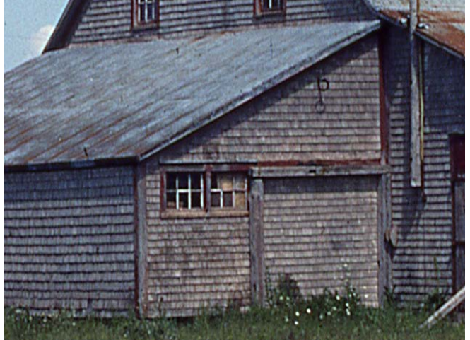
Figure 67 : La porte sud de l'appentis ouest a été ajoutée lors des travaux de restauration de 1988 puisqu'elle n'apparaît pas sur les photos d'archive antérieures. Collection du SHNP.
