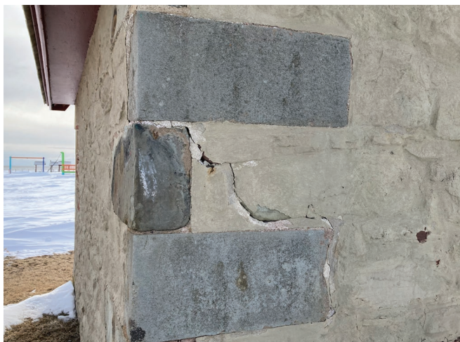
Figure 19 : La reprise de fissures lors des travaux de restauration de 2005 suggère qu'il y a eu des problèmes de structure dans les murs extérieurs par le passé.
