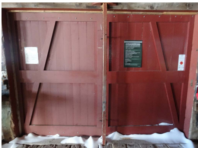
Figure 72 : Certaines portes ne sont pas étanches et laissent passer la neige.
