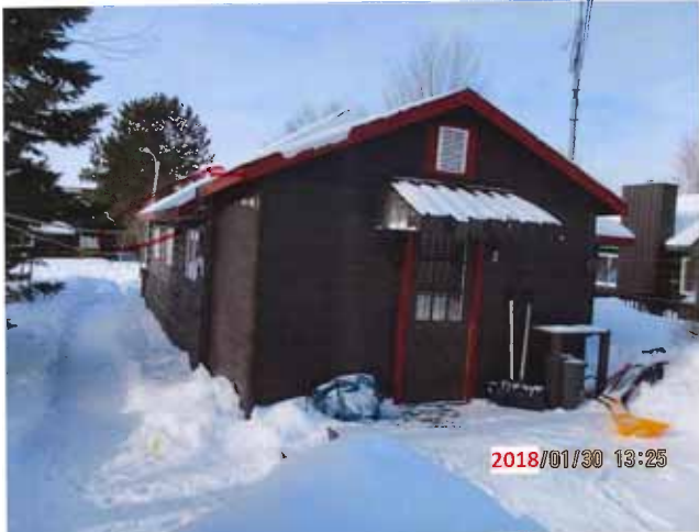
Figure 48 : Formation de petites digues de glace sur le versant latéral sud du 58, rue Marineau en janvier 2018. Vue de l'arrière. Photographie transmise par la ville de Val-d'Or.
