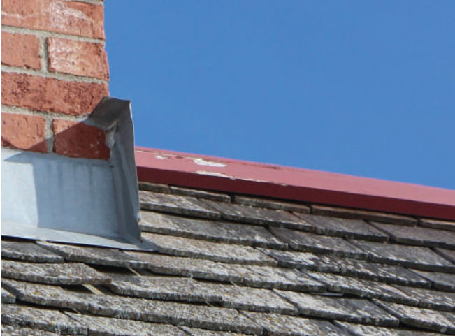
Figure 53 : La planche faitière doit être repeinte.
