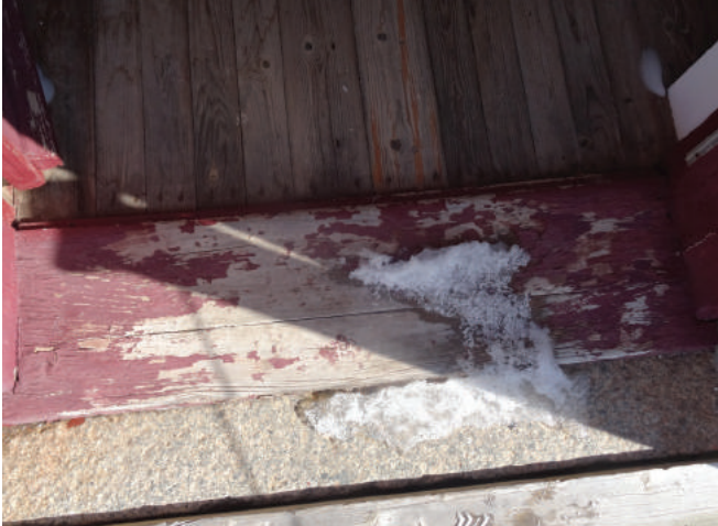
Figure 45 : La peinture des seuils de porte est usée.
