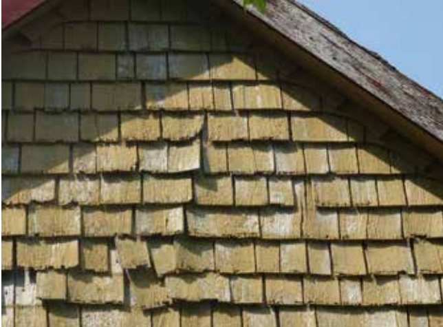
Fig. 42 : Les soffites et fascias du bâtiment sont en bois. De façon générale, la peinture est en mauvais état.
