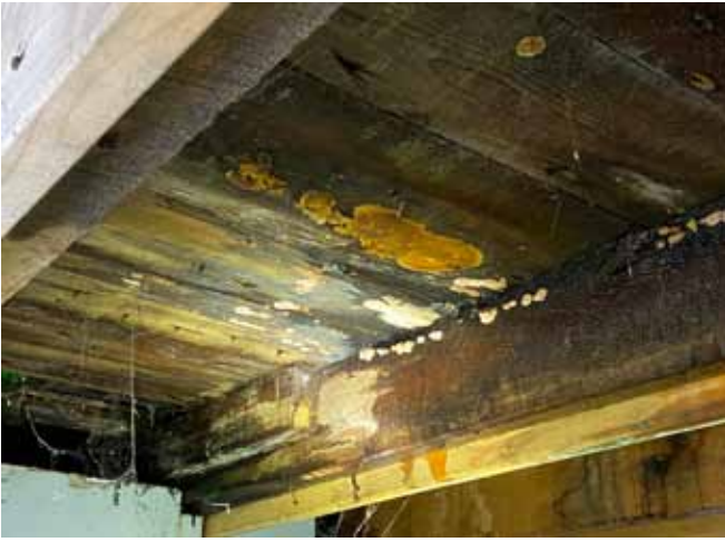
Figure 27 : Quelques champignons localisés ont également été observés au sous-sol sur les poutres et le platelage du plancher de rez-de-chaussée.
