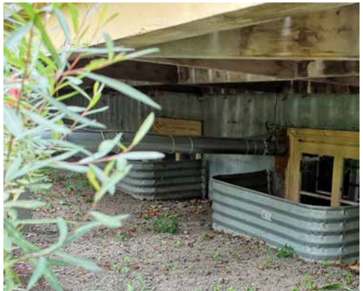
Fig. 113 : Les granules sont acheminées à l'intérieur du bâtiment grâce à un tuyau permanent reliant l'extérieur à l'espace d'entreposage.
