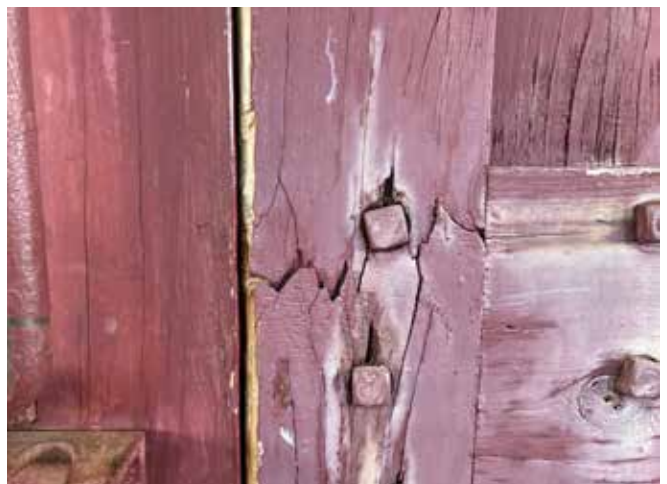
Figure 35 : Certaines portions de bois de la porte sont fissurées.
