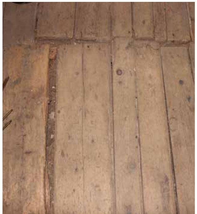
Fig. 18 : Au sous-sol, le plancher de la cuisine d'été et le plancher de la section ouest du corps principal sont en madriers embouvetés déposés sur la terre battue.
