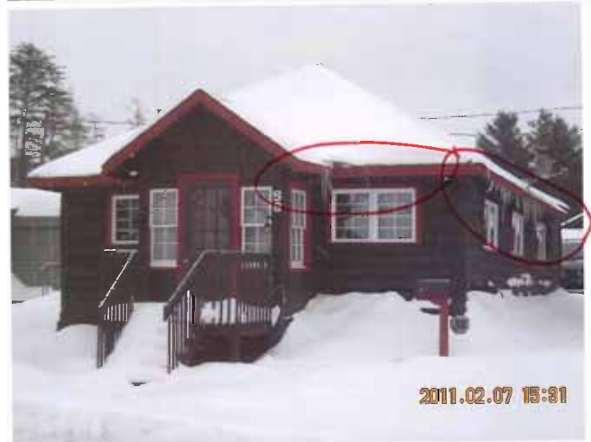
Figure 43 : Formation de digues de glace sur les versants avant ouest et latéral sud du 58, rue Marineau en février 2011. Photographie transmise par la ville de Val-d'Or.
