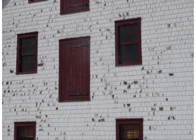
Figure 35 : Le platelage de bois est recouvert d'un revêtement de bardeaux de cèdre peint en blanc. La peinture est aujourd'hui en mauvais état.
