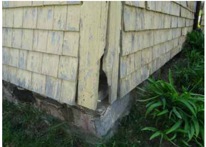
Fig. 39 : La peinture s'écaille à plusieurs endroits. Certaines planches cornières sont très abîmées à la base.
