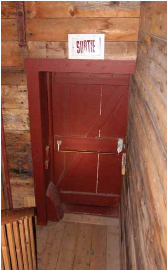
Figure 100 : Une porte d'issue conforme a été ajoutée au bas de l'escalier d'issue.
