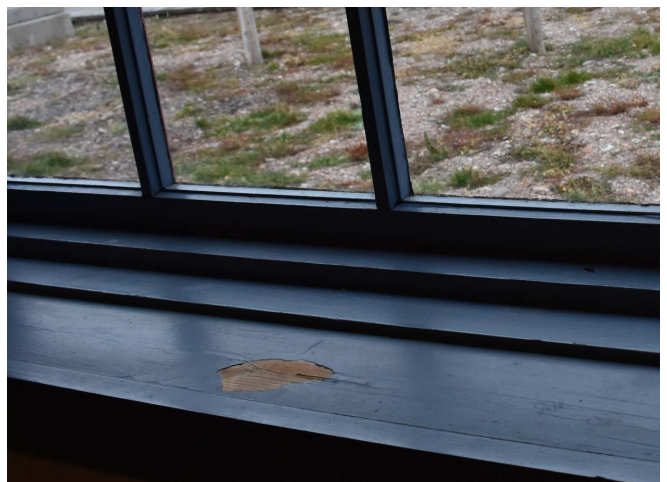
Figure 45 : Du côté intérieur, la peinture sur les cadres des fenêtres est parfois usée.
