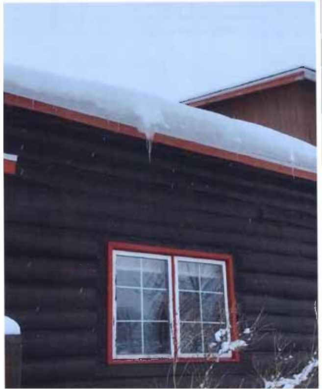
Figure 171 : Formation de digues de glace sur le versant ouest de la toiture en mars 2022. Photographie transmise par la ville de Val-d'Or.
