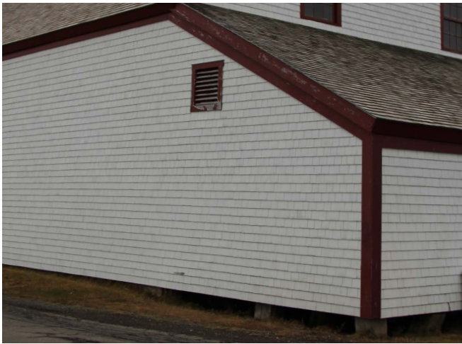
Figure 54 : Une persienne a également été ajoutée sur le mur nord de l'appentis ouest.
