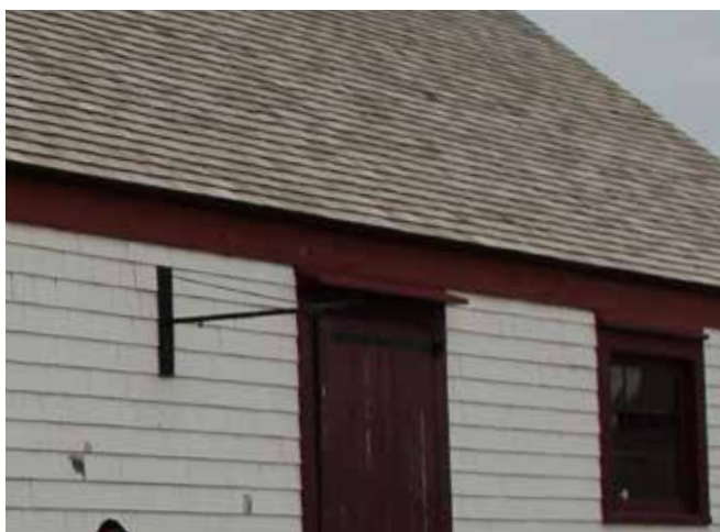
Figure 46 : Sur la façade ouest, une potence métallique permet d'accrocher une affiche à côté de la porte.
