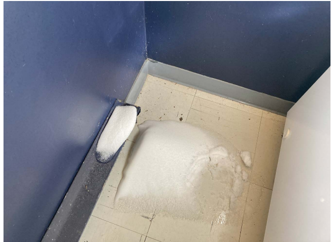
Figure 49 : La fenêtre de l'appentis ouest est tellement détériorée que la neige pénètre à l'intérieur.
