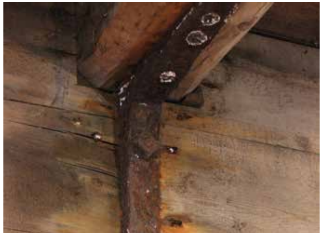
Figure 37 : Certaines consoles de bois ont été remplacées par des consoles en acier qui sont corrodées.
