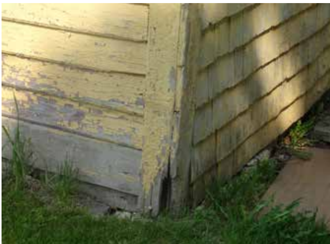
Fig. 40 : La peinture s'écaille à plusieurs endroits. Certaines planches cornières sont très abîmées à la base.
