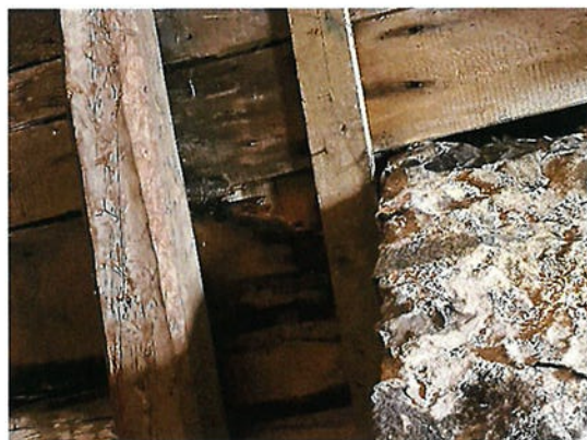
Photo #17 INTERVENTION #2 Platelage du toit, nous avons constaté quelques planches pourries à remplacer, dû à une infiltration d'eau près de la cheminée. Prévoir ragréer le pourtour de la cheminée.
