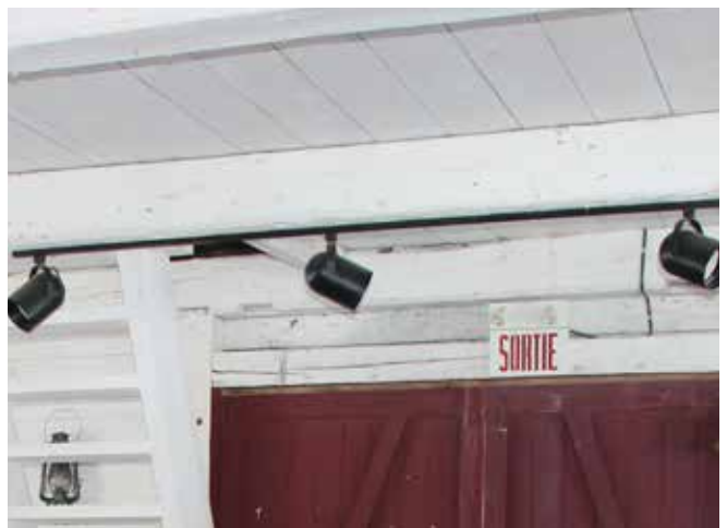
Figure 56 : Un système d'éclairage sur rail est installé au plafond.
