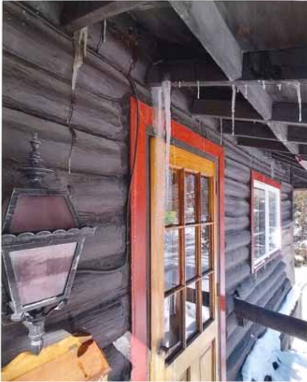
Figure 79 : Diges de glace formées sur la toiture durant l'hiver 2021-2022. Photographie transmise par le propriétaire à la Ville de Val-d'Or.
