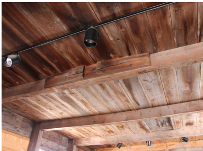
Figure 52 : Un système d'éclairage sur rail est installé au plafond.
