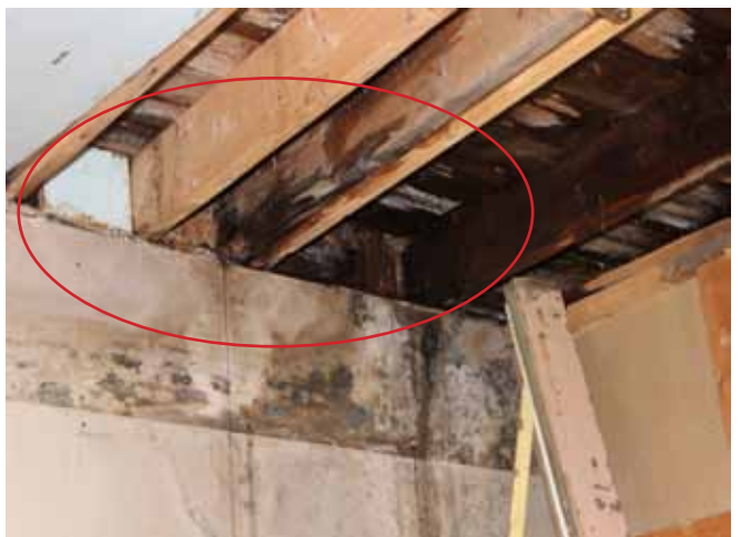
Figure 32 : Des moisissures importantes ont été observées sur les murs du rez-de-chaussée. Ces moisissures ont également atteint la solive de rive et l'extrémité de certaines solives du plancher de l'étage.
