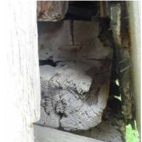
Fig. 61 : Sur le coin nord-est, la pièce de rive au bas du mur est fortement abîmée et son assemblage est disloqué.
