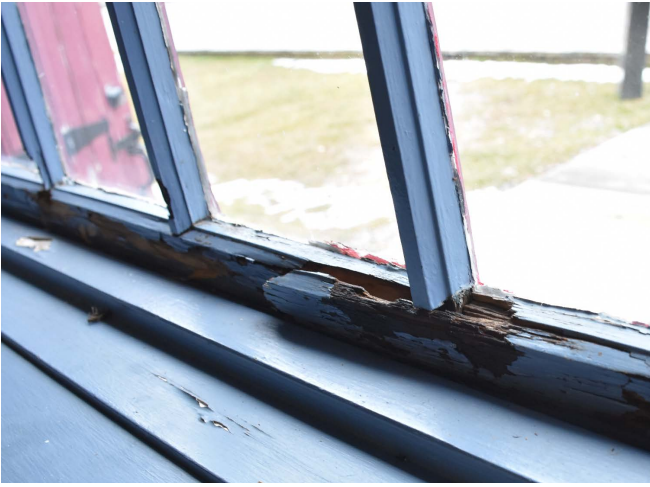
Figure 46 : Les meneaux et cadre de certaines fenêtres de l'appentis sud sont pourris.
