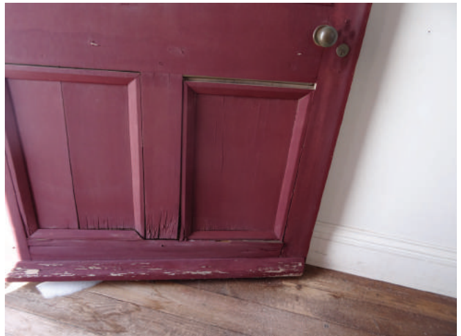
Figure 44 : La peinture des portes est usée.
