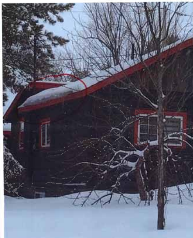
Figure 141 : Formation de digues de glace du côté sud-ouest en mars 2022. Photographie transmise par la ville de Val-d'Or.
