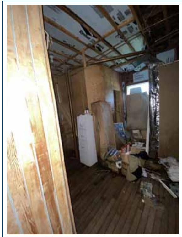
PHOTO 10 : Rez-de-chaussée. Vue sur les objets entreposés sur le plancher, présentant de signes de détérioration par l'eau.
