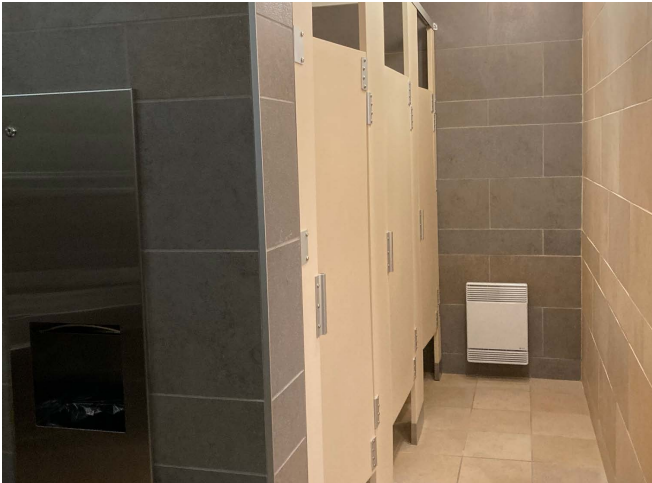
Figure 88 : Les salles de toilettes sont munies de partitions en stratifié massif qui sont en bon état.
