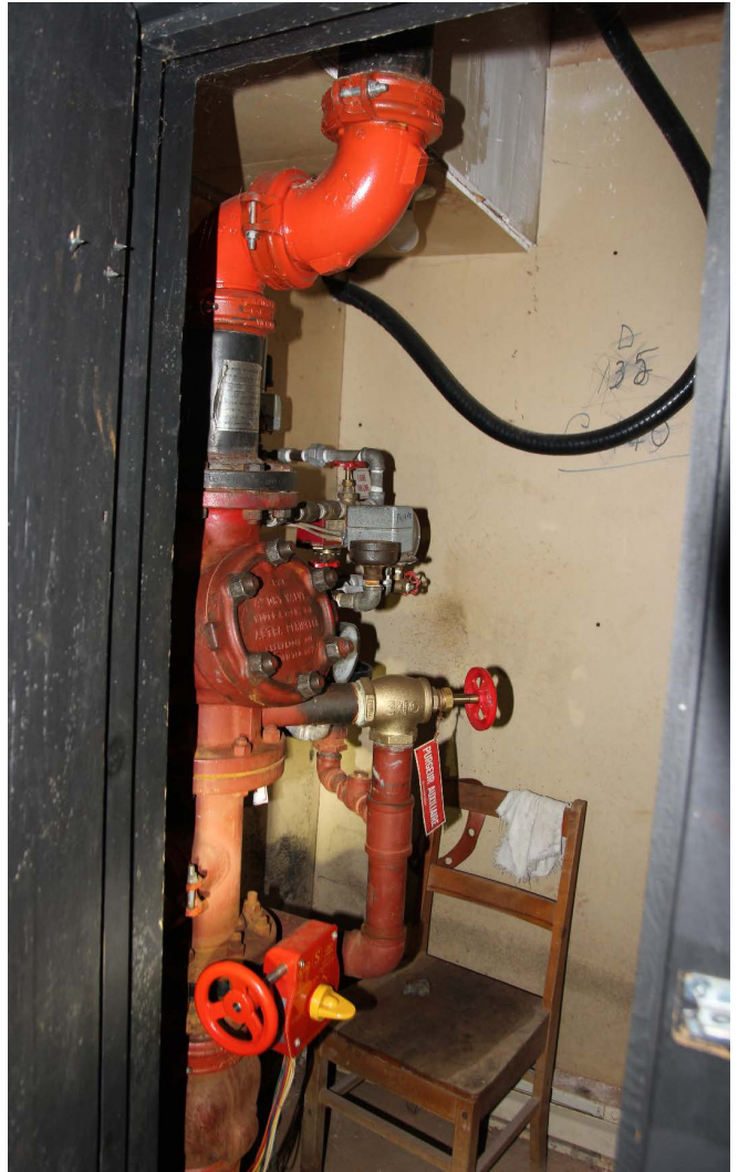
Figure 119 : Le bâtiment est muni d'un système de gicleurs.
