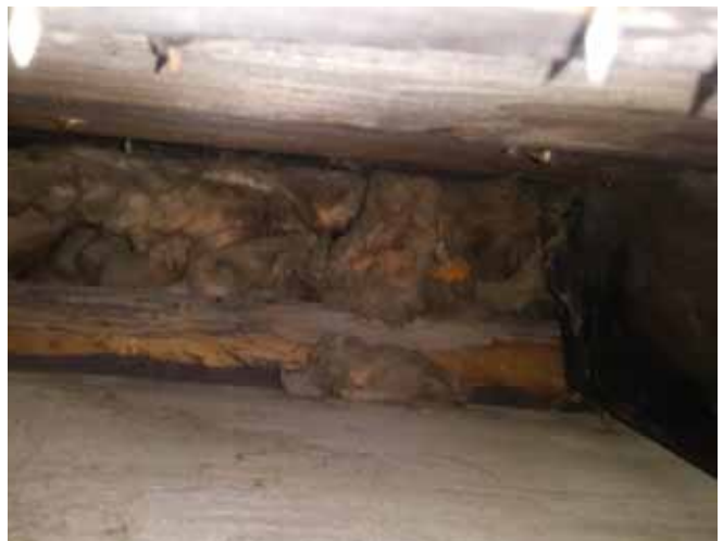
Figure 132 : Les espaces entre les chevrons sont remplis de laine de verre. Donc la toiture n'est pas ventilée du tout
