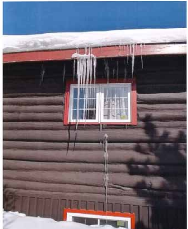
Figure 82 : Diges de glace formées sur la toiture durant l'hiver 2021-2022. Photographie transmise par le propriétaire à la Ville de Val-d'Or.
