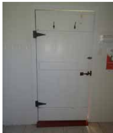
Fig. 34 : Cette porte est en excellent état mais nécessite d'être repeinte.
