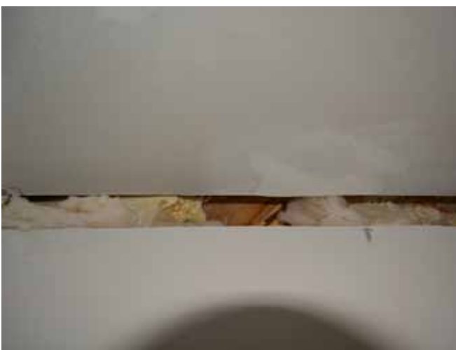
Figure 133 : Les espaces entre les chevrons sont remplis de laine de verre. Donc la toiture n'est pas ventilée du tout.
