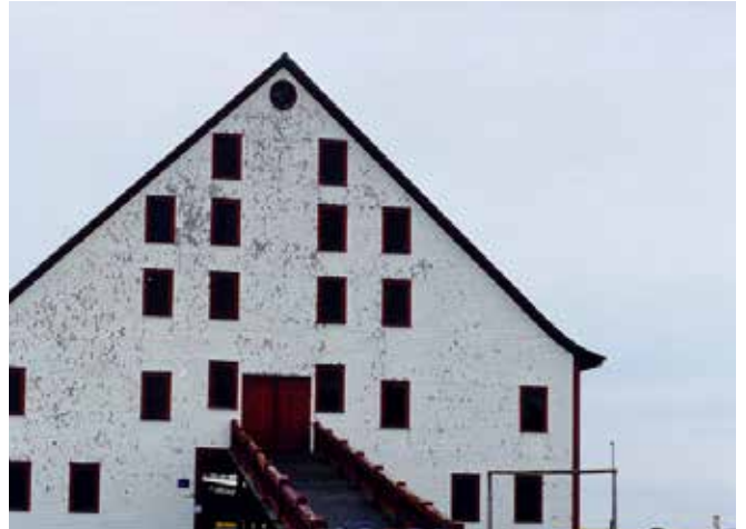
Figure 65 : En 1998, la peinture est détériorée. Source: Collection du SHNP. 1998.
