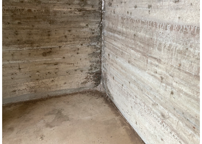
Figure 34 : Le plancher consiste en la dalle sur sol en béton laissé à nu qui est en bon état,
