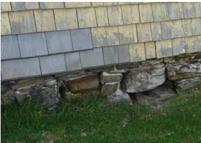
Fig. 19 : Sur la façade arrière, certaines sections de bardeaux ont été remplacées à la base du mur mais ils n'ont pas été peints.
