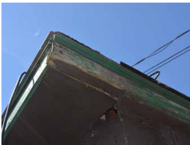
Figure 180 : Les fascias actuels sont en mauvais état et ont besoin d'être restaurés.
