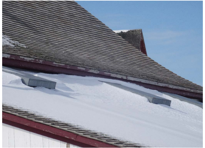
Figure 47 : De façon générale, les larmiers sont en bon état, mais doivent être restaurés et peints puisque la peinture se soulève en plusieurs endroits.
