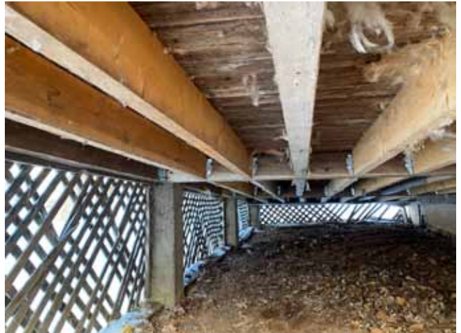
Figure 42 : Le plancher de la véranda était isolé par le dessous au moyen de nattes d'isolant, mais celles-ci se sont détachées et ont disparu.
