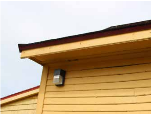
Fig. 68 : Un luminaire extérieur est installé sur la façade principale au-dessus des portes principales.
