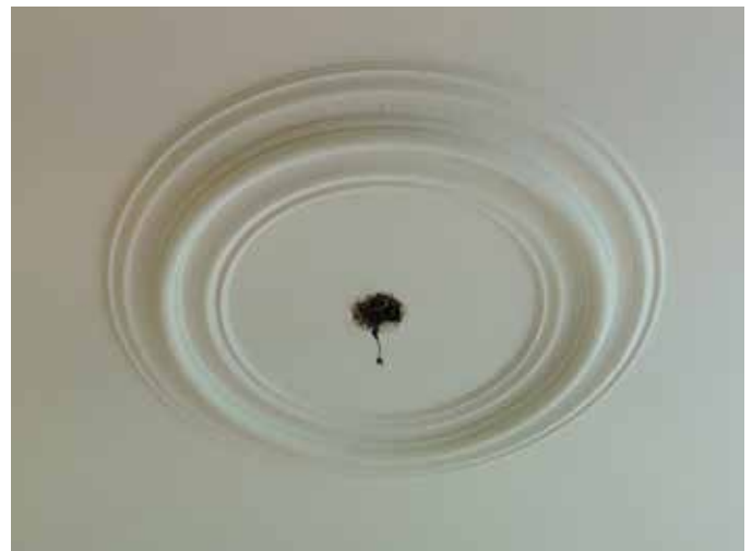
Fig. 124 : Au rez-de-chaussée, un lustre est manquant.
