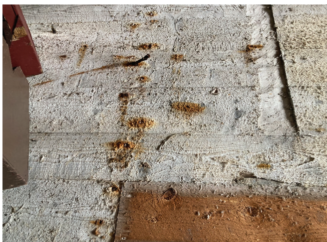
Figure 35 : Des traces de rouille sont présentes autour de clous dans les planches de bois des murs.
