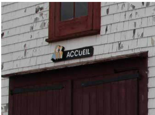
Figure 45 : Au-dessus de la porte de la façade sud, l'enseigne identifiant le bâtiment comme «accueil» a été posée en 2003 pour remplacer l'enseigne identifiant le «cook-room».
