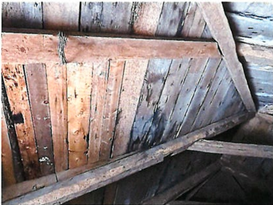
Photo #14 INTERVENTION #2 & 3 Platelage du toit, nous avons constaté quelques planches pourries à remplacer.
