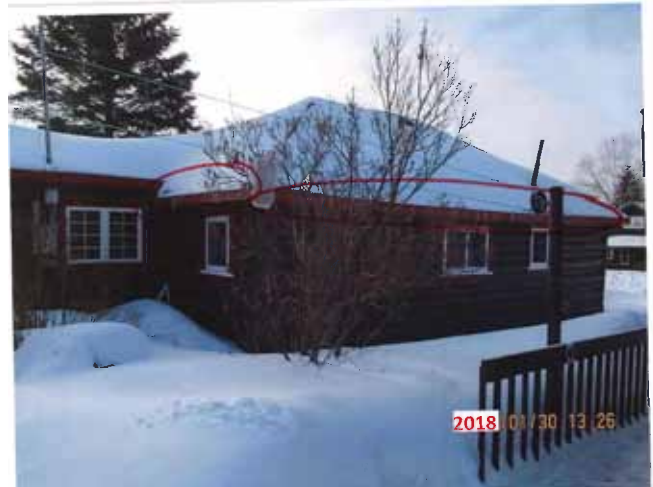
Figure 47 : Accumulation de neige sur le versant nord du 58, rue Marineau en janvier 2018. Photographie transmise par la ville de Val-d'Or.
