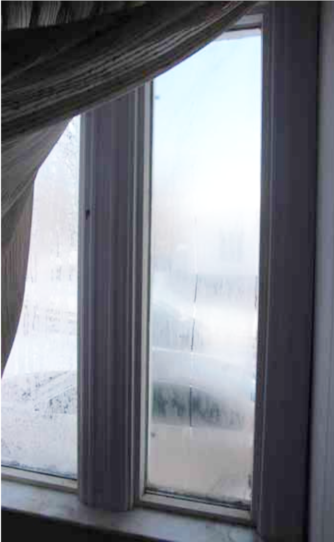
Figure 80 : De la condensation a été observée dans la plupart des vitres de fenêtres, et les cadres de fenêtre se sont détériorés à cause d'infiltrations d'eau.
