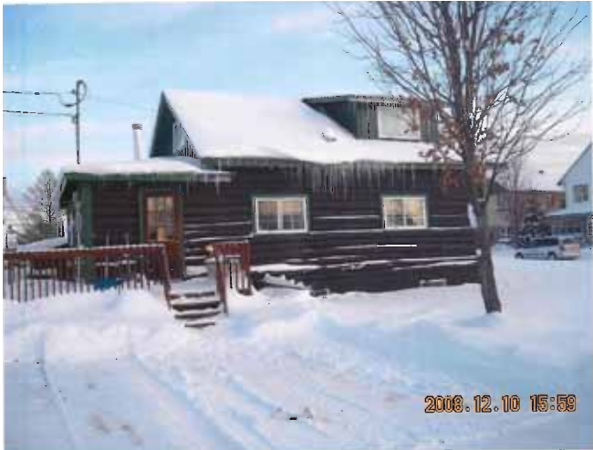
Figure 26 : Formation de digues de glace sur la toiture de l'annexe du 107, avenue Perrault en décembre 2008. Photographie transmise par la ville de Val-d'Or.
