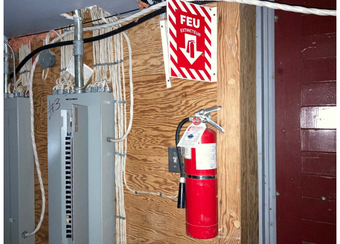
Figure 121 : Des extincteurs portatifs sont installés dans le bâtiment. Ils sont identifiés par des panneaux indicateurs.
