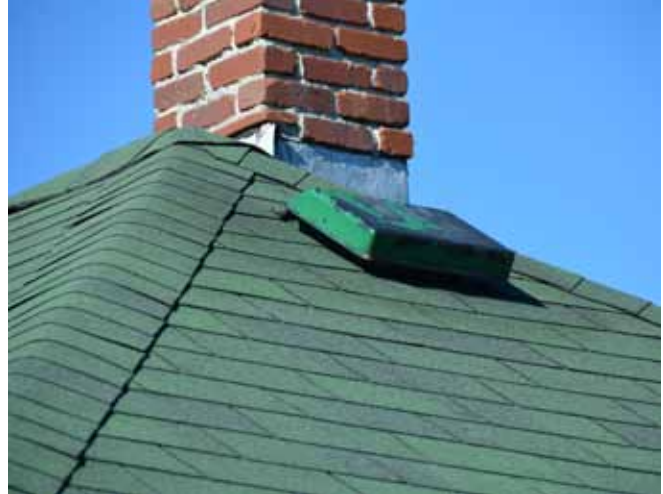
Figure 60 : Exemple de ventilateurs de toiture à profil bas sur la maison témoin située au 123, avenue Perrault.
