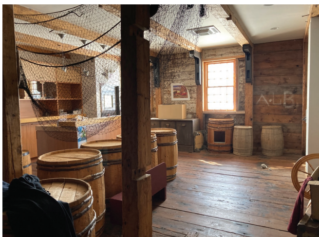
Figure 17 : Les planchers sont composés d'un platelage de bois déposés sur un système de poutres et de colonnes en bois.
