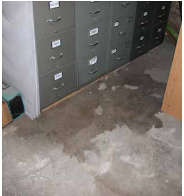
Fig. 16 : Dans la partie centrale du sous-sol, des cernes sur la dalle de béton sont signes de la présence d'humidité dans le sous-sol.
