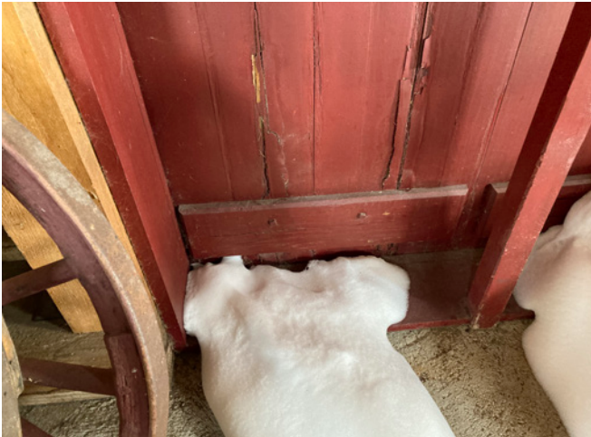
Figure 34 : La porte n'est pas étanche et laisse passer la neige.
