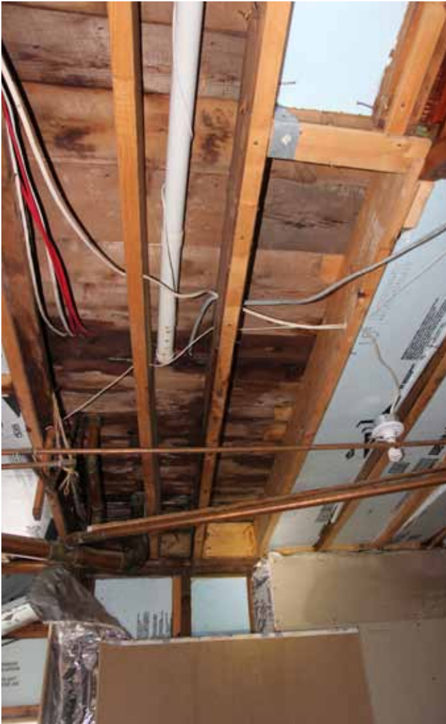
Figure 29 : Des cernes sont également visibles au rez-de-chaussée sur le platelage du plancher de l'étage.
