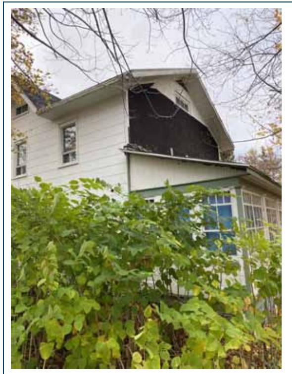
PHOTO 1 : Extérieur. Vue sur le revêtement détérioré et l'absence de gouttières.
