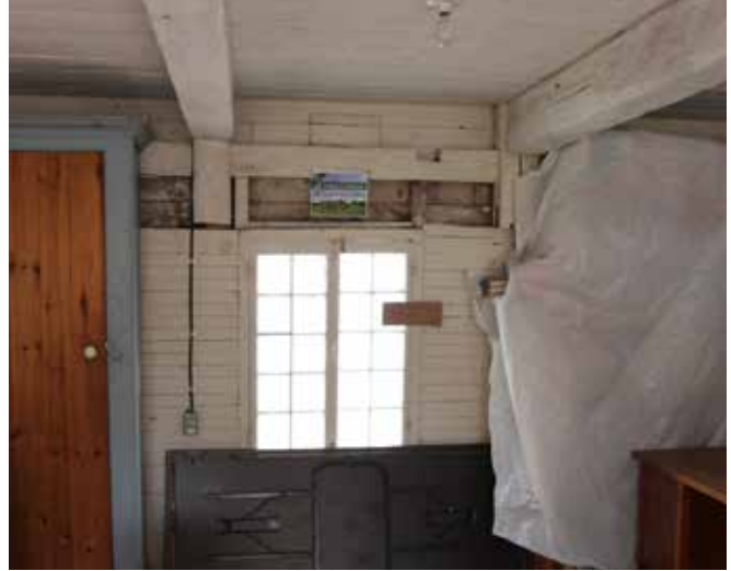
Fig. 55 : Sur la façade nord, des colonnes ont été sectionnées. Les poutres soutenant l'entretoit ne sont donc pas supportées adéquatement.
