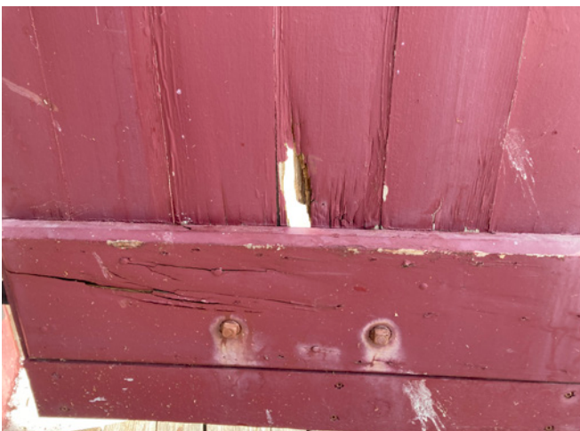
Figure 31 : Les portes sont abîmées et pourries dans leur partie basse.
