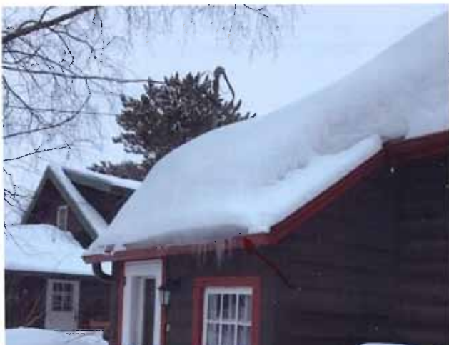
Figure 50 : Formation de digues de glace et accumulation de neige importante sur le versant arrière ouest du 61, rue Marineau. Photographie transmise par la ville de Val-d'Or.
