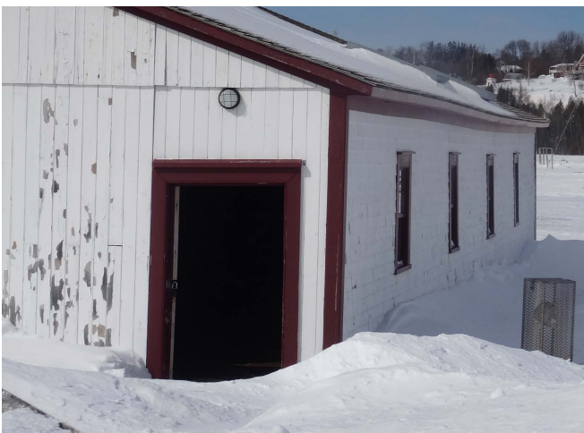
Figure 90 : Un luminaire en appliqué marin est installé au-dessus de la porte simple de la façade est.
