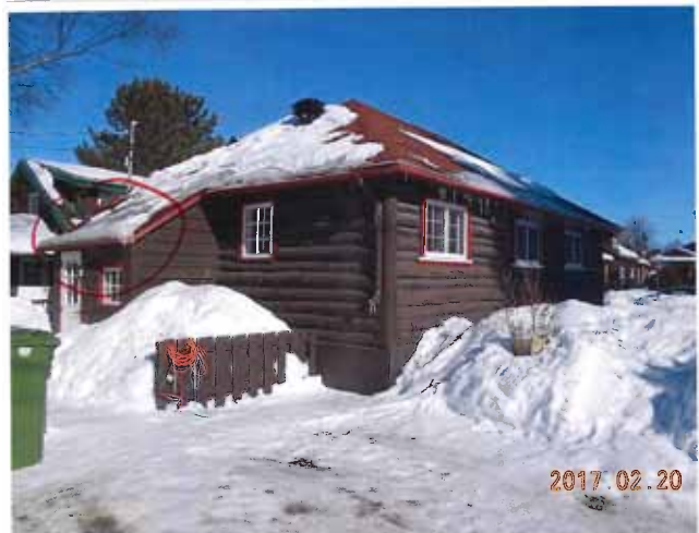
Figure 53 : Il se forme régulièrement des digues de glace à l'arrière du 61, rue Marineau, comme en témoigne cette photographie prise en février 2017. Photographie transmise par la ville de Val-d'Or.
