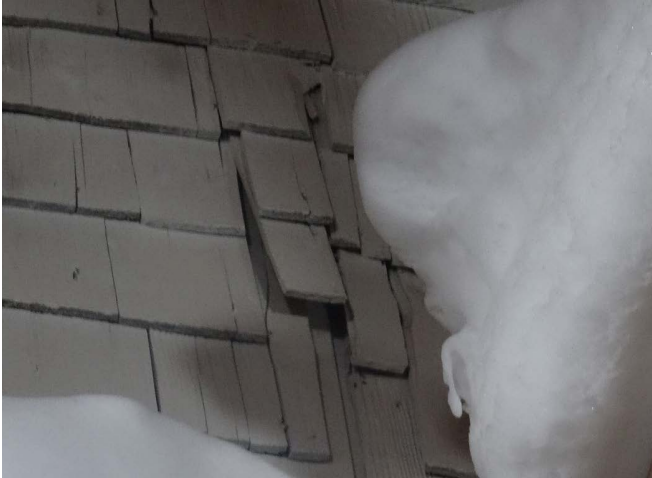
Figure 42 : Quelques bardeaux sont tout de même à remplacer.
