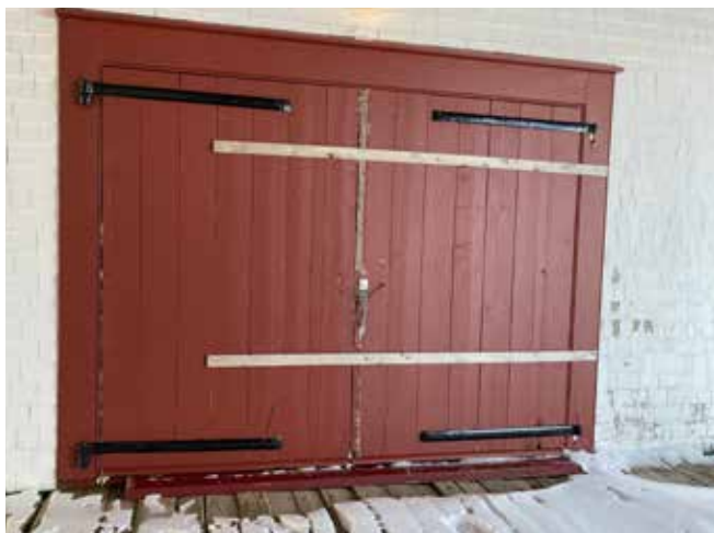
Figure 96 : L'une des portes est condamnée puisque sa quincaillerie est en mauvais état.
