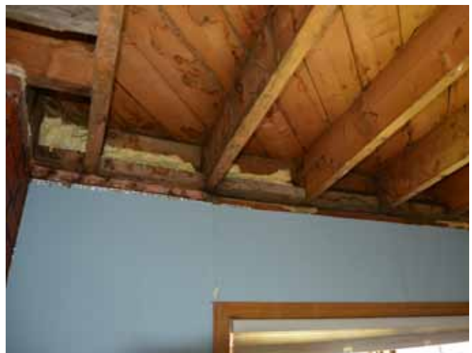
Figure 163 : Les propriétaires ont subi de gros dégâts d'eau à l'intérieur cet hiver qui ont fait tomber le plafond de leur cuisine située dans l'appentis à l'arrière.
