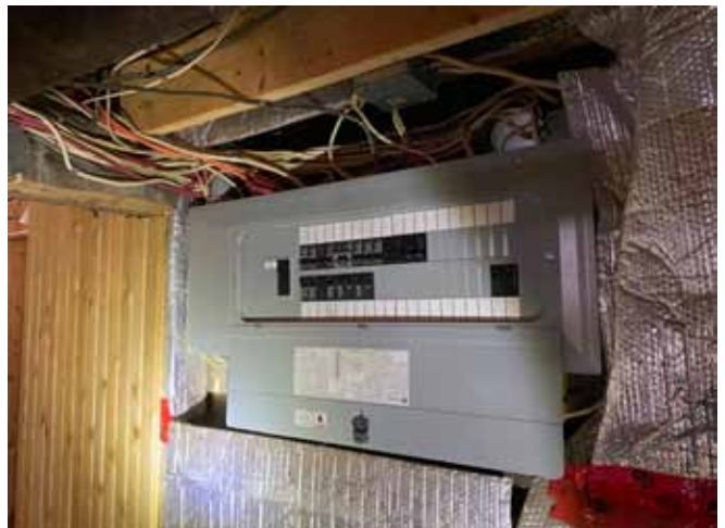
Figure 121 : Le panneau de distribution de la maison est situé au sous-sol.
