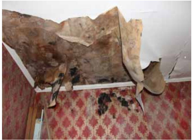
Figure 34 : Les planchers, murs, plafonds et les meubles présentent de la moisissure, et ce, à tous les étages.
