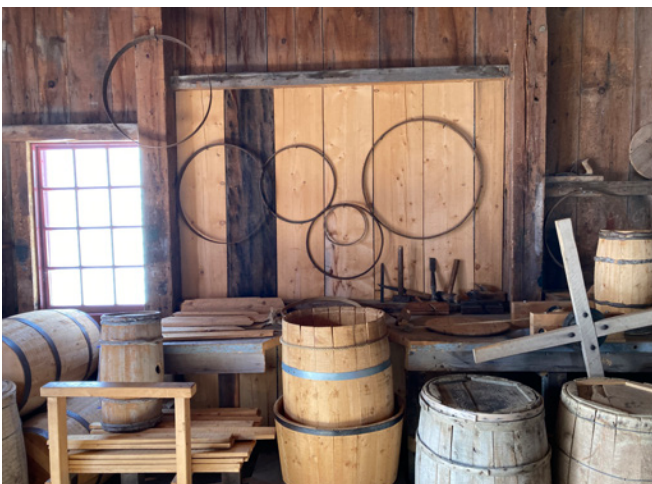
Figure 52 : Les murs intérieurs sont généralement en bon état. Ils sont en grande partie recouverts de planches de bois laissé à nu..
