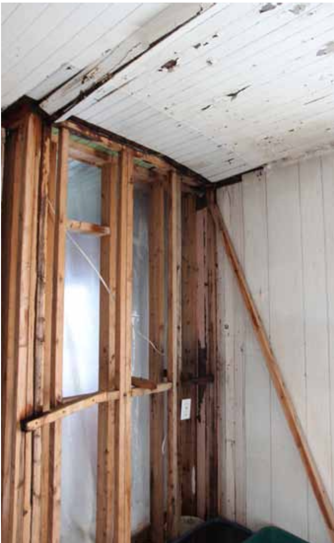
Figure 64 : Une cloison dépourvue de finition laisse apercevoir des montants de bois supportant une lisse haute.
