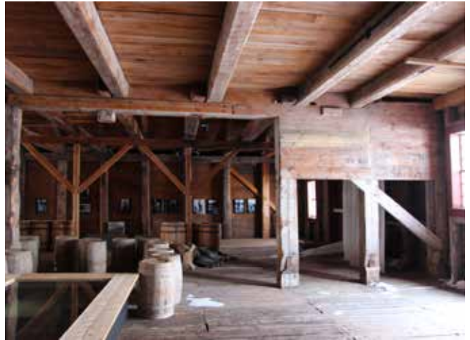
Figure 33 : Les planchers sont composés d'un platelage de bois déposés sur un système de poutres et poutrelles. Des colonnes de bois soutiennent les poutres principales.
