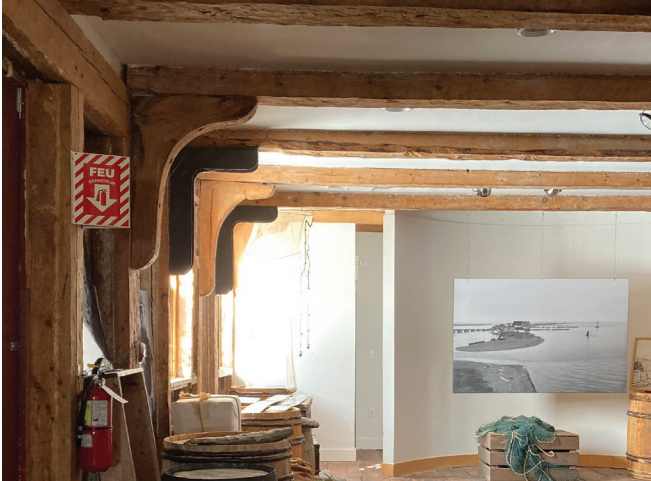
Figure 25 : Sur les murs extérieurs, des consols de bois assurent la stabilité du système de poutres et de colonnes
