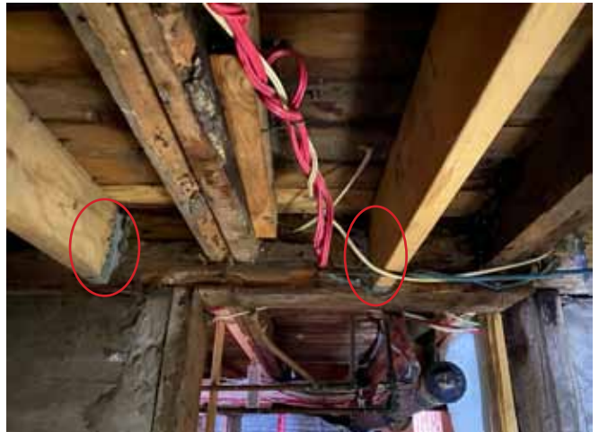
Figure 24 : À plusieurs endroits au sous-sol, les solives d'origine ont été renforcées par l'ajout de solives modernes (2 x 12). Ces solives modernes sont fixées à la solive de rive par des étriers métalliques.
