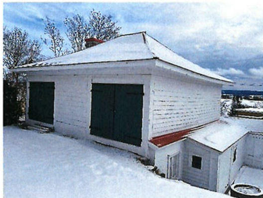
Photo #25 INTERVENTION #10 Façade arrière / latérale gauche Bases de bois sous portes à réparer car pourries.
