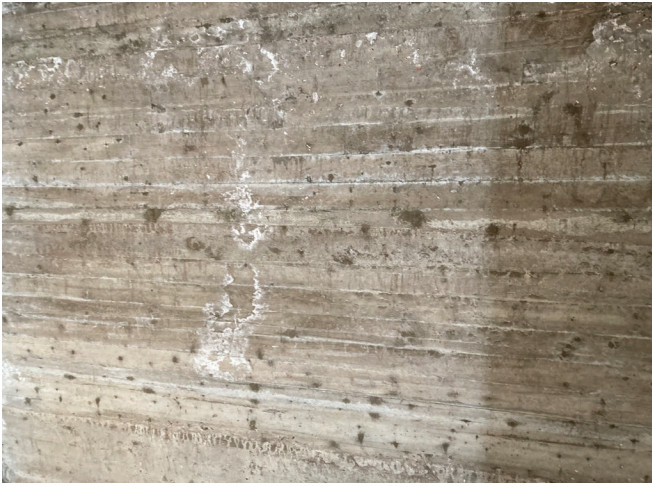
Figure 29 : Des traces du coffrage utilisé pour aménager le coffre-fort dans l'Office Robin sont visibles.
