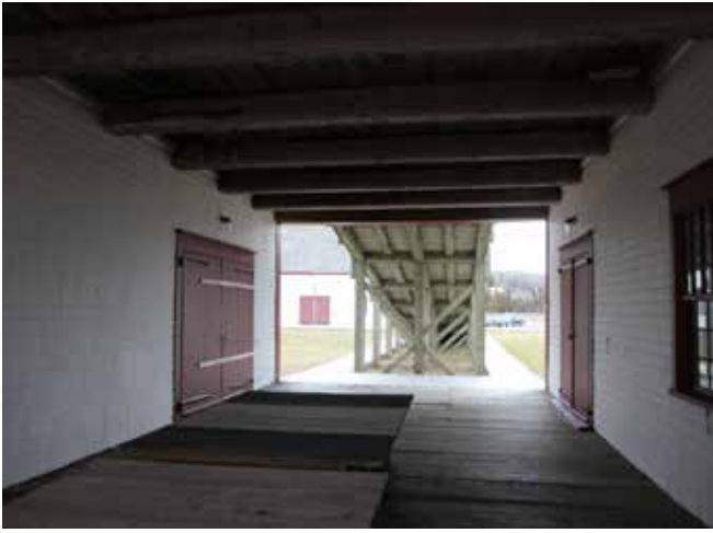
Figure 50 : Le plancher du corridor est construit de bois laissé à nu qui est généralement en très bon état. Le plancher est protégé par le toit du corridor qui le protège des intempéries.
