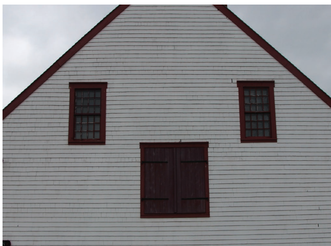
Figure 47 : Une porte double de chargement donne accès à l'étage sur la façade pignon est.
