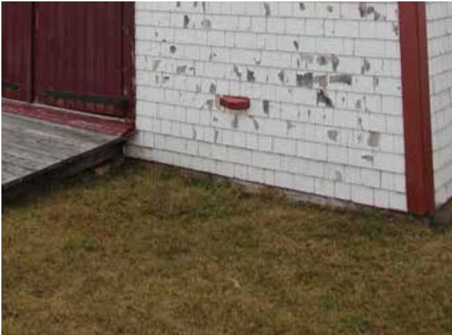
Figure 14 : La semelle de béton des fondations est visible de l'extérieur. Le périmètre du bâtiment est entouré de gazon.
