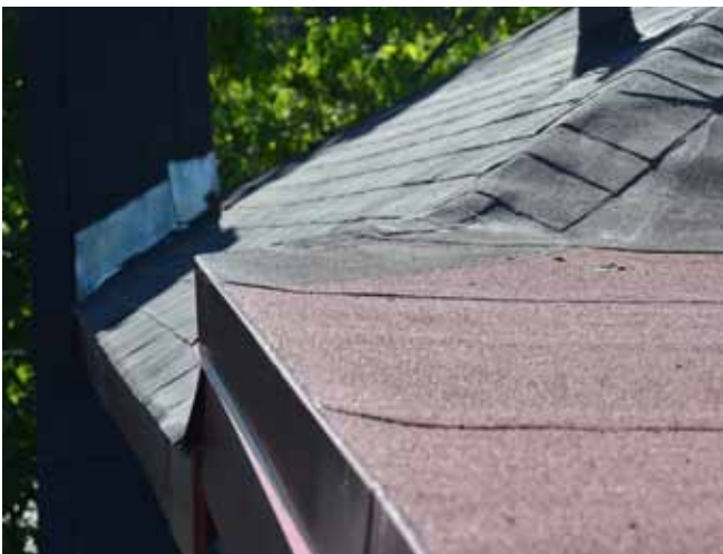
Figure 75 : La toiture a été modifiée pour augmenter la hauteur de l'espace habitable à l'intérieur, faisant en sorte que la toiture de l'annexe dépasse la hauteur de l'égout de la toiture de la maison.
