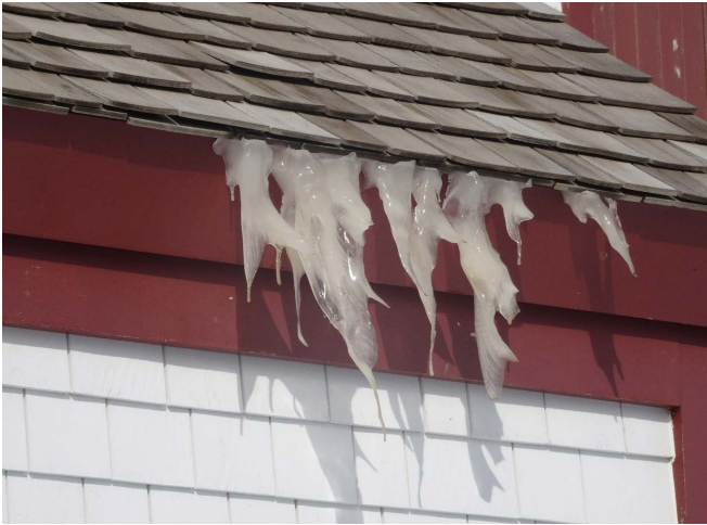
Figure 78 : En hiver, la toiture de la cookroom condense et de grands glaçons se forment du côté sud-est du bâtiment.
