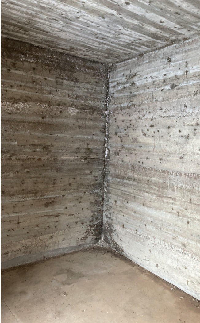
Figure 33 : Le dessous en béton du toit plat constitue la finition intérieure du plafond. Des traces d'infiltrations d'eau sont visibles en périphérie.
