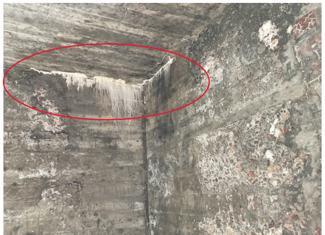
Figure 19 : Lors de la visite d'expertise, des cernes et de la glace sur la partie supérieure des murs intérieurs témoignent des infiltrations d'eau de la toiture.
