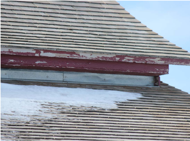
Figure 46 : De façon générale, les larmiers sont en bon état, mais doivent être restaurés et peints puisque la peinture se soulève en plusieurs endroits.
