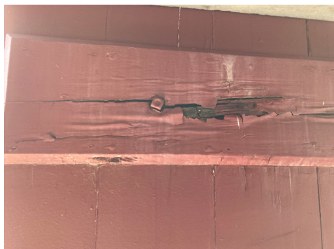
Figure 41 : La peinture s'écaille sur les portes et la porte principale et les portes de chargement sont pourries par endroit.
