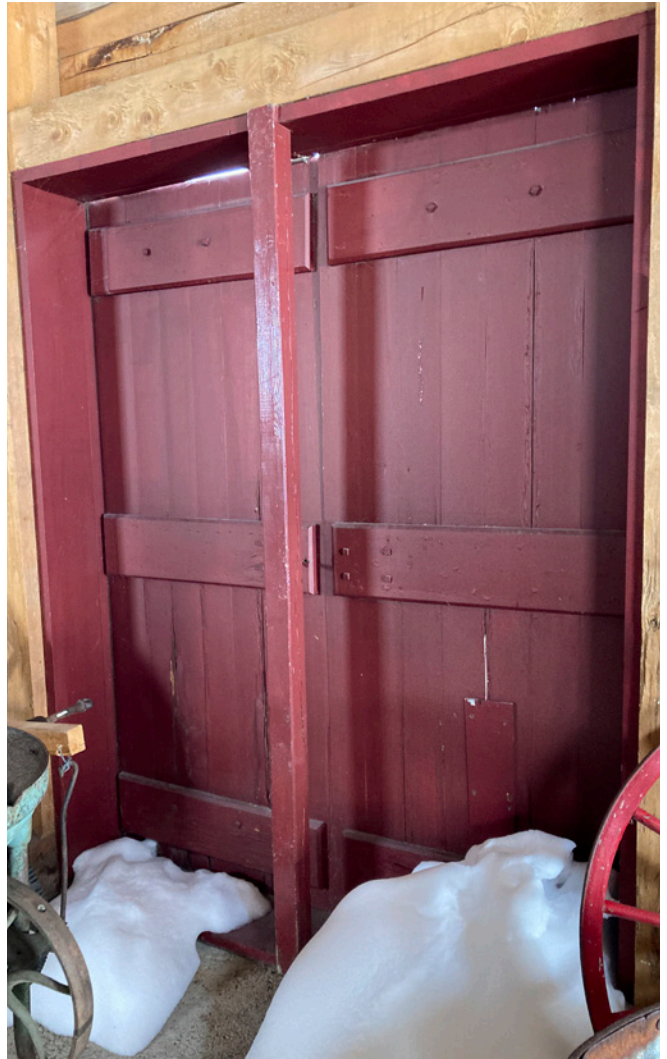
Figure 35 : La porte n'est pas étanche et laisse passer la neige.
