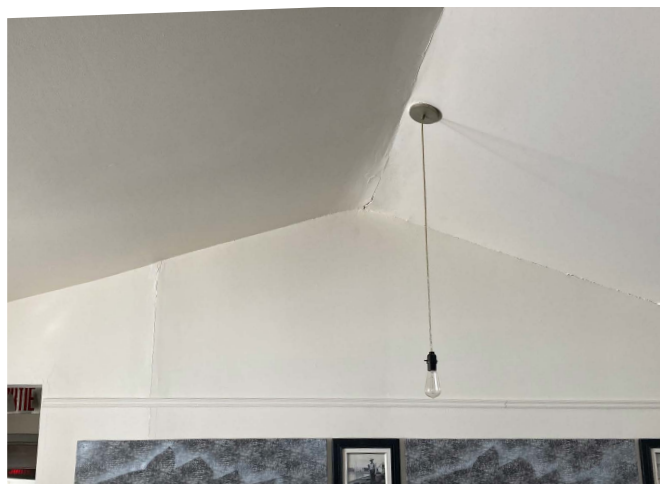
Figure 109 : Les finis de gypse dans la salle à manger sont fissurés.
