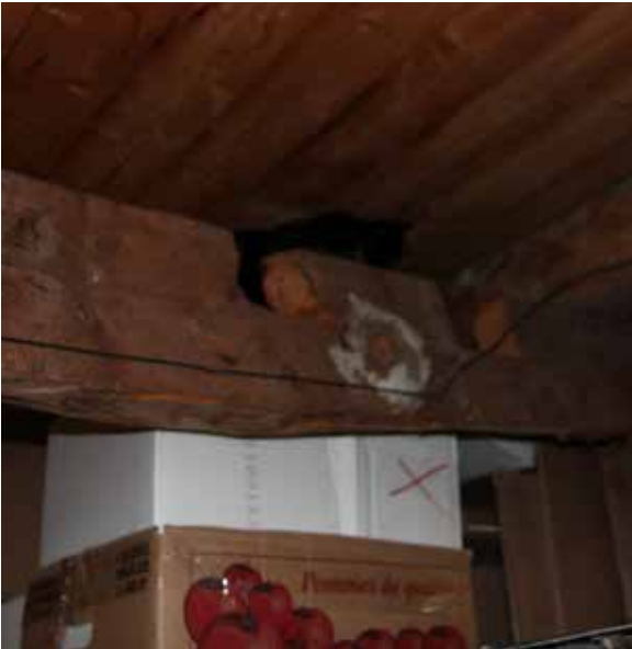
Fig. 13 : Les grumes et les poutres en bois récupérés ont parfois été transpercées sans être renforcées.
