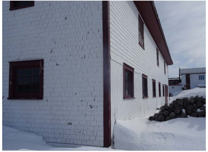
Figure 39 : La façade ouest de l'appentis, et la partie basse de la façade sud du volume principal sont recouverts de planches verticales. La peinture sur les planches s'écaille.
