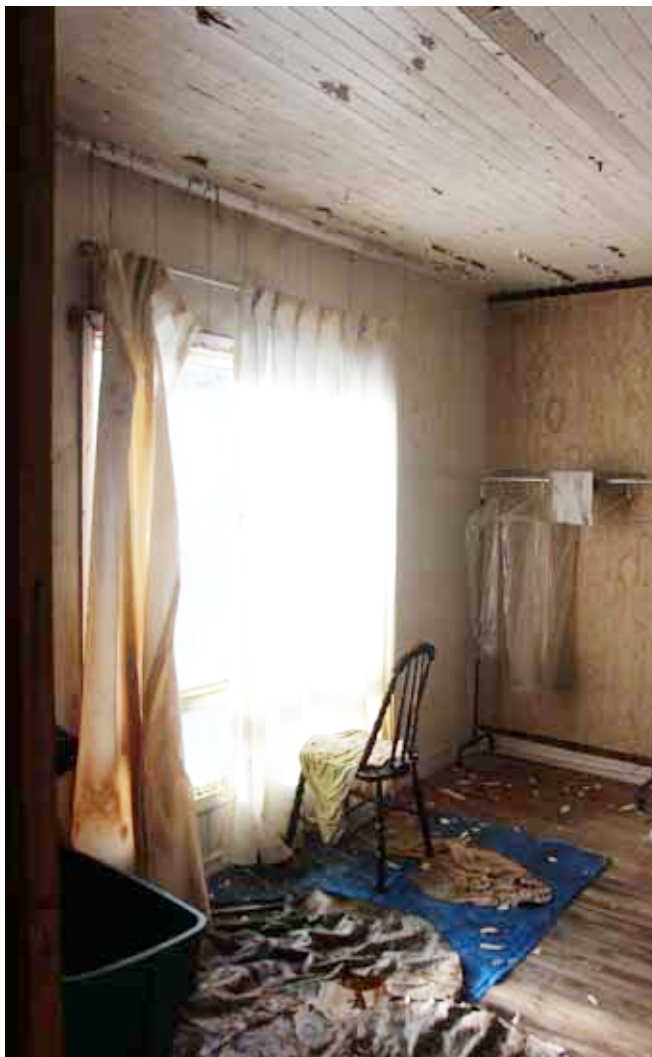
Figure 116 : Les plafonds de plusieurs pièces à l'étage sont recouverts d'un lambris de bois peint. La peinture sur les lattes de bois au plafond est généralement écaillée et ce dans la plupart des pièces.
