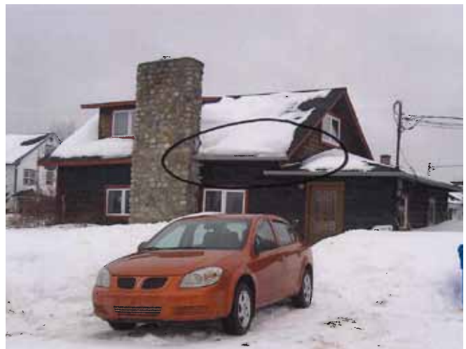
Figure 119 : Formation de digues de glace à l'arrière de la maison avant les travaux d'isolation par l'intérieur. Photographie transmise par la ville de Val-d'Or.
