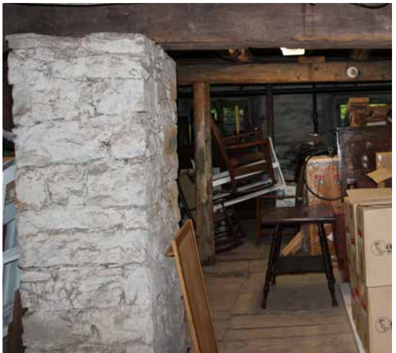
Fig. 12 : Les joints de maçonnerie des colonnes en pierre sont partiellement évidés.
