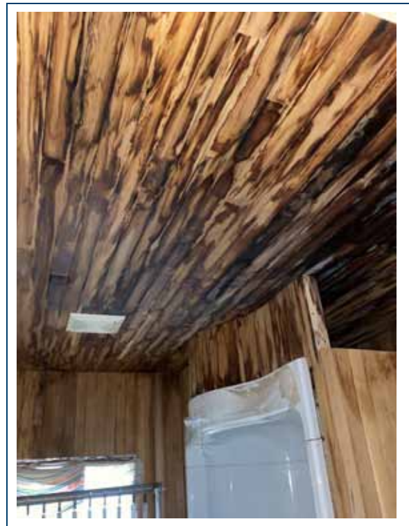
PHOTO 8 : 1 er étage, salle de bain. Vue sur le plafond et les murs affectés par l'eau.
