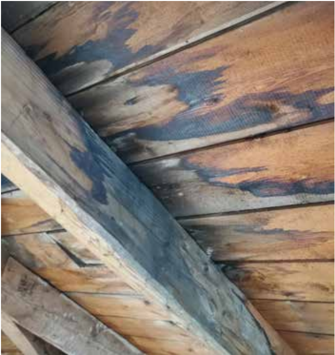
Fig. 40 : Depuis l'entretoit, des traces d'infiltration d'eau sont visibles sur les pièces de bois.
