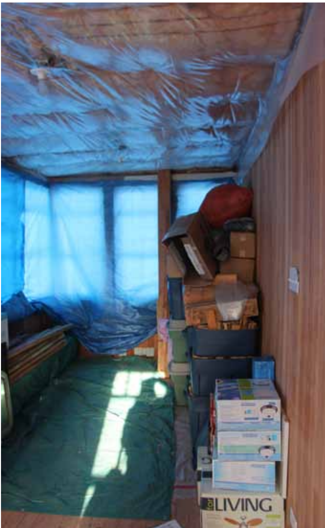
Figure 57 : De grandes bâches sont tendues sous le plafond et devant les fenêtres de la véranda en raison de défauts d'étanchéité.
