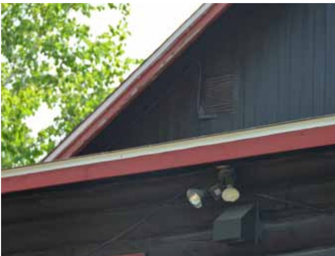
Figure 149 : Des grilles de ventilation ont été aménagées dans les pignons.
