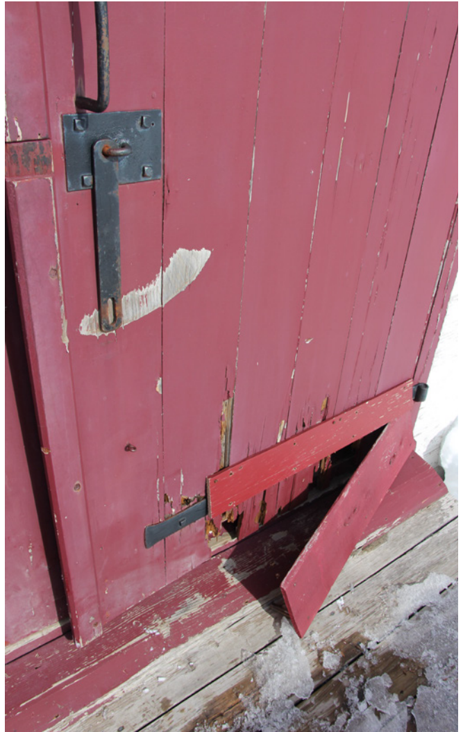
Figure 43 : La peinture s'écaille sur les portes et la porte principale et les portes de chargement sont pourries par endroit.
