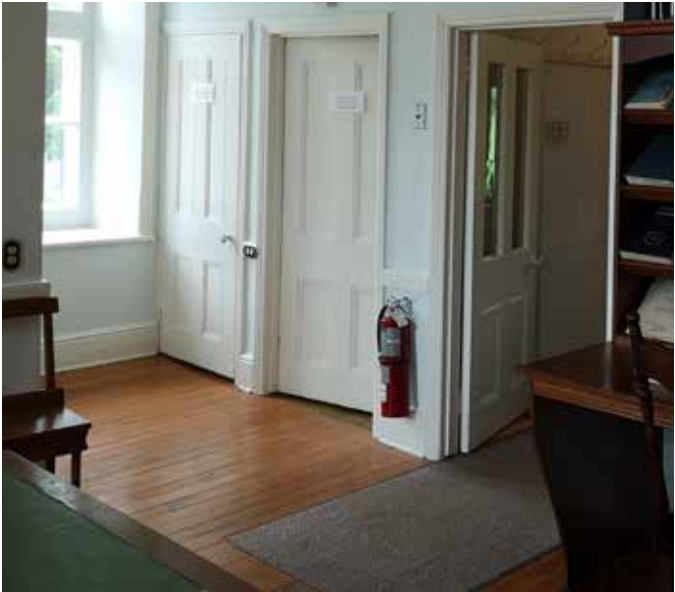
Fig. 114 : L'édifice est muni d'extincteurs portatifs.
