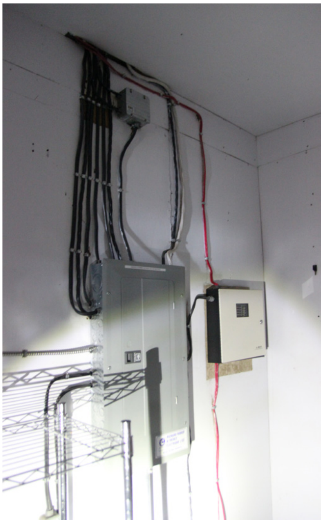
Figure 64 : Les panneaux de distribution sont situés dans la partie arrière du bâtiment.
