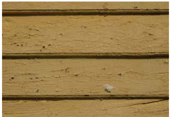
Fig. 20 : Le mur extérieur sud est revêtu de clin de bois. Le parement est encore en très bon état mais doit être restauré.
