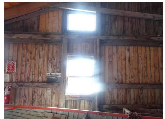
Figure 37 : Le platelage vertical recouvrant la structure des murs de l'appentis est visible depuis l'intérieur.
