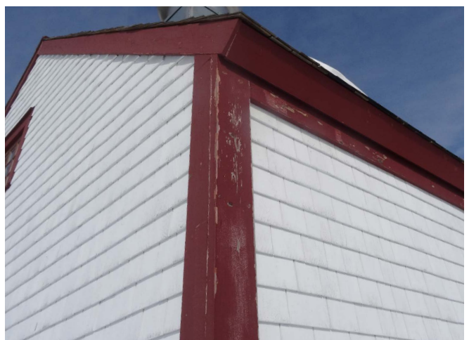
Figure 37 : La peinture des planches cornières est en mauvais état, mais les planches sont en bon état.
