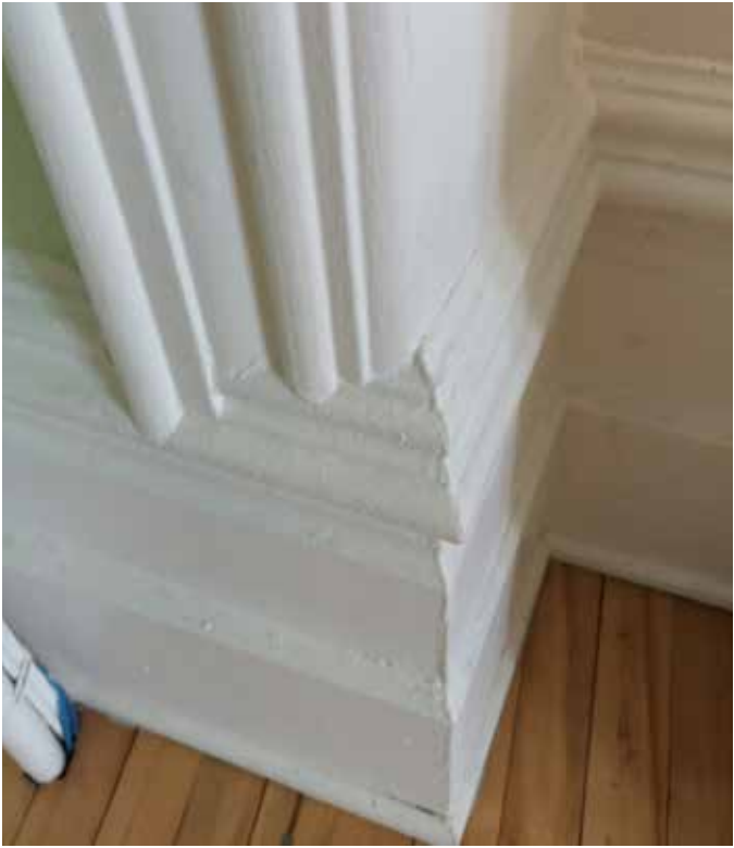
Fig. 79 : Les cloisons intérieures présentent des moulures de bois d'origine qui contribuent à la qualité des espaces.
