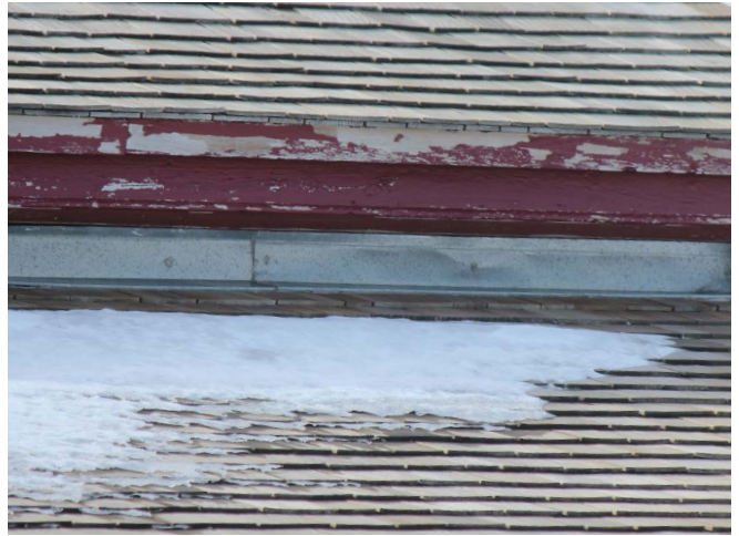
Figure 77 : Un solin métallique assure l'étanchéité entre la toiture de l'appentis et le mur nord du volume principal.
