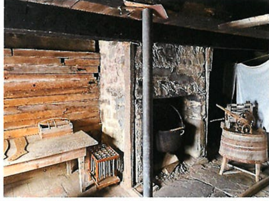
Photo #2 La structure du bâtiment est en bois pièce sur pièce majoritairement. Les poutres sont en bois brute partout. Dans ce bâtiment, on retrouve une seule colonne en acier pour le support du plancher de l'étage et le reste de la structure est en bois.
