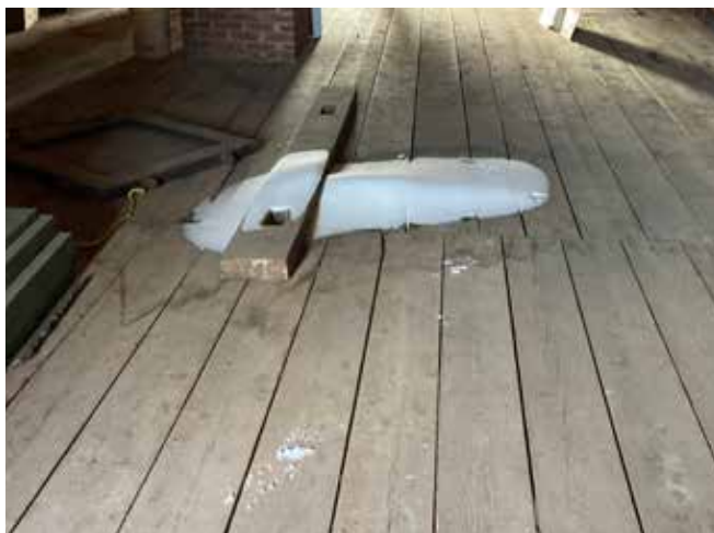
Figure 43 : Lors de la visite d'expertise, de la neige et des cernes ont été observés sur le plancher de l'entretoit, sous la trappe.
