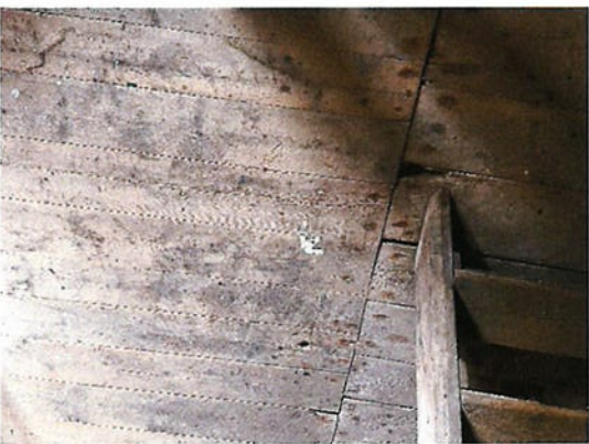
Photo #5 Le plancher est en planche de bois, il est construit sur un vide sanitaire de \pm 14'' de hauteur. Nous constatons un peu d'instabilité au niveau du plancher. Cependant, aucune intervention n'est à prévoir, vue le mode de construction de l'époque.
