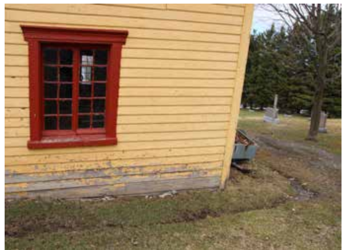
Fig. 14 : Les éclaboussures de l'eau tombant du toit ont abîmé la peinture du clin de bois. Ce qui justifie l'ajout d'un lit de propreté autour des fondations et un système de gouttières au bâtiment.
