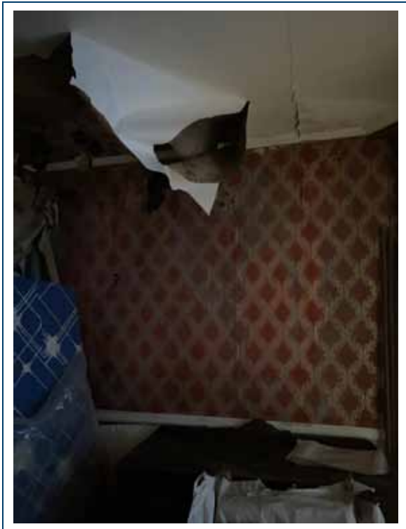
PHOTO 12 : Rez-de-chaussée. Vue sur le plafond affecté par l'eau.
