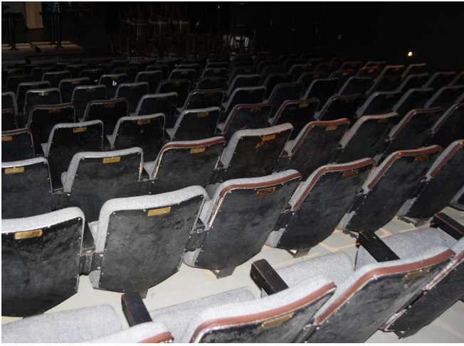
Figure 140 : De la moisissure est visible sur le dos des sièges de la salle de spectacle.
