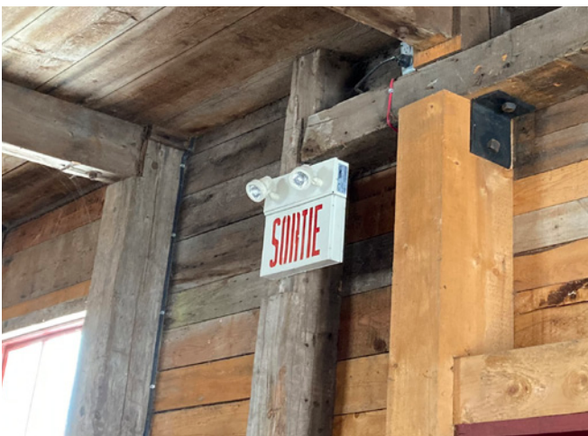
Figure 44 : Les portes d'issues sont surmontées de panneaux de sortie lumineux.
