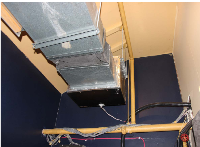
Figure 115 : Des conduits de ventilation sont dispersés dans le bâtiment et visibles depuis la loge.
