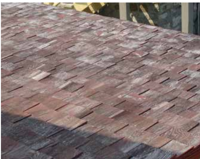
Fig. 46 : La toiture de l'appentis est recouverte de bardeaux de cèdre. Les bardeaux sont en bon état mais doivent être repeints.
