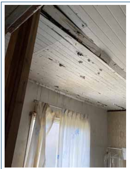
PHOTO 6 : 1 er étage. Vue sur la peinture qui s'écaille au plafond et l'état de détérioration du bois. Des cernes sont visibles sur les panneaux de préfini du mur.
