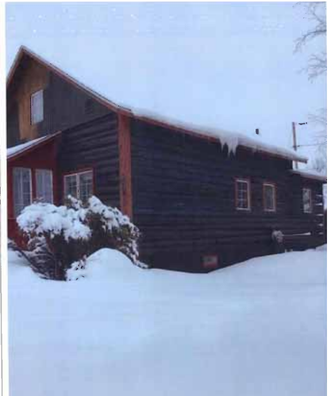
Figure 173 : Formation de digues de glace sur le versant est de la toiture en mars 2022. Photographie transmise par la ville de Val-d'Or.
