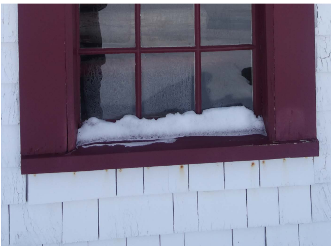
Figure 44 : Les clous corrodés percent parfois la peinture blanche des bardeaux.
