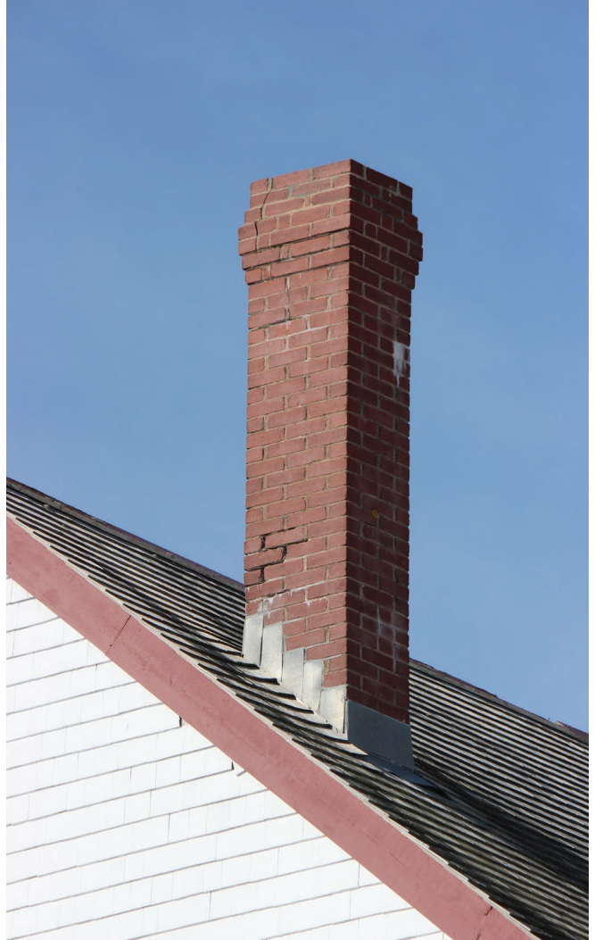
Figure 63 : Du côté extérieur certains joints de mortier sont fissurés et la cheminée se déforme.
