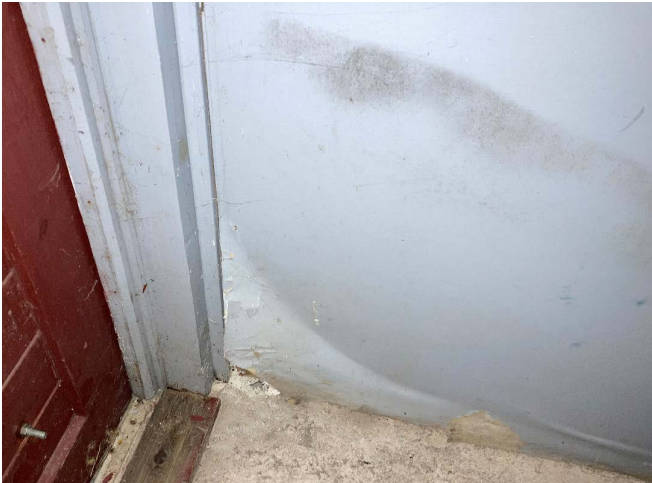
Figure 96 : Les murs de l'appentis ouest sont recouverts de gypse peint. A certains endroits, surtout près de la porte sud, des traces d'infiltration d'eau sont visibles sur les murs.
