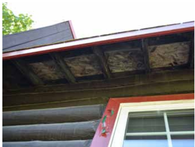
Figure 64 : Les chevrons dépassent des murs d'environ 18". Les soffites sont en partie recouverts de panneaux d'OSB, surtout du côté nord.
