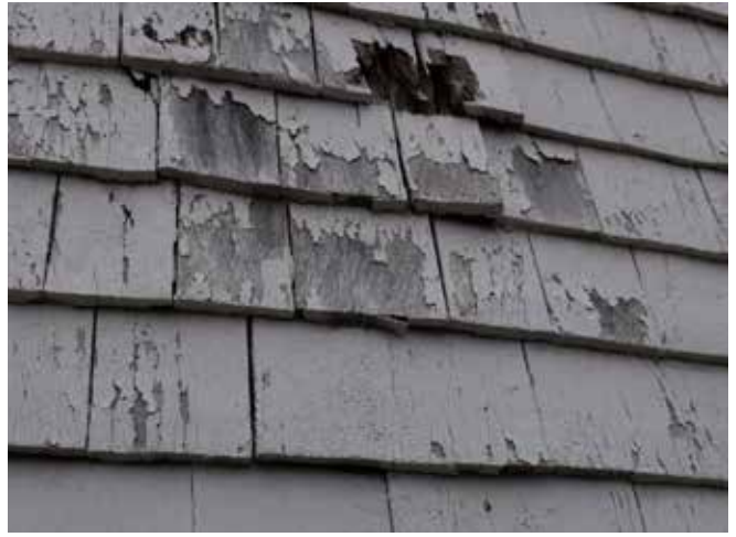
Figure 67 : La peinture est aujourd'hui en mauvais état.
