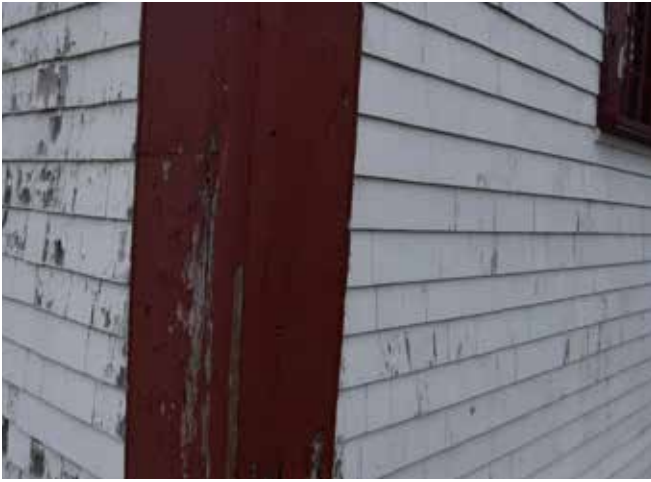
Figure 74 : Des planches cornières ornent le bâtiment. La peinture des planches cornières est en mauvais état et certaines planches sont parfois pourries.
