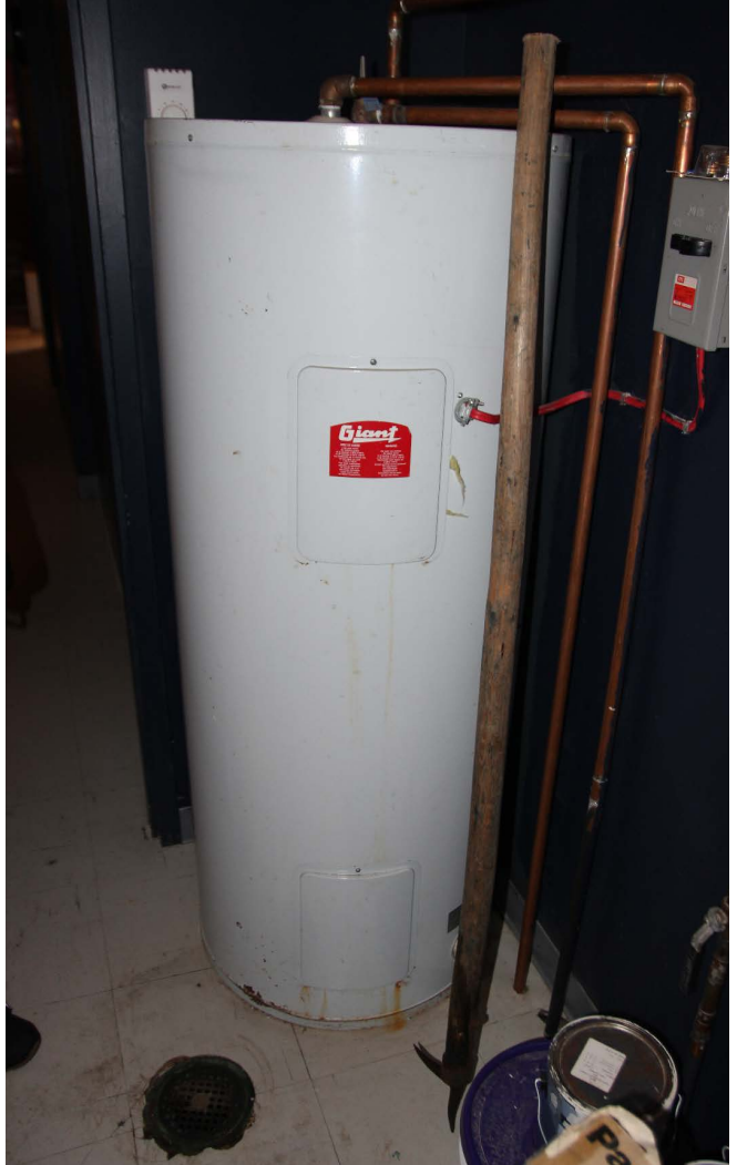
Figure 116 : Un chauffe-eau est installé dans la loge.
