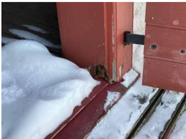
Figure 89 : Le cadre et le seuil de la porte principale située au bout de la rampe de chargement sont pourris.
