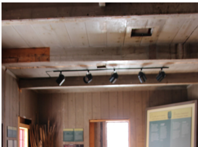
Figure 66 : Un système d'éclairage sur rail est installé au plafond du rez-de-chaussée.
