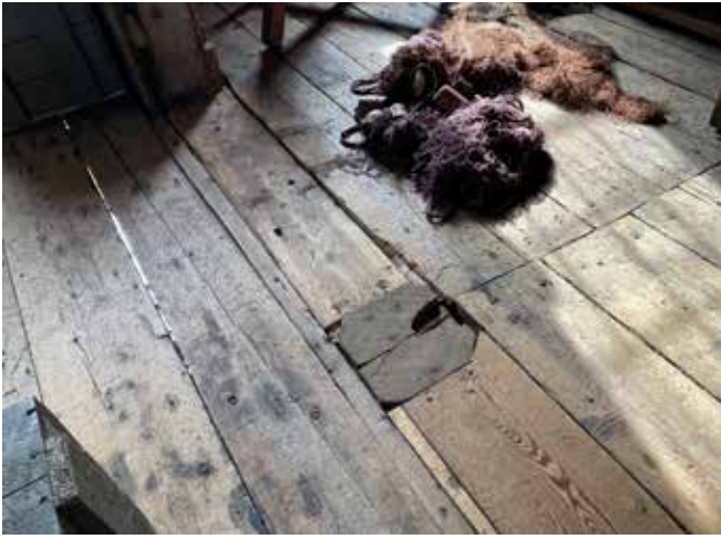
Figure 38 : Le plancher de l'étage a été modifié pour l'accès à la rampe de chargement. Les pièces de structure qui ont été sectionnées sont toujours visibles.
