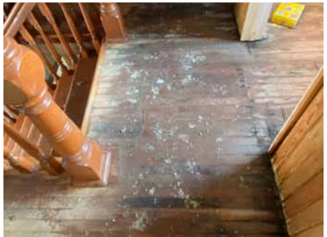
Figure 115 : Les planchers sont recouverts de parquet de bois posé sur le platelage d'origine. Les planchers sont en mauvais état. Ils sont tachés et cernés à cause des infiltrations d'eau.
