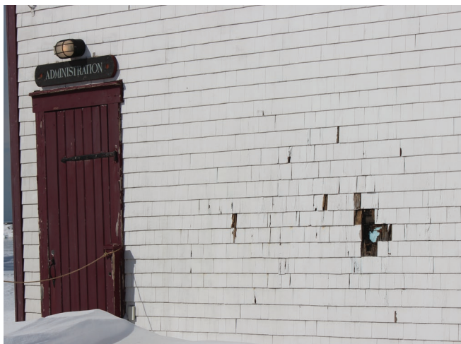
Figure 30 : La peinture est en mauvais état. Plusieurs bardeaux sont pourris et doivent être remplacés.
