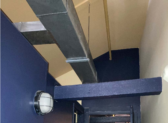
Figure 114 : Des conduits de ventilation sont dispersés dans le bâtiment et visibles depuis la loge.
