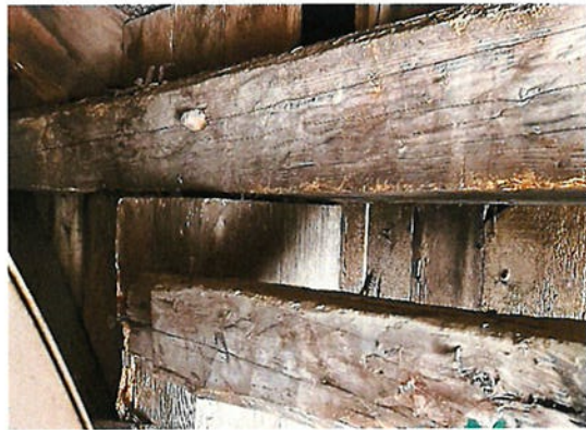
Photo #23 INTERVENTION #4 La poutre ne s'appuie pas sur la colonne, prévoir renforcer la structure en insérant des cales d'acier non-
