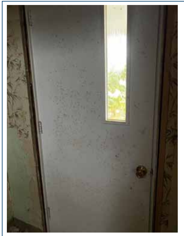
PHOTO 13 : Rez-de-chaussée. Des taches sont visibles sur la porte d'entrée.
