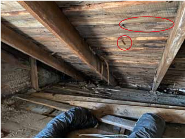
Figure 47 : Des cernes sur les éléments en bois de la charpente témoignent d'infiltrations d'eau.
