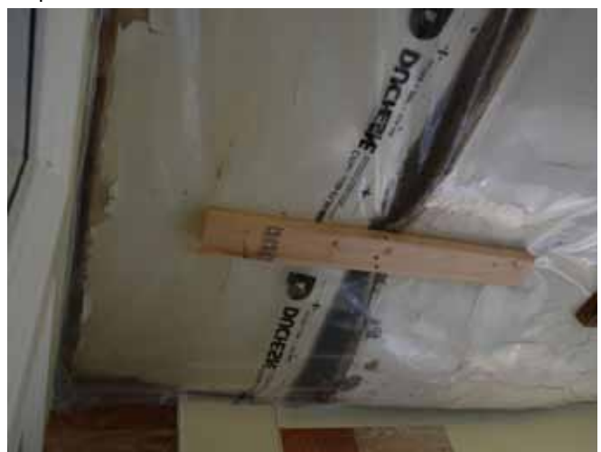
Figure 157 : Les propriétaires ont subi de gros dégâts d'eau à l'intérieur cet hiver qui ont fait tomber le plafond de leur cuisine située dans l'appentis à l'arrière.
