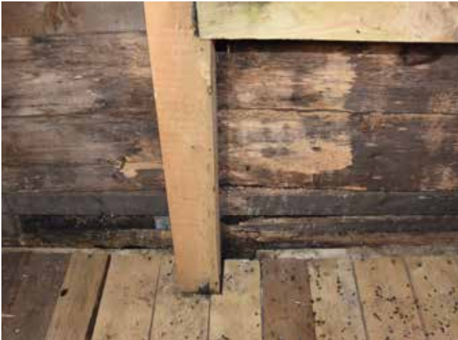
Figure 60 : Certaines pièces de la structure de bois ont été remplacées lors de travaux de restauration.
