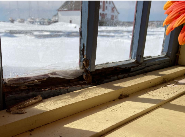
Figure 48 : Les meneaux et cadre de certaines fenêtres de l'appentis sud sont pourris.
