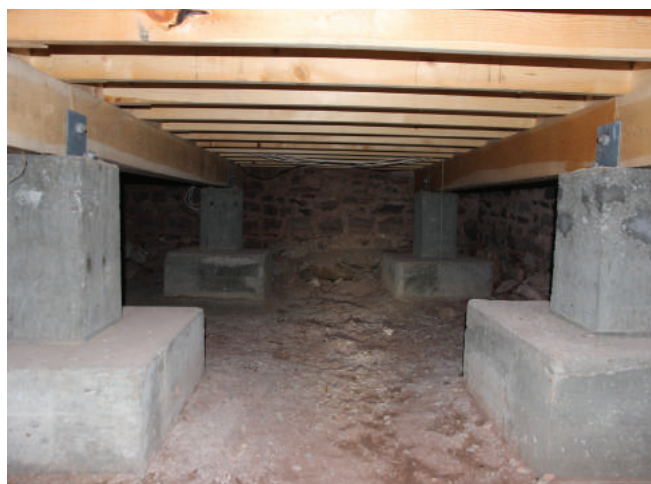
Figure 19 : Le plancher du rez-de-chaussée est composé d'un platalage de bois déposé sur des solives de bois reposant sur des piliers de béton.
