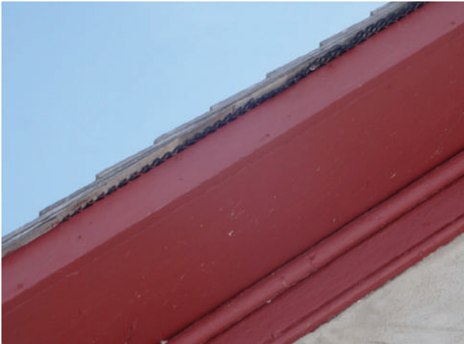
Figure 51 : À certains endroits, du lichen s'est installé sur le revêtement. Quelques bardeaux sont retroussés parfois dans le sens de la largeur parfois dans le sens de la longueur.
