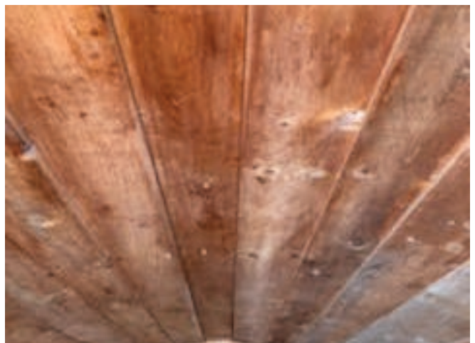
Figure 39 : La voûte en brique du bâtiment est recouverte de planches de bois qui sont en bon état. Photo transmise par le client.
