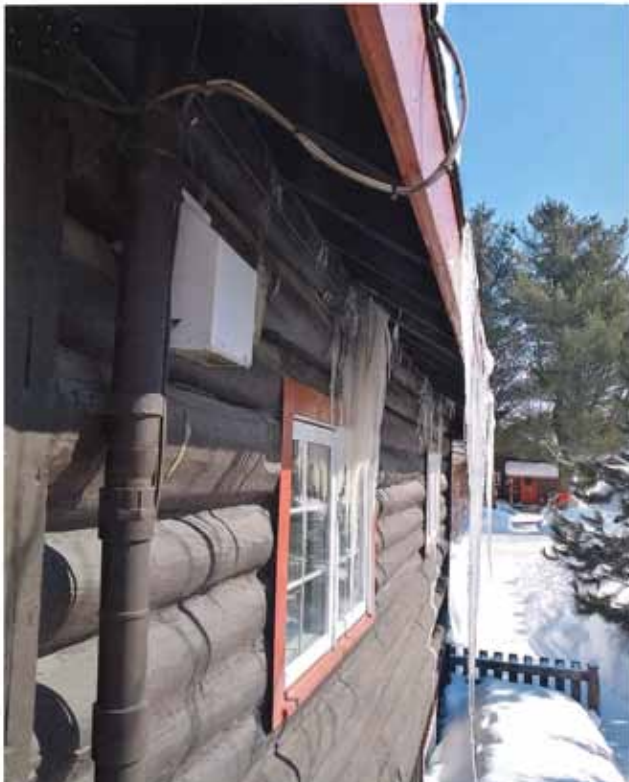
Figure 81 : Diges de glace formées sur la toiture durant l'hiver 2021-2022. Photographie transmise par le propriétaire à la Ville de Val-d'Or.
