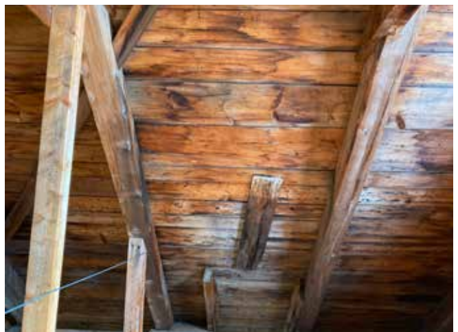
Figure 57 : Des traces d'infiltration d'eau sont visibles sur la face intérieure du platelage de la toiture. Ces infiltrations ne semblent toutefois plus actives.
