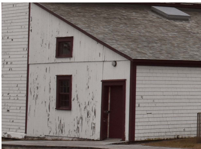
Figure 64 : Une porte simple située sur la façade est donne accès à l'appentis.
