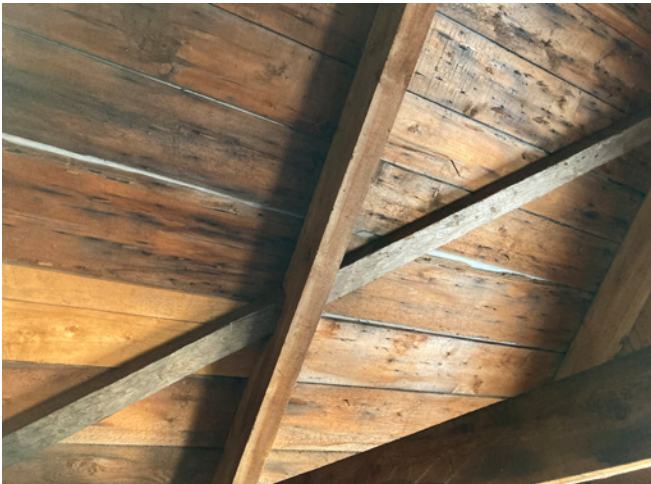
Figure 22 : Des pièces de bois posées à la diagonale contreventent l'ensemble. Lors des travaux de restauration, le revêtement de toiture a été installé sur une membrane visible entre les planches du platelage depuis l'entretoit.
