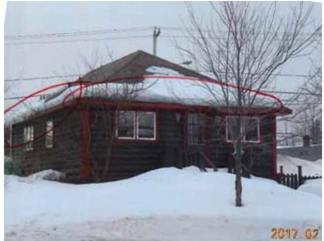
Figure 37 : Maison de type E. 138, avenue Perrault. Formation de digues de glace sur le versant nord en février 2017. Photographie transmise par la ville de Val-d'Or.
