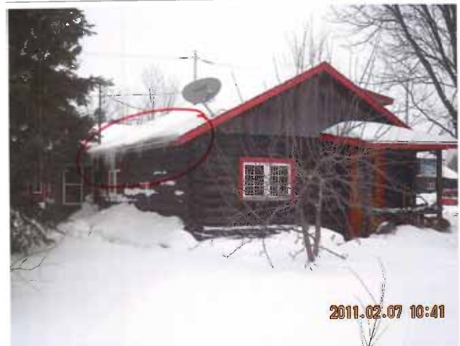
Figure 137 : Photographie prise en février 2011 montrant la formation de digue de glace du côté sud-ouest. Photographie transmise par la ville de Val-d'Or.
