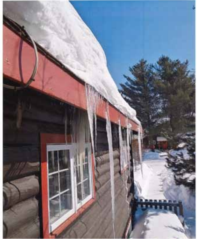
Figure 80 : Diges de glace formées sur la toiture durant l'hiver 2021-2022. Photographie transmise par le propriétaire à la Ville de Val-d'Or.
