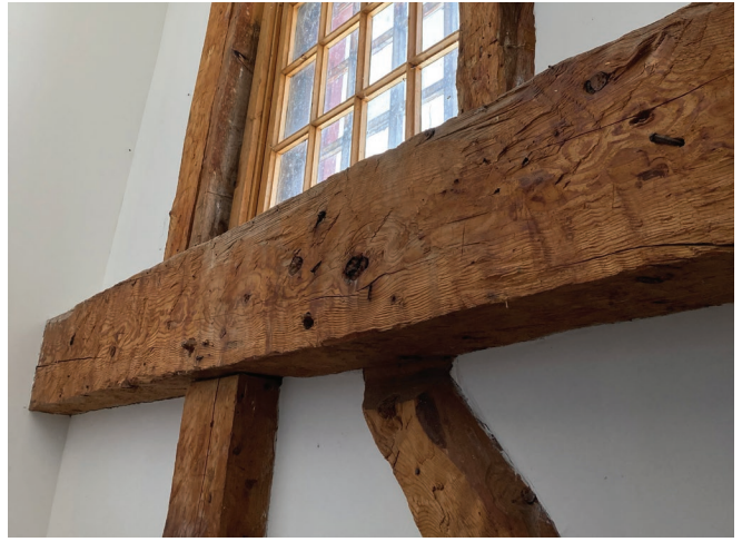
Figure 22 : La structure du bâtiment est composée de poutres et de colonnes de bois assemblées avec des chevilles de bois.
