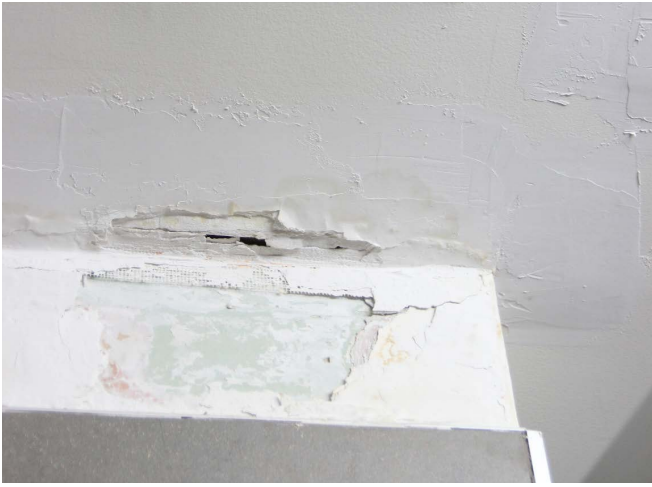
Figure 110 : Les finis de gypse dans la salle de toilette sont aussi abîmés.
