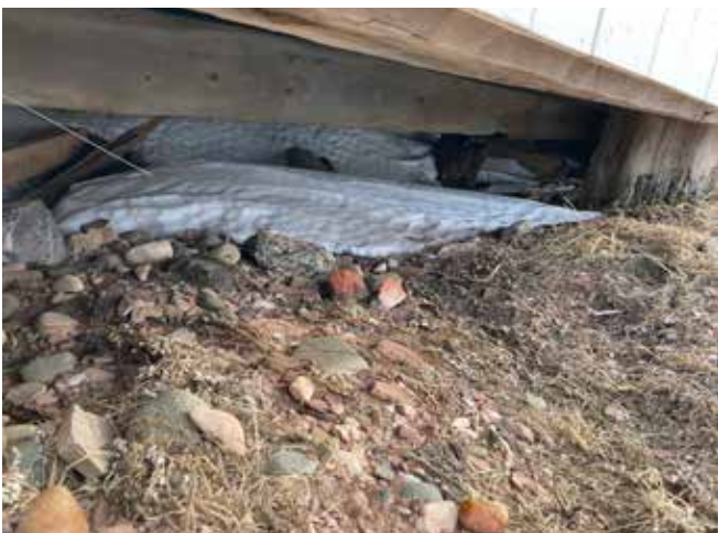
Figure 28 : Dans le vide sanitaire, le sable est parfois entassé sur la structure du plancher.
