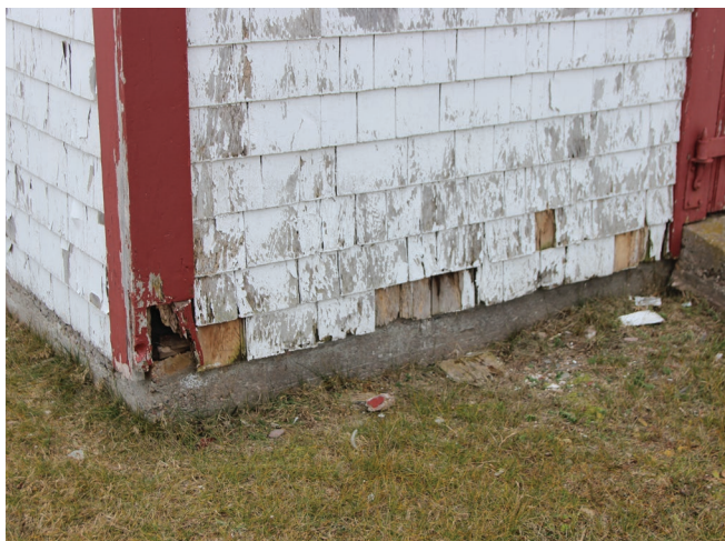
Figure 21 : Certains bardeaux sont brisés ou sont tombés. La peinture des planches cornières en bois peint en rouge est très écaillée et le bois est fissuré près du sol.
