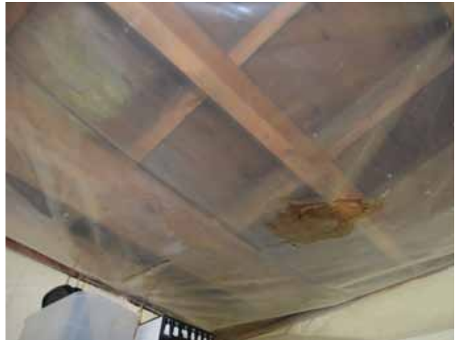
Figure 161 : Les propriétaires ont subi de gros dégâts d'eau à l'intérieur cet hiver qui ont fait tomber le plafond de leur cuisine située dans l'appentis à l'arrière.
