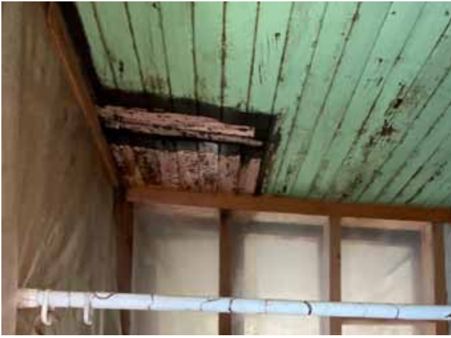
Figure 118 : Les lattes au plafond de la salle de bain à l'étage sont également pourries.
