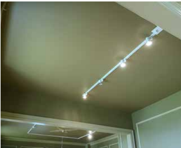
Fig. 123 : L'éclairage intérieur du bâtiment est assuré par des rails d'éclairage
