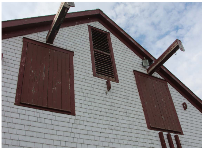
Figure 69 : Les deux portes de chargement à doubles vantaux localisées sur la façade est du volume principal sont en bon état, mais doivent être restaurées et peintes.
