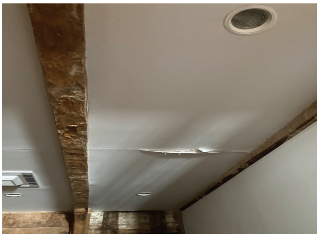
Figure 84 : Les plafonds du rez-de-chaussée et de l'étage sont composés de panneaux de gypse peint blanc installés entre les poutres de bois. A certains endroits, les finis sont fissurés.
