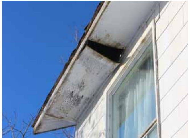
Figure 69 : Les larmiers sont en mauvais état, surtout ceux du corps principal. La peinture est largement écaillée. Le bois est déformé et présente des traces de moisissures.
