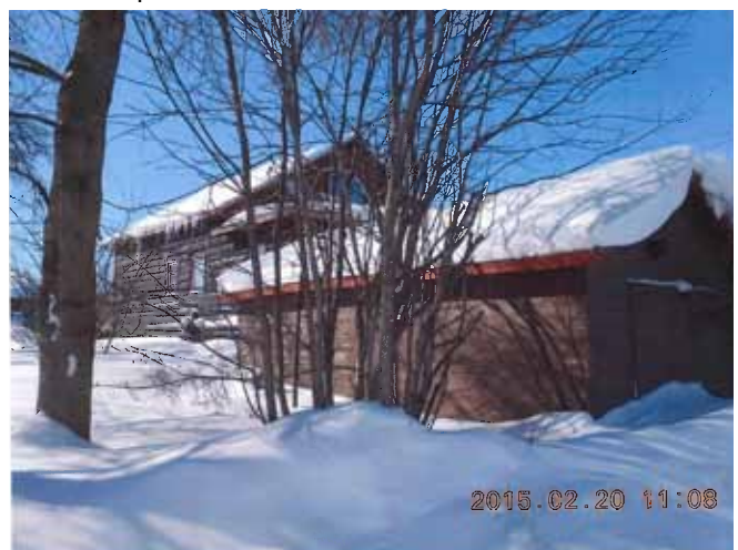
Figure 169 : Formation de digues de glace sur le versant est de la toiture en février 2015. Photographie transmise par la ville de Val-d'Or.
