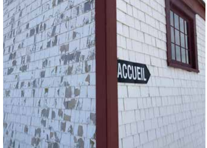
Figure 25 : Les murs extérieurs sont revêtus de bardeaux de cèdre. La peinture est écaillée laissant le bois à nu ce qui accélère sa détérioration.
