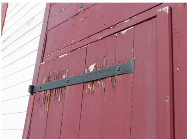
Figure 40 : La peinture s'écaille sur les portes et la porte principale et les portes de chargement sont pourries par endroit.
