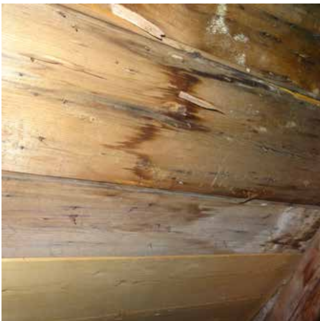
Fig. 52 : De l'intérieur, les clous servant à fixer le parement de bardeau de cèdre transpercent le platelage.
