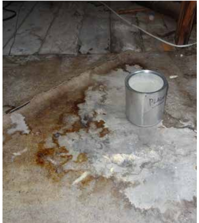
Fig. 41 : Depuis l'entretoit, des traces d'infiltration d'eau sont visibles sur le plancher du comble.
