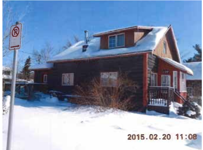
Figure 167 : Formation de digues de glace sur le versant ouest de la toiture, près de la cheminée, en février 2015. Photographie transmise par la ville de Val-d'Or.
