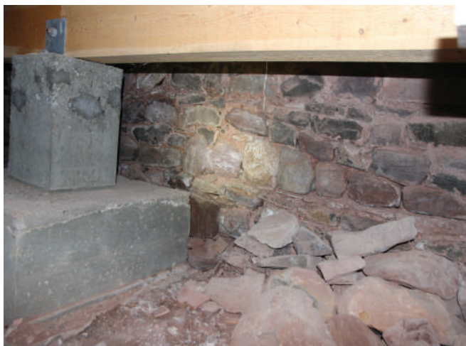
Figure 12 : Les joints de mortiers sont parfois déficients. Des traces d'efflorescence ont été observées sur la maçonnerie.
