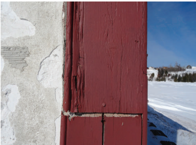
Figure 32 : Certaines planches cornières sont pourries et doivent être remplacées.
