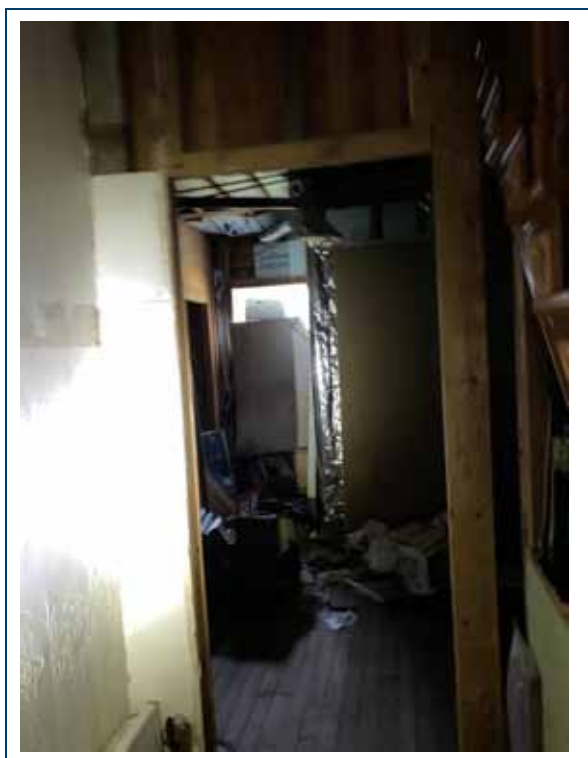
PHOTO 5 : 1 er étage. Vue sur les lieux encombrés et peu entretenus.
