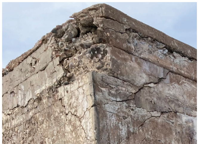
Figure 21 : La finition extérieure du coffre-fort est constituée de murs de béton laissé à nu. Des fissures sont visibles à plusieurs endroits. Le béton situé au coin supérieur sud-est du bâtiment est très désagrégé.
