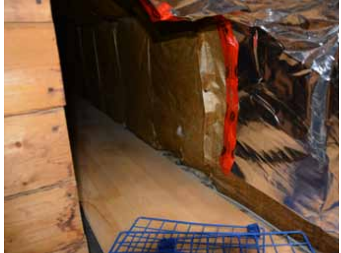
Figure 153 : La face inférieure de la toiture est isolée par des matelas de mousse isolante blanche en polymère avec un pare-vapeur réfléchissant du côté chaud.
