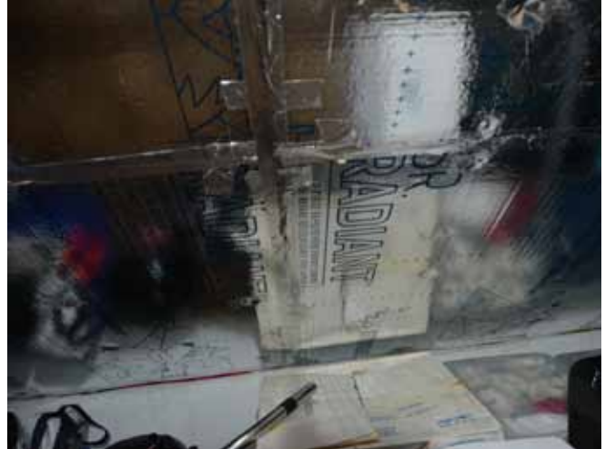
Figure 103 : Ils ont ensuite ajouté, toujours de l'intérieur, une deuxième épaisseur de polystyrène expansé avec un pare-vapeur réfléchissant du côté chaud.
