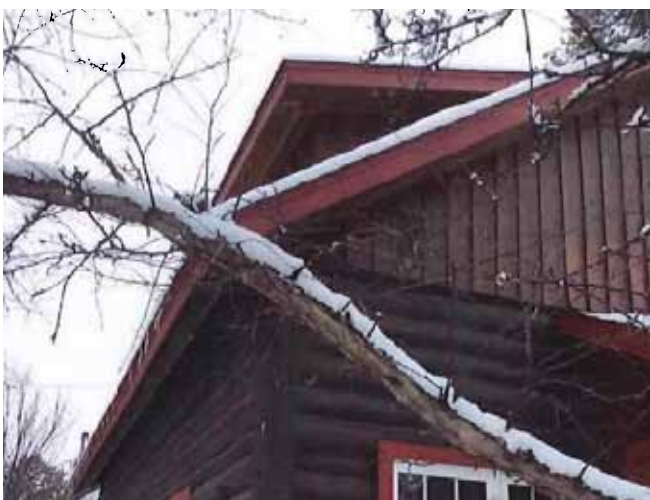
Figure 34 : 133, avenue Perrault. Photographie transmise par la ville de Val-d'Or. Certains propriétaires témoignent que l'ampleur du phénomène de formation de digues de glace diminue depuis l'installation de ventilation sur le faite.
