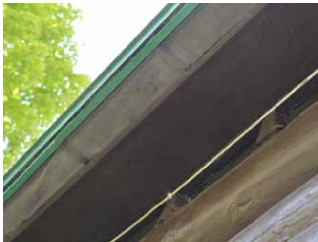
Figure 178 : Les soffites sont ventilés par une ventilation linéaire refermée par un moustiquaire.
