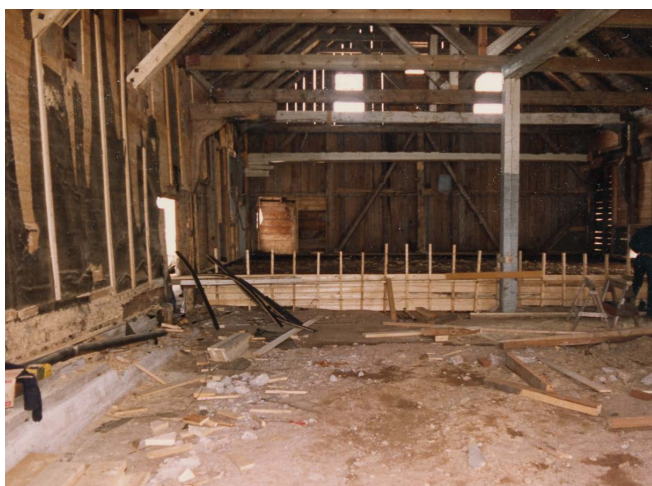
Figure 29 : Lors de ces travaux, plusieurs pièces du platelage de bois pourri ont été remplacées. Travaux de restauration de 1988. Source : Collection du SHNP.
