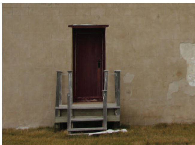
Figure 17 : Le perron est en bois nu et composé de planches de bois. Les garde-corps sont composés de poteaux de section carrée reliés entre eux par des cordes.
