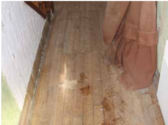
Figure 114 : Les planchers sont recouverts de parquet de bois posé sur le platelage d'origine. Les planchers sont en mauvais état. Ils sont tachés et cernés à cause des infiltrations d'eau.
