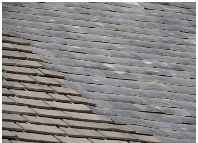
Figure 39 : En général, le revêtement de bardeaux de cèdre est en bon état, mais quelques bardeaux sont retroussés parfois dans le sens de la largeur parfois dans le sens de la longueur.
