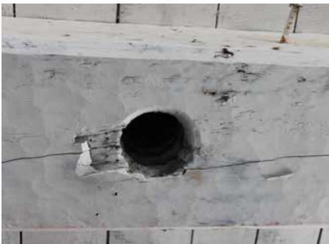
Figure 55 : Des «pas-de-visse» sont visibles dans certaines poutres. Ces éléments permettaient de laisser passer la tige filetée du presseur à morue.
