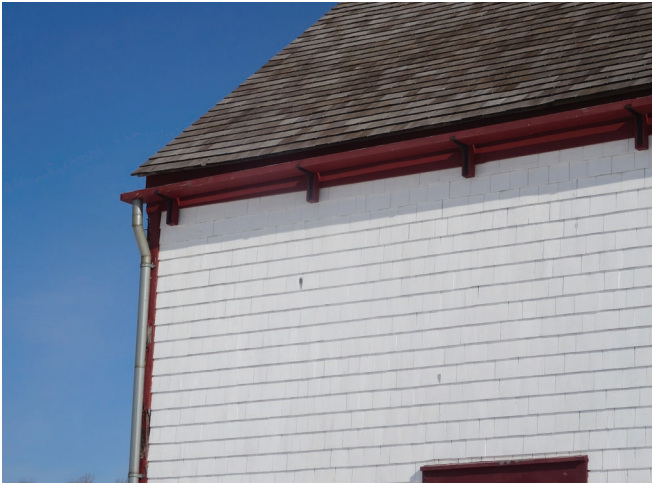
Figure 60 : Des gouttières en bois peint rouge supportées par des consoles de bois sont installées sur les larmiers.
