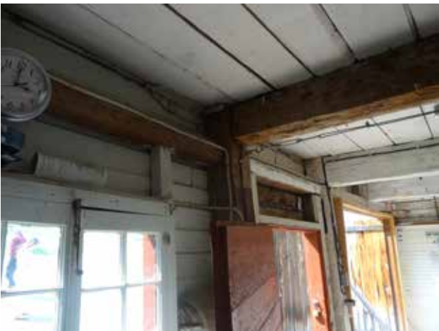
Fig. 58 : Un tendeur métallique a été ajouté sur l'axe nord-sud près d'une poutre de l'étage.
