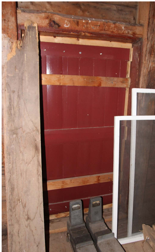
Figure 68 : Les portes de chargement sont condamnées de l'intérieur.
