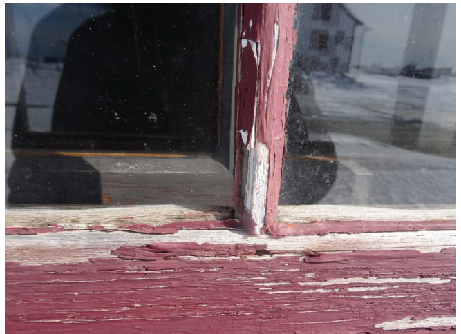
Figure 40 : Le mastic des contre-fenêtres doit également être refait.
