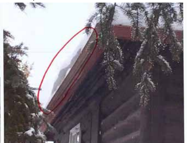
Figure 41 : Accumulation de neige sur la toiture du 52, rue Saint-Jacques en mars 2022. Photographie transmise par la ville de Val-d'Or.
