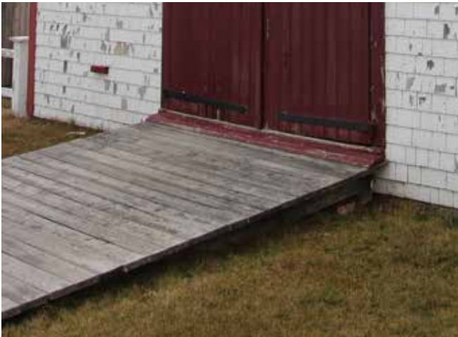
Figure 16 : Une rampe d'accès inclinée en bois est située en façade sud. Le bois est laissé à nu ce qui accélère sa détérioration.
