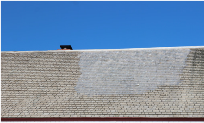
Figure 40 : En général, le revêtement de bardeaux de cèdre est en bon état, mais quelques bardeaux sont retroussés parfois dans le sens de la largeur parfois dans le sens de la longueur.
