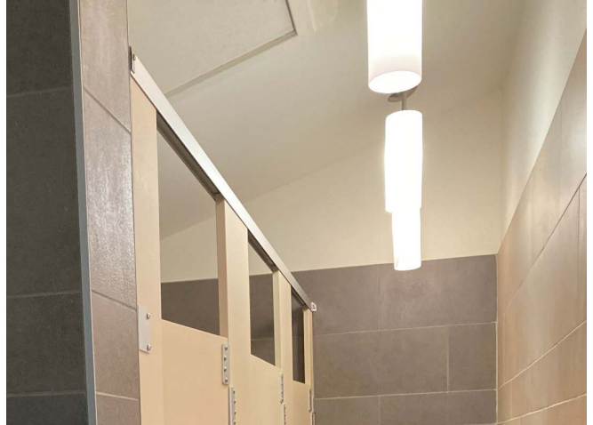
Figure 129 : Des luminaires suspendus éclairent les salles de toilettes.
