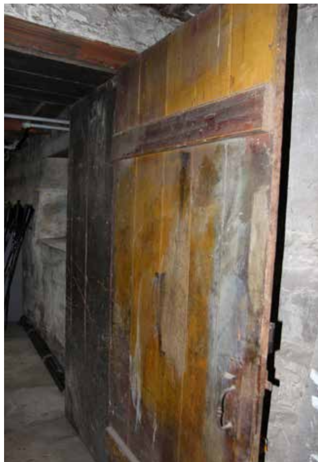
Fig. 84 : La porte menant de la partie centrale à l'extrémité nord-est du bâtiment est entièrement en bois, en bon état, mais présente des couleurs de peintures variées.
