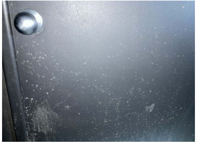
Figure 87 : Sur une des portes intérieures, des traces de moisissures sont visibles.
