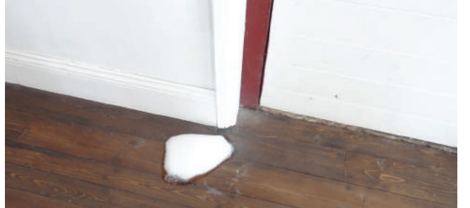
Figure 46 : La porte latérale n'est pas étanche. Des infiltrations de neige ont été observées du côté intérieur.
