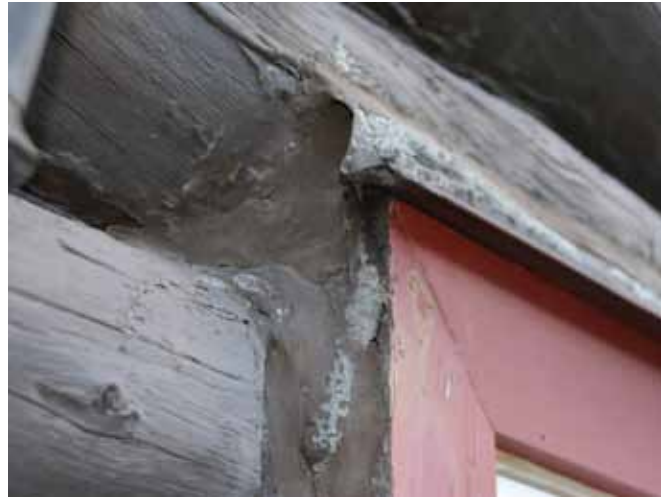
Figure 114 : Les solins sont au-dessus des fenêtres à revoir. L'espace sous le solin a été rempli avec une sorte de scellant.
