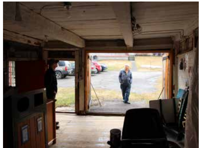
Fig. 69 : À l'intérieur, des appareils d'éclairage sont installés au plafond du rez-de-chaussée.
