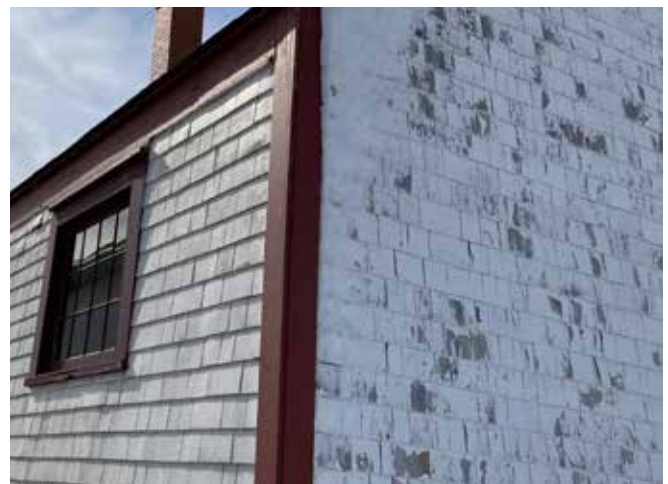
Figure 27 : Les murs extérieurs sont revêtus de bardeaux de cèdre. La peinture est écaillée laissant le bois à nu ce qui accélère sa détérioration.
