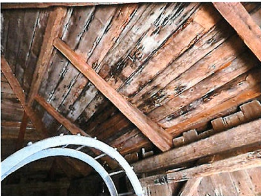
Photo #10 INTERVENTION #2 Platelage du toit (côté gauche, vue de la façade avant), nous avons constaté quelques planches pourries à remplacer.
