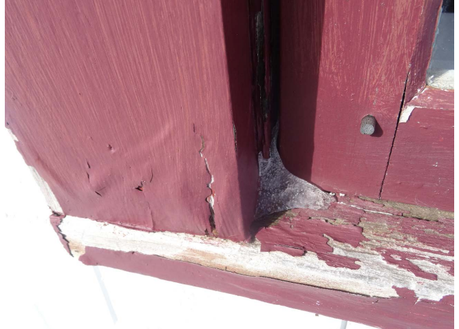
Figure 51 : Du côté extérieur, les fenêtres et leurs chambranles doivent être restaurés et peints.
