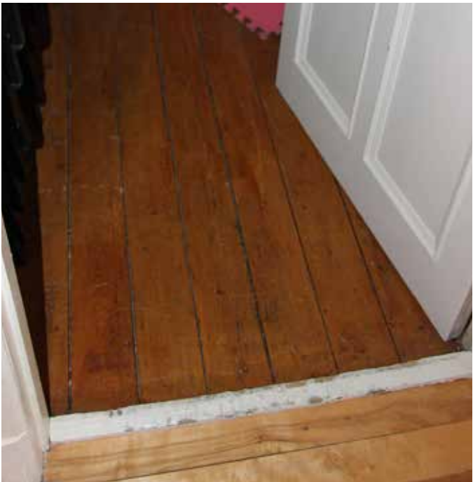
Fig. 104 : Il est possible de voir le plancher d'origine dans un espace de rangement.
