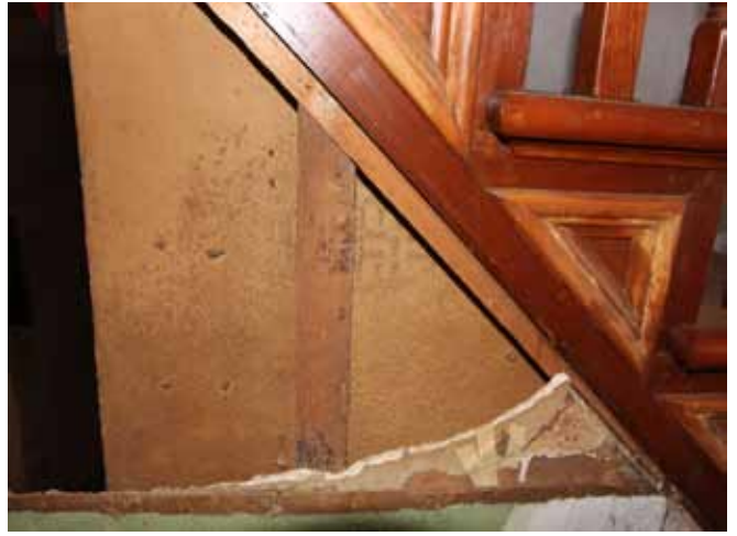
Figure 93 : Les cloisons intérieures sont constituées de colombages légers en bois recouverts de panneaux de gypse. Plusieurs panneaux de gypse sont brisés ou manquants.
