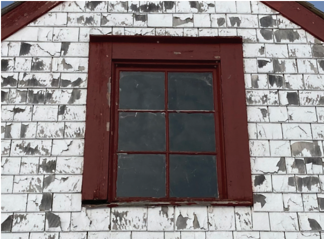
Figure 22 : Fenêtre en bois peint en rouge à six carreaux située sur le mur pignon sud. La peinture de la fenêtre et du chambranle s'écaille.
