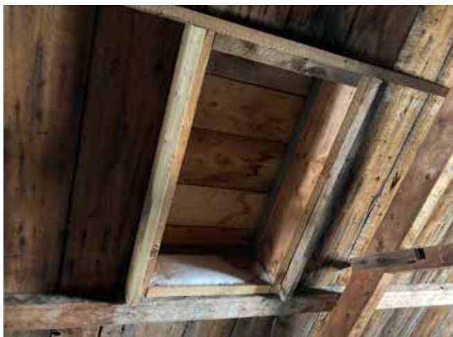
Figure 42 : Un capotin en acier galvanisé a été ajouté au versant ouest de la toiture en 1989. La fonction de l'ouverture dans le toit à cet endroit demeure inconnue.
