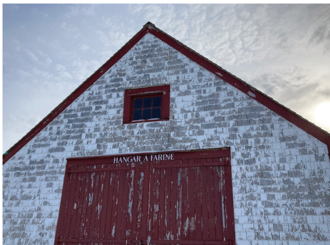
Figure 29 : Le bâtiment n'est pas muni de gouttières et il n'y a pas d'avant-toits.
