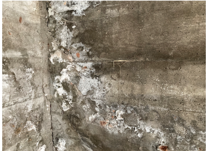
Figure 32 : Des traces d'efflorescence et de la glace ont été observées sur les murs intérieurs lors de la visite.
