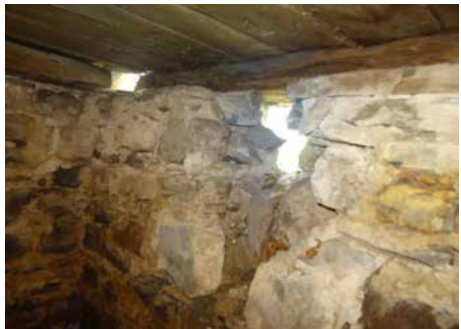
Fig. 8 : Les joints sont très détériorés, parfois inexistants.
