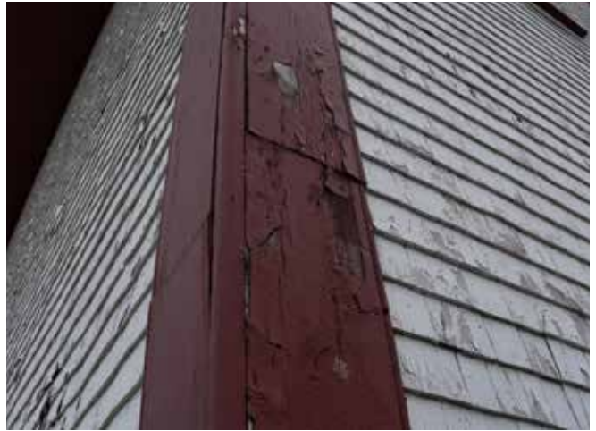
Figure 75 : Des planches cornières ornent le bâtiment. La peinture des planches cornières est en mauvais état et certaines planches sont parfois pourries.
