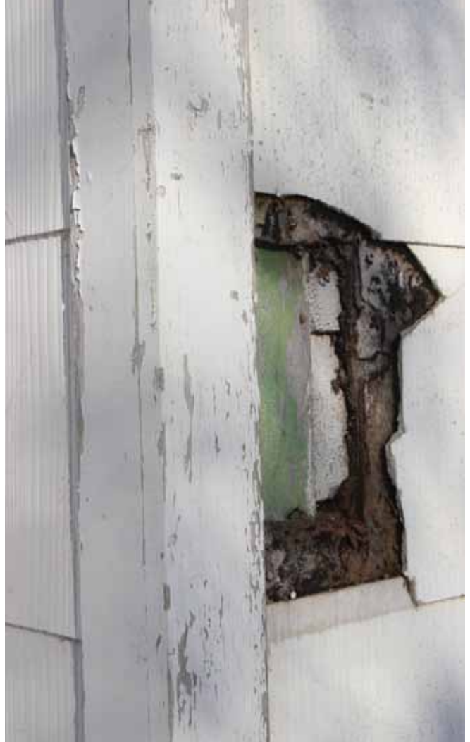
Figure 72 : Un trou dans le revêtement en tuiles d'amiante-ciment permet de voir les planches cornières d'origine sont toujours présentes sous le revêtement actuel.
