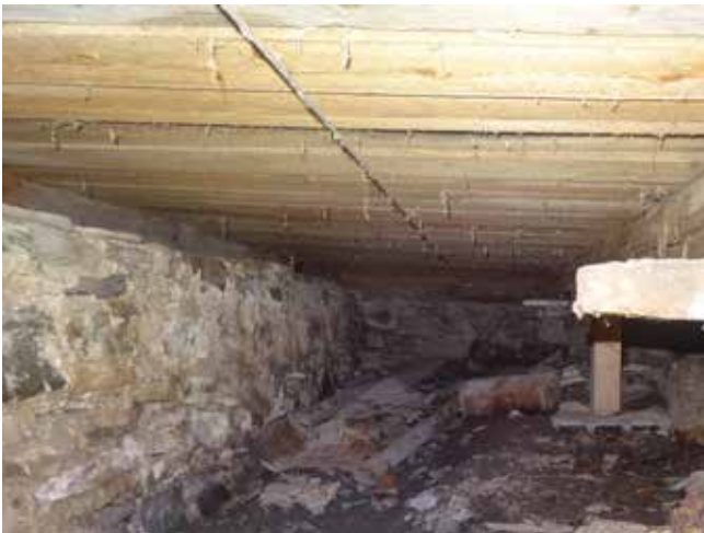
Fig. 62 : Un tendeur métallique a été ajouté sur l'axe nord-sud près de la trappe d'accès au vide sanitaire.
