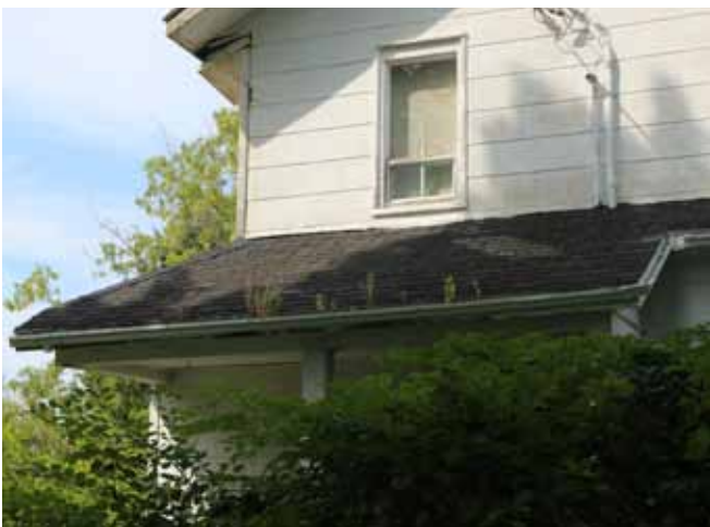
Figure 90 : Le toit du corps principal de la maison et la toiture des annexes au rez-de-chaussée, des galeries et de la véranda sont recouverts de bardeaux d'asphalte de couleur noire.
