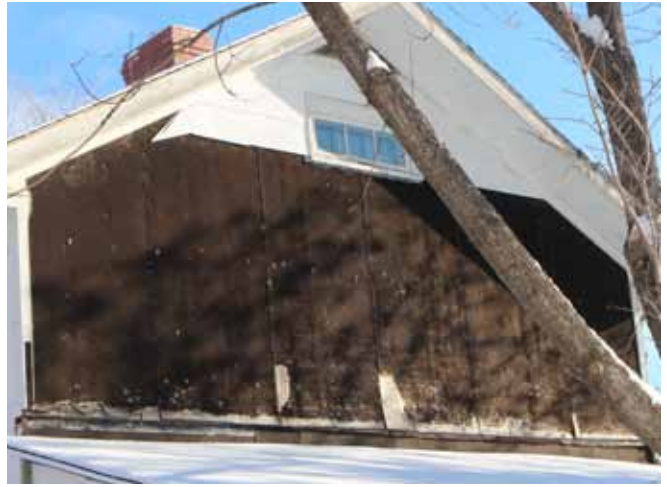
Figure 74 : Une large section de tuiles d'amiante-ciment est tombée sur le pignon de la façade latérale ouest, au-dessus de la véranda, exposant le papier noir posé sur le fond de clouage en bois.
