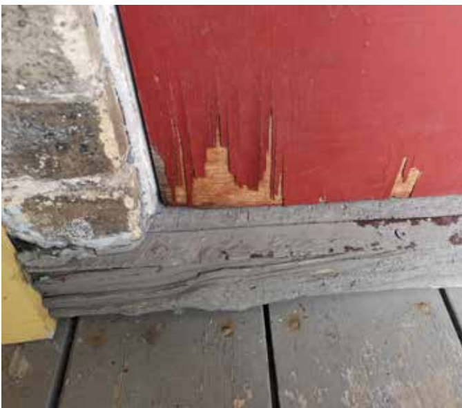
Fig. 61 : La peinture de la porte d'entrée secondaire s'écaille majoritairement dans la partie basse.
