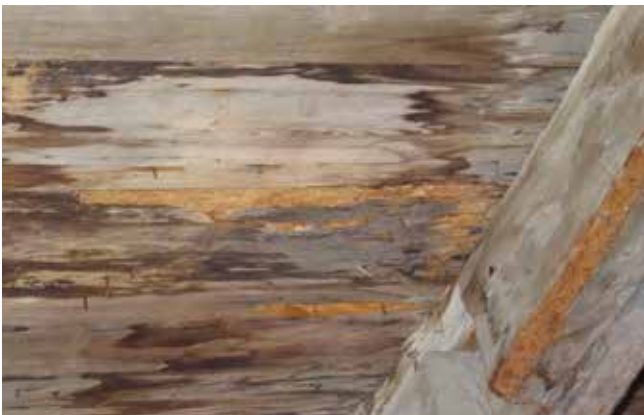
Fig. 50 : Le platelage en planches emboutetées horizontales est généralement en bon état mais présente des traces d'infiltration d'eau.
