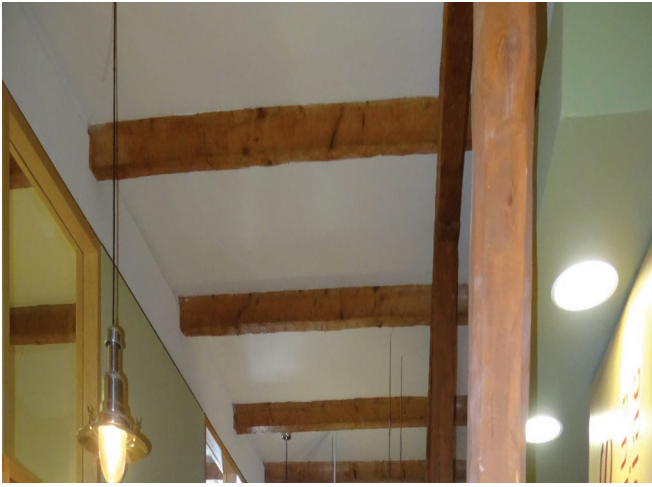
Figure 86 : Des luminaires suspendus éclairent les espaces communs de l'étage.
