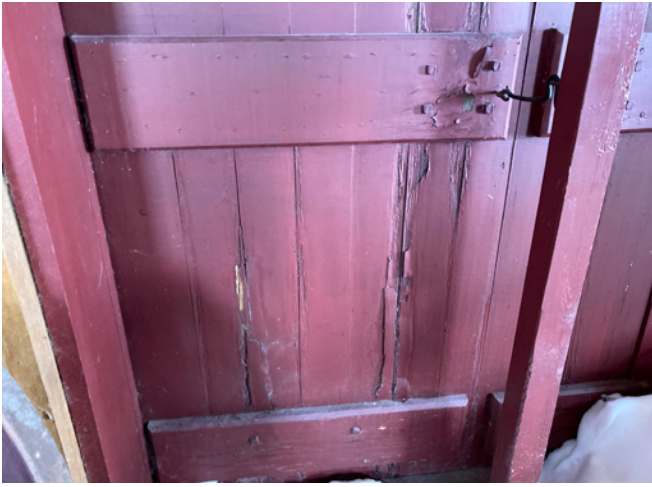
Figure 33 : Les portes sont abimées et pourries dans leur partie basse.
