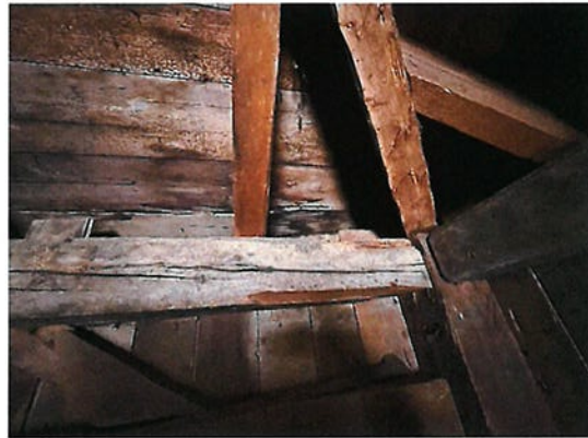
Photo #15 INTERVENTION #2 & 3 Platelage du toit, nous avons constaté quelques planches pourries à remplacer.
