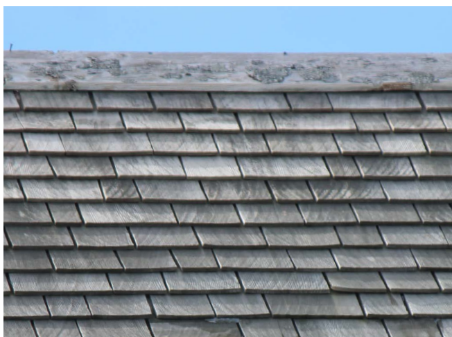
Figure 74 : Les bardeaux sont laissés à nu. Une nouvelle planche faitière en bois a été installée. Elle est en bon état, mais est couverte de mousse.
