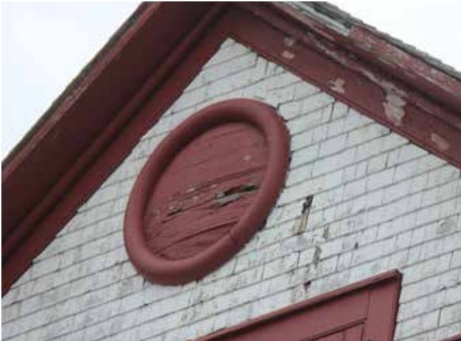
Figure 83 : Sur la façade principale, l'oeil-de-boeuf est fermé par des planches de bois. Il est en très mauvais état.
