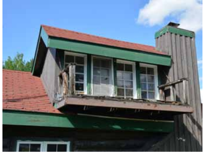
Figure 87 : Le bois du balcon est largement pourri et le garde-corps est manquant.
