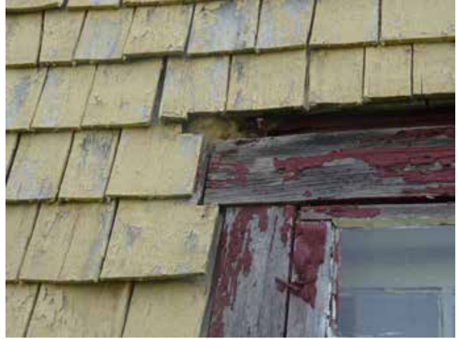
Fig. 37 : Les chambranles doivent être repeints. Dans certains cas, ils sont en très mauvais état. Le bardeau est en surépaisseur des chambranles.
