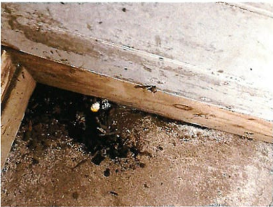
Photo #9 INTERVENTION #1 Nous avons constaté des copeaux de bois pourries à l'intérieur de la pièce attenante au garage, à la jonction des deux espaces – cela pourrait provenir de l'espace entre les murs. Une validation sera à faire sur place, en enlevant une pièce de bois murale.
