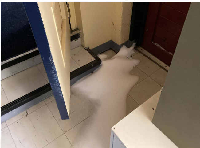
Figure 68 : La porte n'est pas étanche et laisse entrer la neige.
