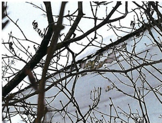
Photo #29 INTERVENTION #8 La peinture sur les fascias et soffite est très écaillée, celle-ci doit être grattée et sablée pour ensuite être teinte.
