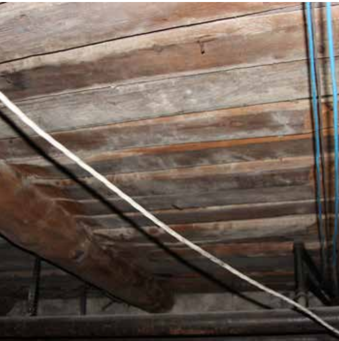
Fig. 15 : Il y a de la moisissure apparente sous le platelage du plancher.
