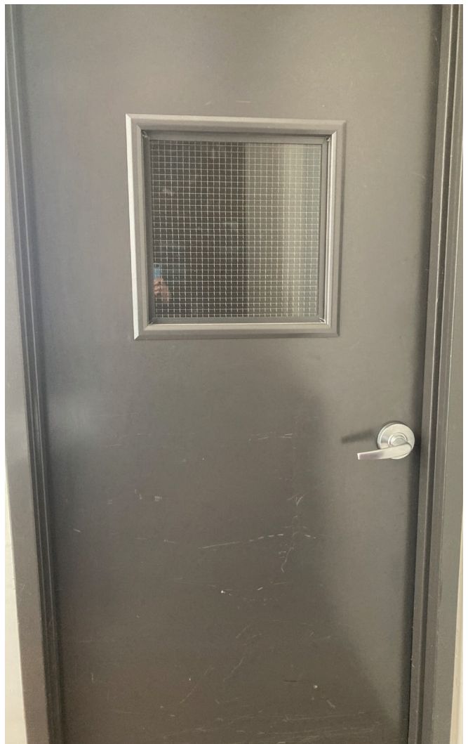
Figure 71 : Au rez-de-chaussée, des portes métalliques peintes en gris avec un degré pare-flamme ont été installées dans les issues. La peinture des portes est usée.
