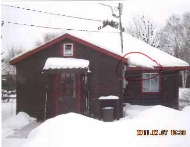
Figure 44 : Accumulation de neige vis-à-vis la noue en façade avant ouest du 58, rue Marineau en février 2011. Photographie transmise par la ville de Val-d'Or.
