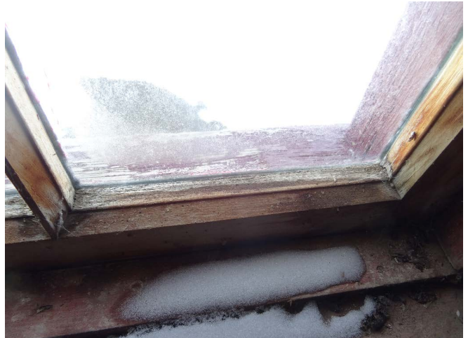
Figure 57 : Les fenêtres sont en bon état, mais les fenêtres, tablettes et cadres doivent être peints et restaurés.
