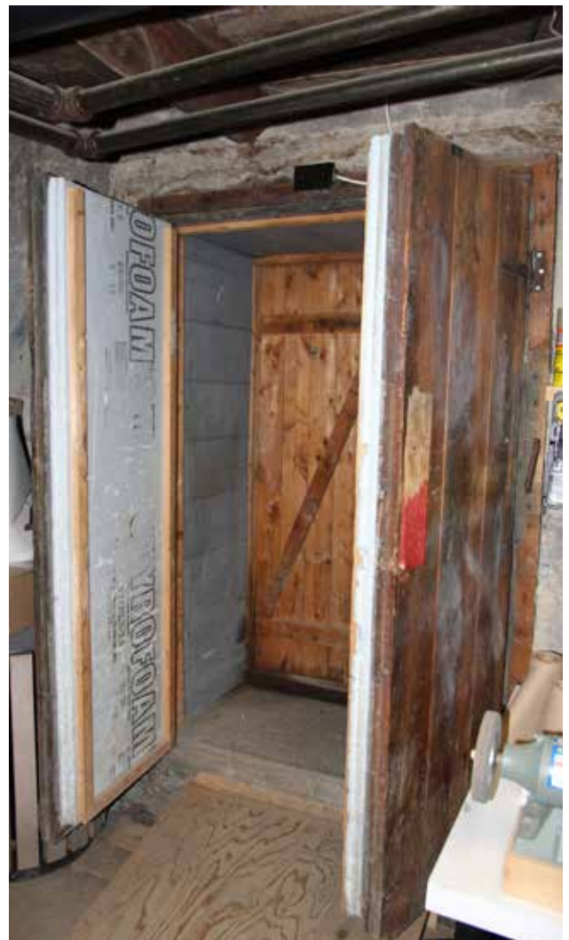
Fig. 66 : Au sous-sol, la contre-porte a été isolée avec un isolant rigide apparent.
