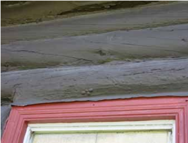
Figure 113 : Les solins sont au-dessus des fenêtres à revoir. La jonction entre les murs en billes de bois et les fenêtres est assurée par un solin métallique qui recouvre le dessus des fenêtres.
