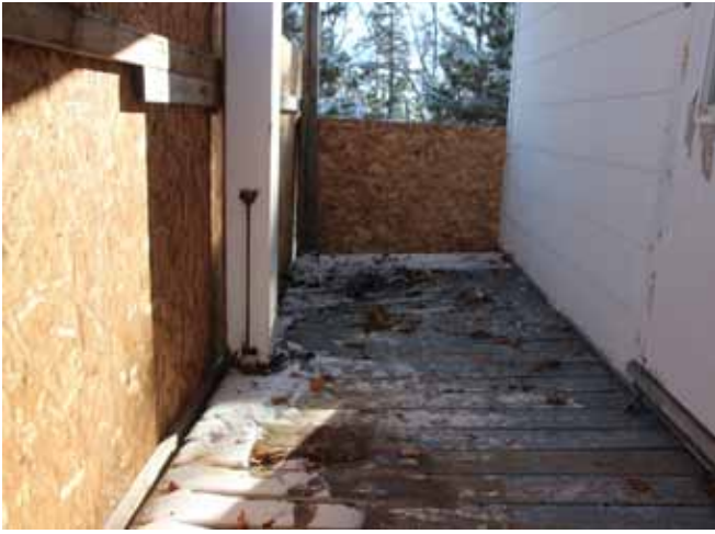
Figure 39 : Le plancher de la galerie est en bois peint en gris. La peinture est très écaillée et certaines planches de bois sont pourries et déformées. La galerie a perdu ses garde-corps.
