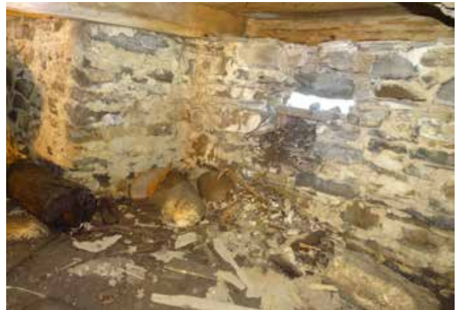
Fig. 12 : Le sol du vide sanitaire est humide et jonché de débris de toutes sortes.
