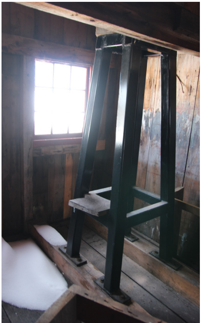
Figure 32 : Les fenêtres de la façade nord ne sont pas étanches et laissent passer la neige.
