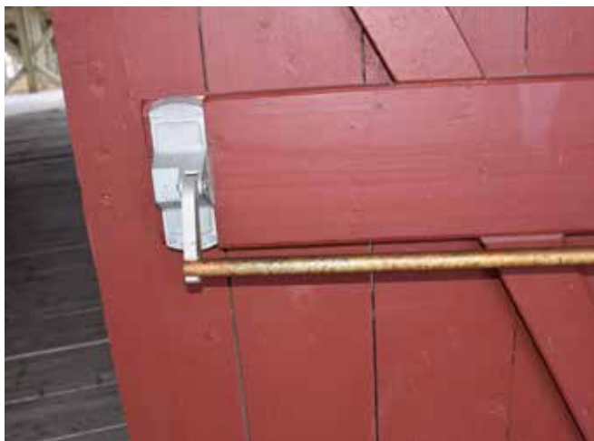
Figure 95 : Une barre panique est installée sur la porte d'issue. La quincaillerie des portes est parfois corrodée.
