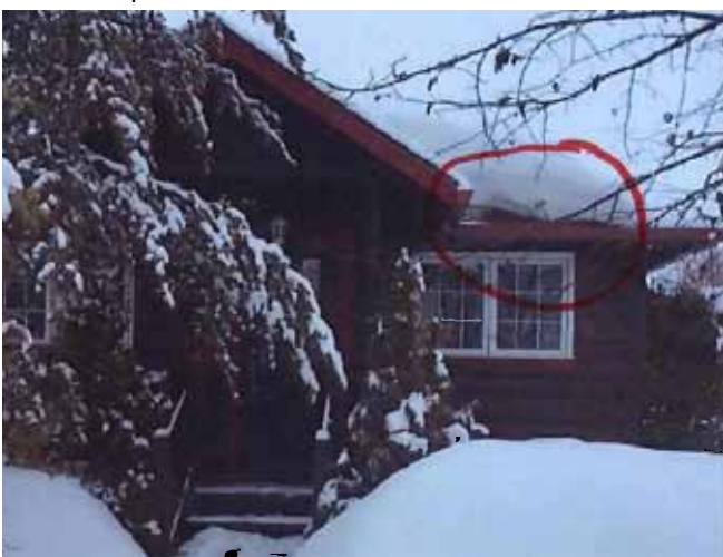
Figure 40 : Maison de type E avec portique ajouté en façade. 52, rue Saint-Jacques. Accumulation de neige sur le versant ouest en mars 2002. Photographie transmise par la ville de Val-d'Or.
