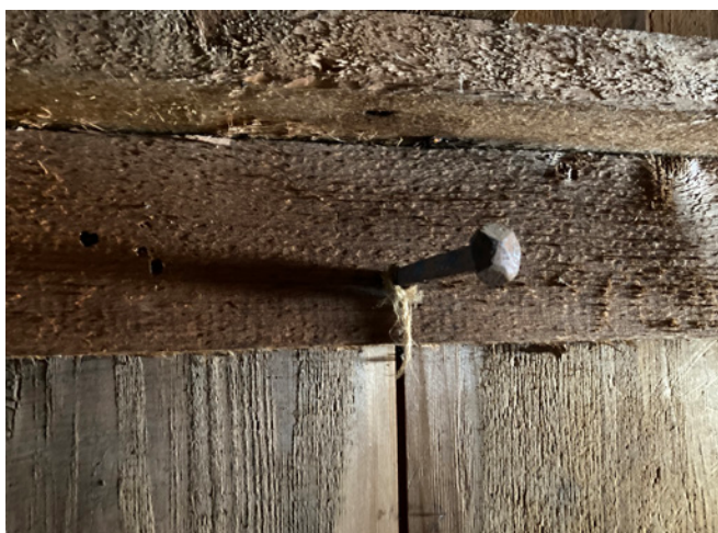
Figure 69 : Des clous sont installés dans la cloison pour accrocher des vêtements.
