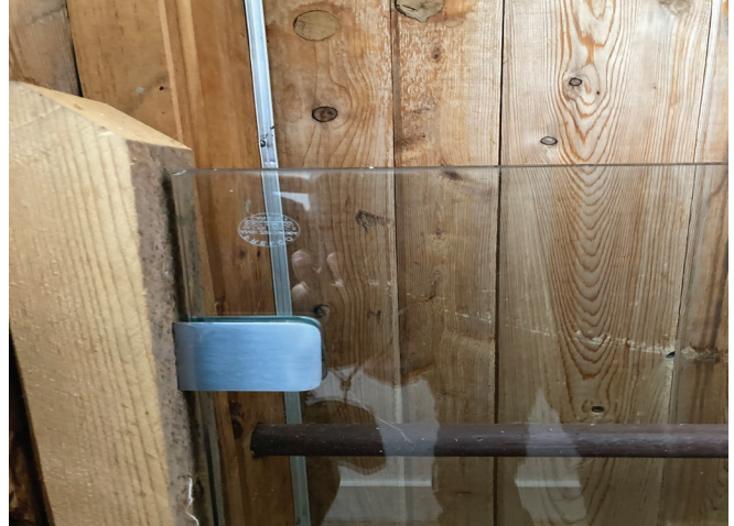
Figure 77 : Des garde-corps de verre sont installés du côté intérieur des portes de chargement de l'étage.
