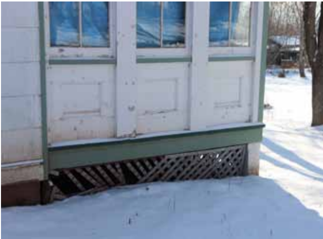
Figure 43 : La véranda est dotée d'une jupe en treillis de bois peint en vert en mauvais état.
