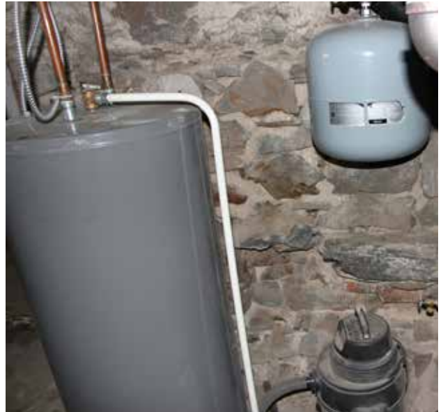
Fig. 109 : Le chauffe-eau est installé au sous-sol du bâtiment.
