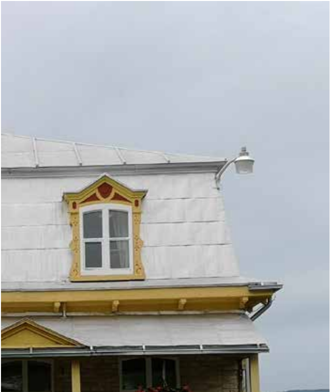
Fig. 127 : Un luminaire est accroché sur le coin est de la toiture du bâtiment.
