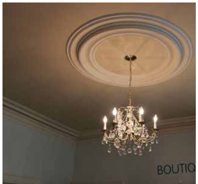
Fig. 107 : Des moulures en bois décorent à plusieurs endroits les plafonds, principalement à leur pourtour et autour des luminaires.
