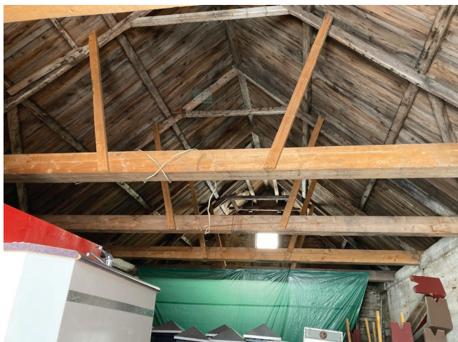
Figure 15 : La charpente de la toiture à deux versants est en bois. La structure se compose d'arbalétriers reliés par deux faux entrails. La structure a été consolidée, possiblement en 1989.
