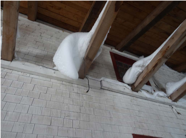
Figure 32 : La toiture de l'appentis n'est pas étanche et laisse passer la neige, possiblement par les aérateurs de toiture.
