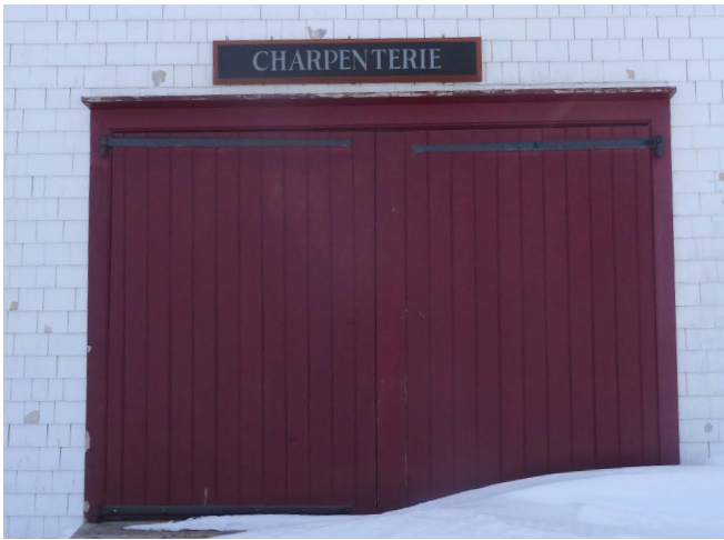
Figure 84 : Sur la façade ouest, une affiche en bois est installée au-dessus de la porte double.
