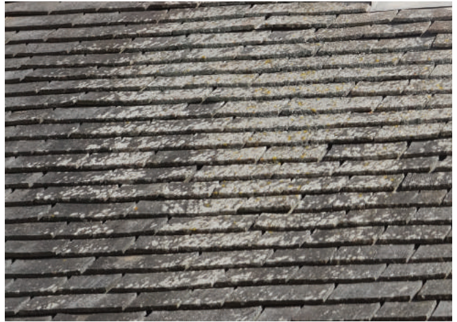
Figure 52 : À certains endroits, du lichen s'est installé sur le revêtement. Quelques bardeaux sont retroussés parfois dans le sens de la largeur parfois dans le sens de la longueur.
