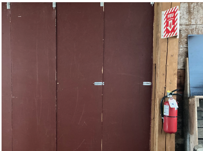
Figure 85 : Des extincteurs portatifs sont installés dans le bâtiment.
