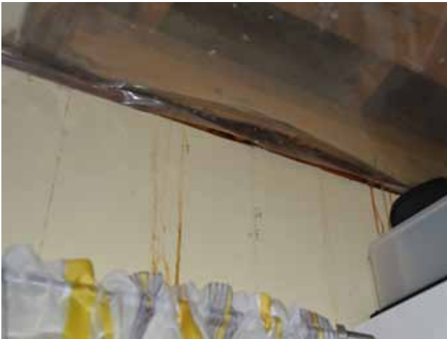
Figure 160 : Les propriétaires ont subi de gros dégâts d'eau à l'intérieur cet hiver qui ont fait tomber le plafond de leur cuisine située dans l'appentis à l'arrière.
