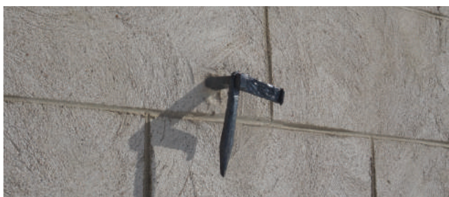
Figure 39 : À l'origine, des volets étaient disposés autour des ouvertures. Les attaches de ces volets sont toujours en place.
