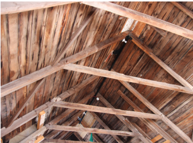
Figure 22 : Des cernes, visibles sur le platelage de la toiture, témoignent d'infiltrations d'eau.
