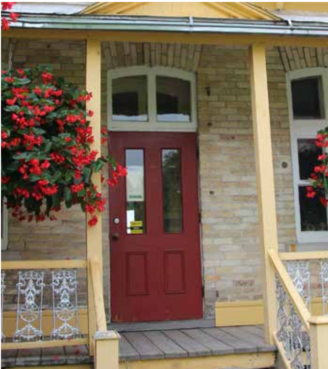
Fig. 60 : En façade avant, la porte secondaire est une porte simple en bois, peinte en rouge, vitrée, avec caissons et imposte vitrée peinte en blanc.
