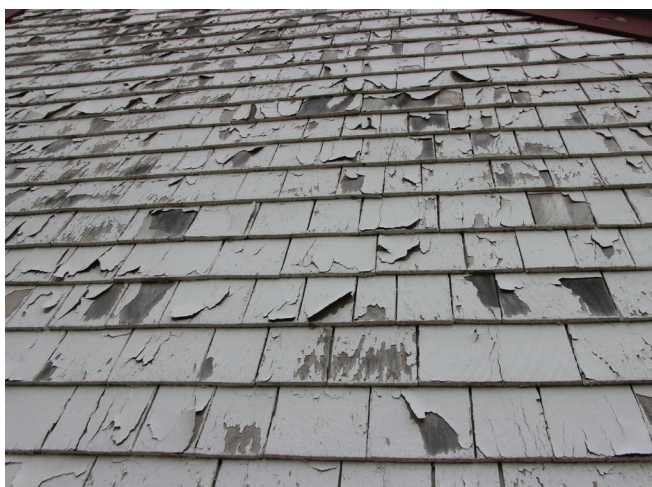
Figure 19 : Les murs extérieurs sont revêtus de bardeaux de cèdre. En 2005, les bardeaux ont été peints. La peinture est très écaillée et le bois est, à divers endroits, laissé à nu.
