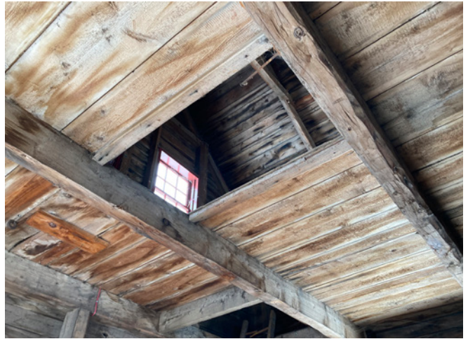
Figure 21 : Des cernes, visibles sur le platelage de la toiture, témoignent d'infiltrations d'eau.
