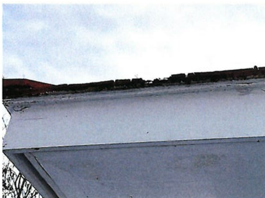
Photo #28 INTERVENTION #7 Les bardeaux sont en très mauvais état. Prévoir remplacer tous les bardeaux.
