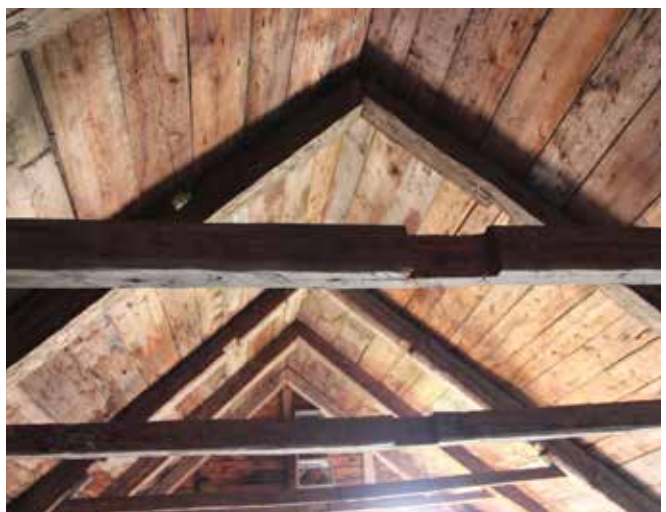
Fig. 47 : La charpente du bâtiment est en bois et en bon état. La charpente est simple et se compose d'arbalétriers de bois déposés sur une sablière.
