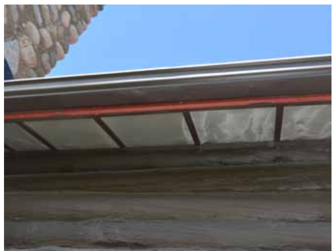
Figure 110 : Vis-à-vis la partie isolée, les planches avec des trous entre les chevrons ont été complètement retirés et ils ont été remplacés par des moustiquaires sous le soffite.
