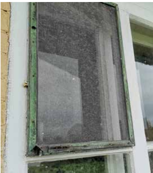
Fig. 56 : Les guichets des contre-fenêtres sont en mauvais état.
