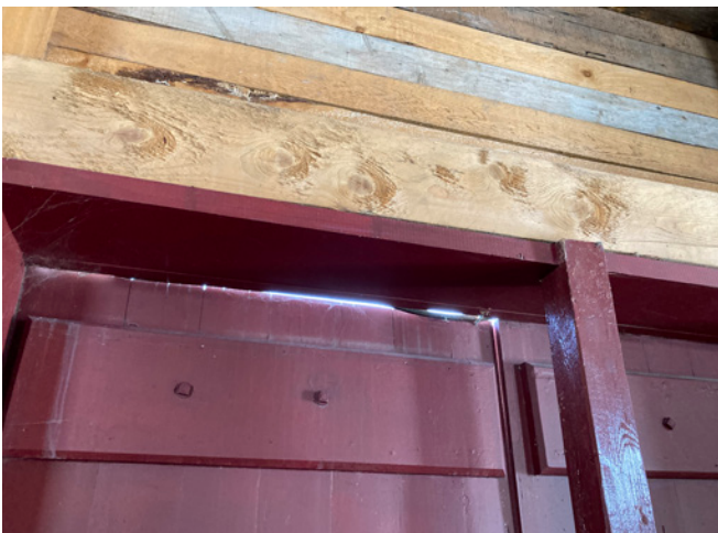
Figure 36 : La porte n'est pas étanche et laisse passer la neige.
