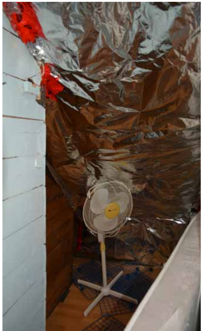
Figure 151 : La face inférieure de la toiture est isolée par des matelas de mousse isolante blanche en polymère avec un pare-vapeur réfléchissant du côté chaud.
