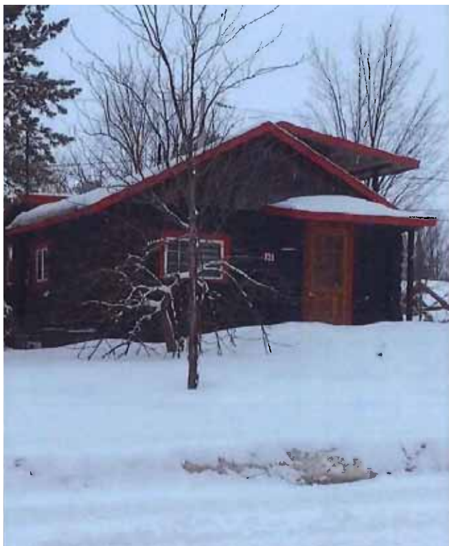
Figure 140 : Formation de digues de glace du côté sud-ouest en mars 2022. Photographie transmise par la ville de Val-d'Or.
