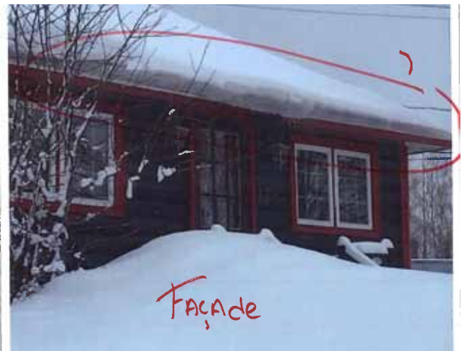
Figure 39 : Maison de type E. 138, avenue Perrault. Accumulation de neige sur le versant nord en mars 2002. Photographie transmise par la ville de Val-d'Or.
