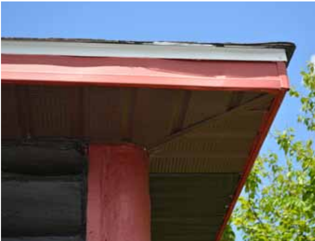
Figure 20 : Sur plusieurs maisons, les soffites ont été modifiés. Ils ont généralement été recouverts, notamment par des grilles en aluminium perforé. 138, avenue Perrault.
