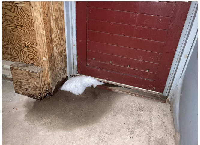
Figure 105 : Sous la régie technique, dans l'espace mécanique, le plancher est en béton. Des infiltrations de neige par la porte sont visibles.
