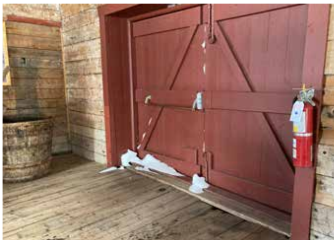
Figure 94 : Une des portes doubles n'est pas étanche et laisse passer la neige.
