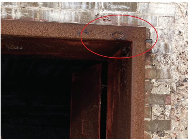
Figure 25 : Par endroits, des portions du cadre métallique se détachent
