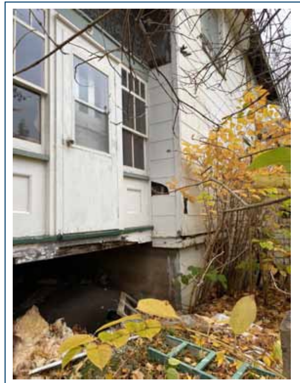
PHOTO 2 : Extérieur. Vue sur le revêtement détérioré.
