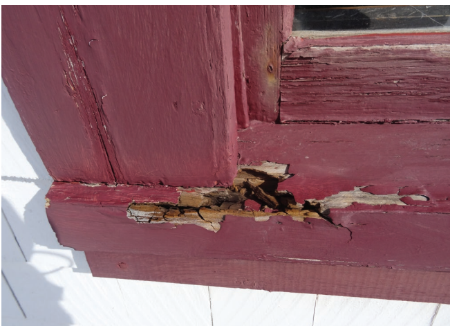
Figure 39 : . Certaines tablettes sont complètement pourries notamment sur la façade ouest.
