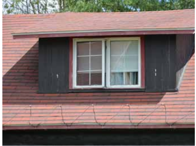
Figure 148 : Les propriétaires ont installé un fil chauffant à la base du versant ouest, immédiatement sous la lucarne.
