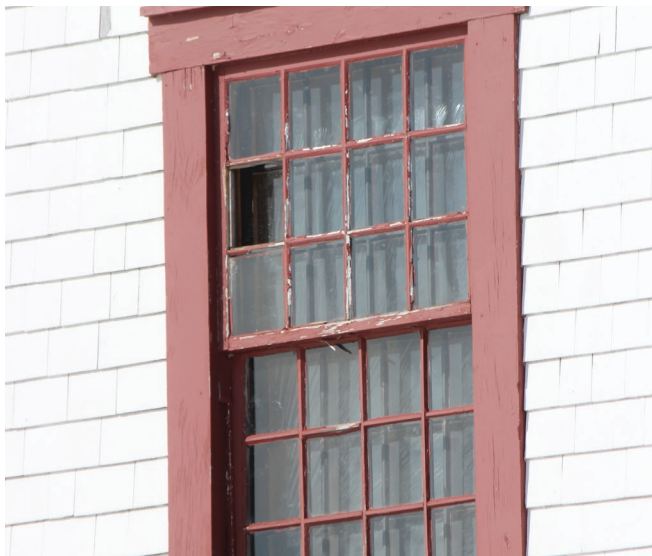
Figure 36 : Un carreau de fenêtre est manquant sur la façade ouest.
