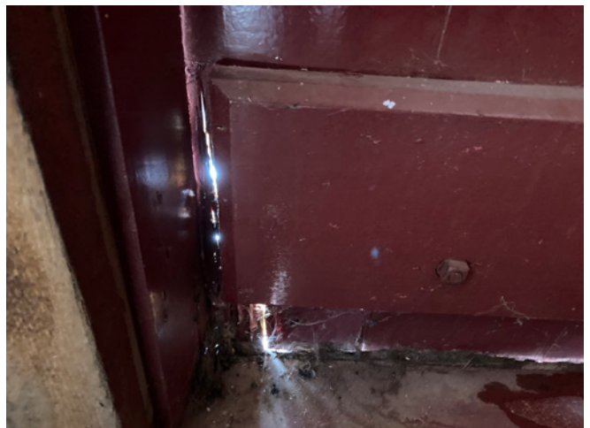
Figure 45 : Les portes ne sont pas étanches et laissent passer la neige.
