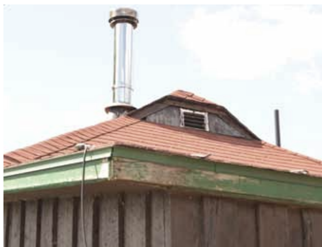
Figure 181 : Les fascias actuels sont en mauvais état et ont besoin d'être restaurés.
