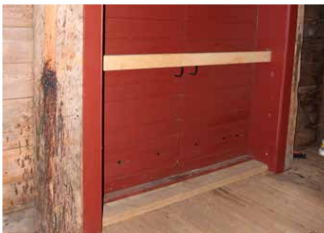
Figure 98 : L'une des portes est condamnée puisque sa quincaillerie est en mauvais état.
