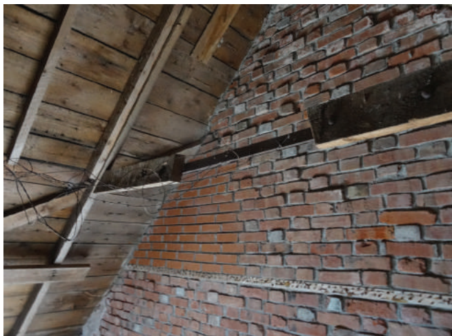
Figure 20 : La charpente est constituée d'arbalétriers en bois reliés en leur sommet par des chevilles de bois et appuyés sur le dessus des murs en maçonnerie.
