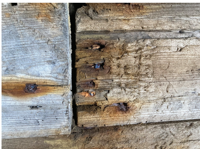
Figure 34 : Des traces de rouille sont présentes autour de clous dans les planches de bois des murs.
