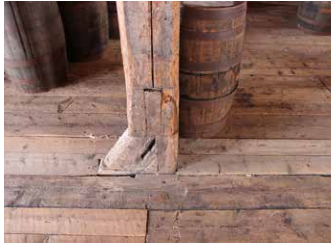
Figure 39 : Le plancher de l'étage a été modifié pour l'accès à la rampe de chargement. Les pièces de structure qui ont été sectionnées sont toujours visibles.
