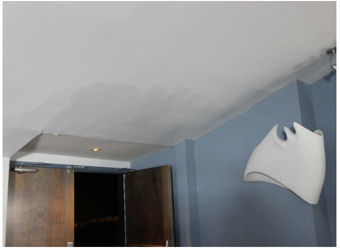
Figure 111 : Dans la grande salle, des reprises de plâtres ont été réalisés suite à des infiltrations d'eau.
