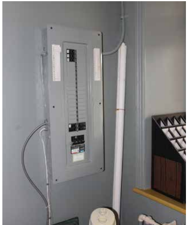
Fig. 117 : Les panneaux électriques sont situés au rez-de-chaussée du côté de la cuisine d'été.
