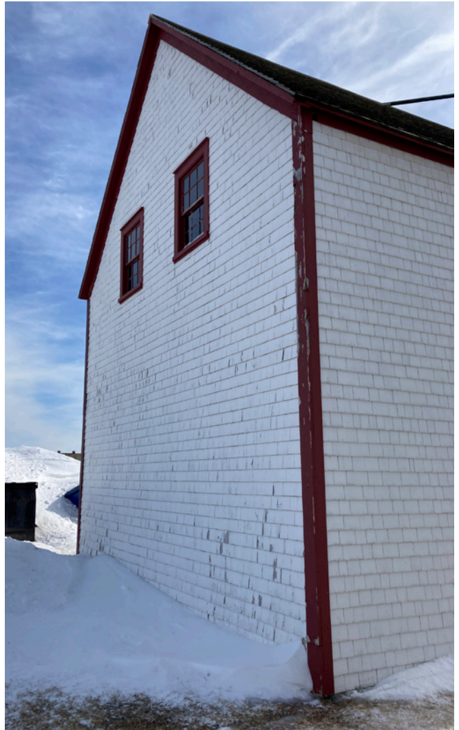
Figure 28 : La peinture est écaillée sur les planches cornières.
