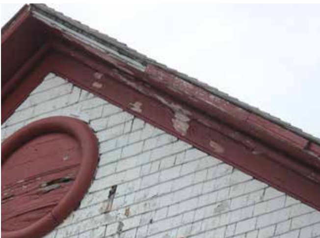
Figure 72 : De façon générale, les larmiers sont en bon état mais sur la façade principale, certaines sections de bois sont manquantes près de la jonction des deux versants.
