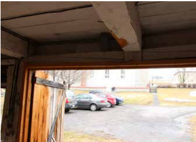
Fig. 56 : Une colonne, située sur la façade sud, a également été sectionnée pour permettre d'agrandir l'ouverture des portes principales.
