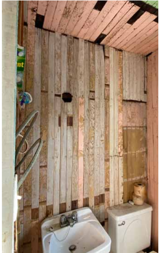
Figure 109 : Dans la salle de bain à l'étage, la finition en lattes de bois est toujours visible. Il s'agit possiblement de la finition d'origine. Elle a été très dégradée par l'humidité.
