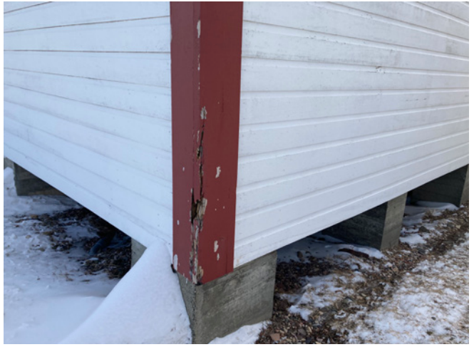
Figure 29 : La peinture est écaillée sur les planches cornières et certaines sections sont pourries.
