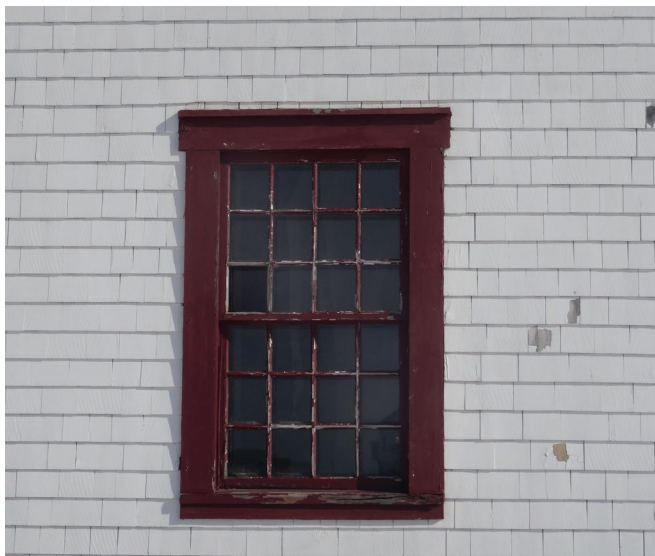
Figure 35 : Le bâtiment possède 8 fenêtres et contre-fenêtres en bois à guillotine de 24 carreaux.
