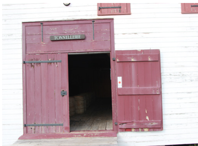
Figure 34 : Le bâtiment est muni d'une porte à doubles vantaux sur la façade sud ainsi que de deux portes de chargement installées dans le pignon de la façade sud.
