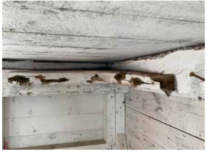
Figure 21 : Des consoles, communément appelées «jambe de chien» à Paspébiac, sont présentes à la base de la charpente dans les coins du bâtiment sous le plancher de l'entretoit.
