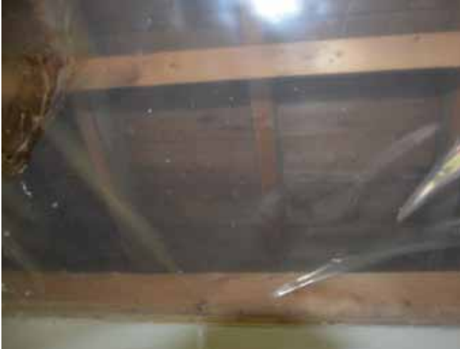
Figure 158 : Les propriétaires ont subi de gros dégâts d'eau à l'intérieur cet hiver qui ont fait tomber le plafond de leur cuisine située dans l'appentis à l'arrière.
