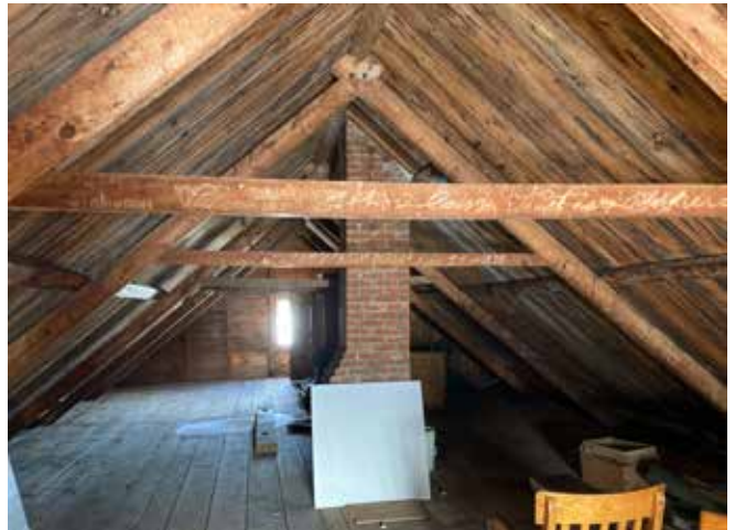
Figure 17 : La charpente de la toiture à deux versants est en bois. La structure, visible de l'intérieur, se compose d'arbalétriers reliés par un entrait.
