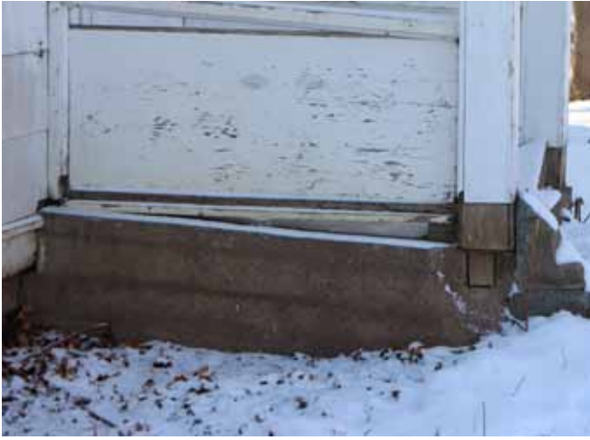
Figure 19 : Le plancher de la galerie devant la porte au centre de la façade avant est constitué d'une dalle de béton inclinée.
