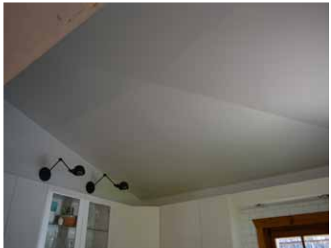
Figure 104 : Les plafonds cathédrale à l'intérieur de la maison sont recouverts de gypse.
