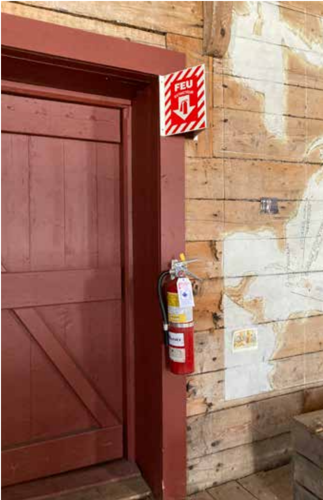
Figure 131 : Des extincteurs sont installés près des portes au rez-de-chaussée.
