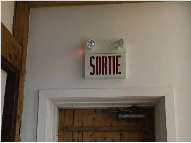
Figure 72 : Les portes d'issues sont surmontées de panneaux de sortie lumineux.
