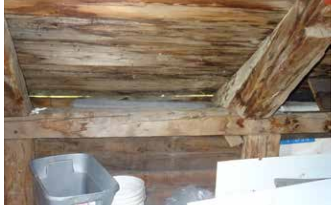
Fig. 49 : Le platelage en planches emboutetées horizontales est généralement en bon état mais présente des traces d'infiltration d'eau.
