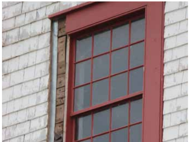
Figure 77 : Les fenêtres sont relativement en bon état. Un chambranle est absent sur l'une des fenêtres.
