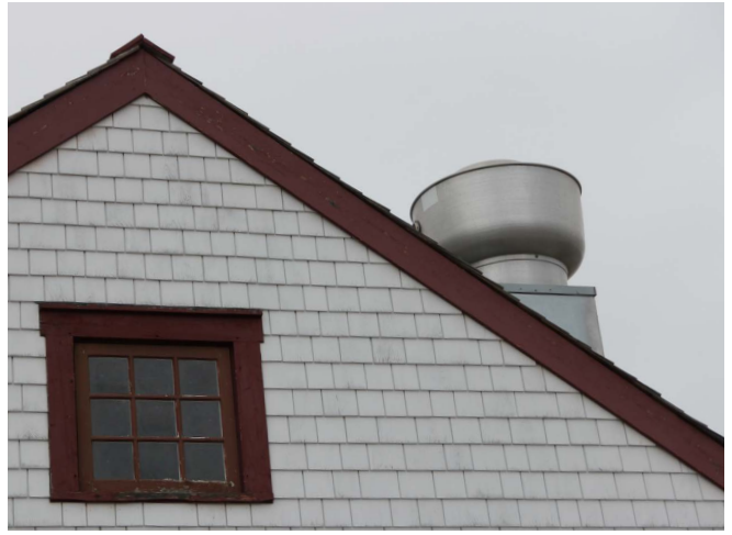
Figure 141 : Un ventilateur commercial a été installé sur le toit en remplacement de la cheminée.
