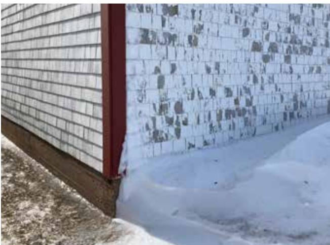
Figure 26 : Les murs extérieurs sont revêtus de bardeaux de cèdre. La peinture est écaillée laissant le bois à nu ce qui accélère sa détérioration.
