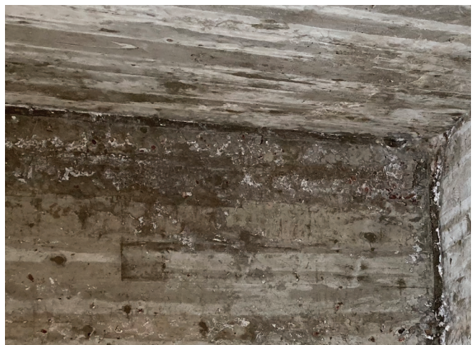
Figure 35 : Des traces d'infiltrations d'eau sont visibles à l'intérieur au pourtour du plafond. Ces infiltrations contribuent à la dégradation du coffre-fort.
