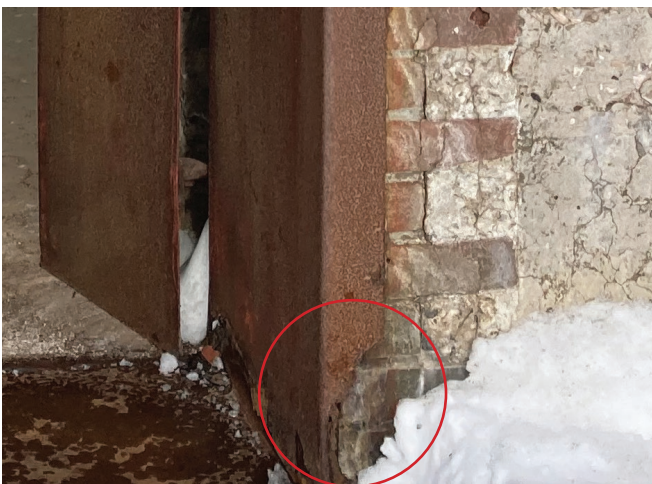
Figure 27 : Par endroits, des portions du cadre métallique se détachent
