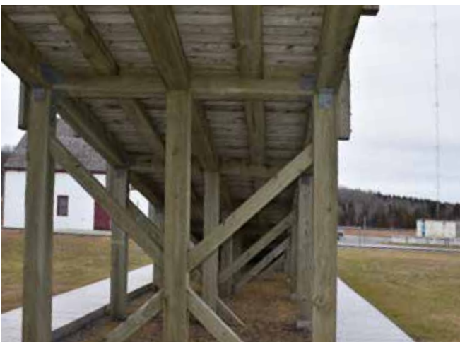
Figure 43 : La rampe est construite de poutres et de poteaux en bois traité contreventé entre eux sur lesquels est déposé un platelage de bois.
