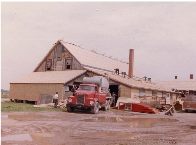
Figure 72 : En 1988, de nouveaux bardeaux de cèdre sont installés sur une membrane. Collection du SHNP.
