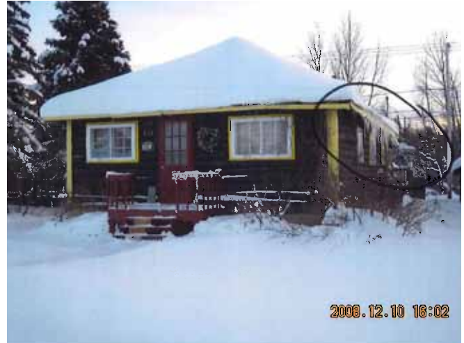
Figure 27 : Maison de type E. Formation de digues de glace sur le versant est de la toiture du 116, avenue Perrault en décembre 2008. Photographie transmise par la ville de Val-d'Or.
