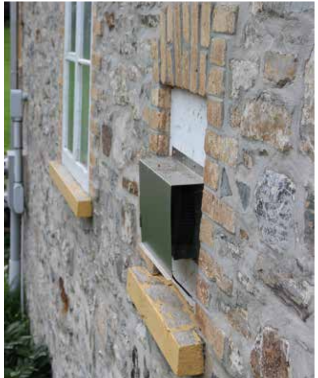
Fig. 55 : Un système de ventilation a été installé dans la fenêtre de la salle du bain située au rez-de-chaussée.
