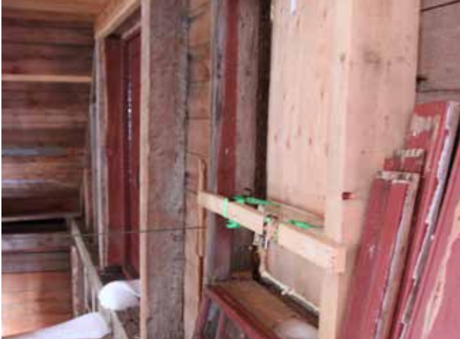
Figure 85 : Sur la façade principale, quatre fenêtres ont été démantelées et remplacées par des contreplaqués.
