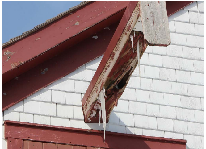
Figure 143 : Les poutres sont en mauvais état. L'hiver, des glaçons se forment sur les poutres.
