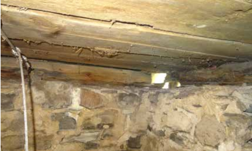
Fig. 60 : Sur le coin nord-est, la pièce de rive au bas du mur est fortement abîmée et son assemblage est disloqué.
