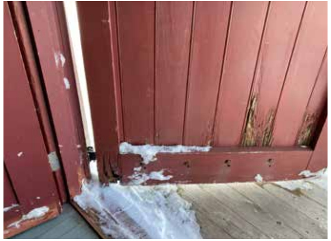
Figure 37 : Certaines portions de bois sont fissurées sur la face intérieure de la contre-porte.
