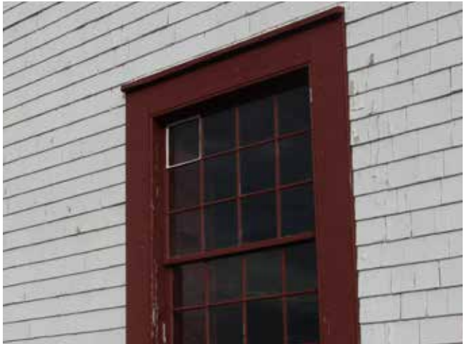
Figure 80 : Le mastic d'un des verres de la fenêtre de la façade sud-est a été refait. Il n'est pas peint.
