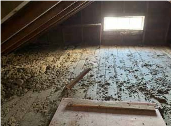
Figure 54 : Le plancher de l'entrecroisement est recouvert d'un platelage de bois.
