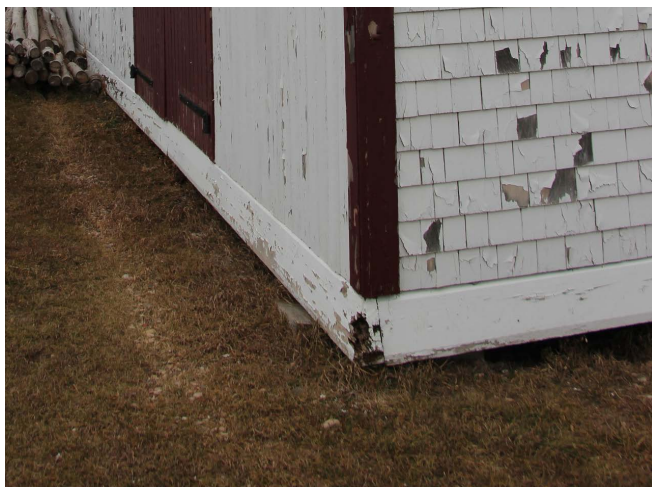
Figure 23 : La solive de rive au coin sud-est du bâtiment est pourrie.
