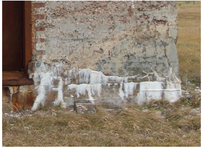
Figure 23 : Des traces d'efflorescence ont été observées au pied des murs extérieurs.
