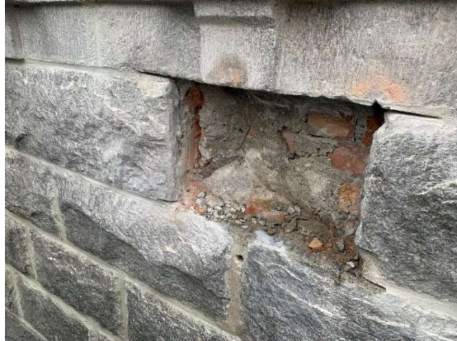
Photo 20 : Ouverture exploratoire dans le parement
