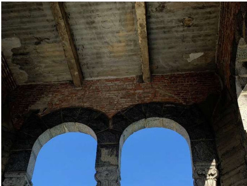
Photo 18 : Fissuration des arches
