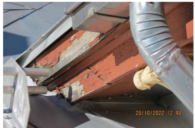
14 Débord de toit à corriger
