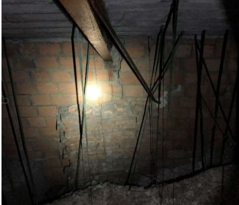
Photo 5 : Fissure observée dans le parement intérieur
