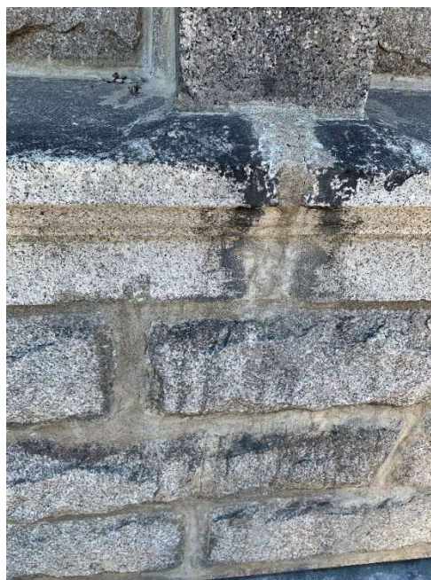
Photo 24 : Fissure dans l'enveloppe avec pierre de parement fracturée
