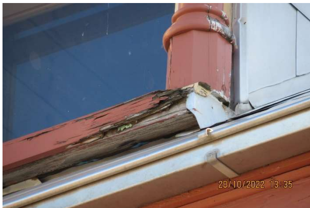
34 Allège de lucarne endommagée
