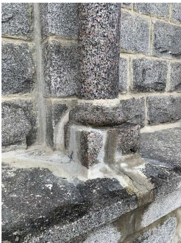
Photo 13 : Bris de la base d'une colonne de granit
