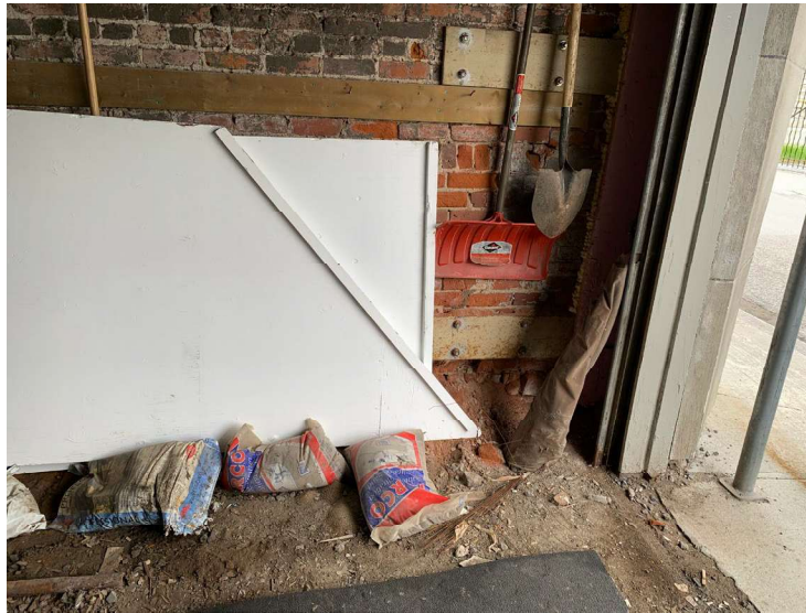
Photo 6 : Dégradation ponctuelle du mur sud-ouest
