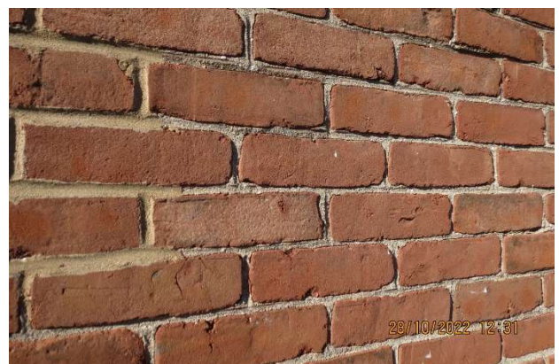
24 État des joints de mortier
