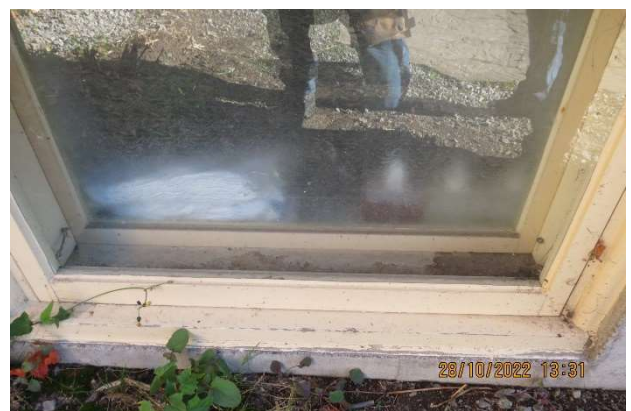
37 Fenêtre de sous-sol inefficace
