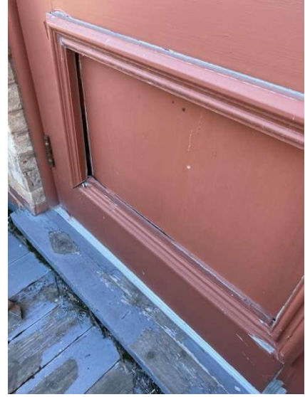
45 Porte du balcon Est endommagée
