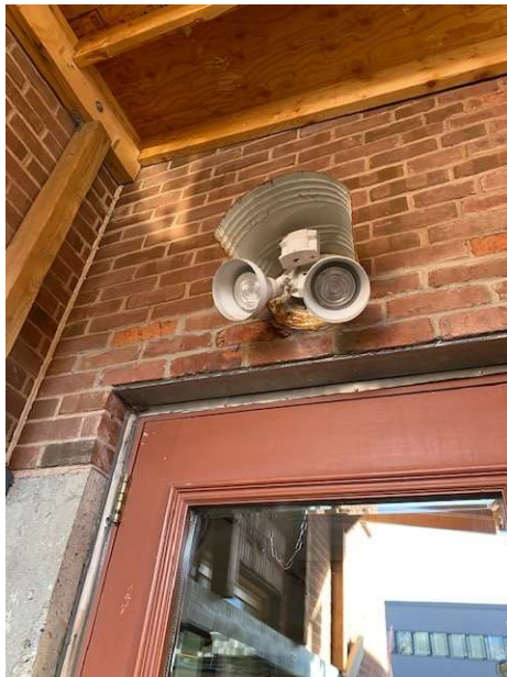
28 Section de briques endommagées
