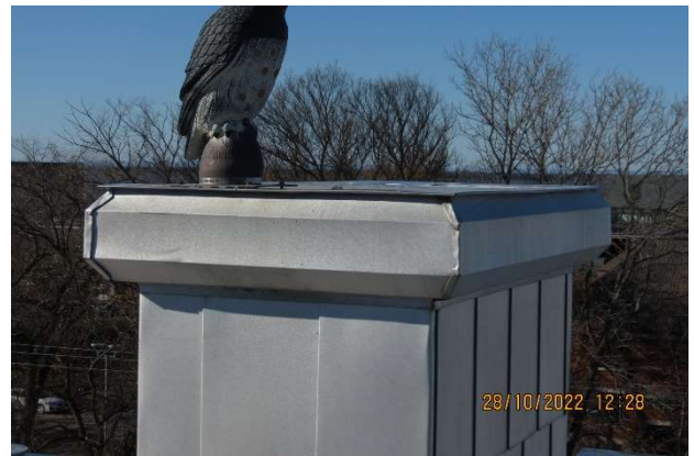
10 Source probable d'infiltration
