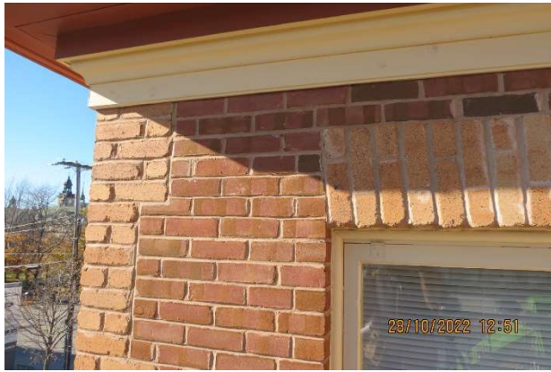
25 Fissures joints de mortier
