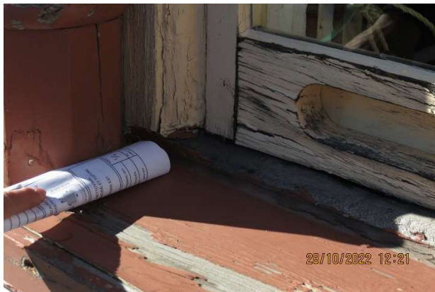
32 État typique des Contre-fenêtres
