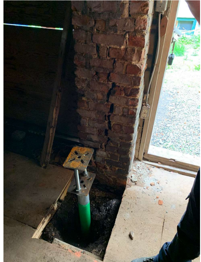
Photo 4 : Fissure importante dans un pilastre
