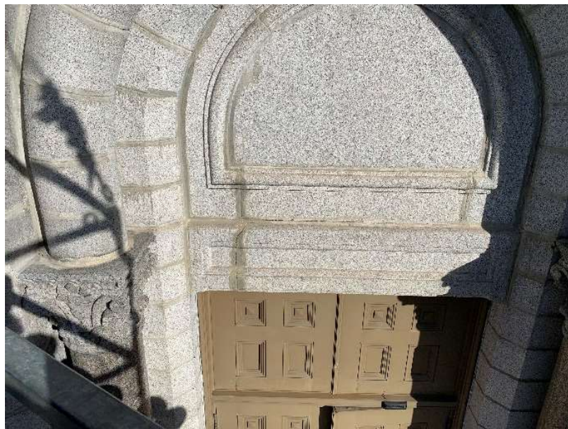
Photo 15 : Propagation de la fissure jusqu'à la l'arche de la fenêtre sous-jacente
