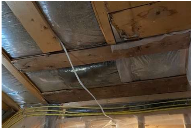
11 Traces d'infiltration observées
