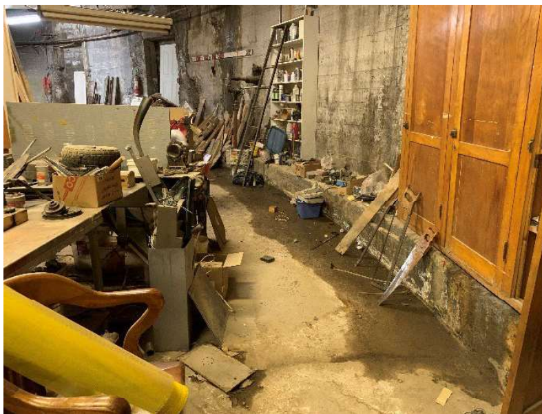
Photo 1 : Humidité à la base d'un mur et trace d'efflorescence
