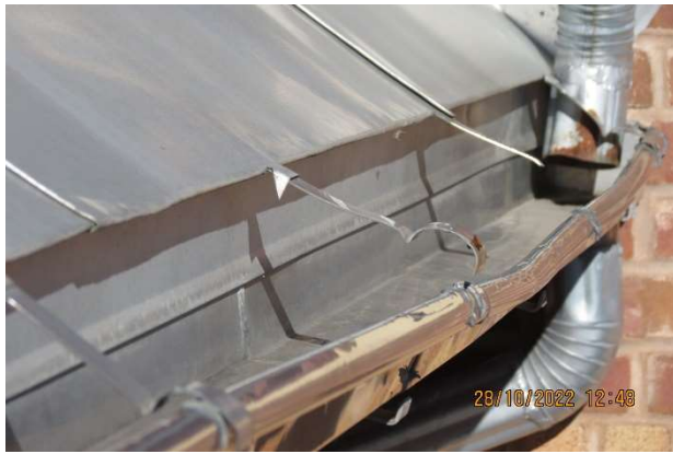
13 Attaches de gouttière endommagées
