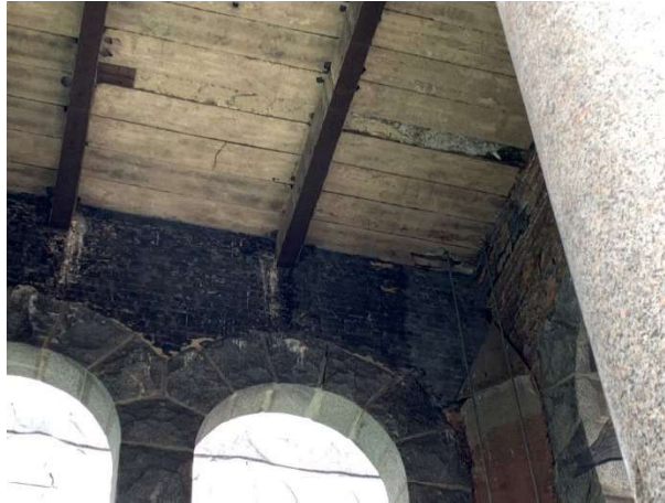
Photo 27 : Fissure au sommet du clocher est et bris des dalles de béton
