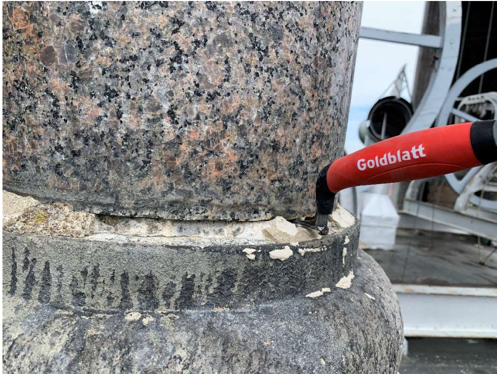
Photo 31 : Joint de maçonnerie endommagé
