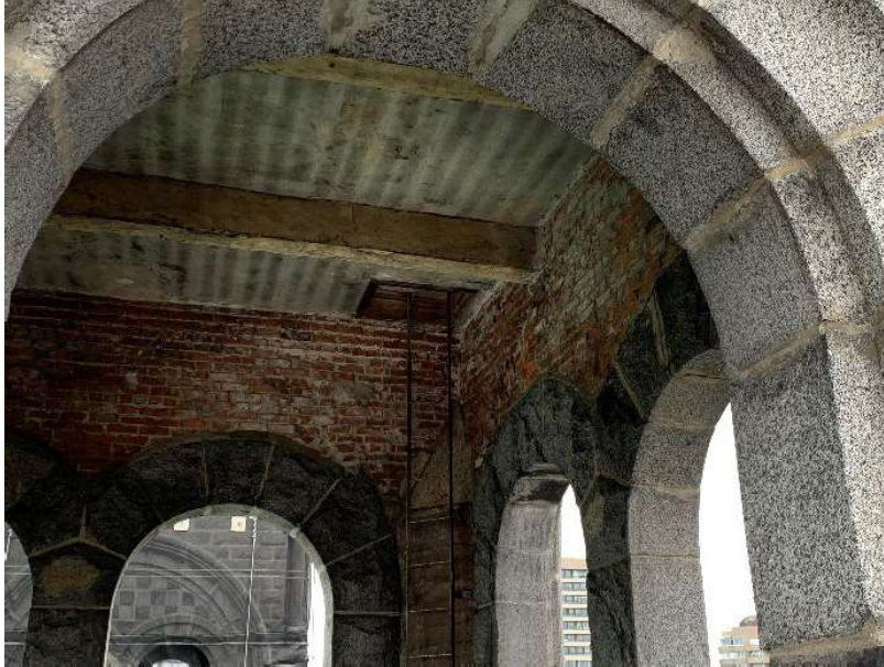
Photo 19 : Dégradation de la maçonnerie de briques
