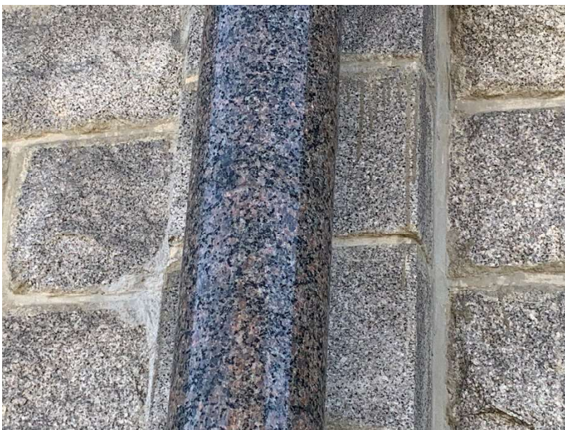
Photo 26 : Fissure horizontale sur une colonne de granit sur la face est
