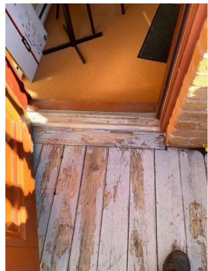
43 État typique des seuils de porte
