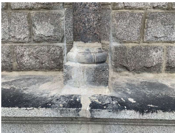
Photo 30 : Bris de la pierre d'assise d'une colonne de granit
