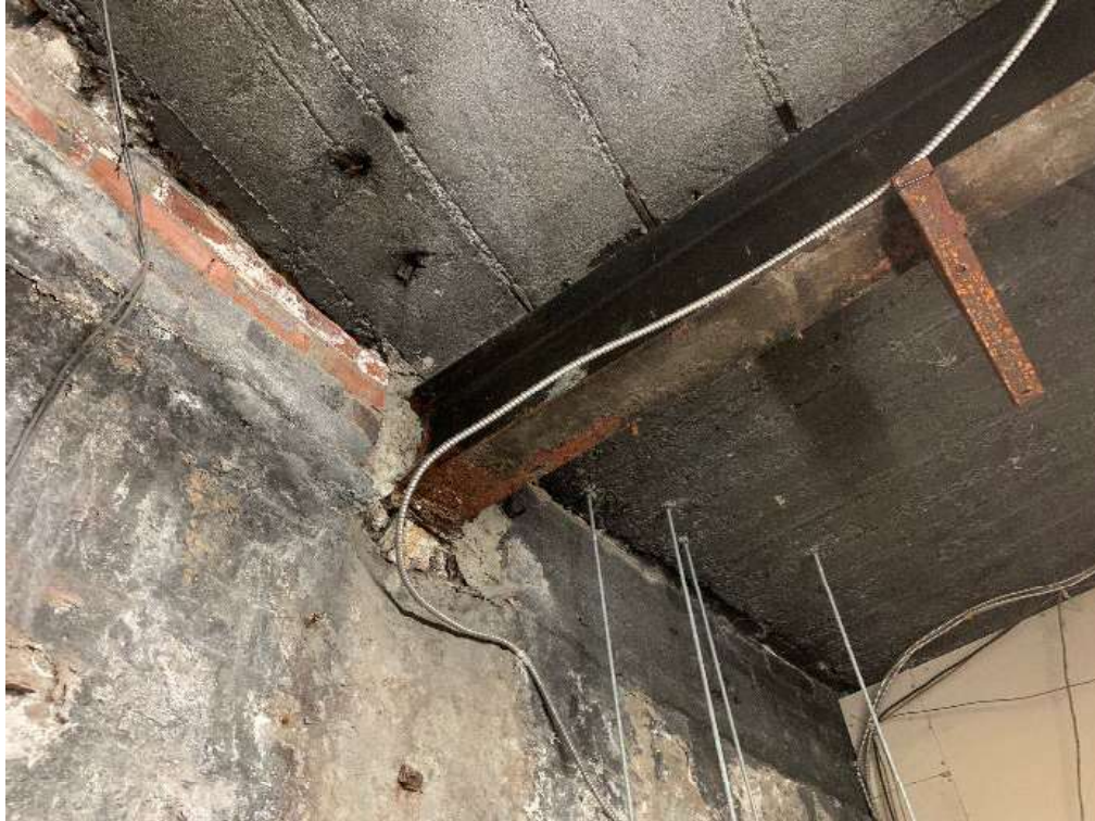
Photo 10 : Exemple de poutre d'acier corrodée dans la dalle surplombant la chaufferie
