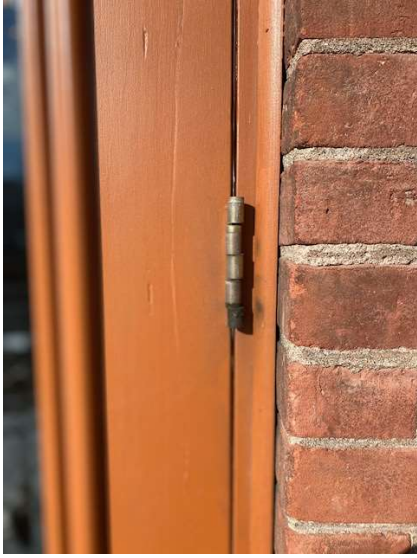
44 Porte Sud charnière endommagée
