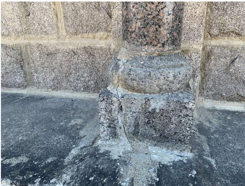
Photo 25 : Fissure sur une pierre d'assise d'une colonne de granit sur la face est
