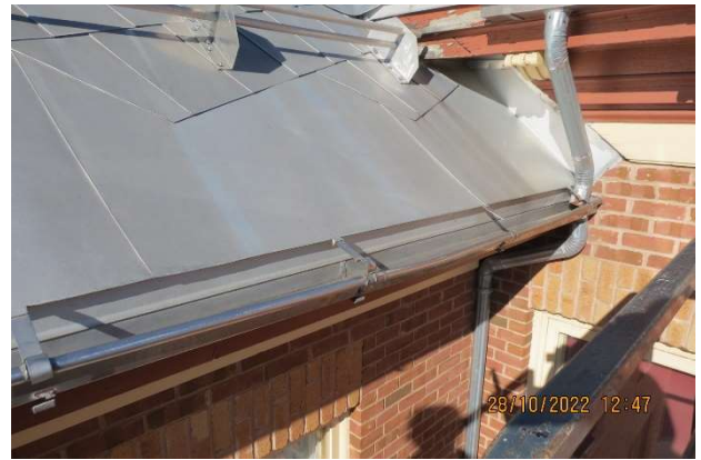
12 Section de gouttière endommagée
