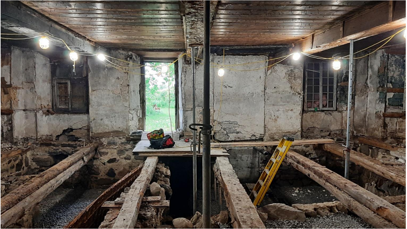
Figure 11. Aperçu des poutres supportant le plancher du rez-de-chaussée et de l'étage, après dégarnissage et retrait des différentes surfaces. Vue vers le sud.
