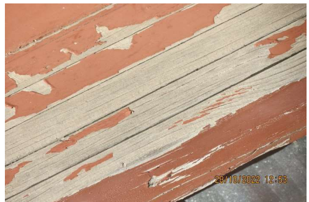
33 Allège de fenêtre délamérée typique
