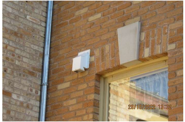
53 Sortie de ventilation typique
