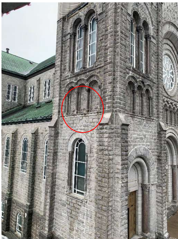
Photo 12 : Localisation du défaut
