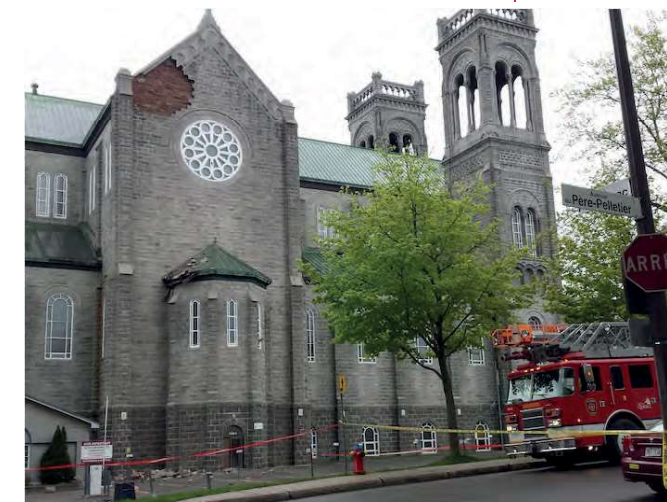
Écroulement d'une partie de la maçonnerie, 2017. Source : Radio-Canada.
