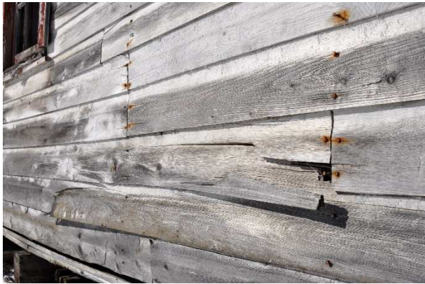
Image 13. Détail du parement de la chalouperie. Sur le mur exposé au soleil (côté baie), c'est davantage l'érosion, le gauchissement et le fendillement qui détériore le parement, tandis que de l'autre côté, c'est davantage la pourriture et les moisissures.
