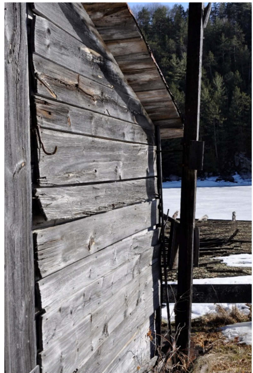
Image 12. Détail montrant le parement d'un appentis en planches horizontales. Plusieurs planches trop gauchies ou comportant des fentes profondes et traversantes devront être remplacées.
