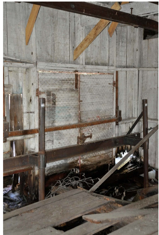
Image 6. Détail montrant l'état des murs et d'une porte de la menuiserie donnant du côté terre. On remarque que toutes les parties basses sont dans un état de pourriture avancée, voire complètement disparues. On remarque également la présence de pieux, d'une poutrelle et de renforts en bois ajoutés en 2009.
