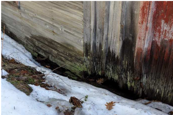
Image 15. Détail montrant l'état des parements à la jonction de la chalouperie et de la menuiserie. À droite, on voit le bas de la porte double qui correspond à celle présente sur l'image 6.
