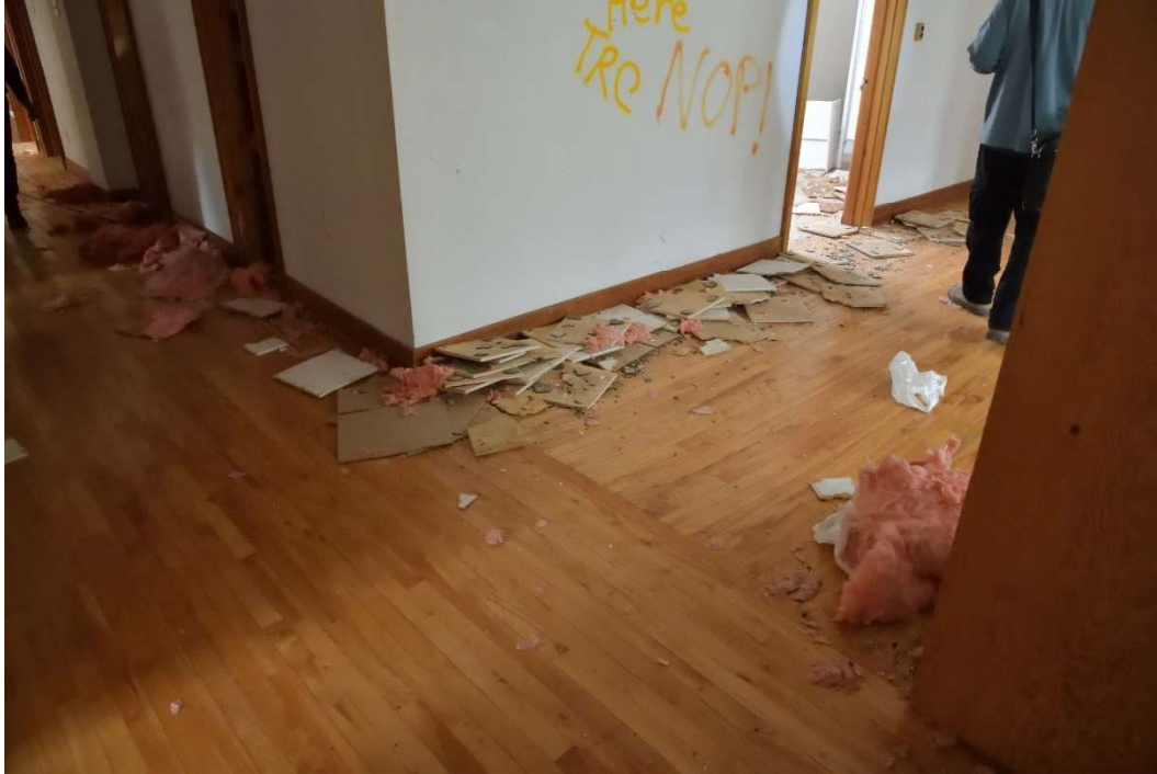
Photo 2021-12 : au dernier étage de l'aile construite en 1923, on note le soulèvement du plancher de bois franc dans un secteur où les drains de toit ont cédé et laissent pénétrer l'eau.
