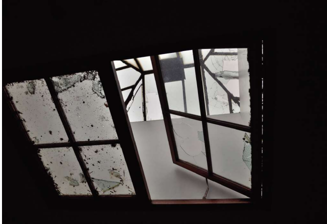
Figure 77. Lanterneau vandalisé et défoncé, BGLA
