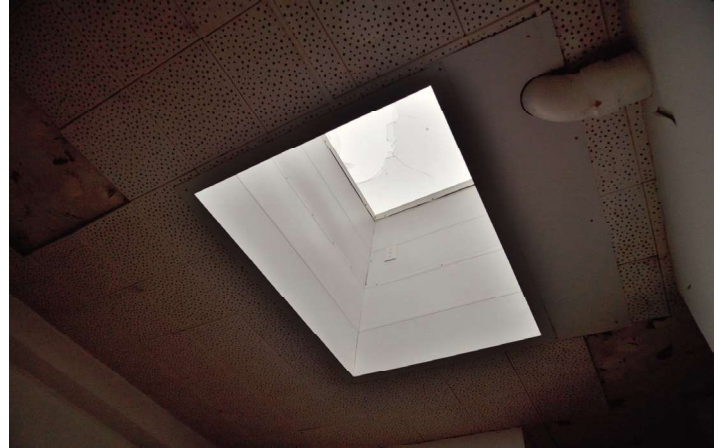
Figure 78. Lanterneau vandalisé et défoncé, BGLA
