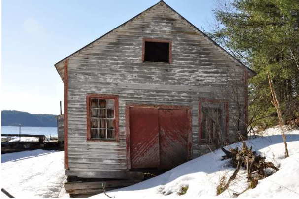
Image 1. Vue du mur pignon de la chalouperie. Ce mur est, dans l'ensemble, l'un des mieux conservés du bâtiment.
