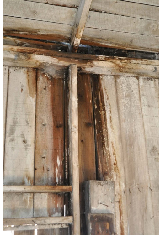
Image 8. Détail montrant une zone d'infiltration ayant causé la pourriture du chevron et des autres composantes sous-jacentes.
