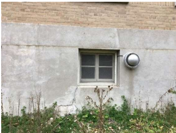
Photo 14 : Fissuration typique d'une fissure au droit d'une fenêtre
