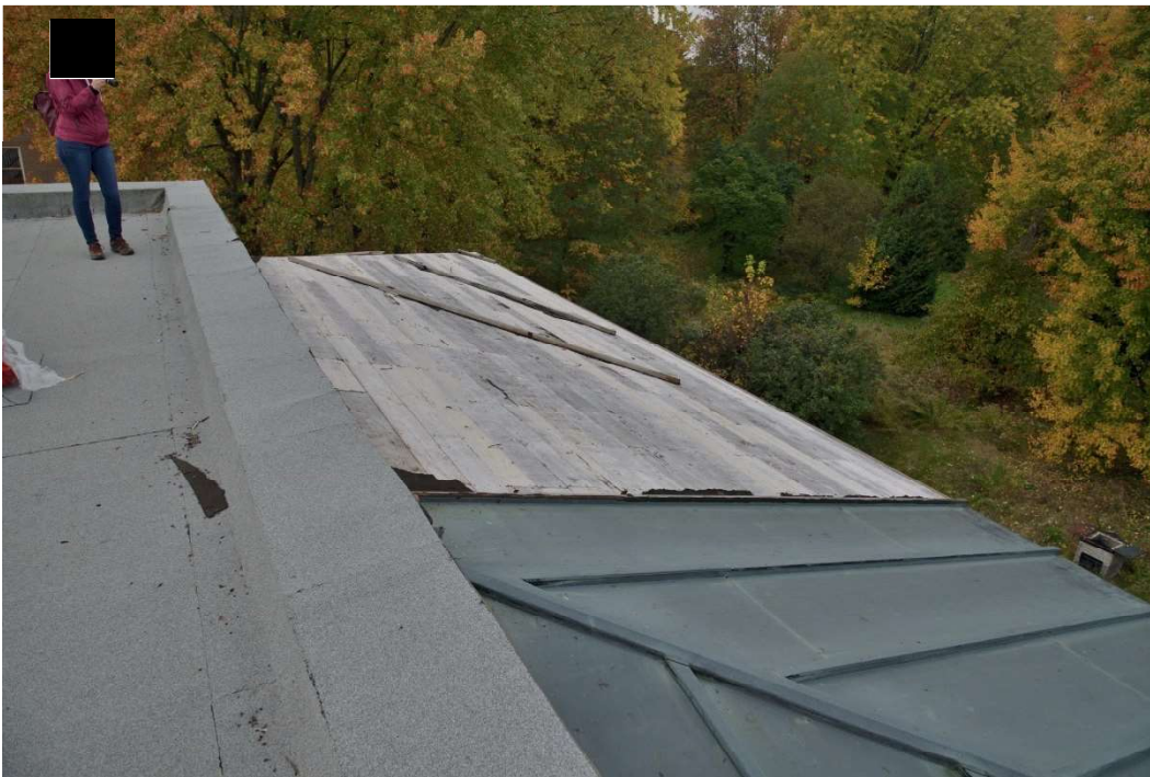
Photo 2021-04 : couverture de cuivre volée, toit du balcon nord-est.
