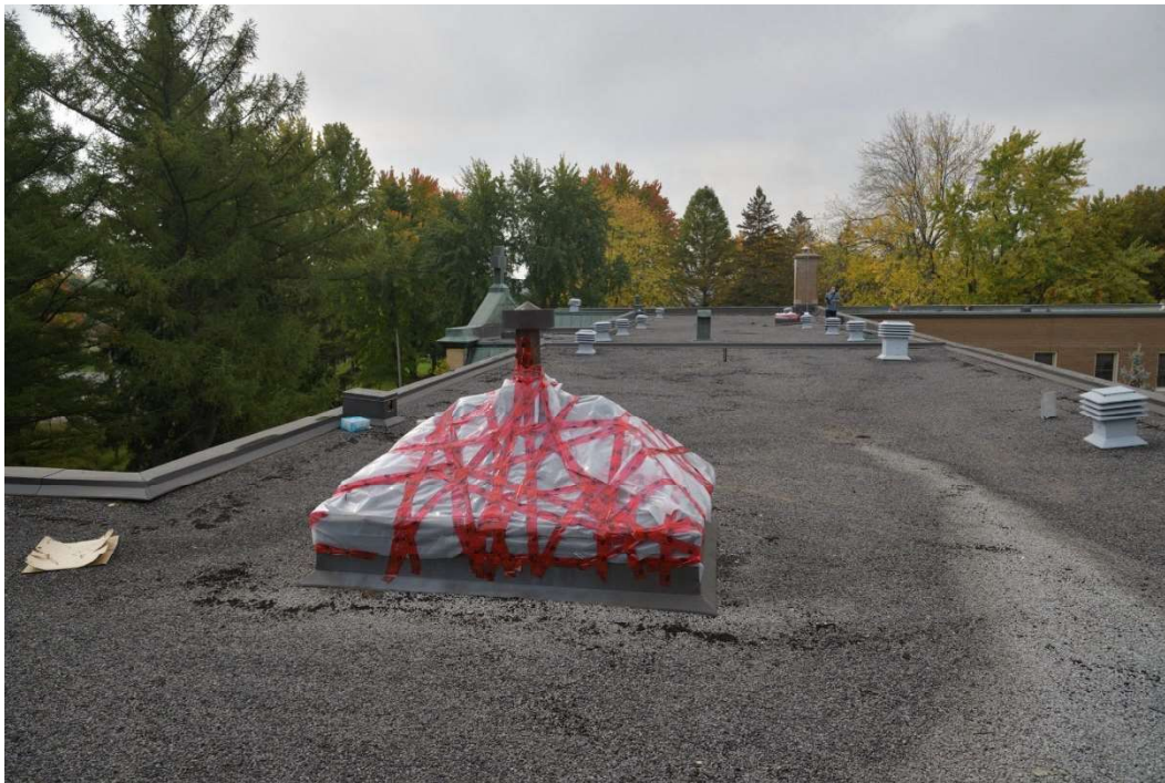
Photo 2021-09 : vue d'un puits de lumière au coin sud-est de l'édifice, fermé de façon rudimentaire par du polyéthylène maintenant déchiré et qui était maintenu en place par du ruban de type « duct tape ».
