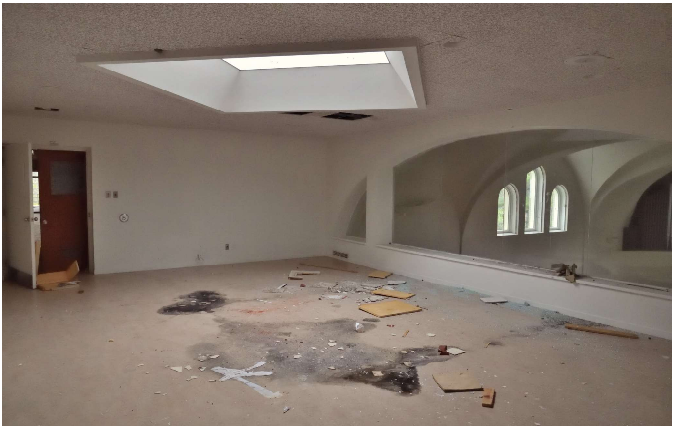
Figure 76. Infiltrations dues au vandalisme, BGLA
