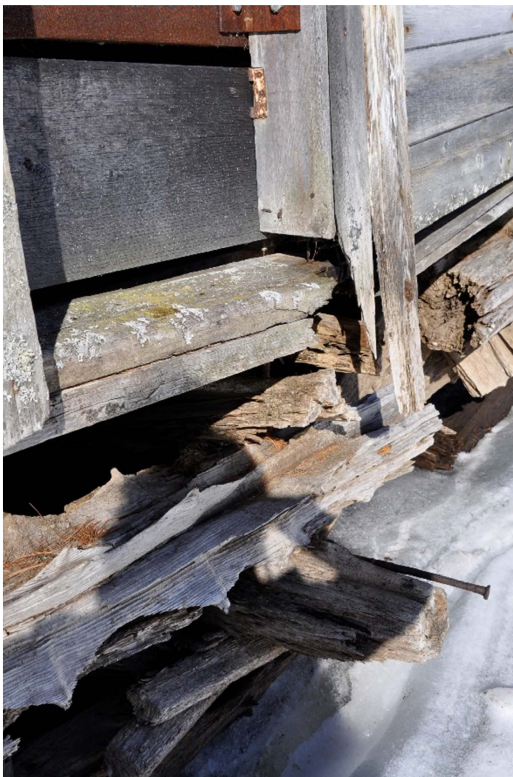
Image 5. Détail montrant une partie du soutènement en caissons de billots à claire-voie. La plupart des troncs sont excessivement érodés, et la jonction entre les deux parties de l'édifice semble être un point faible de cette structure.
