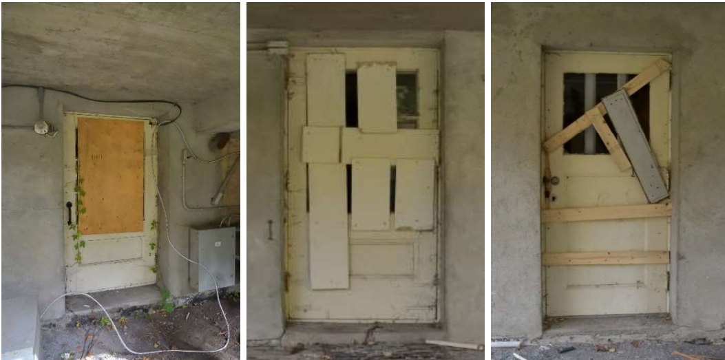
Photos 2021-01 à 03 : portes défoncées et barricades de façon rudimentaire, têtes de vis accessibles de l'extérieur.
