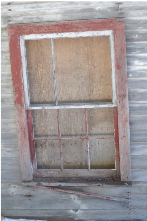
Image 11. Détail montrant l'une des fenêtres les mieux conservées du bâtiment. Les chambranles pourront être démontés, restaurés en atelier puis remis en place. Notons que le châssis du haut est blanc, tandis que celui du bas est rouge.
