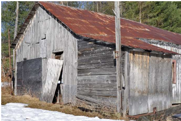
Image 3. Vue du mur pignon de la menuiserie. Sur la droite, les portes de l'appentis sont disparues, et l'ouverture a été placardée. Le mur pignon a également été placardé sur ses ouvertures et sur le bas du mur.
