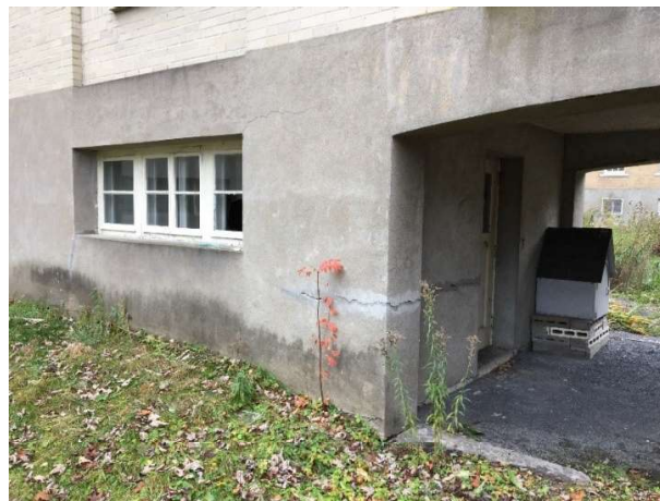
Photo 13 : Fissuration du mur nord
