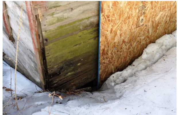
Image 16. Détail montrant l'état du parement de la chalouperie, côté terre. De ce côté moins ensoleillé, les moisissures et la pourriture sont très présentes.
