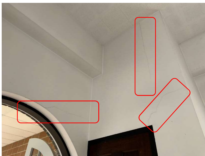
Photo 25 : Fissures types dans une cloison intérieure (inspection d'octobre 2021)
