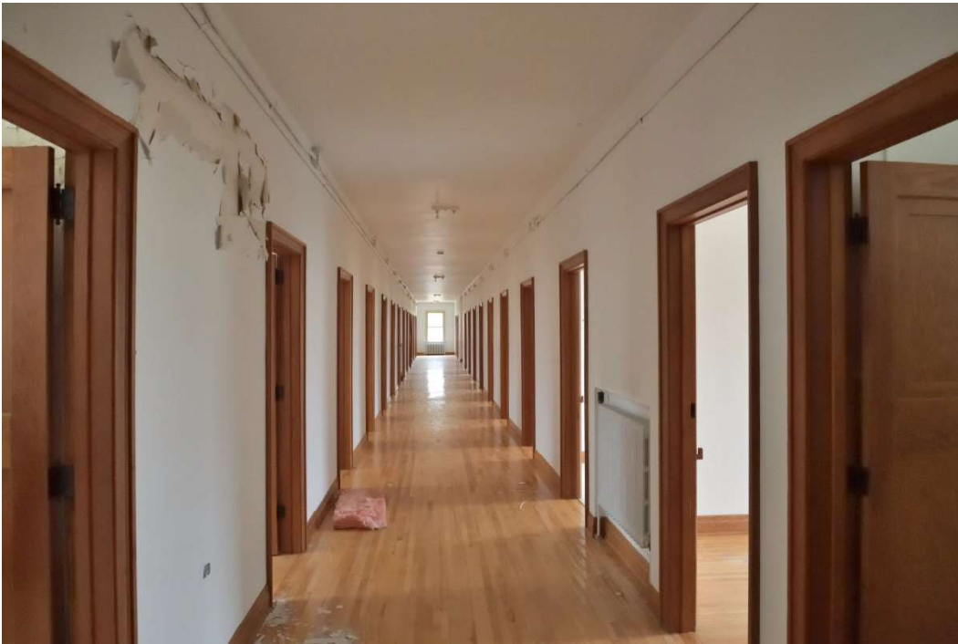
Photos 2020-07 : corridor de l'aile 1950, à l'étage : traces d'infiltration d'eau par un drain de toiture sur le mur à gauche, sinon les finis sont en bon état, entre autres le plancher de bois.
