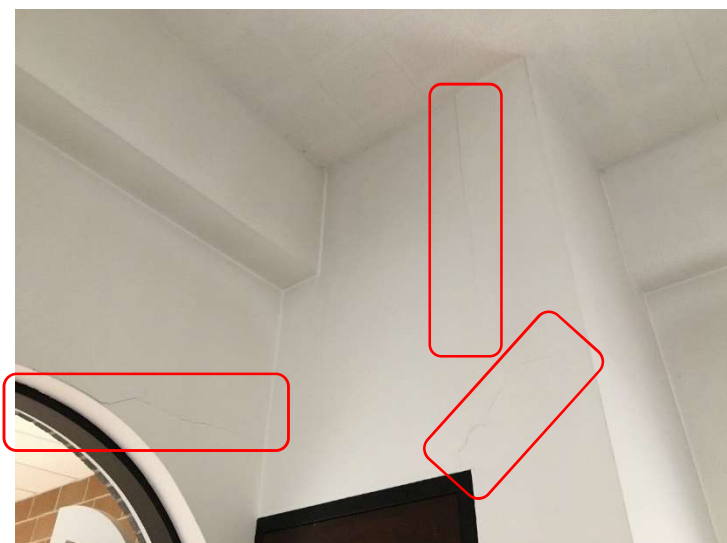
Photo 25 : Fissures types dans une cloison intérieure (2020)
