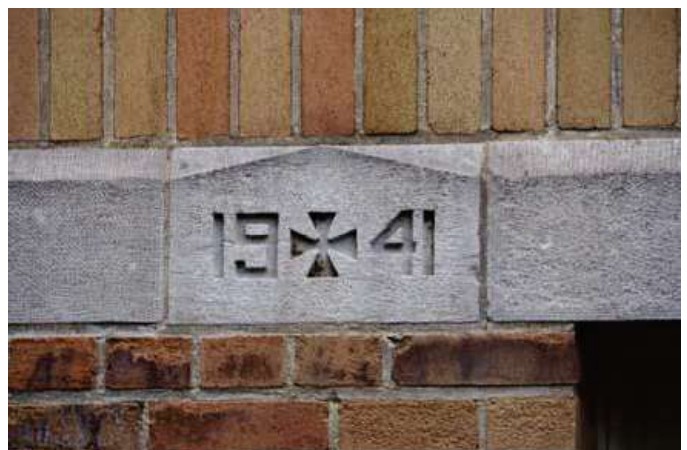
Pierre de date (1941) intégrée à un bandeau en pierre de l'avant-corps est.
