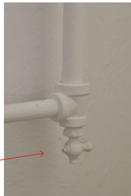
Figure 83. Par la présence de peinture enrobant cette valve, nous constatons que les dispositifs de vidange n'ont pas été ouverts lors de la fermeture du bâtiment. L'eau résiduelle dans le système de chauffage n'a pas été drainée, BGLA
