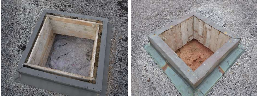
Photo 2021-07 et 08 : quelques-unes des trappes d'accès au toit ventilé enlevées, ouvertures laissées libres où l'eau pénètre.
