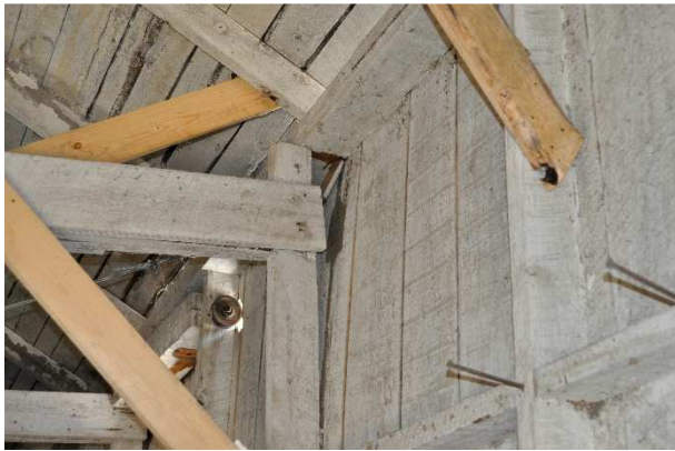
Image 9. Détail montrant une dislocation du parement vertical de la menuiserie en raison de torsions latérales causées par l'affaissement de l'édifice. L'absence d'entrants fixés aux chevrons rend ce type de déformation très probable.
