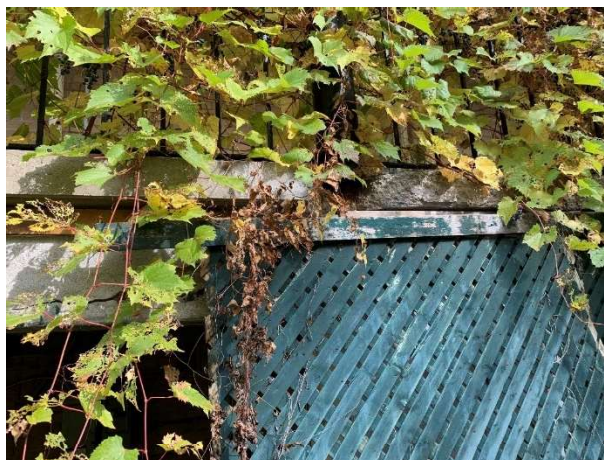
Photo 19 : Appui partiel d'une colonne de l'étage du balcon ouest
