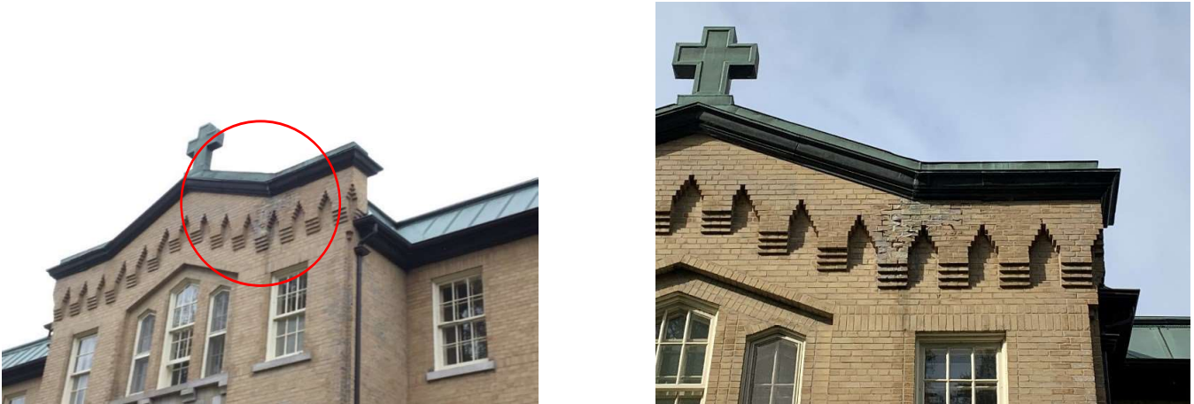
Photo 4 : Dégradation de la brique façade sud (à gauche en 2020 et à droite en 2021)
