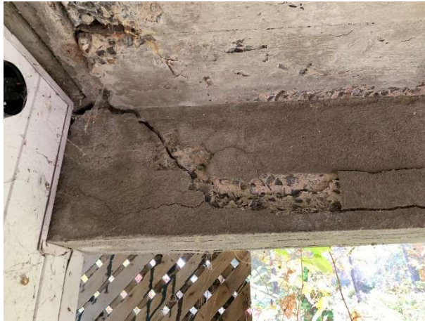
Photo 18 : Fissuration importante d'une poutre de béton du balcon ouest
