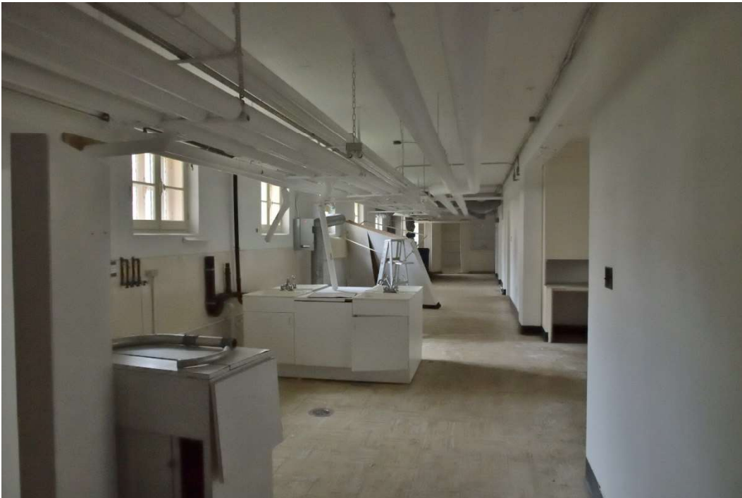
Photo 2020-02 : corridor sud au sous-sol. Quelques matériaux sont appuyés sur un mur, sans plus.
