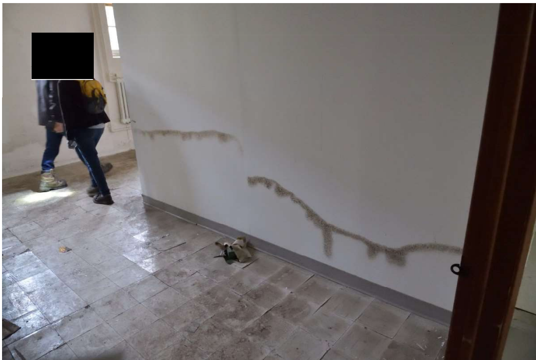
Photo 2021-11 : traces de moisissures résultant du contenu élevé d'humidité dans les matériaux en contact avec la dalle sur sol du sous-sol, ainsi que tuiles soulevées.
