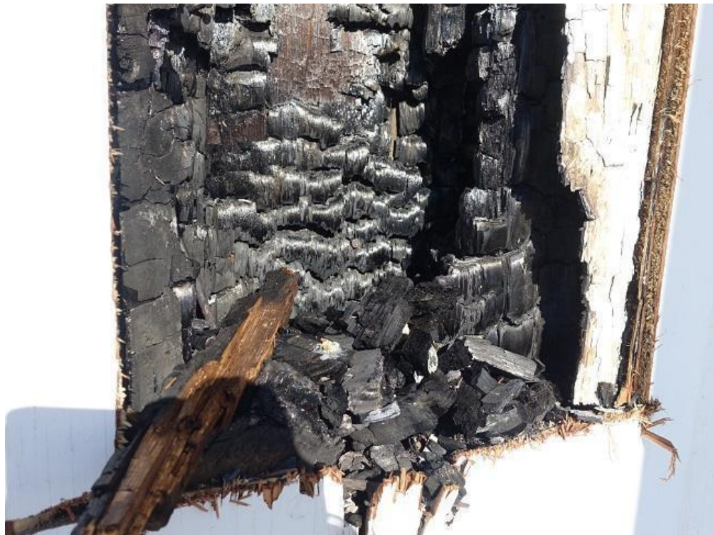
12) Manoir Taschereau après incendie vu du rez-de-chaussée. Idem détail.
