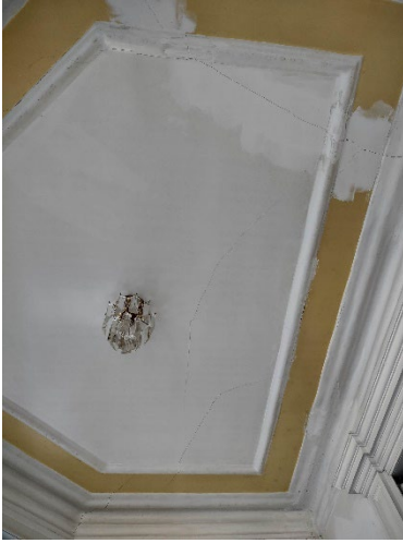
Exemple de réparation inadéquates au plafond du solarium
