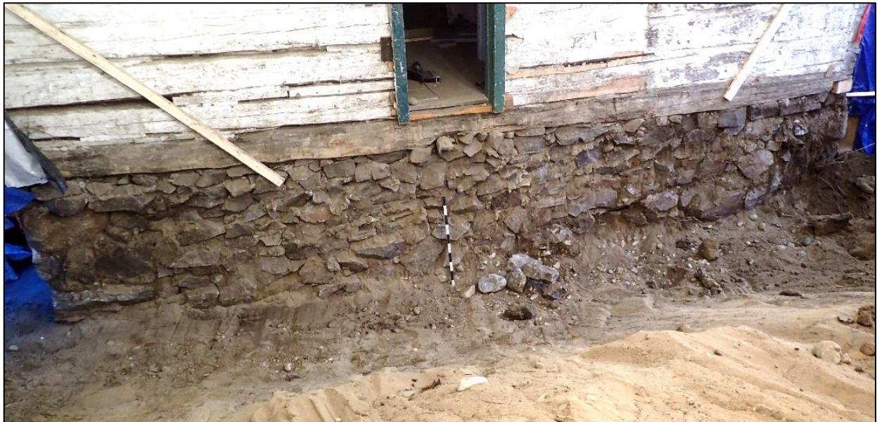
Figure 71 : Fondation nord de l'auberge Jodoin exposée après l'excavation à la pelle mécanique de la tranchée 11B et montrant un mode de construction différent des autres murs (vue vers le sud; photo #4111).
