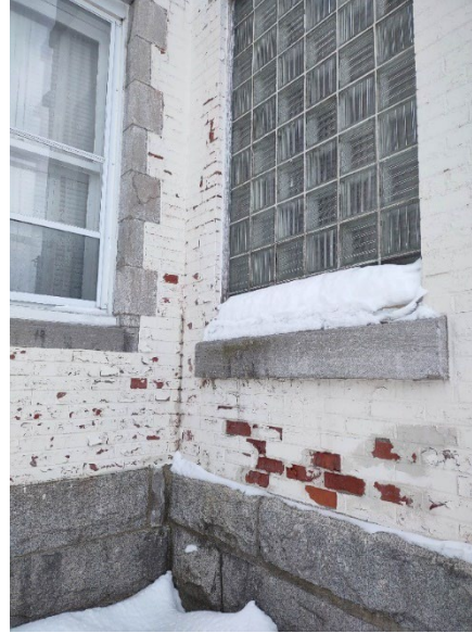
Exemple de briques éclatées
