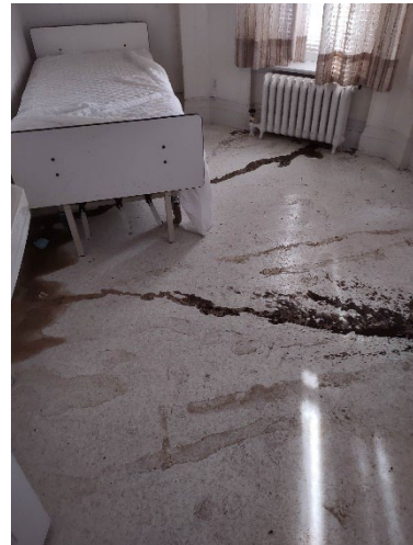
Exemple de dégât causé par l'éclatement d'un radiateur
