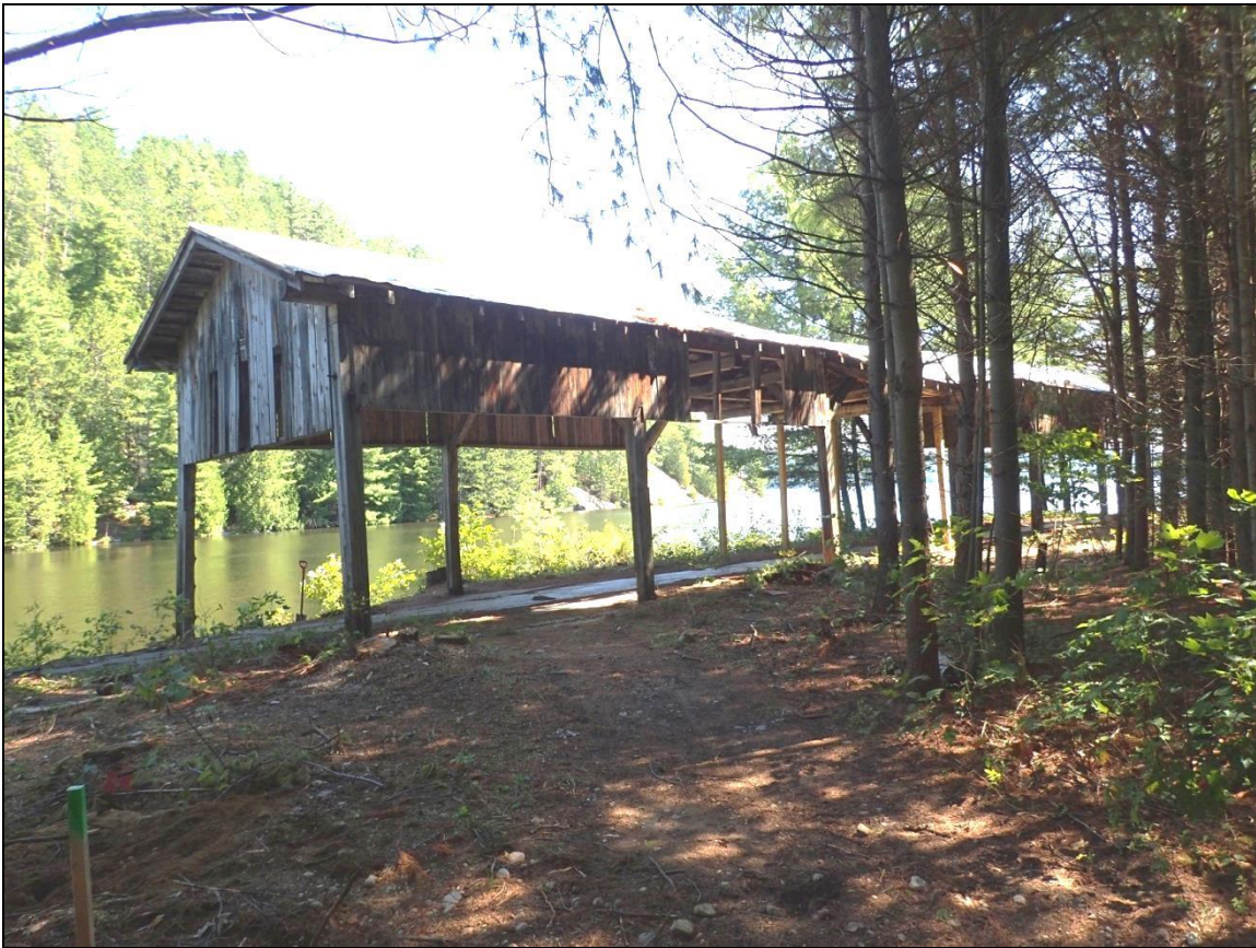
Figure 28 : Vue de la zone 2 au niveau du hangar à estacades (vue vers le sud-est; photo P9060036).
