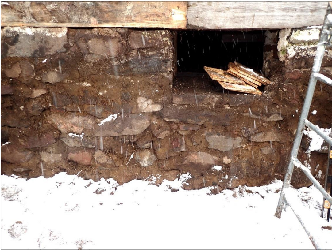
Figure 72 : Détail de la fondation ouest de l'auberge Jodoin exposée après l'excavation à la pelle mécanique de la tranchée 11B (vue vers l'est; photo #3735).
