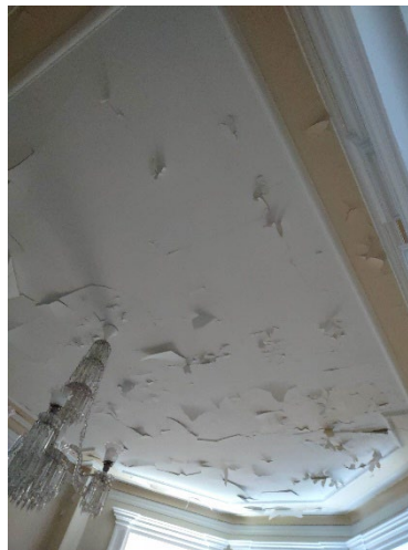
Exemple d'écaillage et de boursouffle
