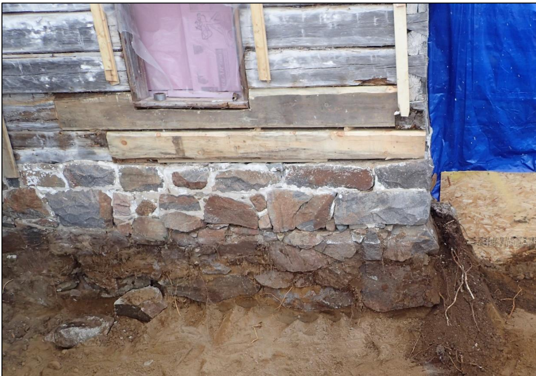
Figure 73 : Détail de la fondation sud de l'auberge Jodoin exposée après l'excavation à la pelle mécanique de la tranchée 11B (vue vers l'est; photo #3960).
