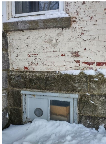
Exemple de briques éclatées
