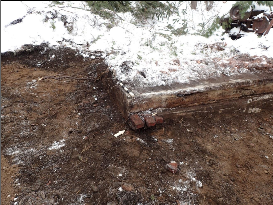
Figure 34 : Vue de la sous-opération 3C et du massif de béton soutenant le treuil à vapeur (zone 3) (vue vers le nord-ouest; photo PC062074).
