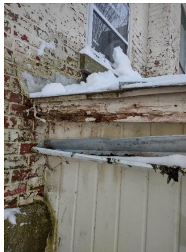
Gouttière et fascia endommagé
