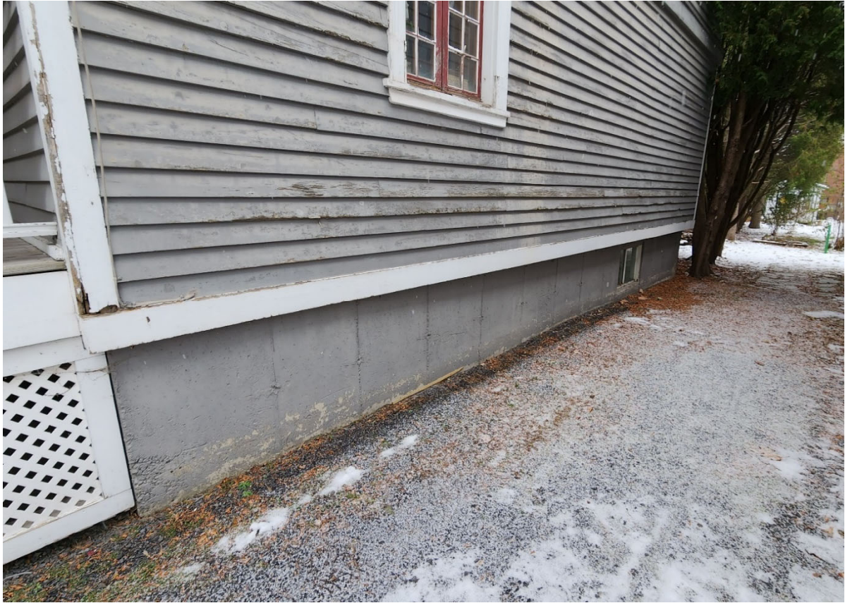
Photo 4. Une partie dégagée de la fondation révèle qu'elle a été remplacée récemment, impliquant d'importantes excavations à proximité des murs, vue vers le nord-est (VDB2248-22-NUM1-005)
