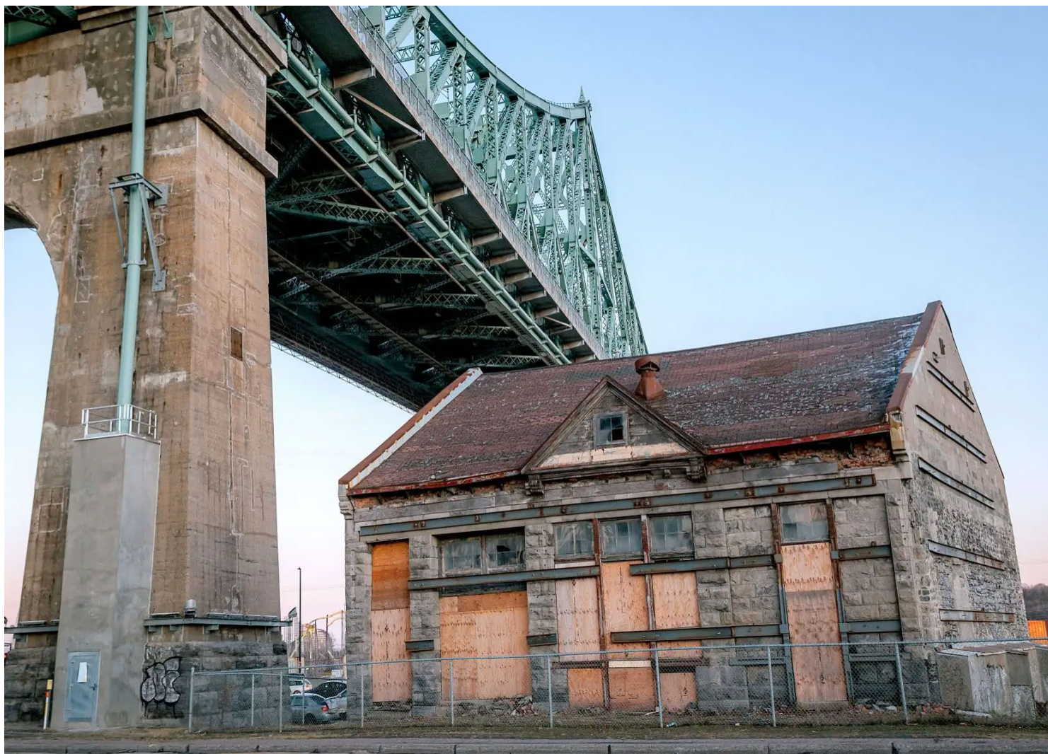
Photo: Valérien Mazataud Le Devoir La station de pompage Craig, située au pied du pont Jacques-Cartier
