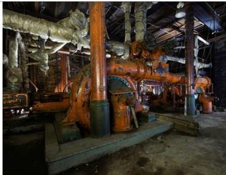
Station Craig | Pompes à vapeur Crédit photo : Archives de Montréal (Groupe CNW/Ville de Montréal - Arrondissement de Ville-Marie)
