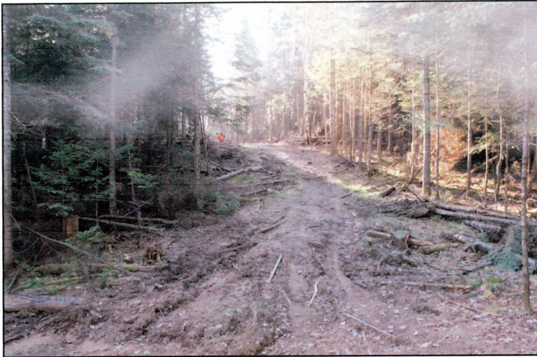
Photo 25 Projet 154-86-0721; secteur 5A, impact de la machinerie, direction est, partie sud.
