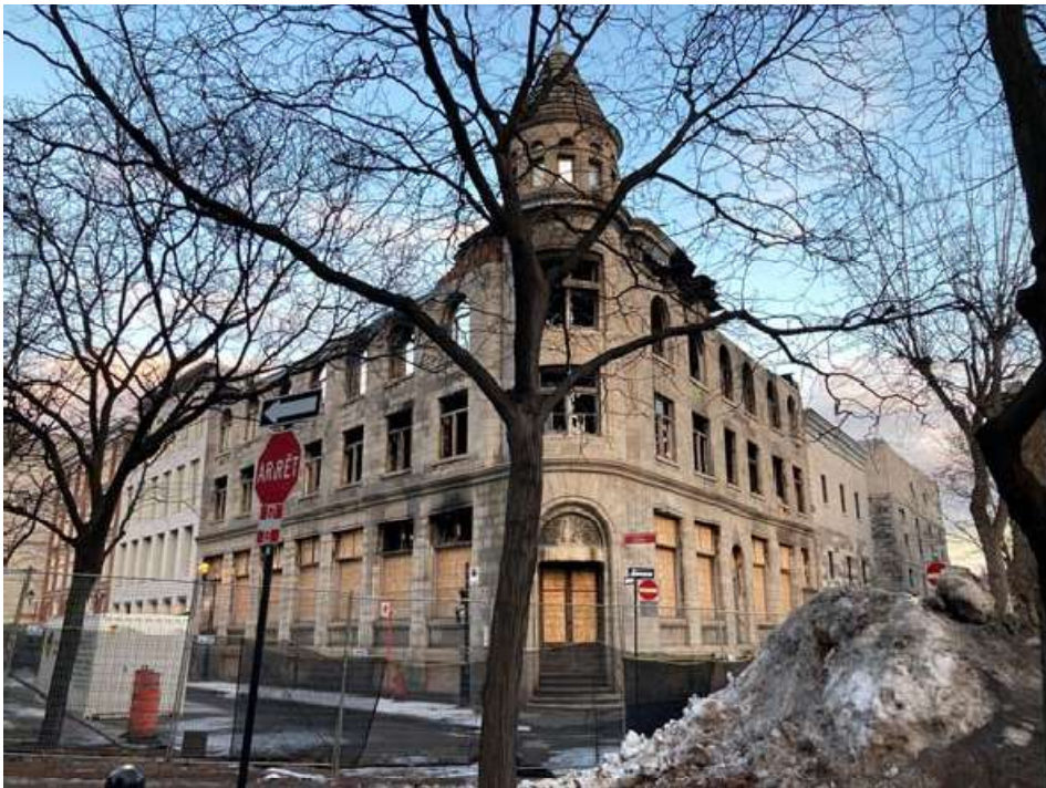
2. Vue du coin de l'édifice. On remarque l'absence de l'escalier de secours métallique.
