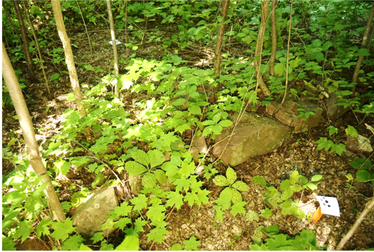
Photo ABL_7312 Vue vers l'ouest Mur est, segment centre La végétation camoufle le mur. Des arbustes poussent dans le mur.
