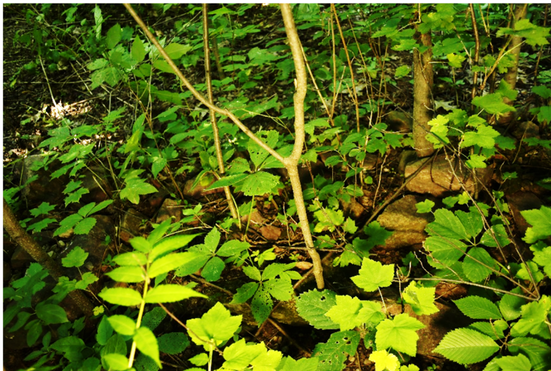
Photo ABL_7355 Vue vers le sud Mur nord, segment centre La végétation camoufle le mur. Des arbustes poussent dans le mur.
