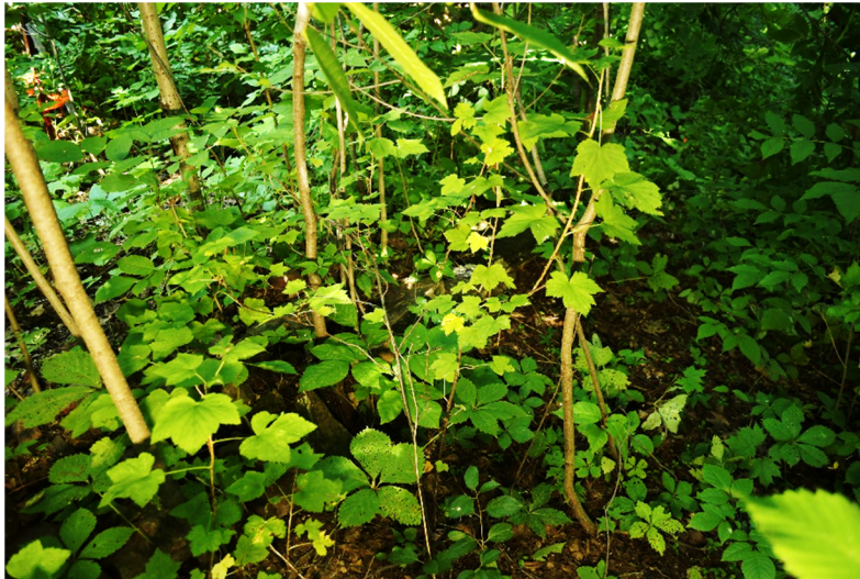
Photo ABL_7358 Vue vers le sud-ouest Mur nord, segment est La végétation camoufle le mur. Des arbustes poussent dans le mur.
