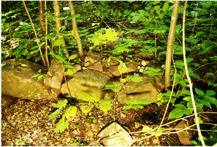
Photo ABL_7349 Vue vers l'ouest Mur est, segment nord La végétation camoufle le mur. Des arbustes poussent dans le mur.
