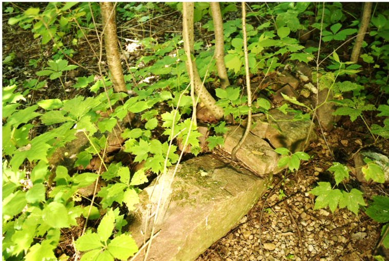
Photo ABL_7331 Vue vers le nord-ouest Mur est, segment centre La végétation camoufle le mur. Des arbustes poussent dans le mur.
