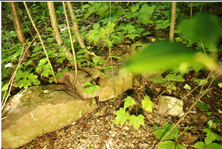
Photo ABL_7335 Vue vers l'ouest Mur est, segment nord La végétation camoufle le mur. Des arbustes poussent dans le mur.
