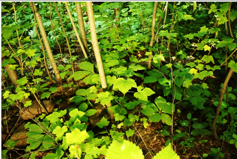
Photo ABL_7357 Vue vers le sud-ouest Mur est, segment nord La végétation camoufle le mur. Des arbustes poussent dans le mur.
