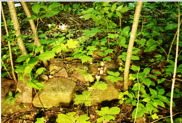
Photo ABL_7352 Vue vers le nord-ouest Mur est, segment nord La végétation camoufle le mur. Des arbustes poussent dans le mur.
