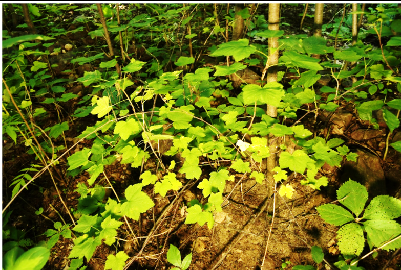
Photo ABL_7362 Vue vers le sud-ouest Mur nord, segment centre La végétation camoufle le mur. Des arbustes poussent dans le mur.
