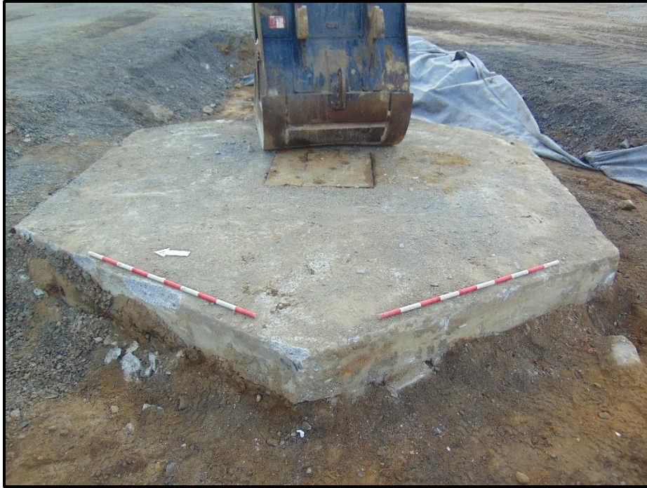
Figure 42 : Dalle de béton hexagonale et couvercle en métal composant la ST-12.
