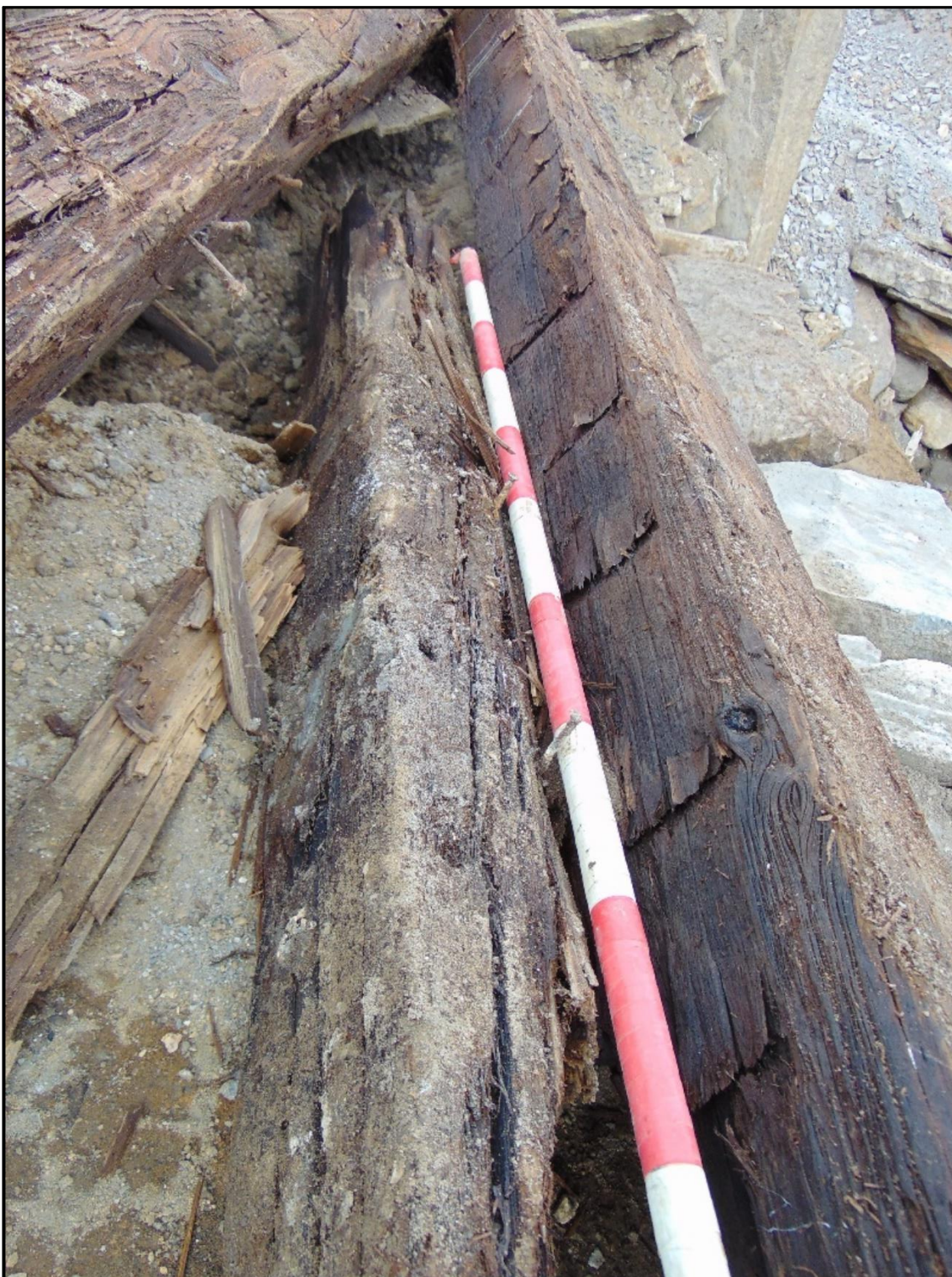
Figure 52 : Encoches sur un côté de l'une des poutres de bois
