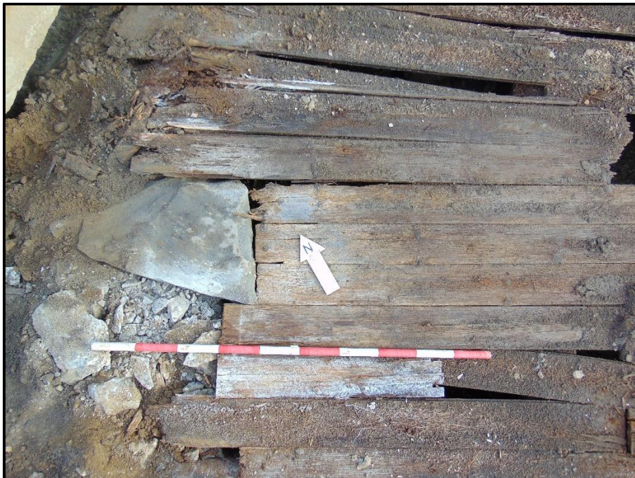
Figure 49 : Pierre proéminente qui explique l'obstruction partielle du trou laissé au centre du coffrage. On a préféré placer trois planches en retrait, plutôt que de retirer la pierre.
