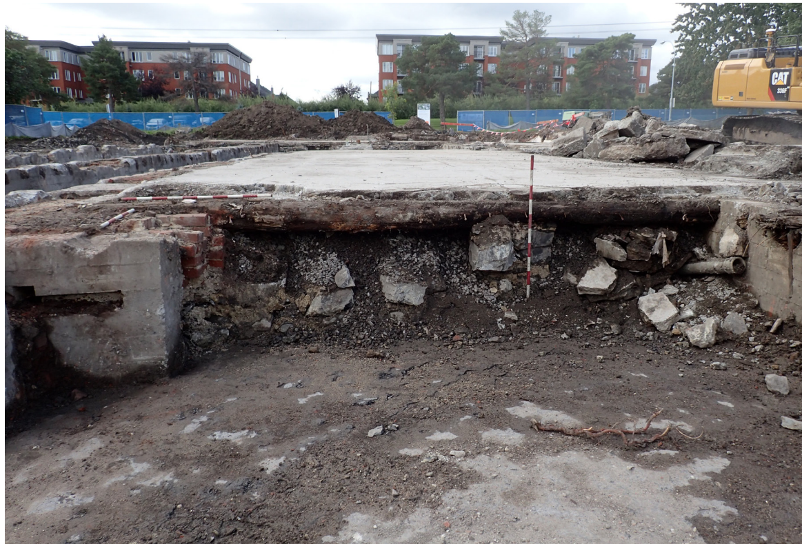
Photo 4.66 Longue solive bordant le terrazzo 9A121, entre 9A103 et 9A125. Vue vers l'ouest (photo PATR23N12_2307).
