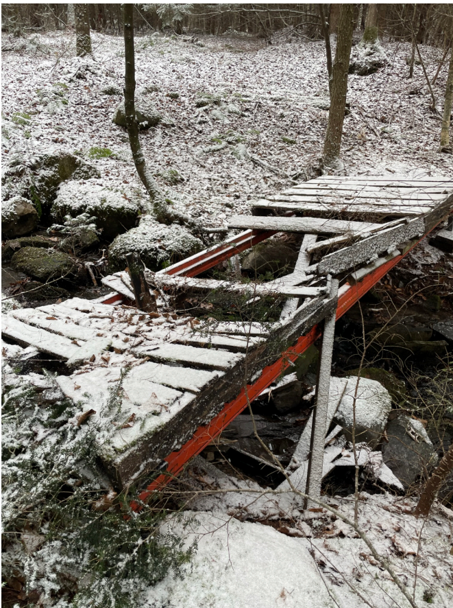
Photo 7.16 Petit pont délabré traversant le petit ruisseau, structure en métal et palettes de bois Photo Archéotec BOI23_ED1_1932
