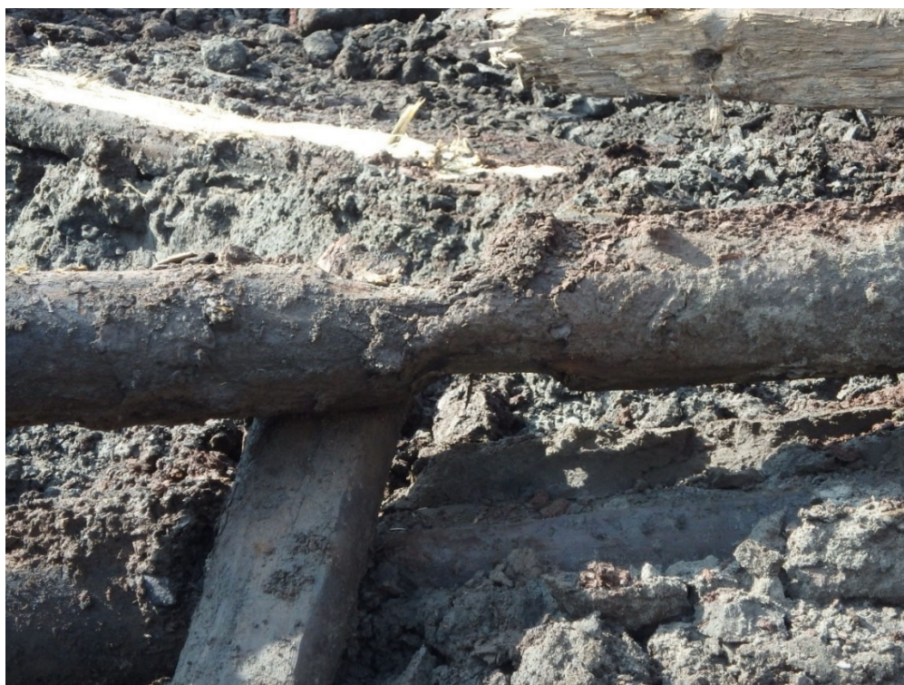
Photo 30. Encoches arrondies dans une pièce de bois (CeEt-982-2023-NUM2-116)
