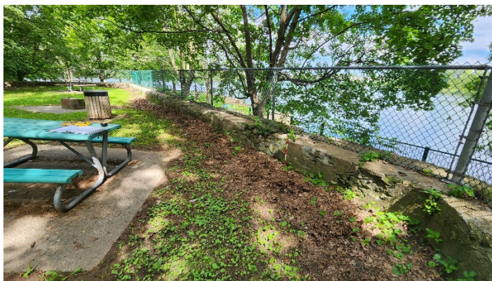
Photo 27. Un léger affaissement est observable vis-à-vis l'ouverture bouchée du centre, vue vers le nord (HYD2329-23-NUM4-023)
