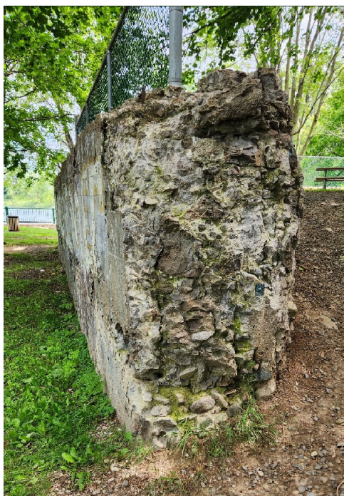
Photo 23. Le faciès partiellement démolé du mur permet d'apprécier la composition du béton de l'ouvrage. Un repère altimétrique est également présent dans l'ouvrage, vue vers le nord-est (HYD2329-23-NUM4-031)
