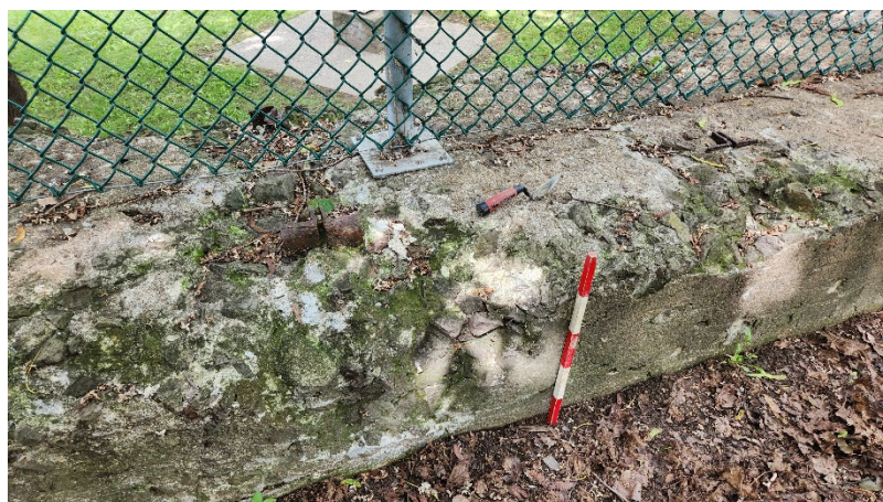
Photo 22. Des poutres de métal tronquées sont visibles au sommet du mur 2A2, vue vers le nord-ouest (HYD2329-23-NUM4-027)
