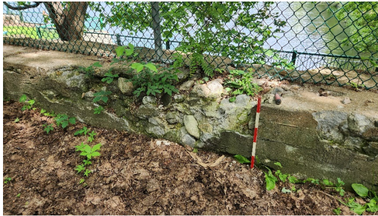
Photo 26. Le parement interne du mur 2A1 montre plusieurs traces évidentes de détérioration, vue vers le nord-est (HYD2329-23-NUM4-021)
