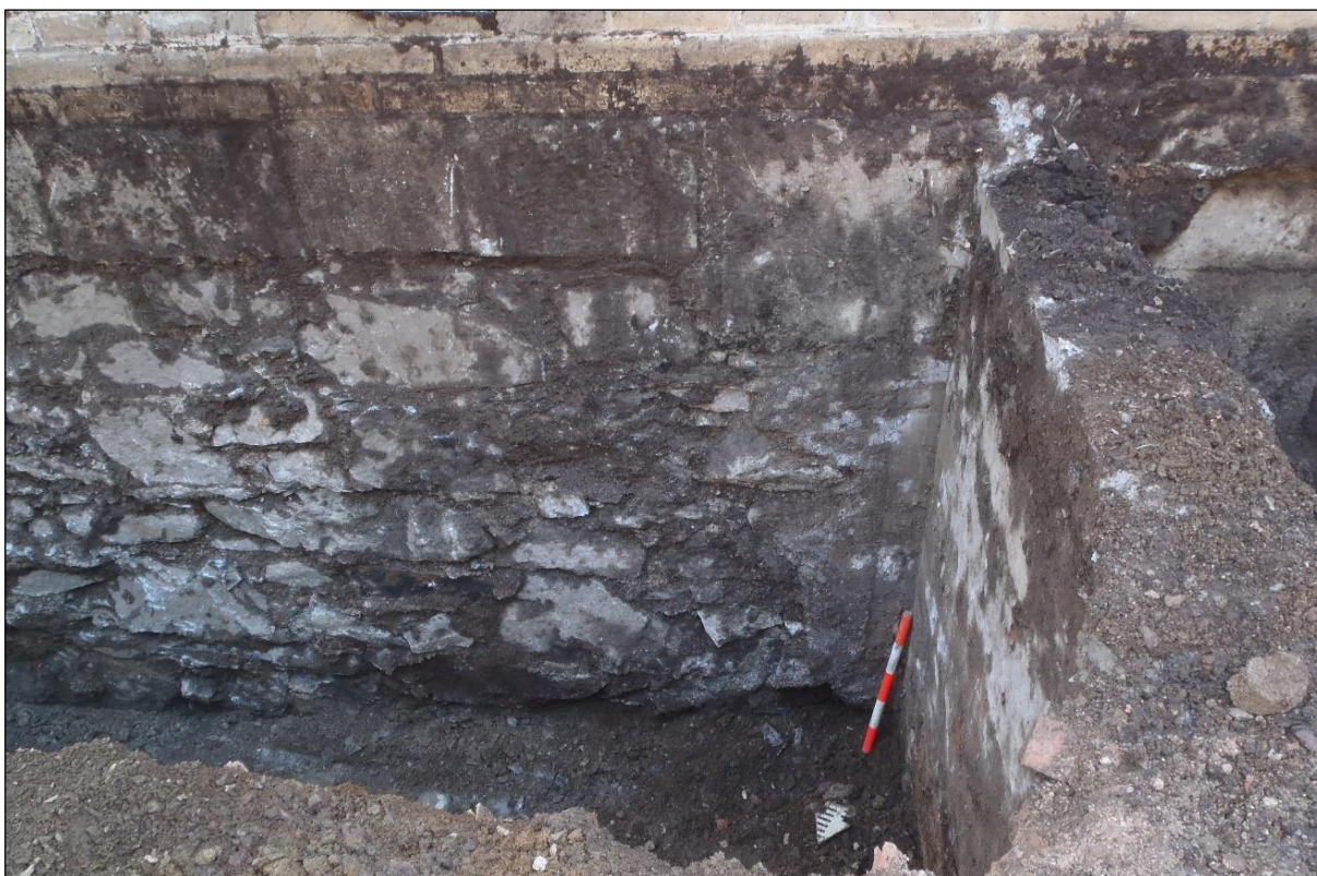
Photo 30. Présence d'un crépi de béton sur le mur de fondation ouest du corps central des anciennes écuries, au nord de l'entrée de cave relevée, vers le sud-est (TCI-CeEt-806-2023-089)
