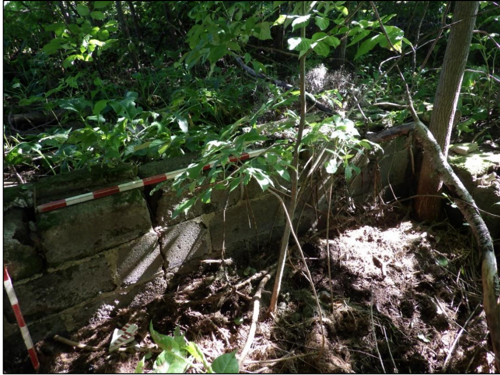
Photo 19. Jonction des murs est et sud d'un bâtiment partiellement effondré, vers l'est (TCI-MTQ-BAT-23-193)
