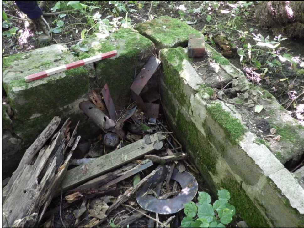
Photo 21. Jonction des murs sud et ouest du bâtiment partiellement effondré, vers le sud (TCI-MTQ-BAT-23-198)
