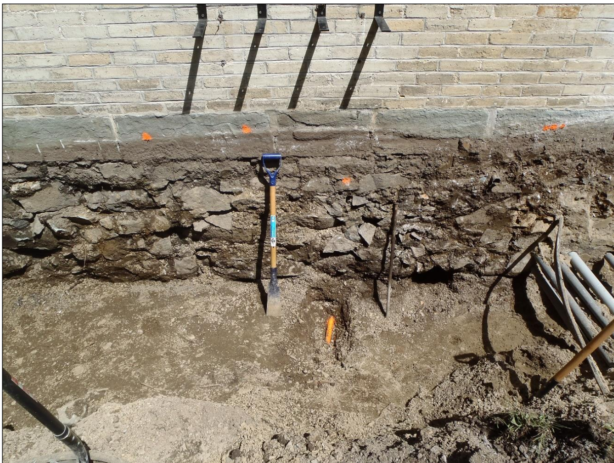
Photo 5. Conduite d'aqueduc en cuivre présente à la base du mur de fondation sud des anciennes écuries, vers le nord-nord-est (TCI-CeEt-806-2023-016)
