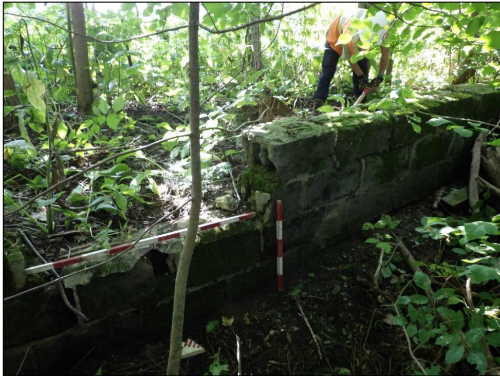
Photo 20. Seuil de porte visible dans le mur sud d'un bâtiment partiellement effondré, vers l'ouest (TCI-MTQ-BAT-23-195)
