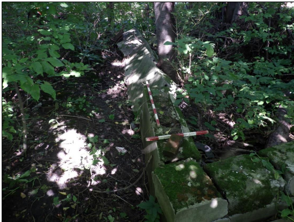
Photo 18. Mur nord d'un bâtiment partiellement effondré et sa jonction avec le mur ouest, vers l'est (TCI-MTQ-BAT-23-190)
