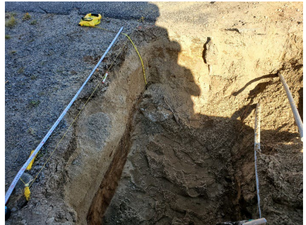
Figure 22 : Opération 5 – conduits électriques, vers le nord-est
