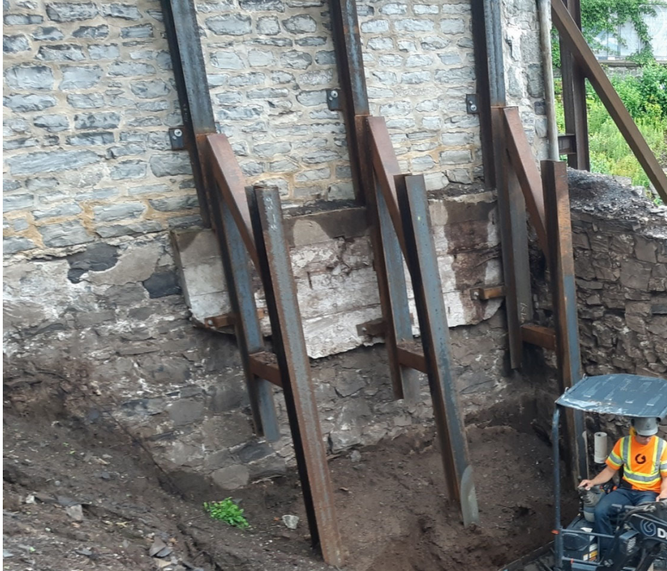
Photo 4. Restauration ancienne du mur CeEt-19-9A400 (mur L) par l'ajout de béton, vue vers le sud (CeEt-19-24-NUM1-223)
