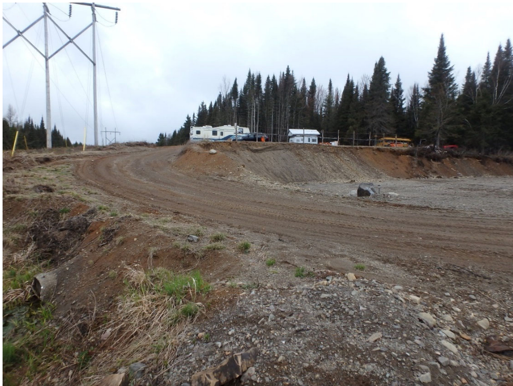
Photo 14. Zone P31, vue d'ensemble, vers le nord-ouest (HYD2356-2024-NUM1-83)
