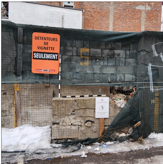
Photo 3.8 : Section 2, parement est. Vestiges de béton de nature inconnue cachant l'état A. Photo N1-65.
