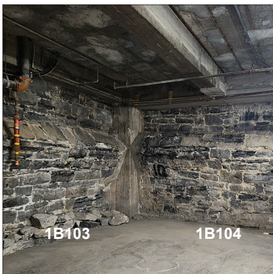
Photo 3.29 : Angle formé par 1B103 et 1B104 et liaison cachée par l'ajout d'un pilier de béton, vue vers le nord-est. Photo N1-8.
