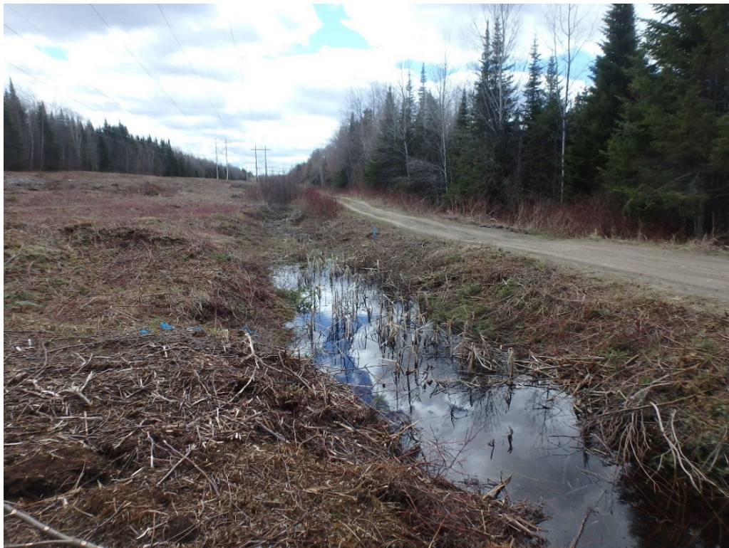
Photo 22. Zone P49, route et fossé inondé, vers l'ouest (HYD2356-2024-NUM1-35)
