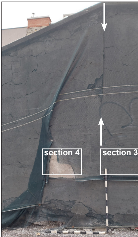
Photo 3.15 : Liaison non impliquée ayant fragilisé le recouvrement en crépi entre les sections 3 et 4, parement est. Photo N2-46.
