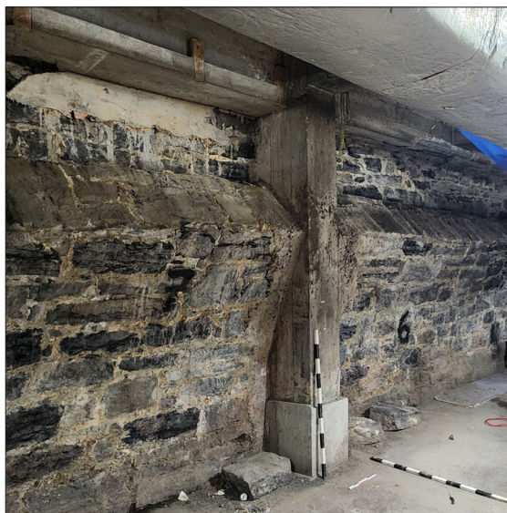
Photo 3.30 : Exemple d'altération par l'ajout d'un pilier de béton dans le parement du vestige 1B104, vue vers le sud-est. Photo N1-12.
