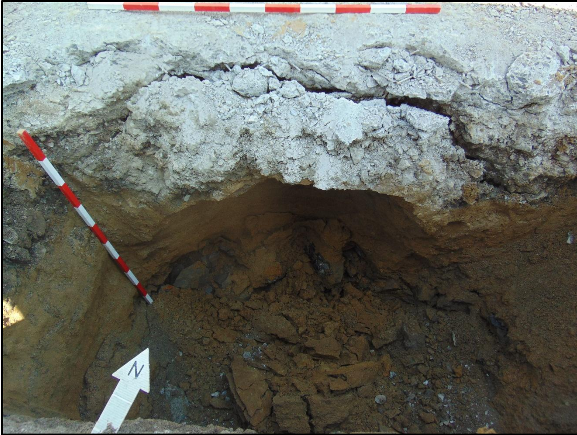
Figure 40 : Affaissement de la paroi nord du sondage mécanique 9A. Elle a justifié l'arrêt des excavations.
