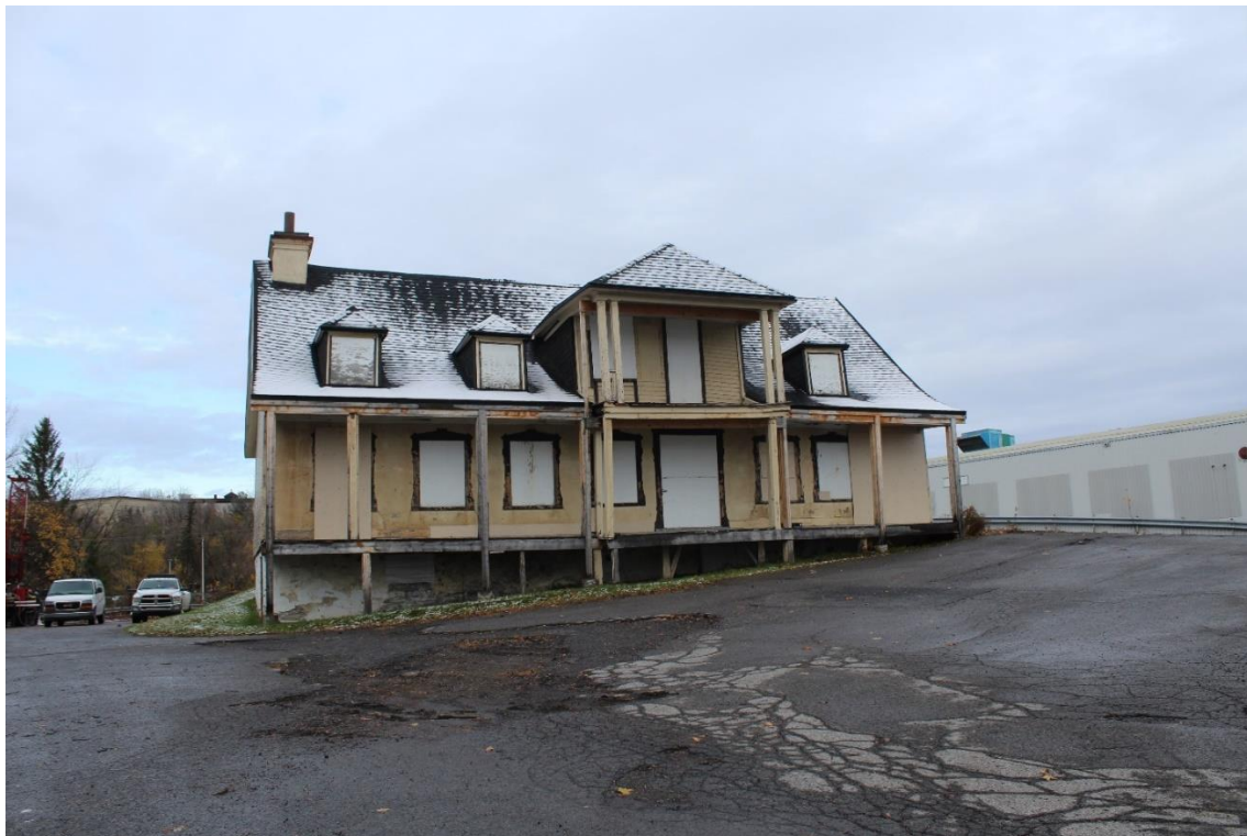
Photo 38 : Maison Salaberry-Juchereau-Duchesnay en 2020. Le crépi et la peinture blanche sont encore en relativement bon état.
