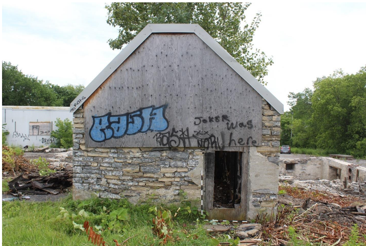
Photo 58 : Parement extérieur du nord du fournil, placardé à la suite de l'incendie de 1998.
