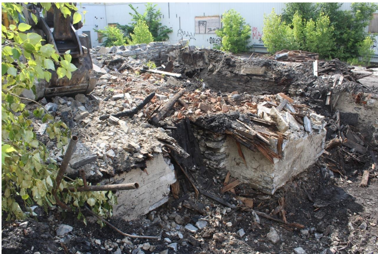
Photo 21 : Concentration de brique s'étendant vers l'est et prenant origine près du pilier de pierre 6A1000. Vue vers le sud-est.
