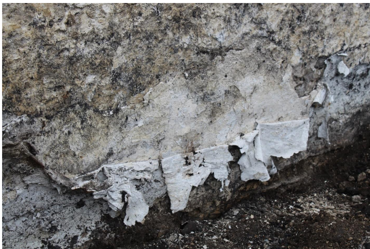
Photo 54 : Peinture blanche pelant d'un mur, probablement à cause de la chaleur de l'incendie. Base du parement extérieur du mur sud 6A300.
