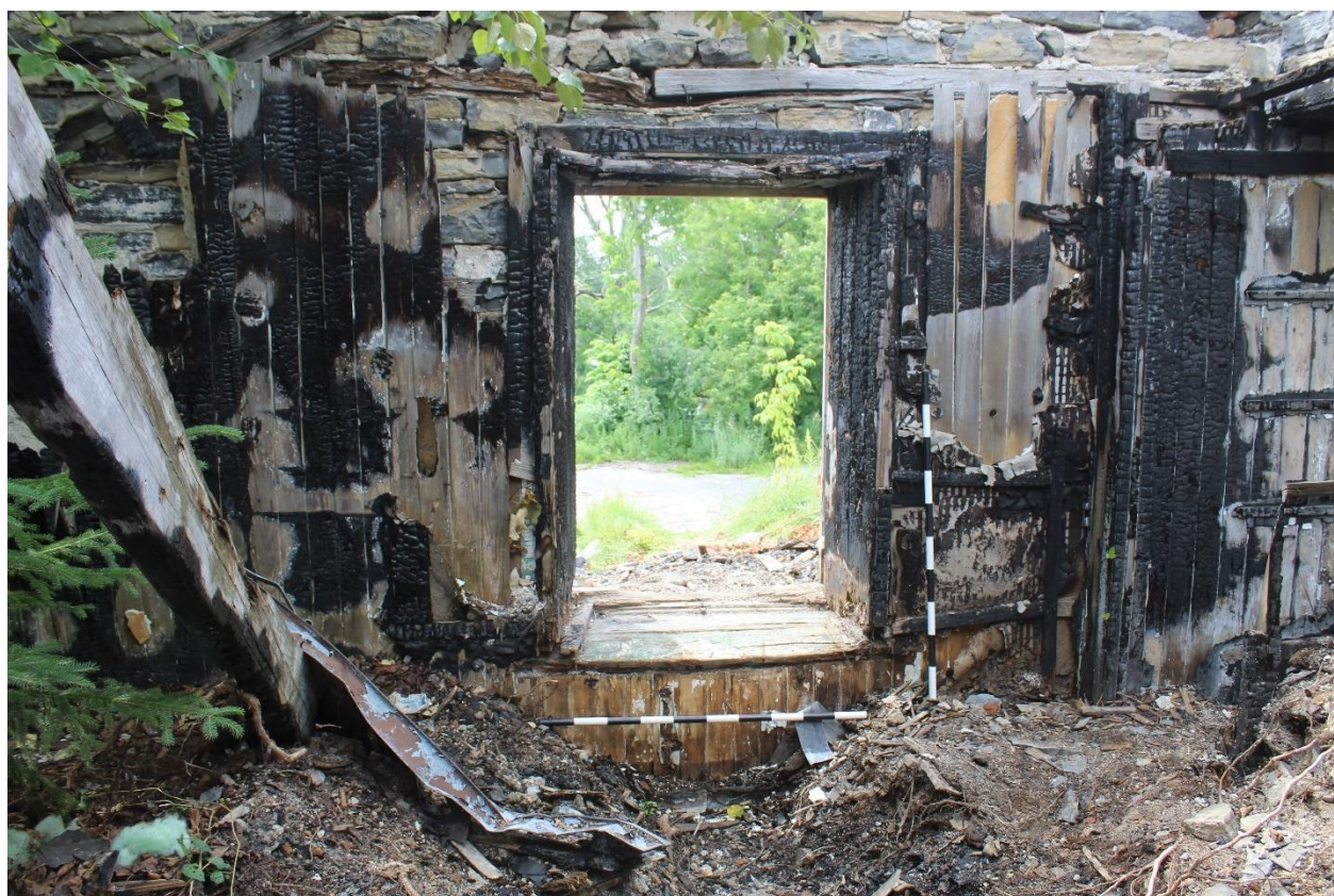
Photo 57 : Exemple d'un parement intérieur de mur couvert d'un lambris en bois, obstruant la vue sur l'assemblage maçonné.
