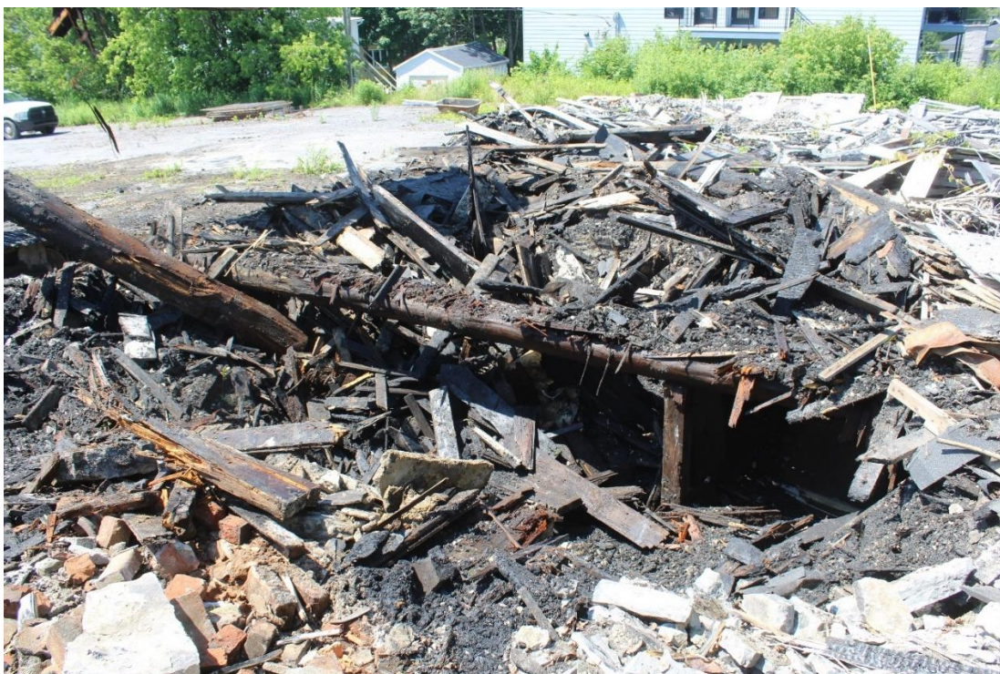
Photo 4 : Au milieu de la photo, une poutre du plancher ayant survécu à l'incendie est encore posée sur un poteau. Vue vers le sud-ouest.
