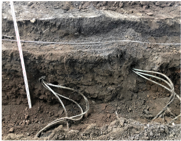
Photo 23 - Tranchée 1D – Câbles électriques triphasés tronquant les parois sud et nord de la sous-opération (MTL22-12-1-22-N1-61_2294)
