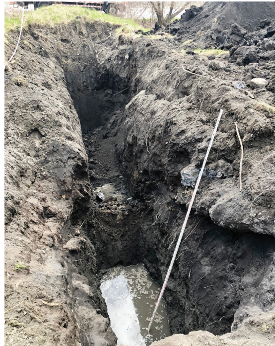
Photo 10 - Tranchée 1A1 — Accumulation d'eau — Vue vers le sud-sud-ouest (MTL22-12-1-22-N1-11)
