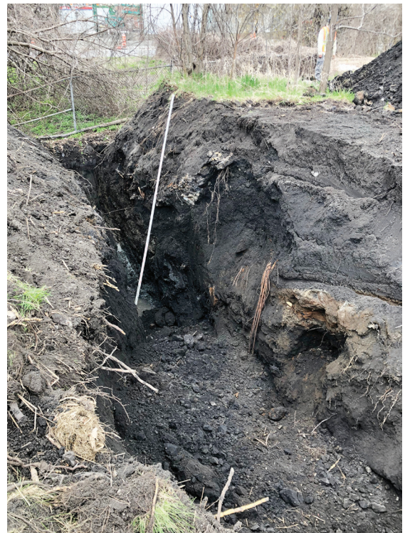
Photo 5 - Tranchée 1B – Parois effondrées. La clôture marque la limite sud de l’aire d’étude – Vue vers le sud-ouest (MTL22-12-1-22-N1-20)
