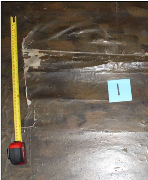
Photo 1 : pertes de la couche picturale.
