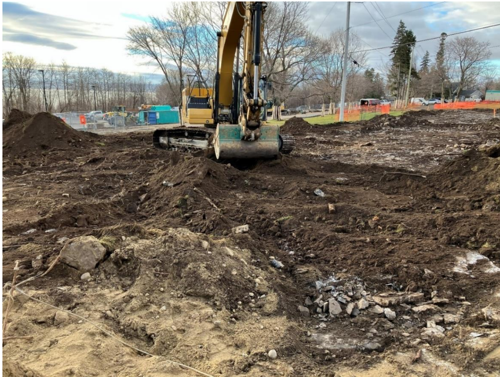
Photo 13. Excavation en cours à l'est des vestiges de Poston House, vue vers le sud-ouest (CfEs-23-24-NUM2-8)
