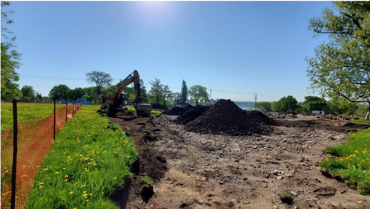
Photo 15. Excavation en cours au nord jusqu'à la limite nord de l'emprise des travaux, vue vers l'est (CfEs-23-25- NUM3-12)
