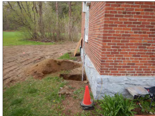
Figure 7.6 : Emplacement de la sous-opération 33B contre le mur sud de la Maison du jardinier, vue vers l'ouest. BjFr-33-25-N1 (24).
