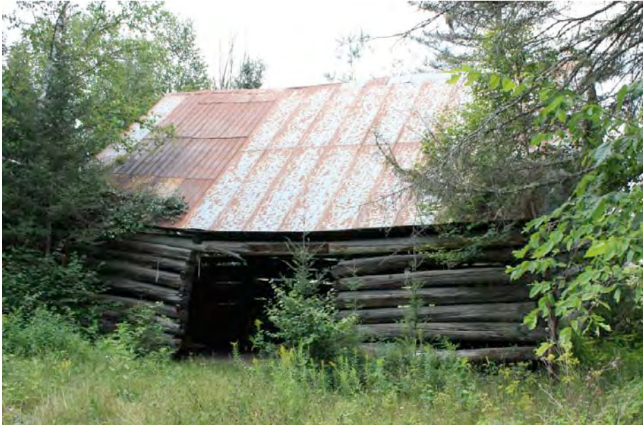
Grange-étable en pièce sur pièce passablement détériorée, chemin de la Rivière-Gatineau, Sainte-Thérèse-de-la-Gatineau. Elle est littéralement en train de s'effondrer. De nombreux autres bâtiments sont dans la même situation. IMG_0642.jpg
