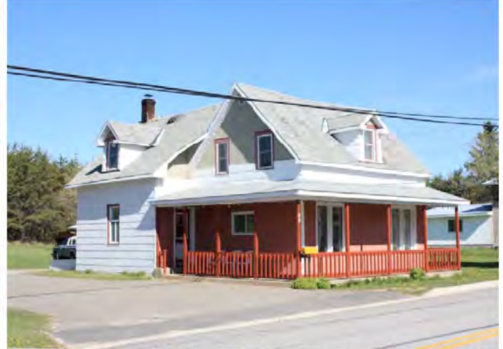
Rue Principale, Messines, bâtiment principal qui a fait l'objet d'interventions inappropriées en ce qui a trait au revêtement mural et aux ouvertures. Le modèle et le format de ces dernières ont été modifiés. IMG_7754.jpg
