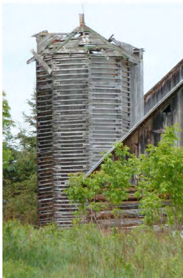
Silo en bois présentant un très mauvais état de conservation, 81, chemin du Détour-Brown, Gracefield. 33F.jpg
