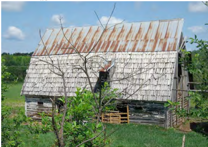
Le revêtement de la toiture de cette grange-étable est fortement détérioré, tout comme le mur-pignon, 3 e Rang Sud, Montcerf-Lytton. 76A.jpg
