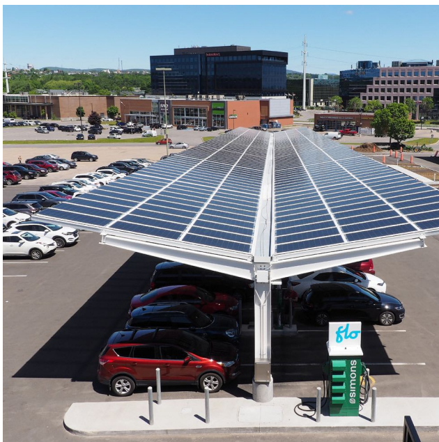
Ombrières solaires à Québec
