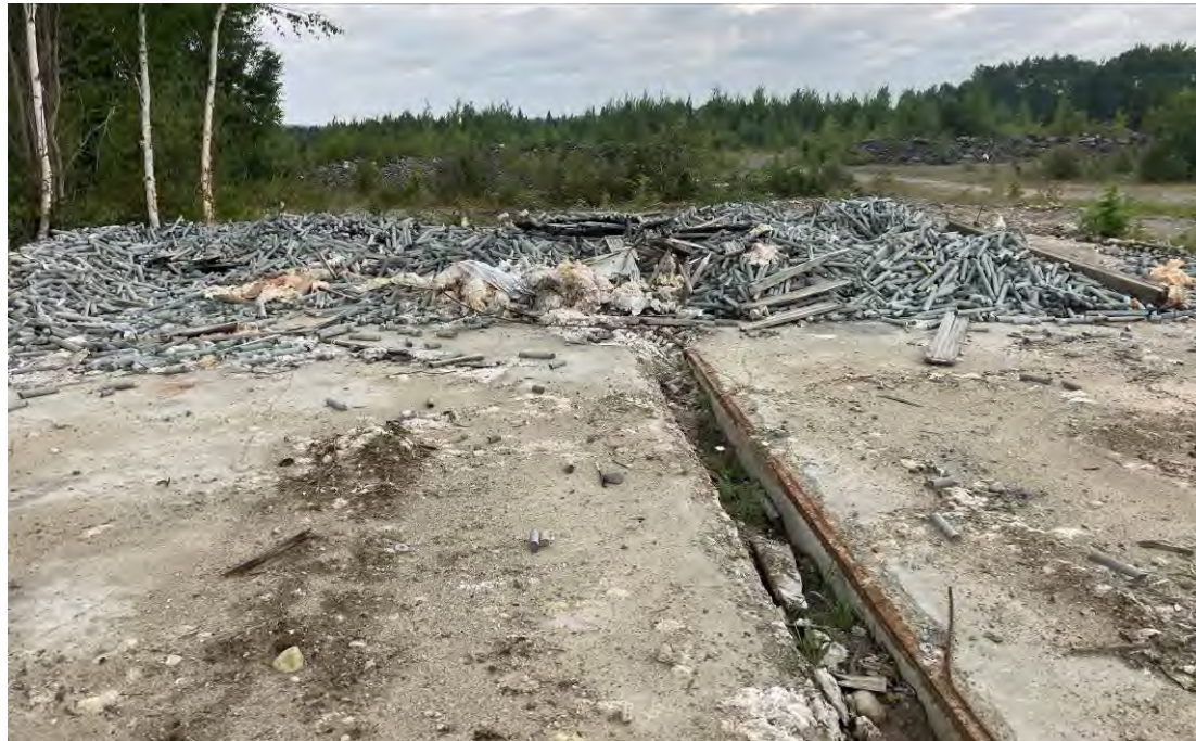
Photographie 2021-07-26_CROI-002 Sur la fondation du garage, on retrouve encore quelques débris qui devront être récupérés UTM NAD 83 : 349548 Est / 5330296 Nord
