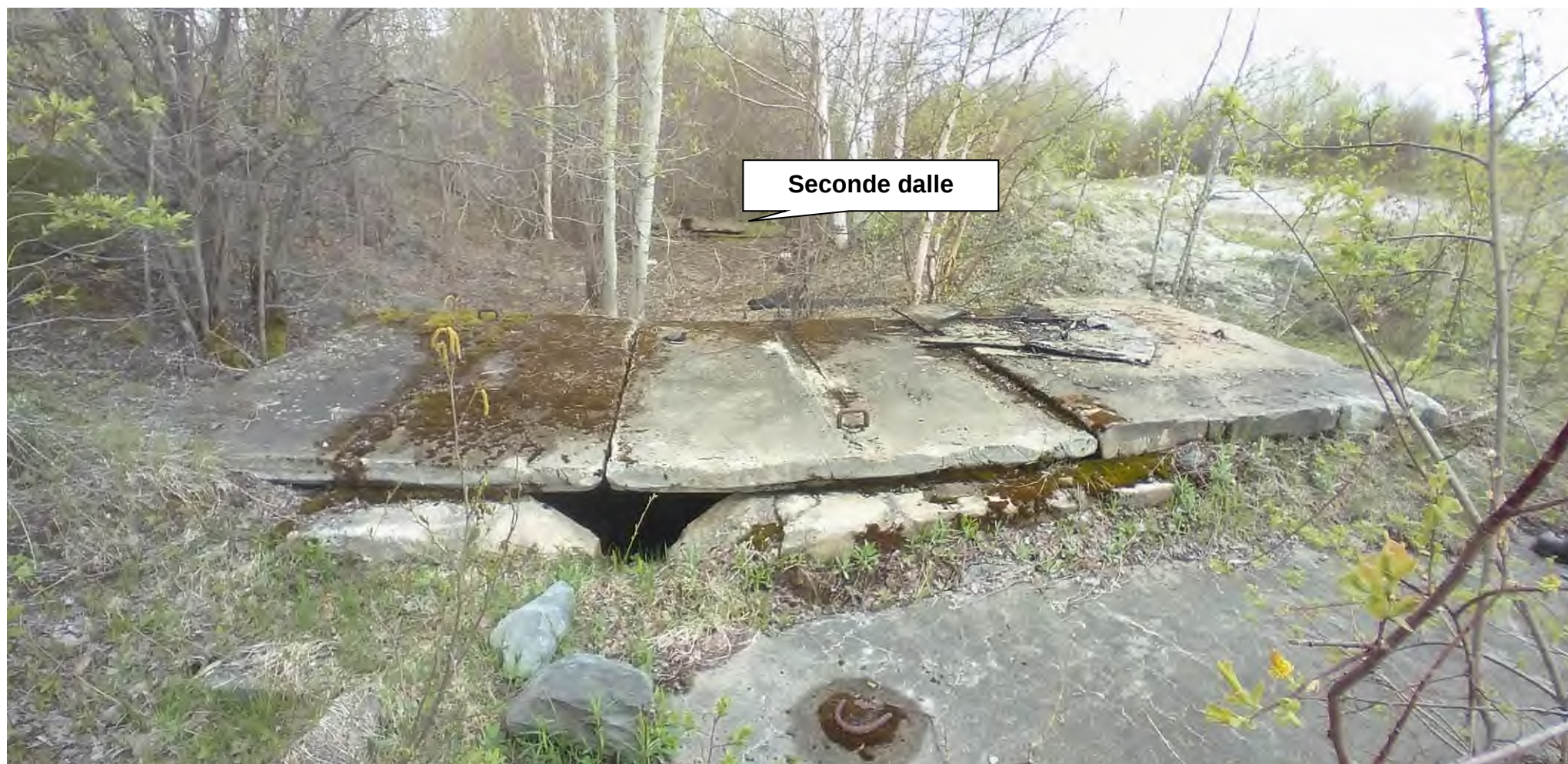
2021-05-20_CROI-009 : Dalle de béton endommagé condamnant le puits
