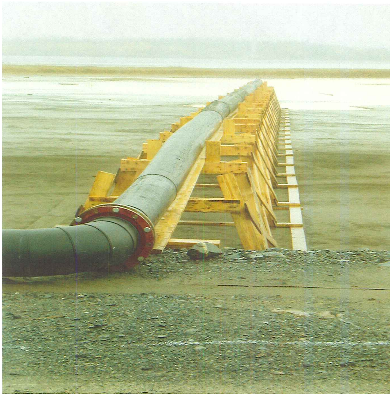
Photo 1 : Le tuyau de déchargement de l'eau de la fosse MLM dans le bassin ouest.
