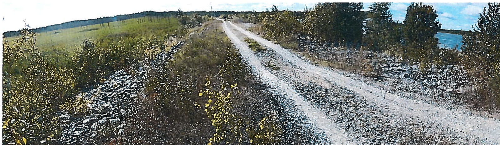
Photographie 2016-09-01_E-SUL-016 — Déversoir d'urgence du bassin sud.
