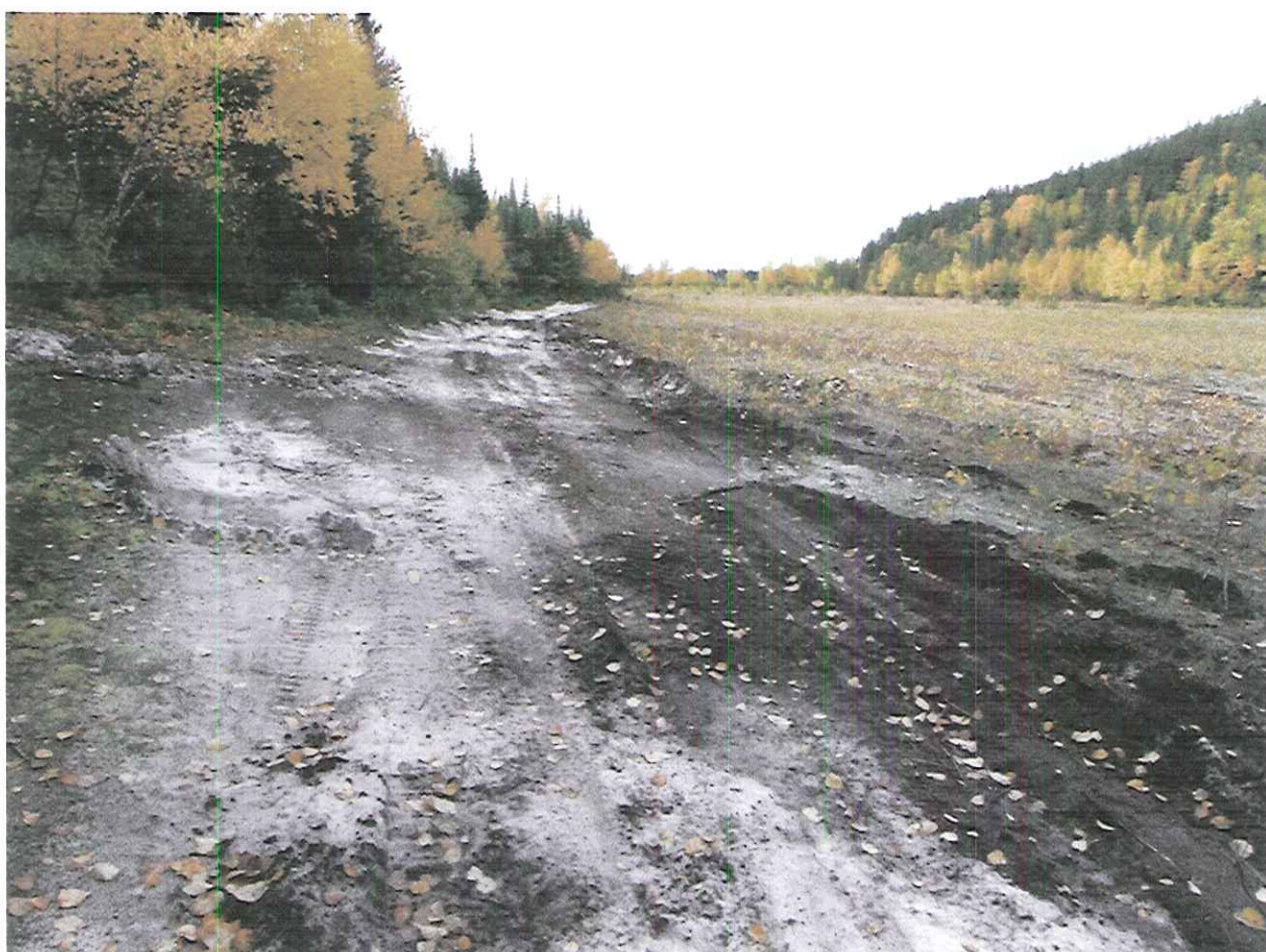
Photo 10 : Le chemin du côté sud du parc est aussi dégradé dans la portion est.
