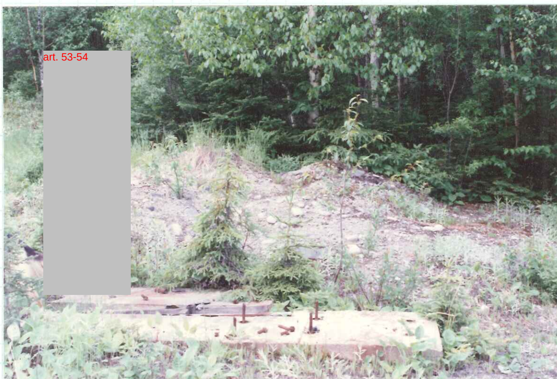
Cheminée numéro 2. Base du ventilateur. Le gardien est permanent.
