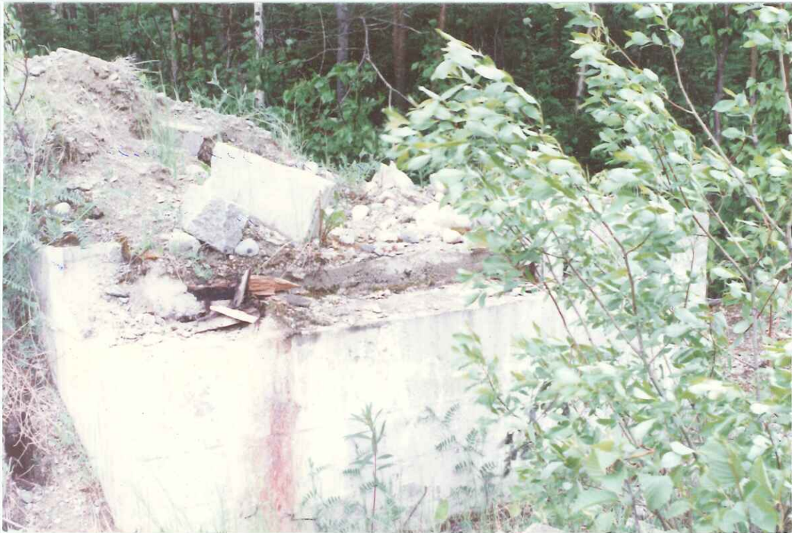
Cheminée numéro 4. Monterie en surface de ventilation de la galerie 1-69 S.E. .La batisse à été démolie et volée.
