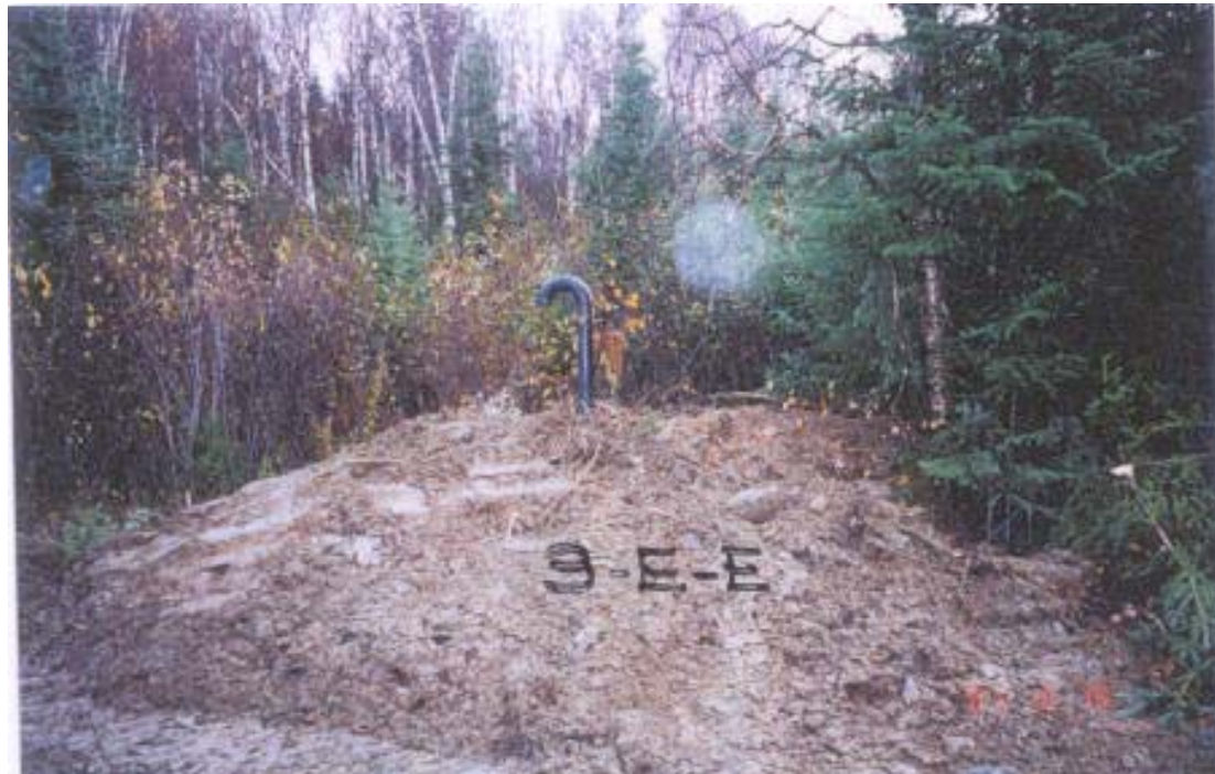
QL-2001-10-009 – Monterie ventilateur de surface recouverte.
