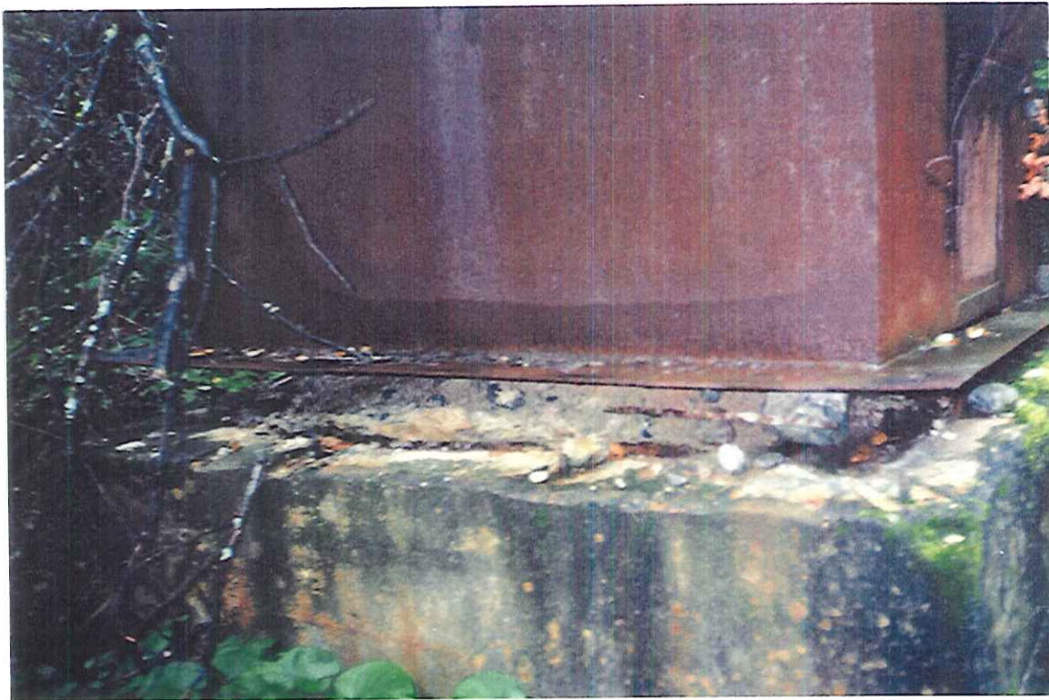
Photo 3. Dalle de béton de la cheminée de ventilation endommagée (avant les travaux).
