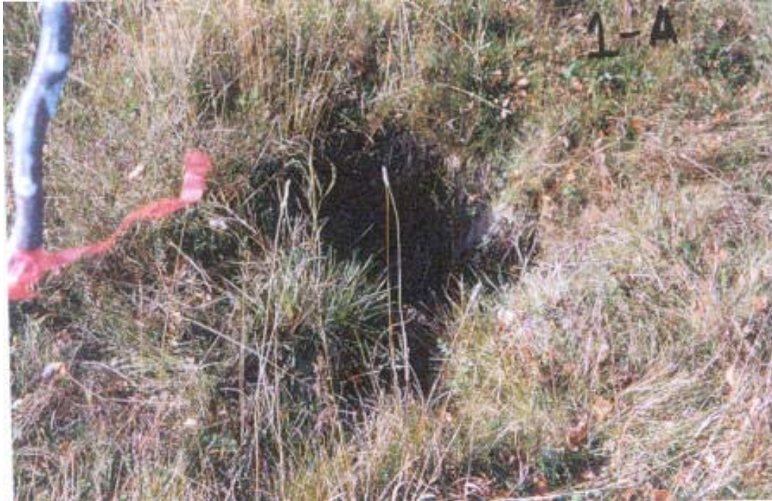
QL-2001-10-001 – Tour de décantation : affaissement
