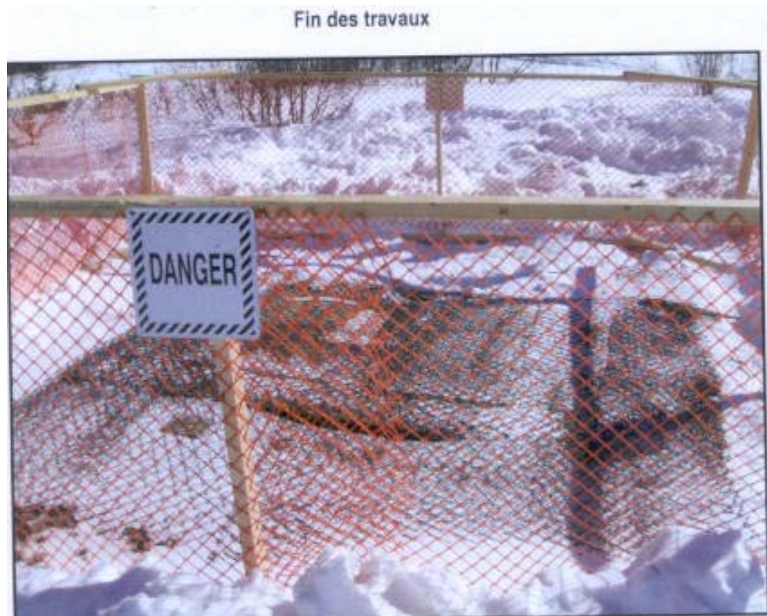
QL-2007-12-002 – Affaissement APRÈS les travaux correcteurs
