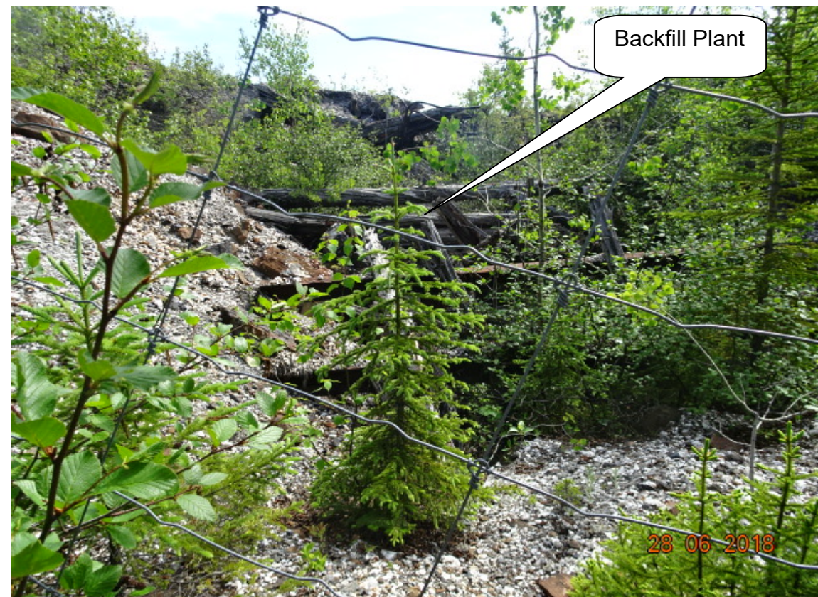
IS-2018-06-28-007 – Du côté Ouest, affaissement au Backfill Plant (vue vers l'Est) Coordonnées UTM Nad83 : 584861 Est, 5565719 Nord
