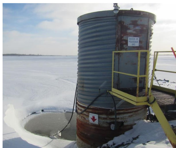
2021-12-03_CAM_013 : Station de pompage du bassin 1 du parc à résidus
