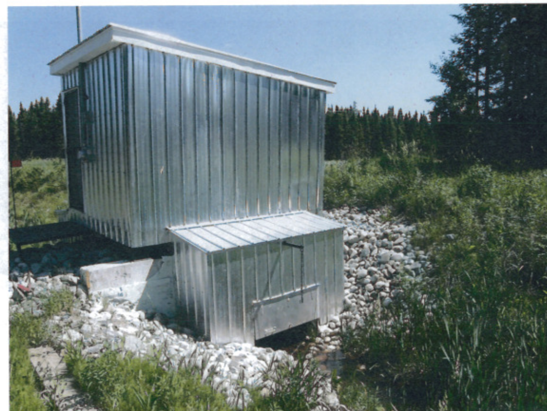
Photo Camflo-2012-06-21-002 : Effluent fédéral, situé à l'extrémité nord-ouest du bassin 1.
