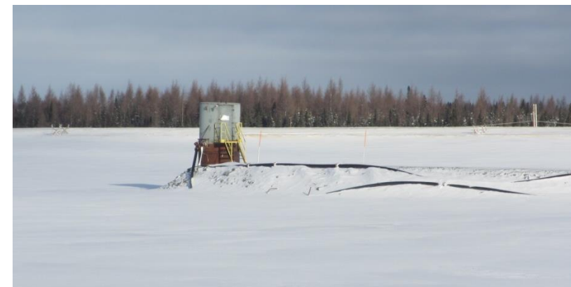
2021-12-03_CAM_018 : Station de pompage du bassin 2 du parc à résidus
