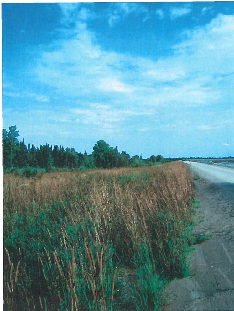
Photo Camflo-2017-08-29-008 : Végétation sur la digue 1-ouest
