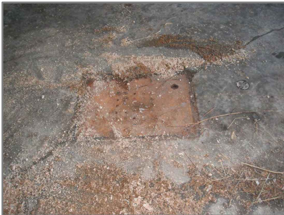
Photo 17 : Drain de plancher dans l'entrepôt
