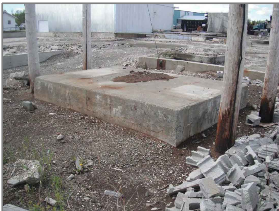
Photo 26 : Ancien poste électrique de l'usine (direction Sud-Ouest)
