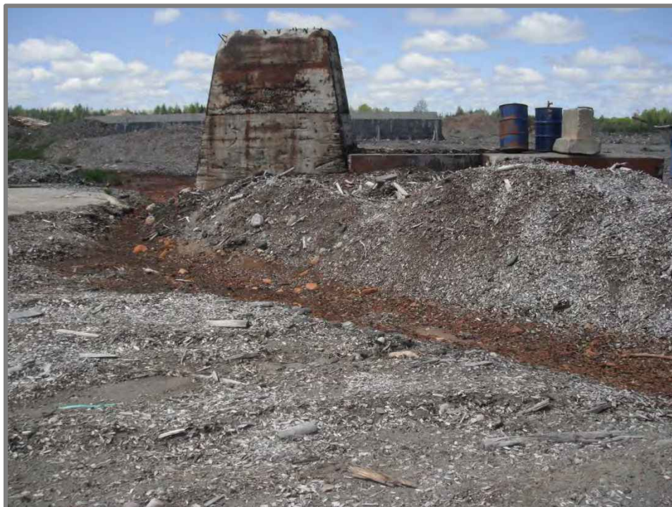
Photo 27 : Structures supportant les chargeuses fixes à l'entrée de l'usine (direction Est)
