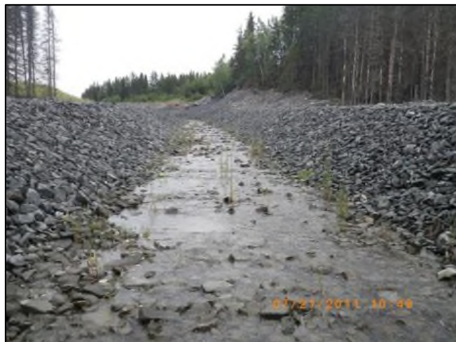
Photo 1 : Canal de sortie du bassin de polissage après la rupture de la digue en 2014
