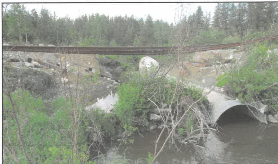
Figure 2-15: Voie ferrée endommagée
