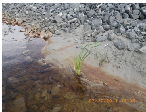
Fuite dans la digue et écoulement de résidus
