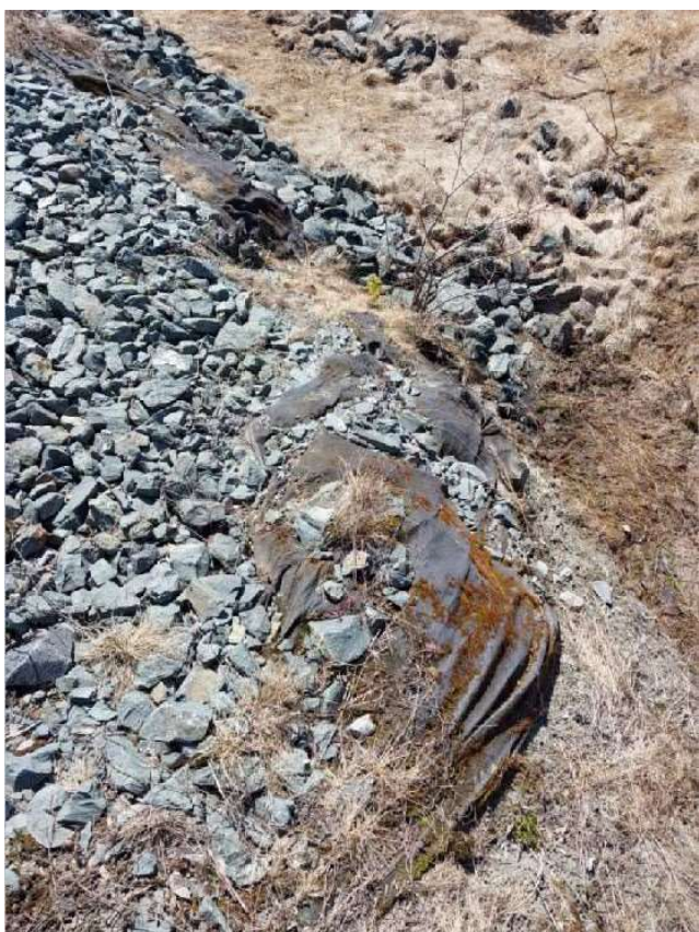
Photo no. 18. Géomembrane dénudée autour du bassin ouest.
