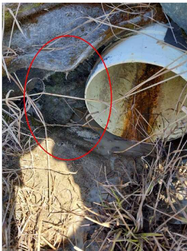
Photo no. 19. Cavité en bordure d'un des trois tuyaux qui déversent le bassin ouest.
