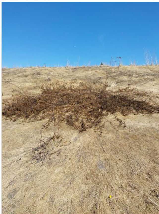
Photo no. 34. Zone de glissement sur le digue ouest, Coordonnées de la photo UTM Nad 83 303183 E 5378342 N
