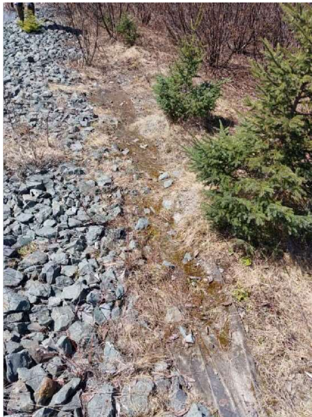
Photo no. 17. Géomembrane dénudée autour du bassin ouest.
