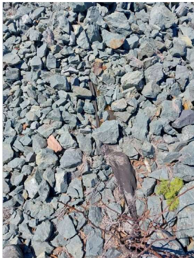
Photo no. 25. Géomembrane dénudée du bassin est.
