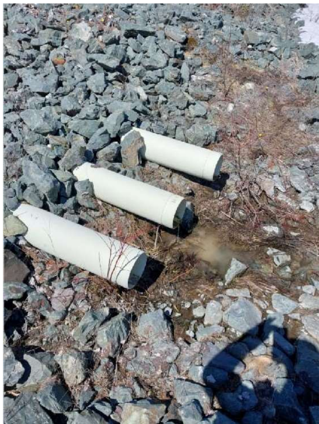
Photo no. 20. Tuyaux qui déversent le bassin ouest. Regard vers l'ouest.
