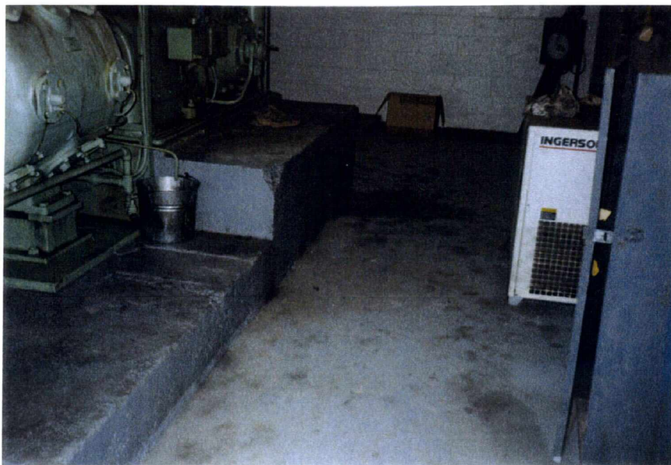
Salle de compresseurs attenante au nouveau garage. Plancher de béton repeint.
