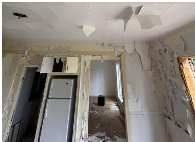
Photographie 8 : 5356915-mur (sur bord de la fenêtre à droite)
