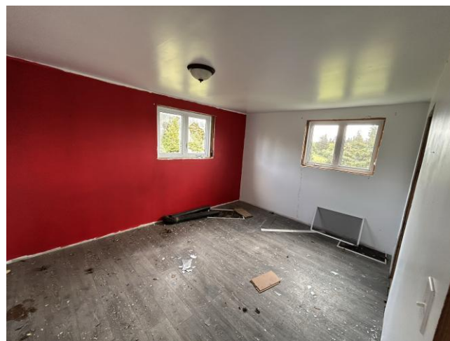
Photographie 20 : 5356949-mur1 (angle bas de la fenêtre sur mur blanc)
