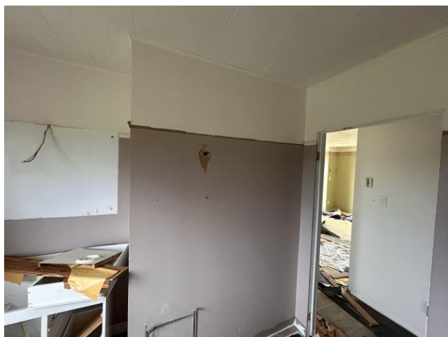
Photographie 3 : 5356913-mur3 (à droite de l'entrée de la salle d'eau)
