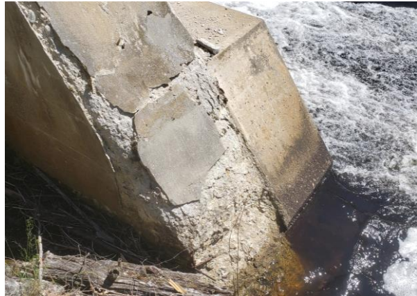
Figure 70 Délaminage d'une structure de béton, ouvrage rigide.
