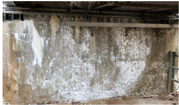
Figure 74 Dégradation d'un mur de béton par réaction alcali-granulat. Source : WSP
