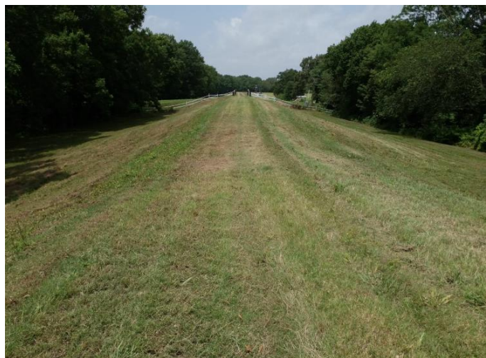
Figure 50 Zone de tassement localisée au niveau de la crête d'une digue.
