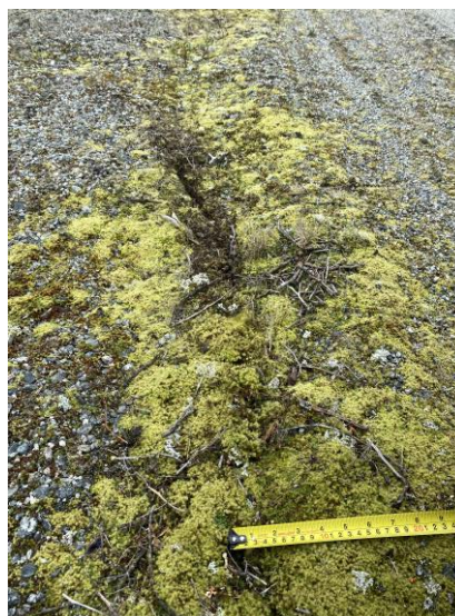
Figure 56 Fissure longitudinale en crête d'une digue.
