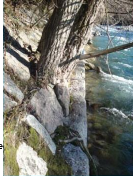
Figure 76 Endommagement par la végétation d'un parement amont en maçonnerie.
