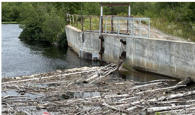
Figure 72 Instabilité d'un mur d'un ouvrage rigide, accumulation de débris.
