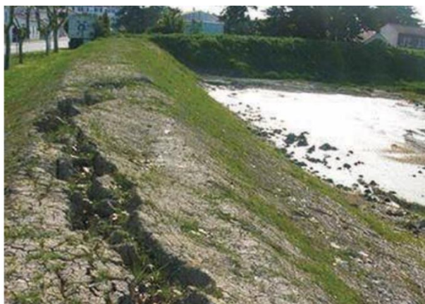
Figure 55 Digue montrant l'amorce d'un glissement par la présence de fissures ouvertes en crête.
