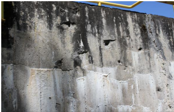
Figure 73 Éclats de béton et fissuration polygonale d'un mur. Source : WSP
