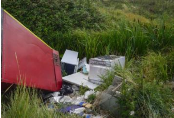
Figure 66 Accumulation de débris qui font obstruction à l'écoulement dans un canal de drainage.
