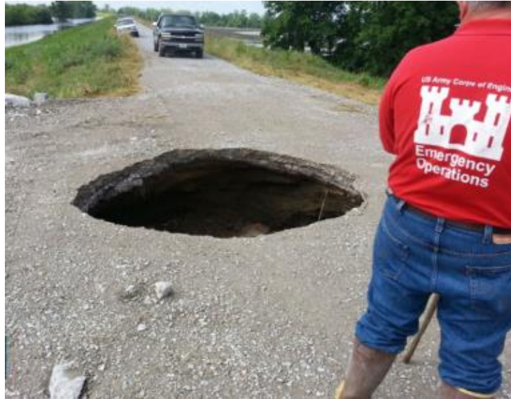
Figure 49 Affaissement en crête d'une digue.
