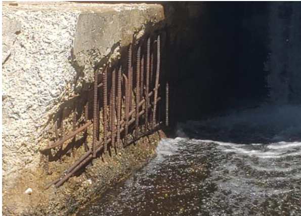
Figure 69 Érosion d'un mur de béton avec armature apparente, ouvrage rigide.
