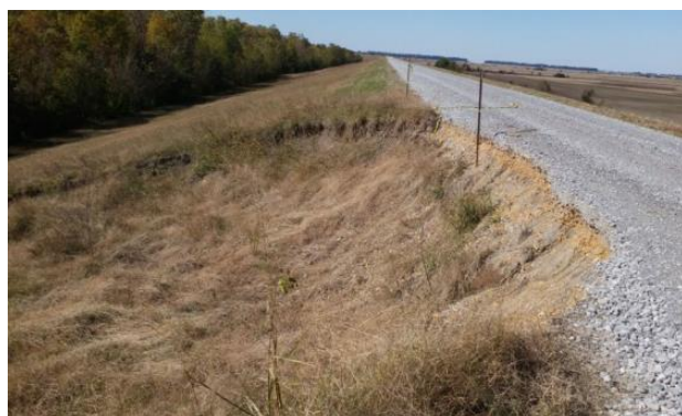
Figure 57 Glissement du talus aval avec perte partielle de la crête.
