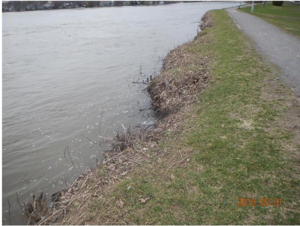
Figure 51 Anse d'érosion mineure du parement amont d'une digue. Source : MELCCFP
