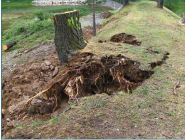
Figure 38 Déracinement d'un arbre sur une digue.
