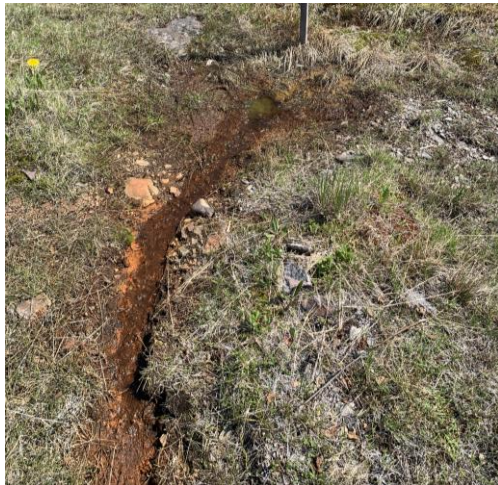
Figure 61 Venue d'eau en aval d'une digue en terre.
