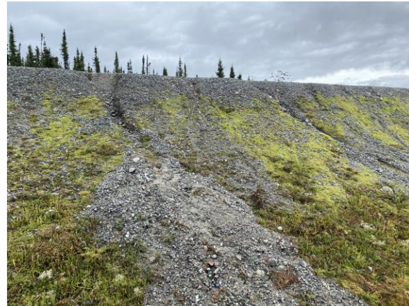
Figure 52 Sillon d'érosion sur la pente aval d'une digue. Source : WSP
