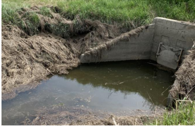
Figure 71 Érosion au droit des appuis de murs d'aile en béton d'un dispositif connexe, fissuration, clapet côté eau.
