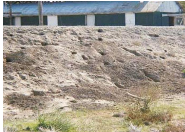
Figure 54 Cavités créées par des animaux fouisseurs dans le talus d'une digue. Source : CEREMA
