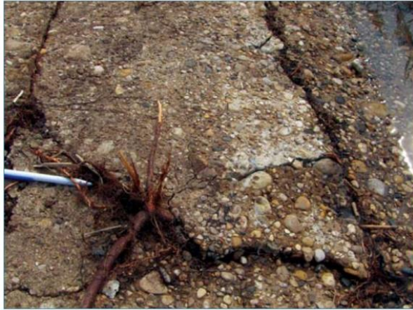
Figure 75 Intrusion de racines dans une dalle de béton.
