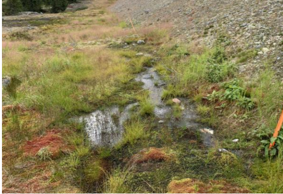
Figure 63 Zone humide avec accumulation d'eau au pied aval d'une digue en terre. Source : WSP
