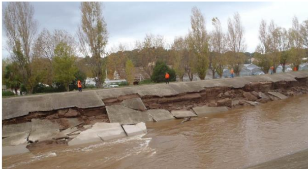
Figure 53 Érosion de perré. Source : CFBR (2021)
