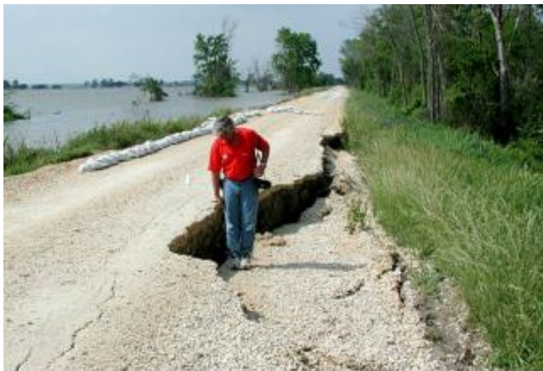
Figure 48 Affaissement avec présence de fissures en surface.
