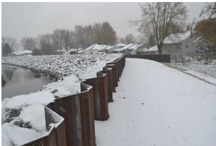
Figure 7 : Exemple d'ouvrage protégeant un secteur habité (Source : MELCCFP)
