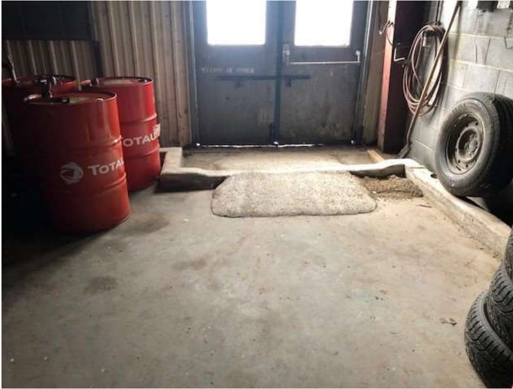
Figure 34 : Bac de rétention pleine grandeur à même la dalle de béton
