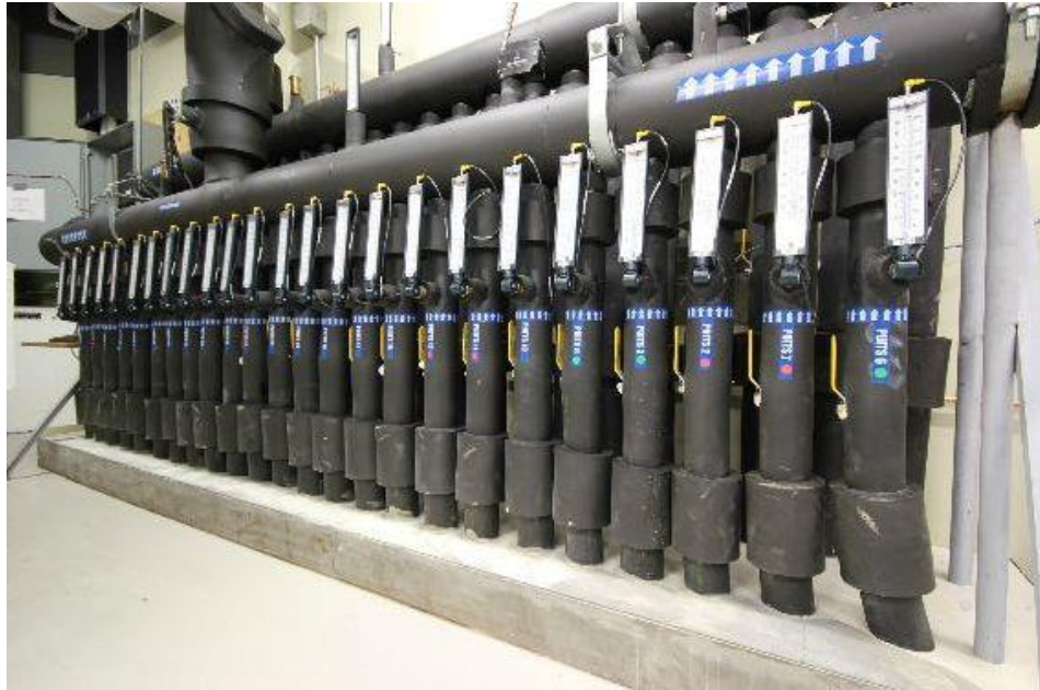
Géothermie – Réseau de conduits menant au puits géothermique – Source : Solutions Novika
