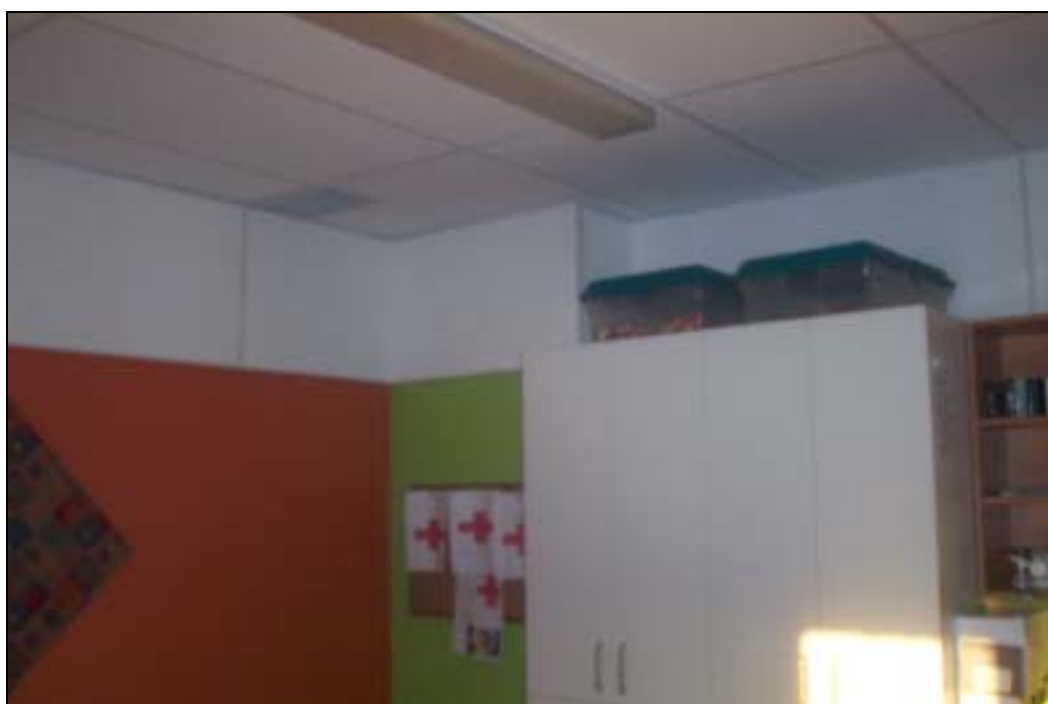
Figure 16 Plafond acoustique avec une bande de panneaux acoustiques de 2 pieds de hauteur installés dans le local A-1
