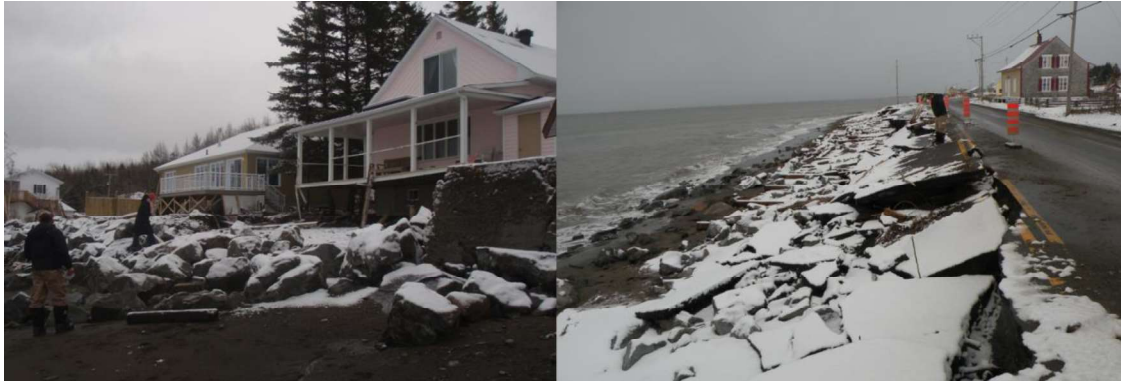
Figure 6. Érosion derrière des ouvrages de protections côtière lors de la tempête du 6 décembre 2010 ©LDGIZC, UQAR
